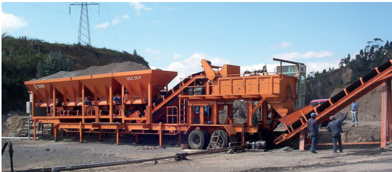
Figura 13. Planta mezcladora de suelo-cemento Fuente: Ciber, 2018
