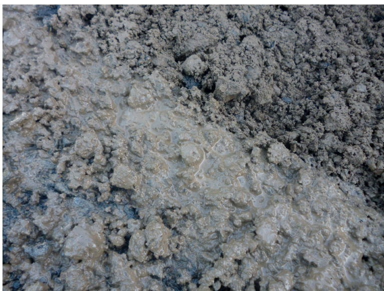
Figura 7. Base con exceso de humedad Fuente: LanammeUCR
