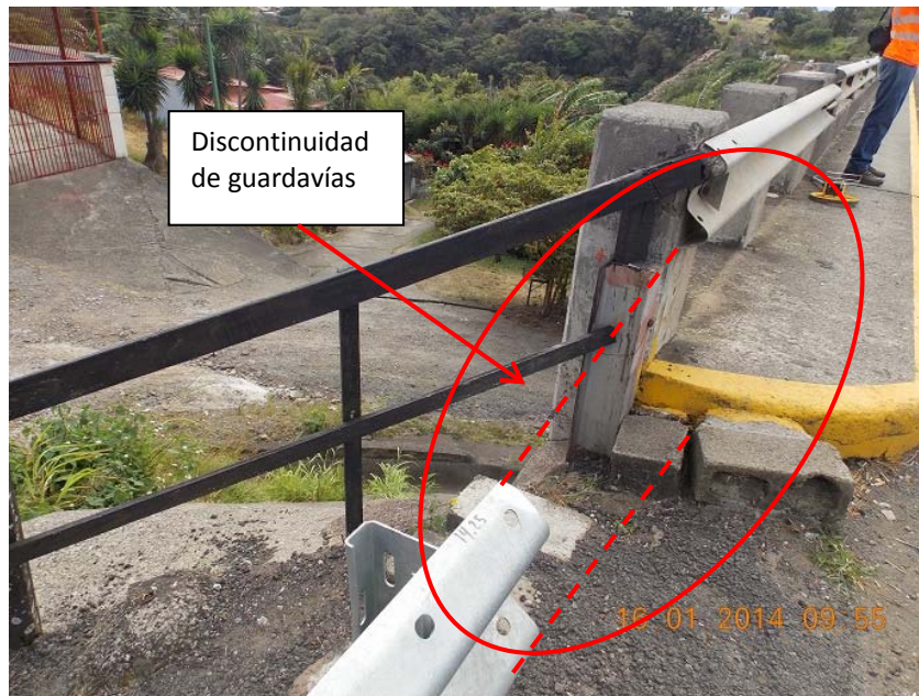
Figura 5: El guardavías del acceso norte en el costado este no es continuo.
