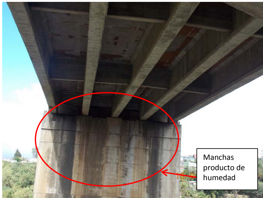
Figura 33: Manchas producto de la humedad constante en pila 4.
