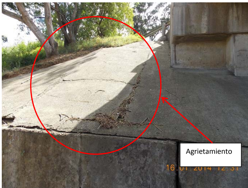
Figura 28: Agrietamiento en la losa de protección del talud del acceso sur.
