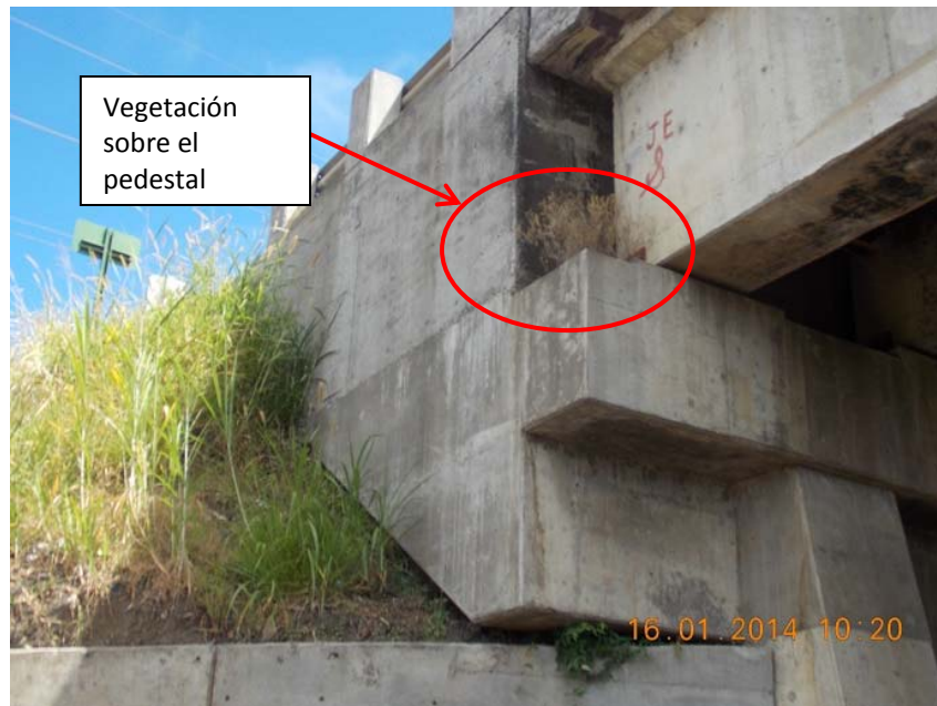
Figura 25: Vegetación sobre el pedestal del bastión 1.
