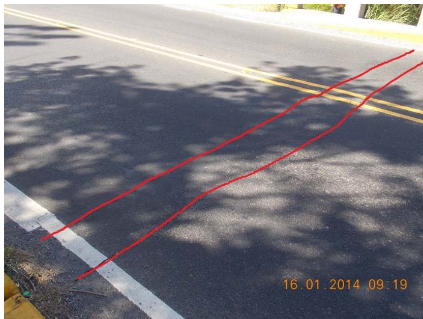
Figura 14: Junta cubierta con asfalto entre bastión 2 y tramo 7. Se resalta con rojo el agrietamiento en el asfalto
