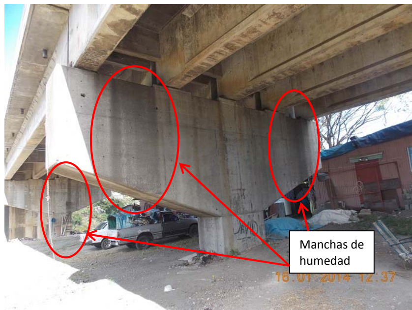
Figura 34: Manchas producto de la humedad constante en las pilas 5 y 6.
