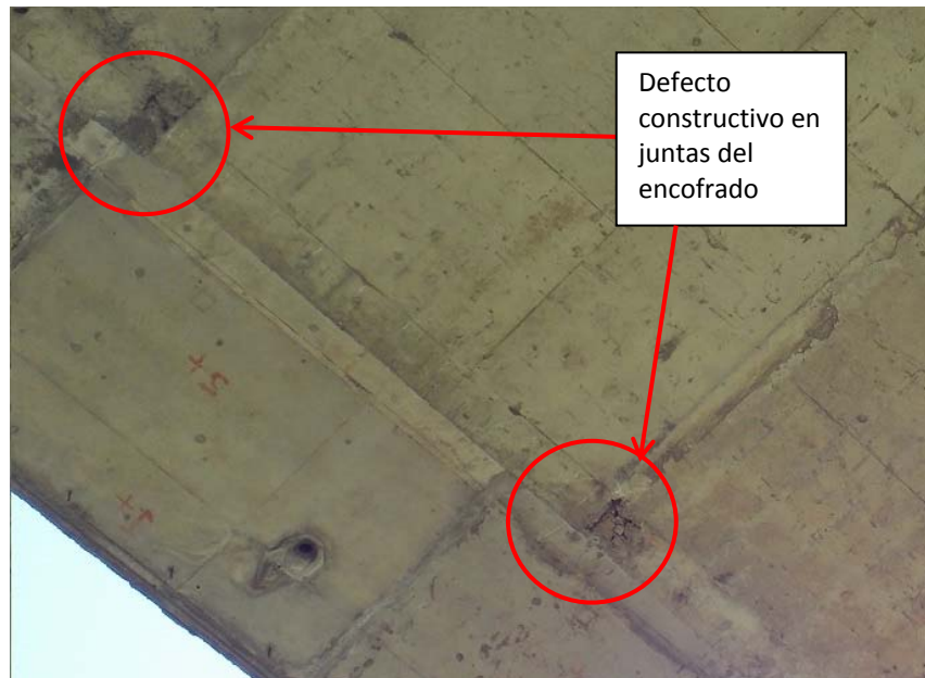
Figura 17: Defecto constructivo en viga cajón debido a colocación del encofrado, costado este del tramo 2.
