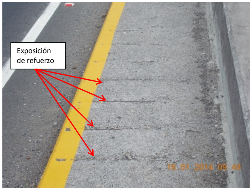
Figura 9: Exposición de refuerzo por recubrimiento insuficiente en acera del costado este.
