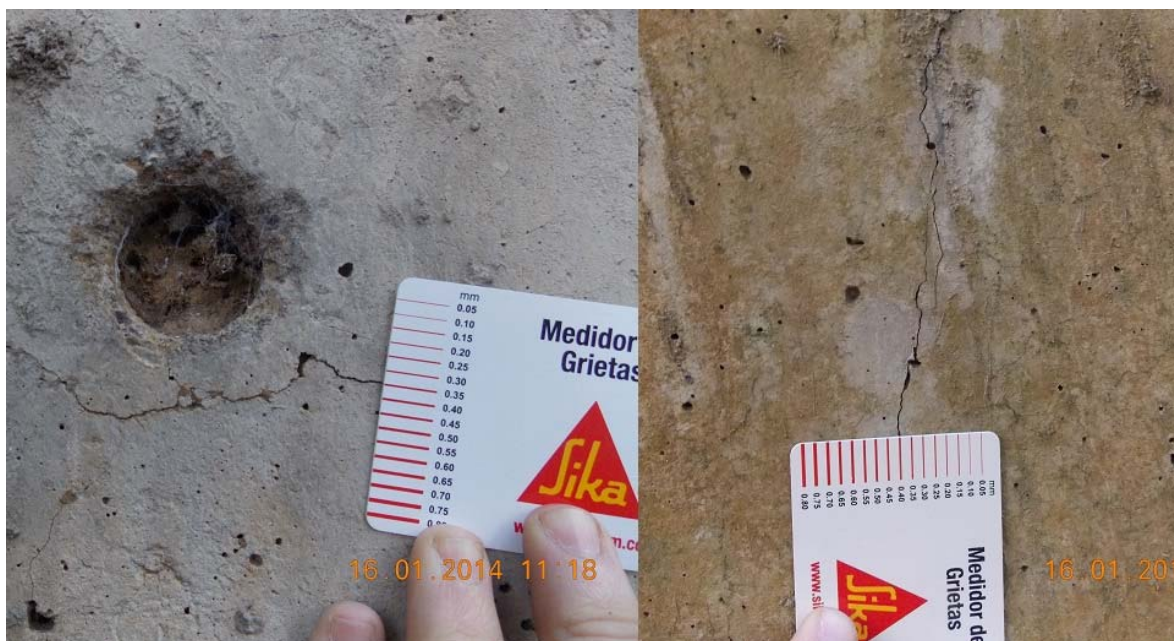
Figura 30: Agrietamiento no estructural en el cuerpo de pila 2. Daño puntual.
