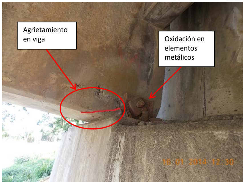
Figura 23: Agrietamiento en viga y oxidación en angulares placas y pernos en apoyo del bastión 2.
