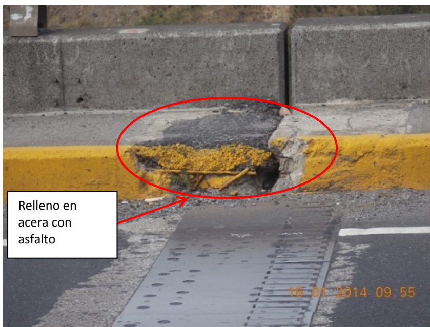
Figura 10: Relleno con material asfáltico en la acera en el costado este entre tramos 1 y 2.
