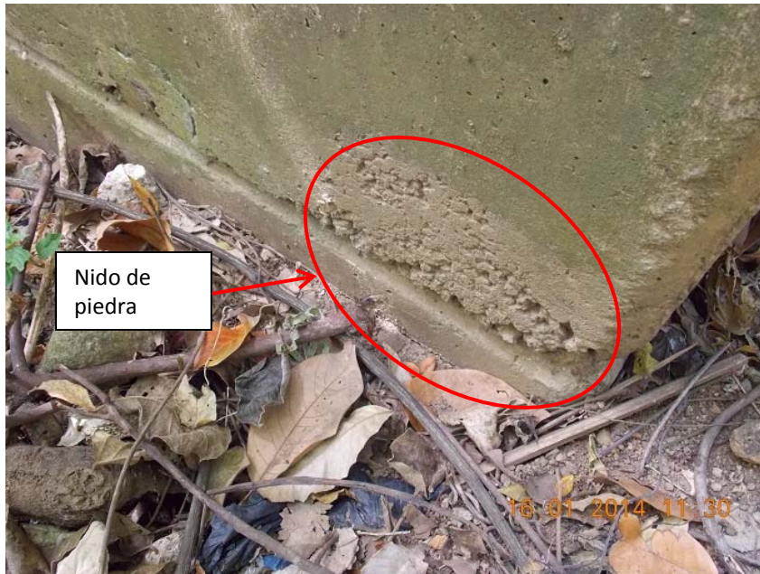
Figura 31: Nido de piedra en base de pila 2. El daño es puntual.
