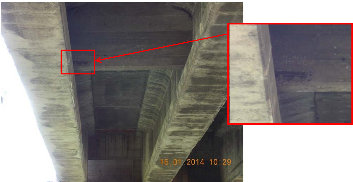
Figura 22: Desprendimiento de concreto y exposición del refuerzo en viga diafragma interior del costado este del tramo 1. El daño es puntual.
