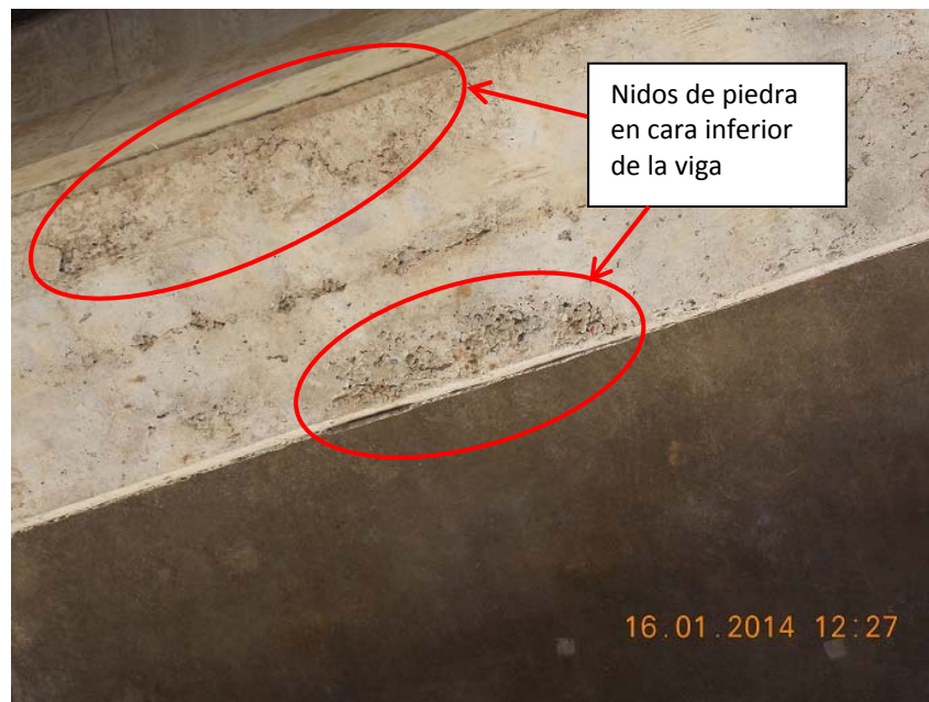
Figura 16: Nidos de piedra en viga del tramo 2. El daño es puntual.
