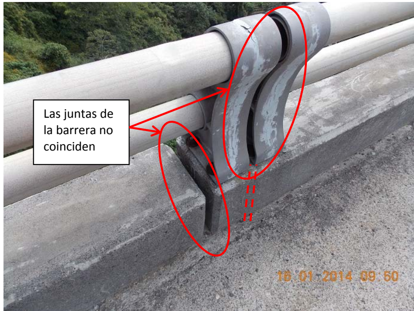
Figura 3: Las juntas de la barrera vehicular no coinciden.
