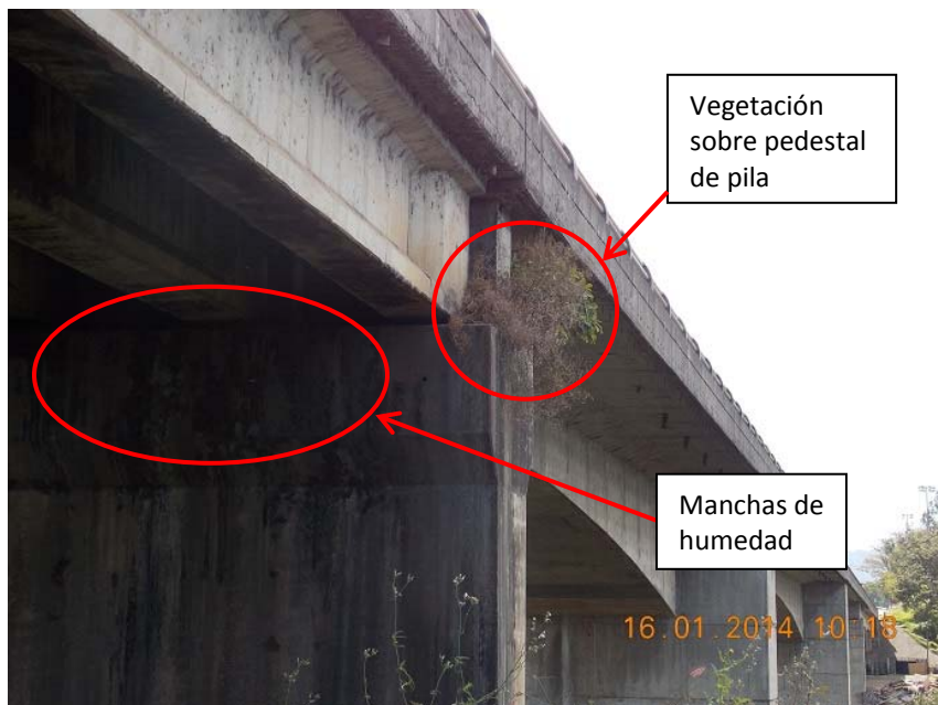
Figura 29: Manchas de humedad y vegetación sobre pedestal en pila 1.
