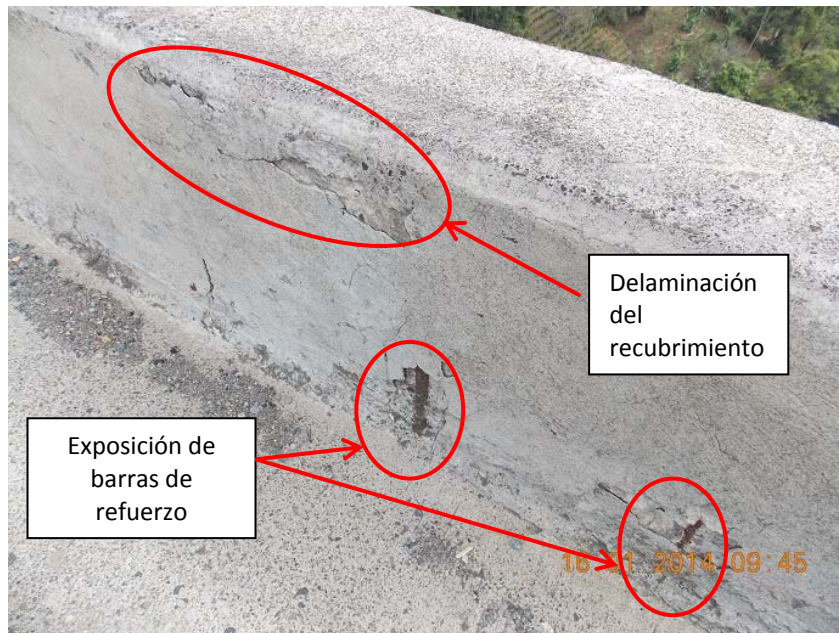
Figura 1: Pérdida de recubrimiento y barras de acero de refuerzo expuestas en barrera del costado este.
