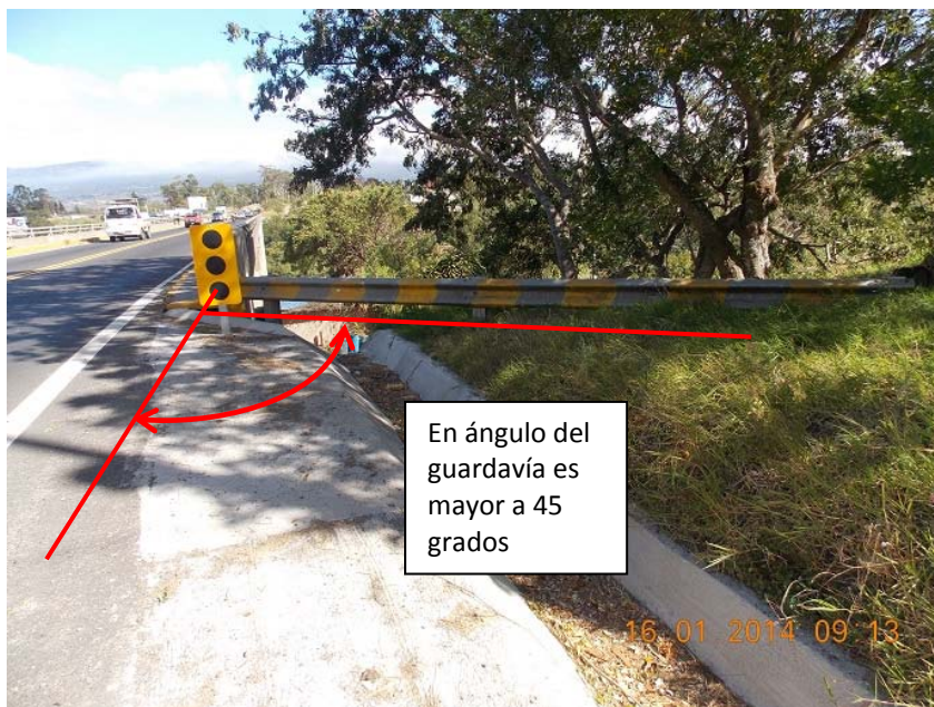
Figura 4: Guardavías del acceso sur con un ángulo inadecuado para retornar vehículos a la calzada.
