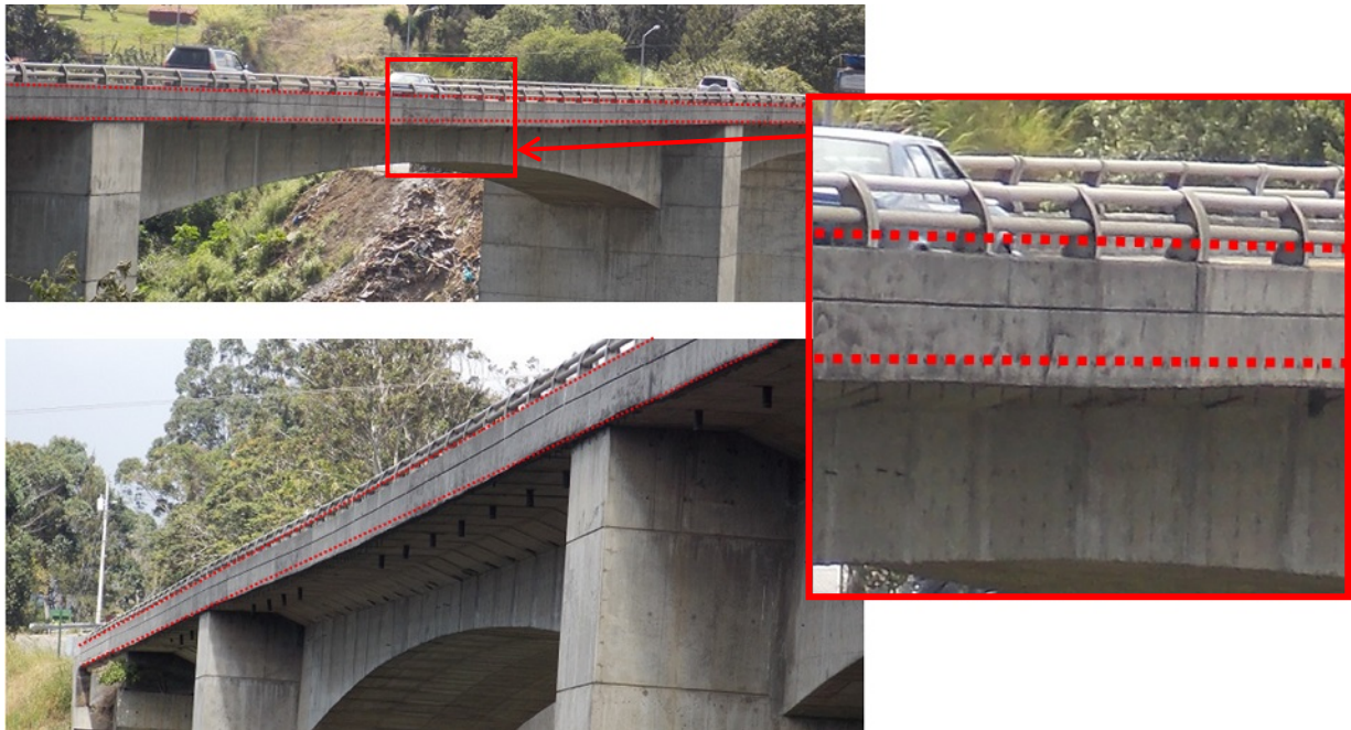
Figura 21: Deformación vertical del tramo 3. Arriba visto desde el norte, abajo vista desde el sur
