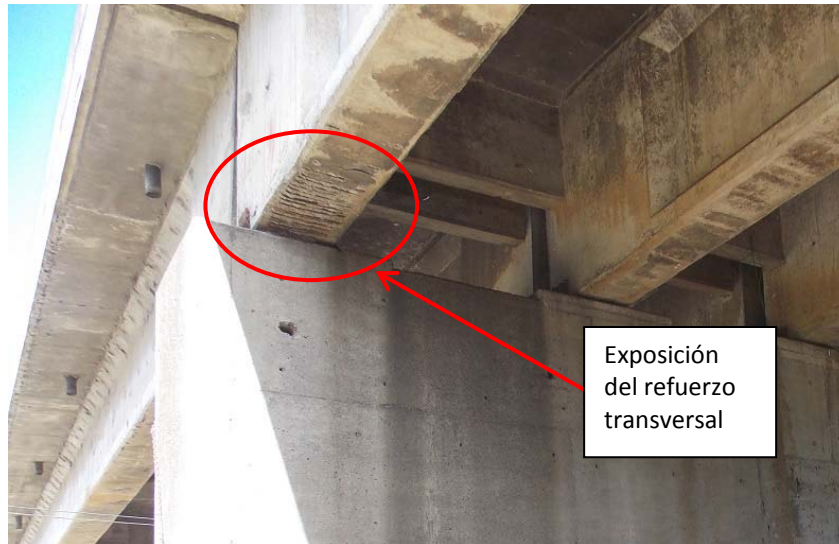
Figura 15: Pérdida de recubrimiento y exposición del refuerzo transversal en el extremo norte de la viga del costado oeste del tramo 7. El daño es puntual.
