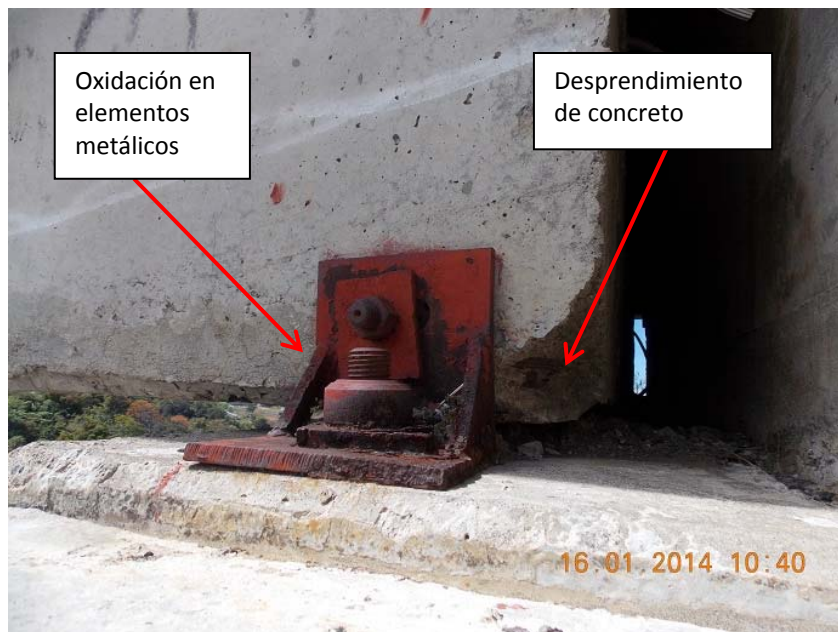
Figura 24: Agrietamiento en viga y oxidación en angulares placas y pernos en apoyo del bastión 2.
