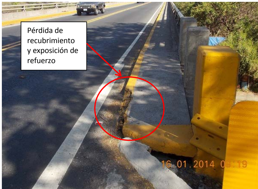
Figura 7: Pérdida de recubrimiento en acera del acceso sur costado este.
