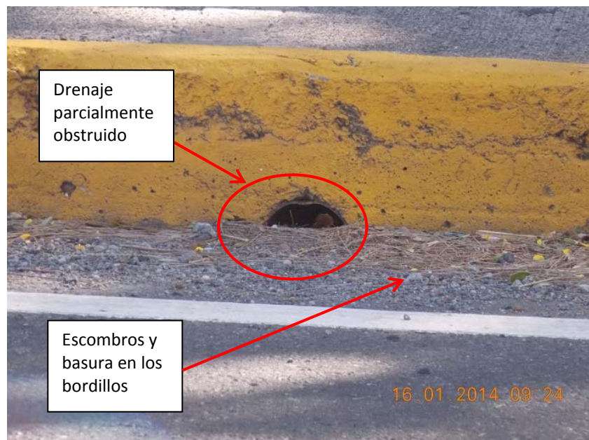
Figura 12: Acumulación de basura y escombros en bordillo y drenaje parcialmente obstruido con sobrecapa de asfalto.
