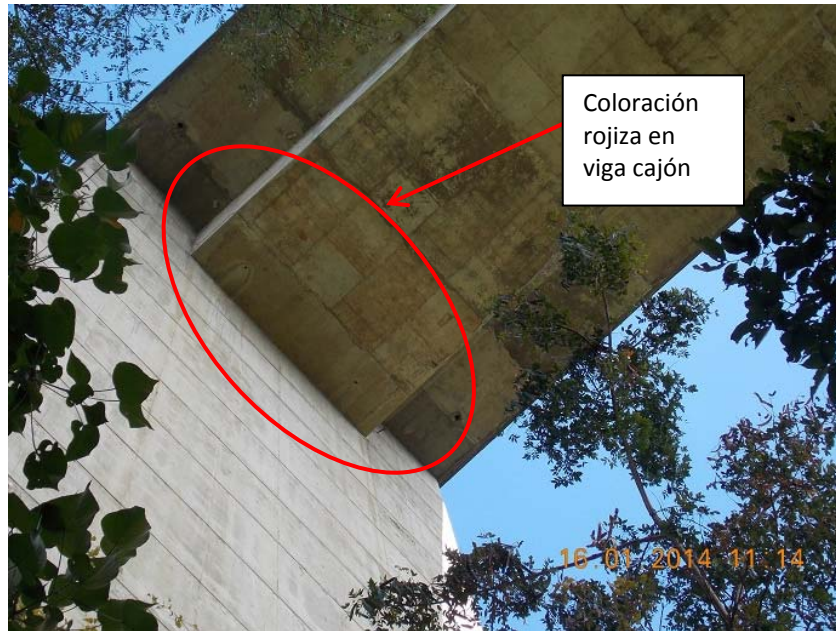
Figura 19: Coloración rojiza en viga cajón del tramo 2.
