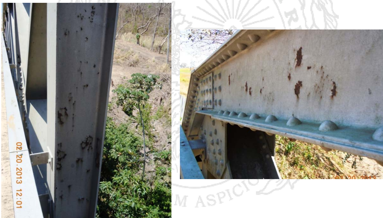
Figura 16: Zonas puntuales de corrosión en los elementos de las armaduras.
