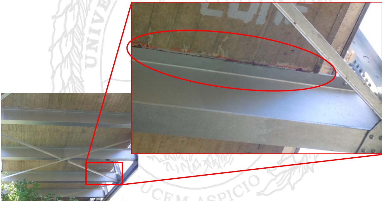
Figura 14: Agrietamiento y eflorescencia de la losa de concreto en los apoyos de las vigas transversales.
