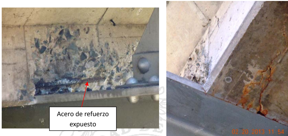
Figura 13: Agrietamiento y desprendimiento de concreto por concentración de esfuerzos en los bordes de la losa.
