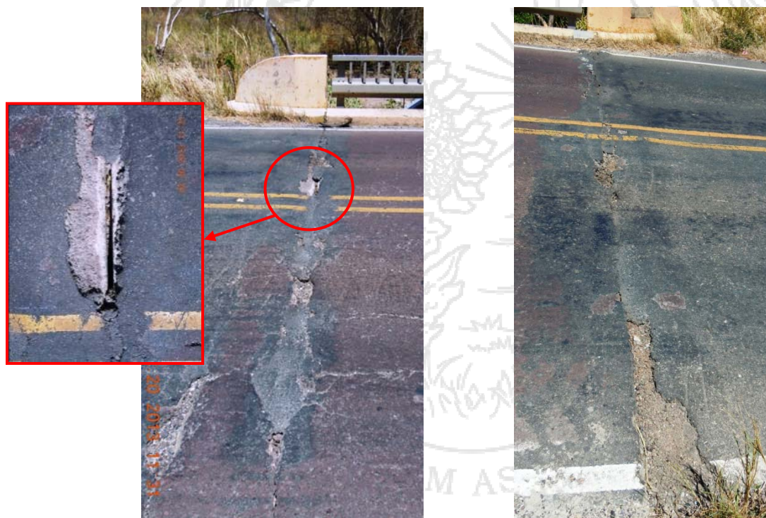
Figura 12: Obstrucción de las juntas de expansión y pérdida del sello.
