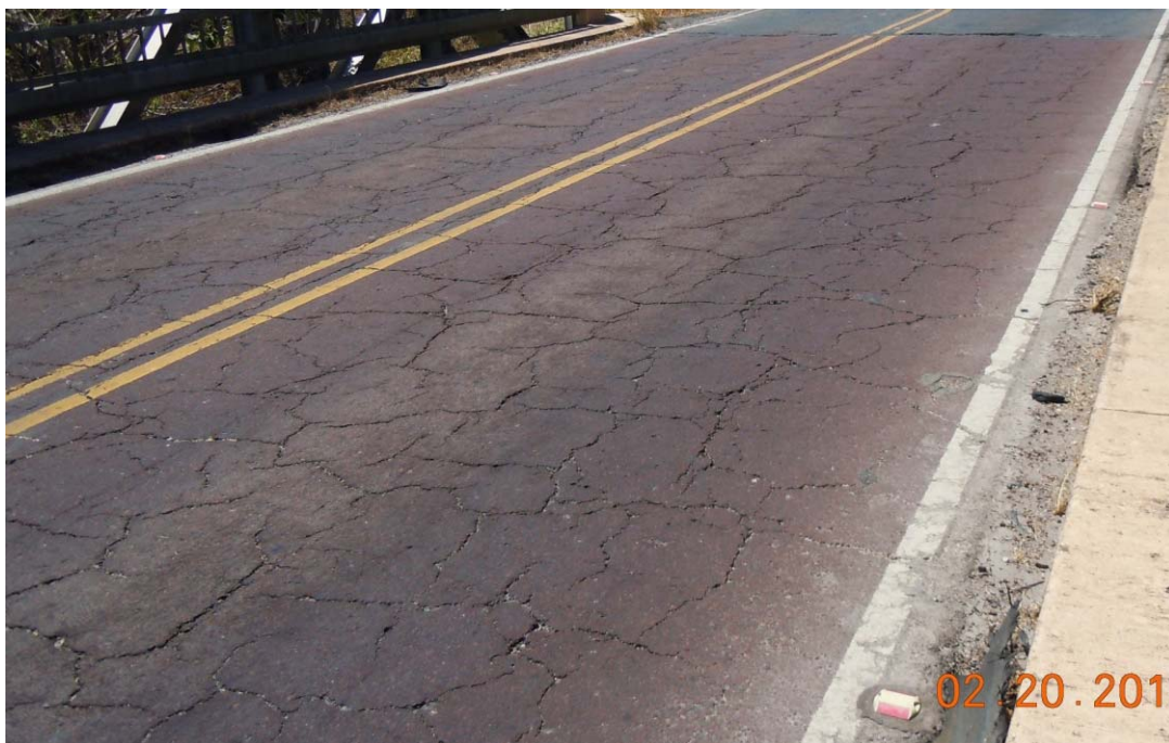
Figura 9: Demarcación horizontal regular, pérdida total de captaluces en la línea centro y agrietamiento en red de la superficie de rodamiento.
