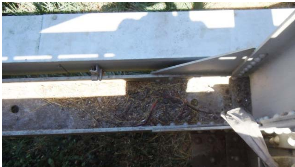
Figura 15: Acumulación de sedimentos, basura y maleza en la cuerda inferior de las armaduras de acero.
