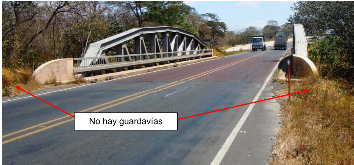
Figura 7: Faltante de guardavías y sistema de drenaje en ambos accesos, caso del sector oeste.
