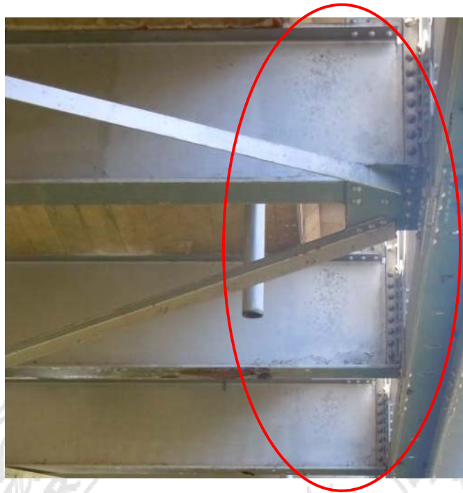
Figura 17: Deterioro de sistema de pintura así como zonas puntuales de corrosión en extremos de vigas transversales.
