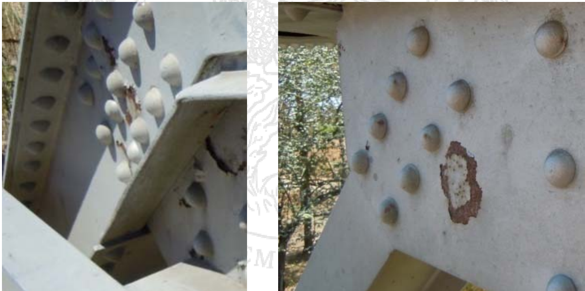
Figura 18: Zonas puntuales de corrosión en placas de acero de conexiones.
