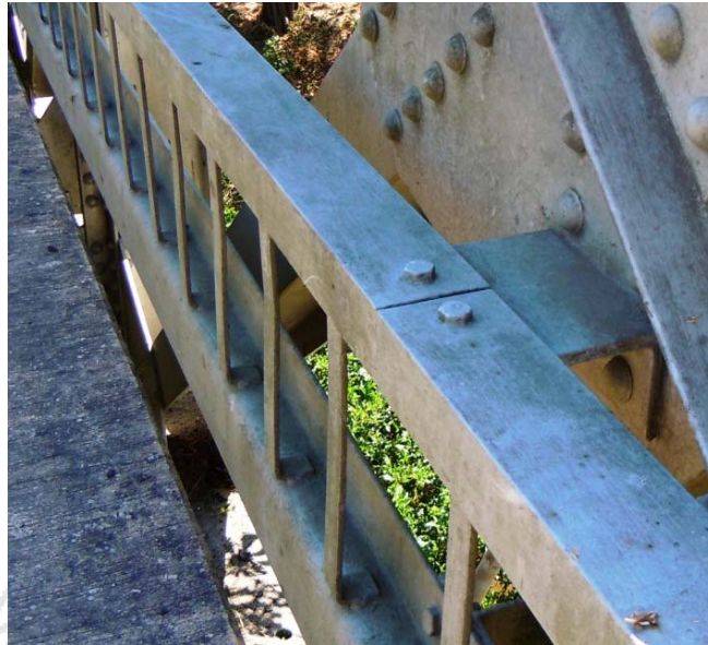
Figura 5: Barrera de acero diseñada de acuerdo con AASHO 1949 que no cumple con los requerimientos de una tipo TL-4 según AASHTO LRFD 2012.
