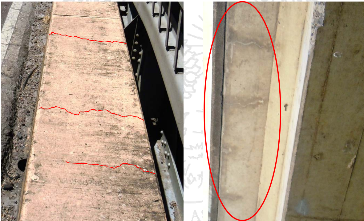
Figura 8: Agrietamiento transversal del bordillo de seguridad, sentido Bagaces-Libera.
