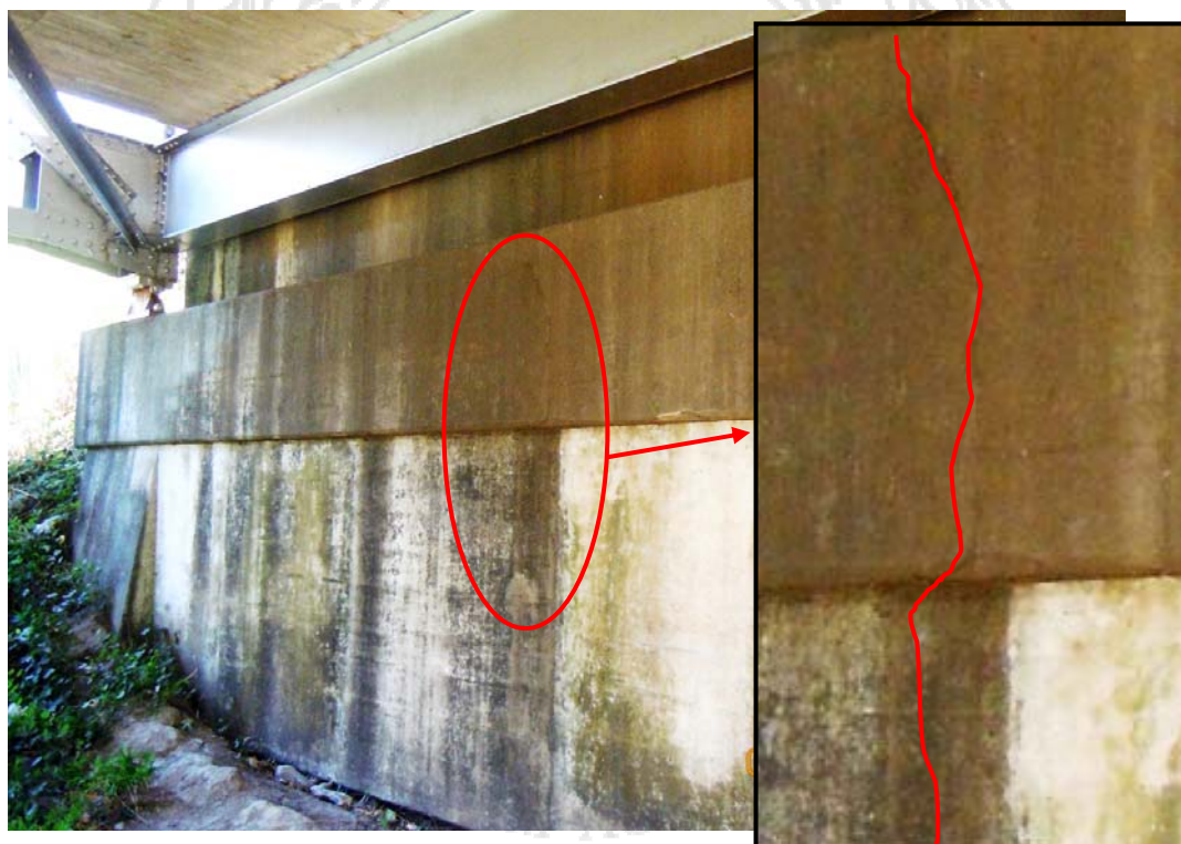
Figura 20: Agrietamiento de la viga cabezal y del cuerpo principal del Bastión 1 así como manchas por humedad.
