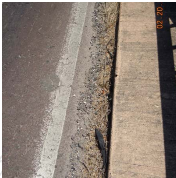
Figura 11: Acumulación de sedimentos y maleza en los bordillos de seguridad.
