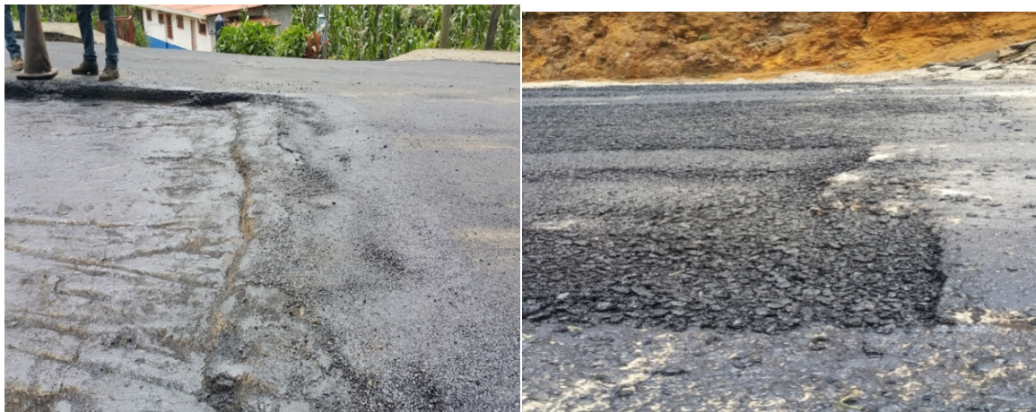
Fotografía 3. Falta de corte en juntas transversales. Las juntas se preparan con el uso de "back hoe".
