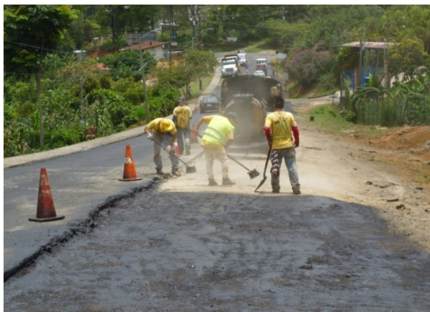
Fotografía 2. Barrido de superficie con material granular suelto, donde se colocó el riego de liga. Ubicación: Sobre la Ruta 226, km 1+800 desde el cruce con la Ruta Nacional 313, Sección de control 10151 Límite Cantonal León Cortés/Tarrazú - San Pablo de León Cortés. Fecha 25 de agosto de 2015. Fuente: LanammeUCR.
