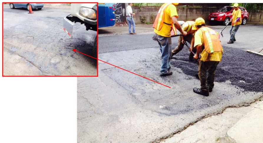
Fotografía 8. Riego de liga deficiente para colocación de capa con espesor reducido.
