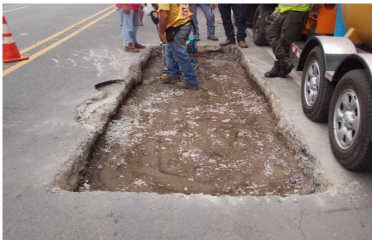
Fotografía 14. Bache de espesor de 20 cm, juntas longitudinales sin la preparación de cortes. Se observa la compactación del material granular con la plancha vibratoria antes de la colocación de mezcla asfáltica. Ubicación: Sobre la Ruta 34, km 0+800 desde inicio sección de control en La Julieta, Sección de control 60120: La Julieta- Límite cantonal Parrita-Quepos, Fecha 1 de setiembre de 2015. Fuente: LanammeUCR.
