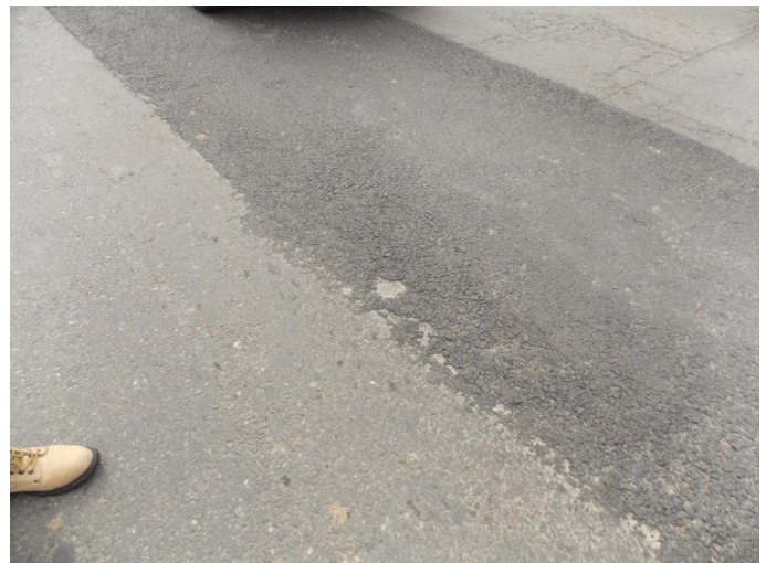
Fotografía 11. Desprendimiento de agregado en capa asfáltica colocada. Ubicación: sobre ruta de travesía 11501, 75 m Este del Super Tacho, Sección de control 19777, Fuentes de Montes de Oca (R 203)- San Pedro de Montes de Oca(R.2), Fecha 6 de octubre de 2015. Fuente LanammeUCR
