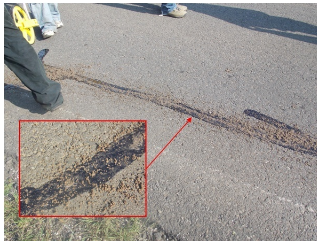
Fotografía 23. Insuficiente cobertura del sello con arena húmeda como material de secado.
