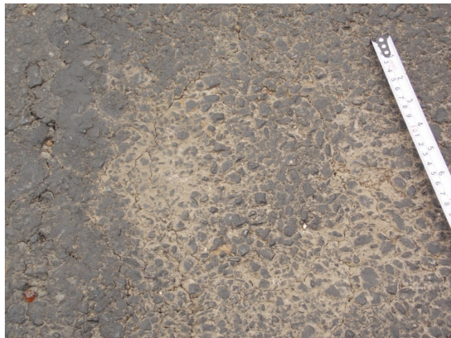
Fotografía 13. Agrietamientos en mezclas asfáltica colocada. Ubicación: sobre ruta de travesía 11501, 50 m Este del Super Tacho, Sección de control 19777, Fuentes de Montes de Oca (R 203)- San Pedro de Montes de Oca(R.2), Fecha 6 de octubre de 2015. Fuente LanammeUCR
