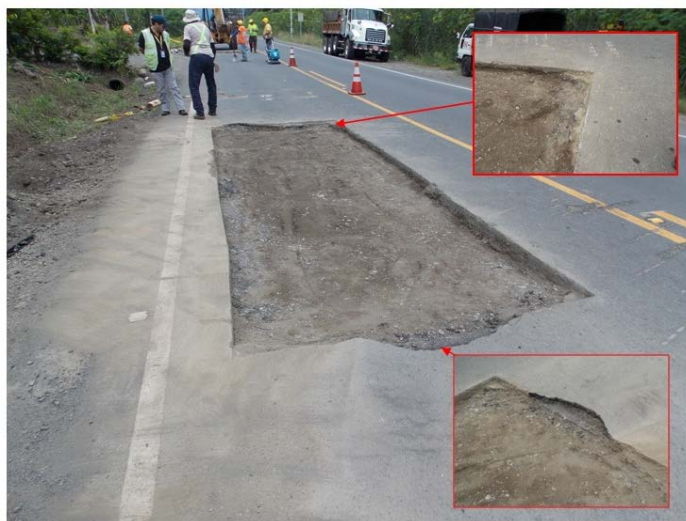
Fotografía 16. Bordes irregulares en juntas transversales y material sin remover en esquinas del bache. Ubicación: Sobre la Ruta 34, km 0+850 desde inicio sección de control La Julieta, Sección de control 60120: La Julieta- Límite cantonal Parrita-Quepos, Fecha 1 de setiembre de 2015. Fuente: LanammeUCR
