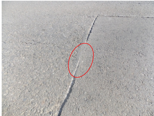
Fotografía 22. Corte incompleto para colocación de emulsión asfáltica.
