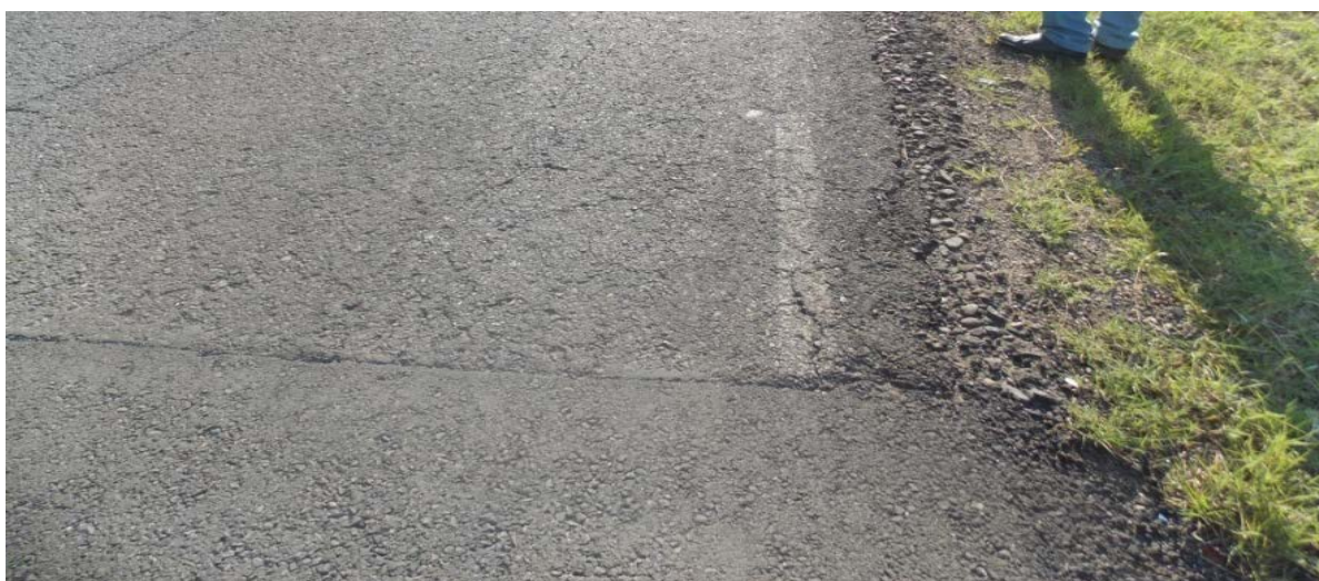
Fotografía 24. Agrietamiento longitudinal y junta de bache abierta sin atender.
