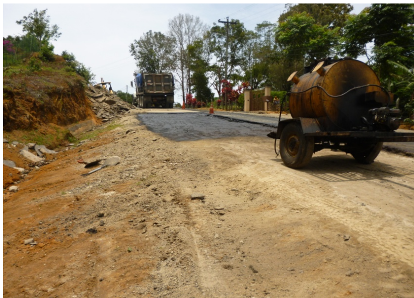
Fotografía 1. Colocación de riego de liga sobre superficie con material granular suelto. Ubicación: Sobre la Ruta 226, km 1+800 desde el cruce con la Ruta Nacional 313, Sección de control 10151 Límite Cantonal León Cortés/Tarrazú - San Pablo de León Cortés. Fecha 25 de agosto de 2015. Fuente: LanammeUCR.
