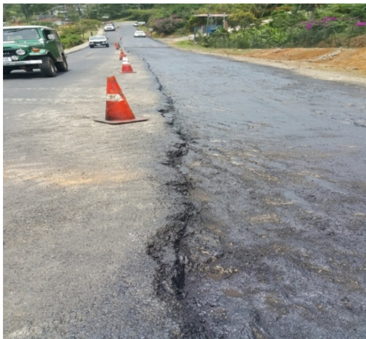
Fotografía 4. Condición de junta longitudinal donde se construyó el bache. La mezcla de la izquierda fue colocada días atrás y no se ha concluido en su espesor total al momento de la visita.
