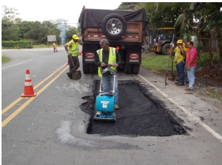
Fotografía 15. Compactación de capas con espesores aproximados de 7 cm mediante plancha vibratoria de bajo peso. Ubicación: Sobre la Ruta 34, km 0+800 desde inicio sección de control La Julieta, Sección de control 60120: La Julieta- Límite cantonal Parrita-Quepos, Fecha 1 de setiembre de 2015. Fuente: LanammeUCR
