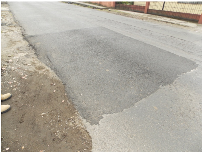
Fotografía 10. Deformación en capa de espesor delgado. Ubicación: sobre ruta de travesía 11501, 100 m Este del Super Tacho, Sección de control 19777, Fuentes de Montes de Oca (R 203)- San Pedro de Montes de Oca(R.2), Fecha 6 de octubre de 2015. Fuente LanammeUCR
