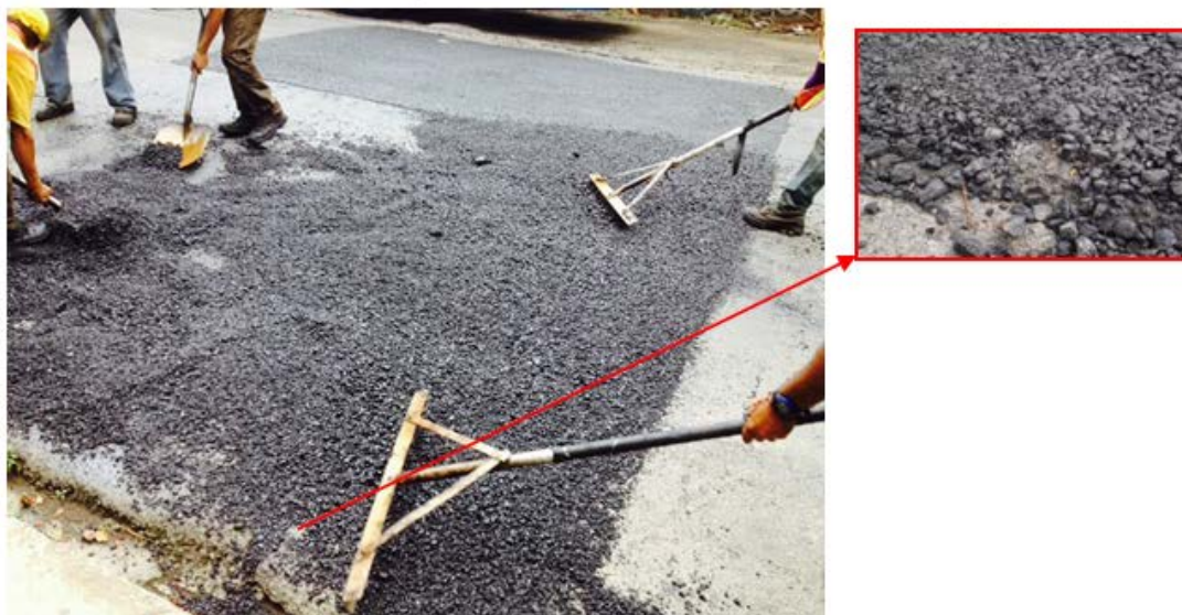
Fotografía 9. La capa de espesor reducido se desprende con facilidad en los bordes y esquinas del bache.
