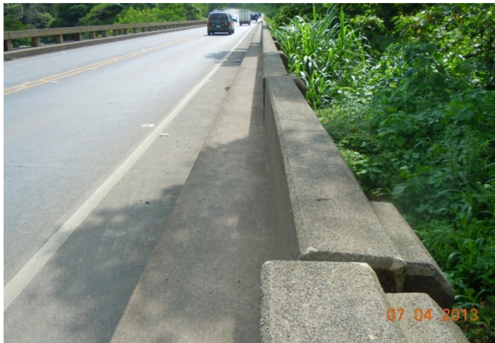
Figura 2: Desalineación de la barrera vehicular noroeste cerca del acceso 2 producto del impacto vehicular que ha provocado desprendimientos de concreto alrededor de los postes de la barrera.
