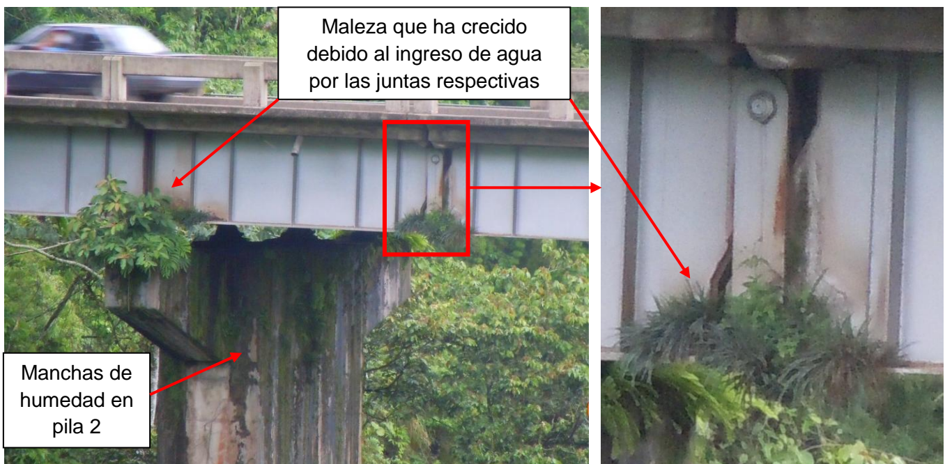
Figura 22: Maleza en apoyo tipo pin-enlace y sobre la pila 2, corrosión en vigas principales y manchas de humedad en pila 2.
