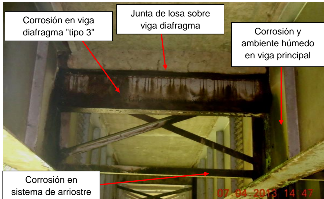
Figura 15: Corrosión en viga diafragma, vigas principales y sistema de arriostramiento en la producto del ingreso de agua a través de la junta de expansión de la losa ubicada sobre las vigas diafragma "tipo 3" (típico).
