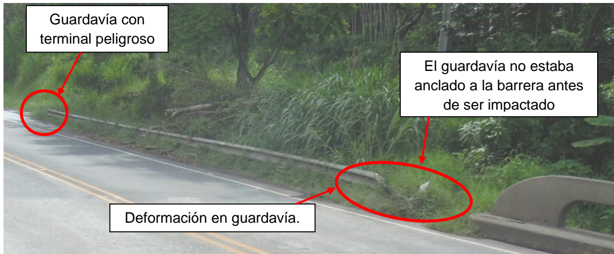
Figura 3: Guardavías noroeste del acceso 1 deformado. Detalle típico de ausencia de anclaje a la barrera vehicular, extremo con terminal peligroso y maleza alrededor del guardavía.
