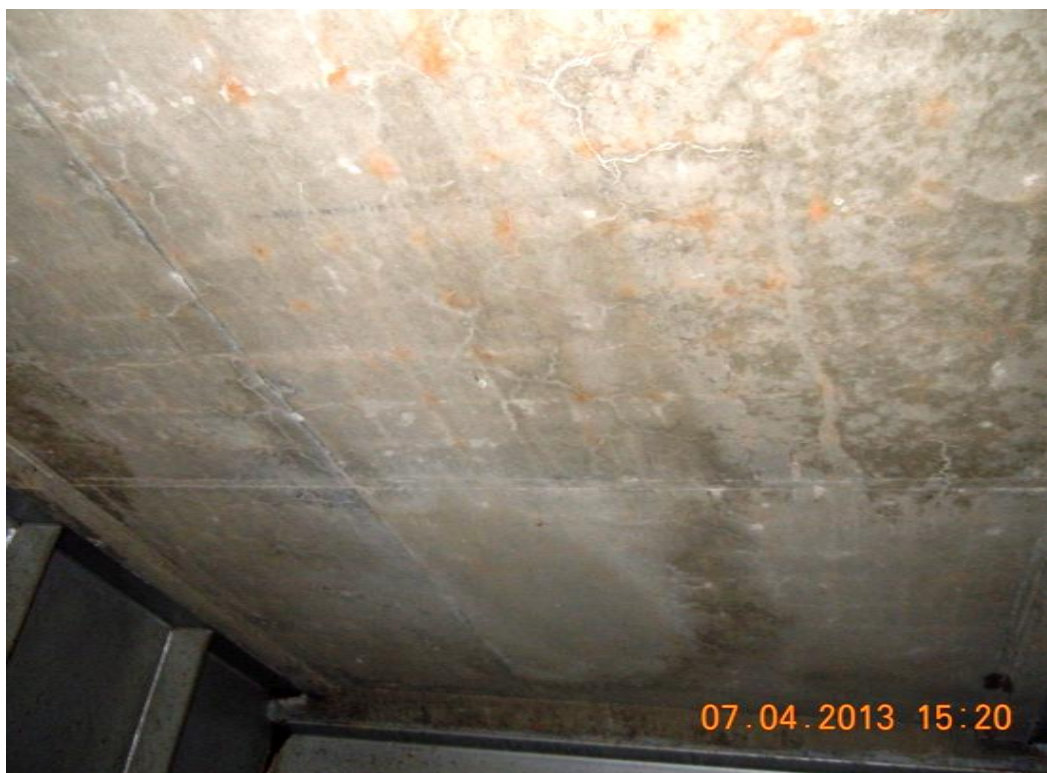
Figura 14: Agrietamiento en dos direcciones, eflorescencia y manchas que indican corrosión del acero de refuerzo de la losa de la superestructura 3.
