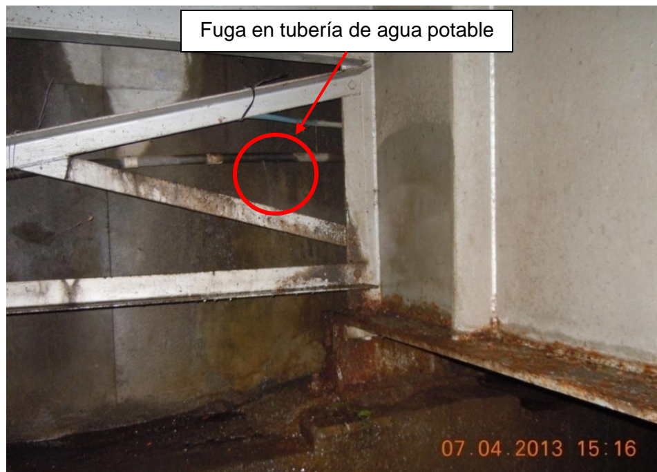
Figura 16: Corrosión en viga principal, arriostres y apoyos sobre el bastión 2 producto de la fuga de agua de una tubería.
