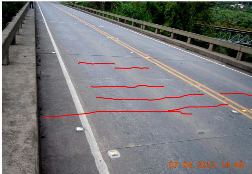
Figura 11: Grietas perpendiculares a la dirección del tránsito en la losa (típico).
