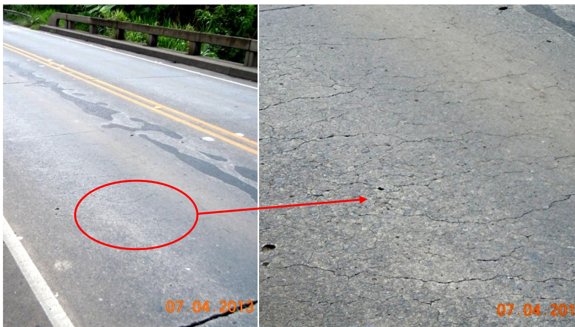
Figura 12: Grietas en dos direcciones en la losa del la sección en voladizo de la superestructura 1 del puente.
