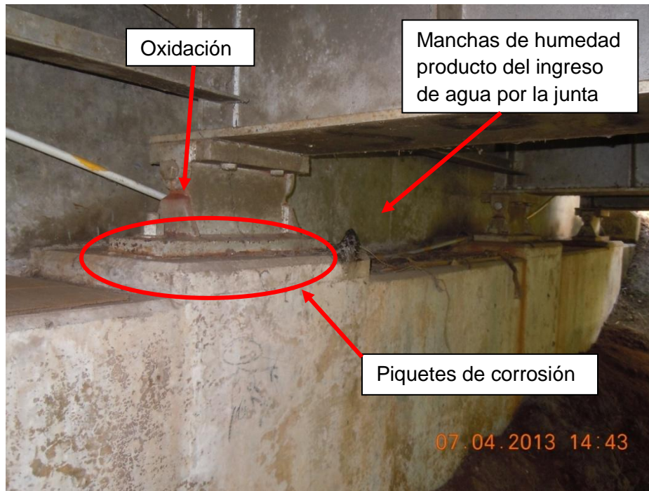
Figura 19: Oxidación y piquetes de corrosión en apoyos sobre el bastión 1.
