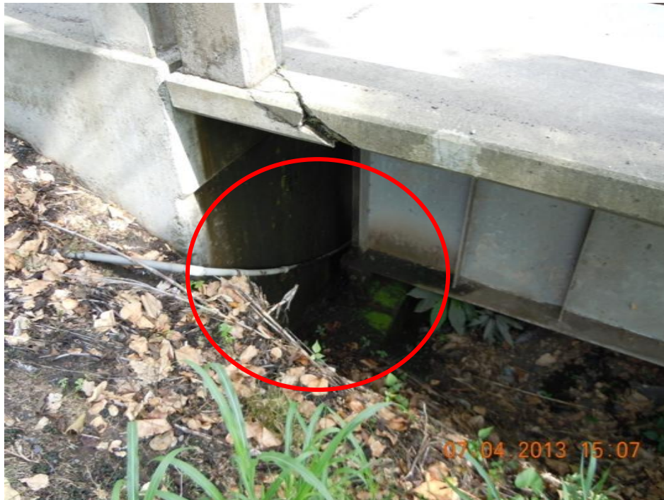
Figura 21: Ambiente húmedo y corrosión del apoyo sureste sobre el bastión 2 producto de la descarga de agua debido a la ausencia de un sistema de drenaje en los accesos (típico)
