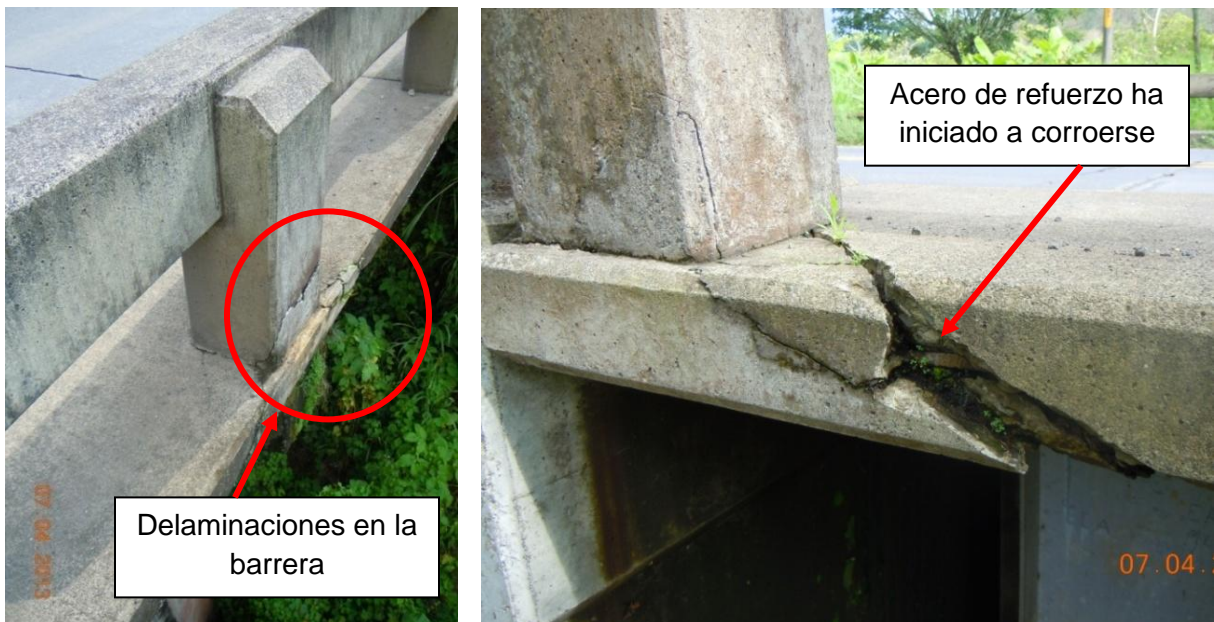
Figura 1: Agrietamiento, desprendimientos de concreto y delaminaciones con vegetación, y corrosión del acero de refuerzo en varios puntos de la barrera vehicular (típico).
