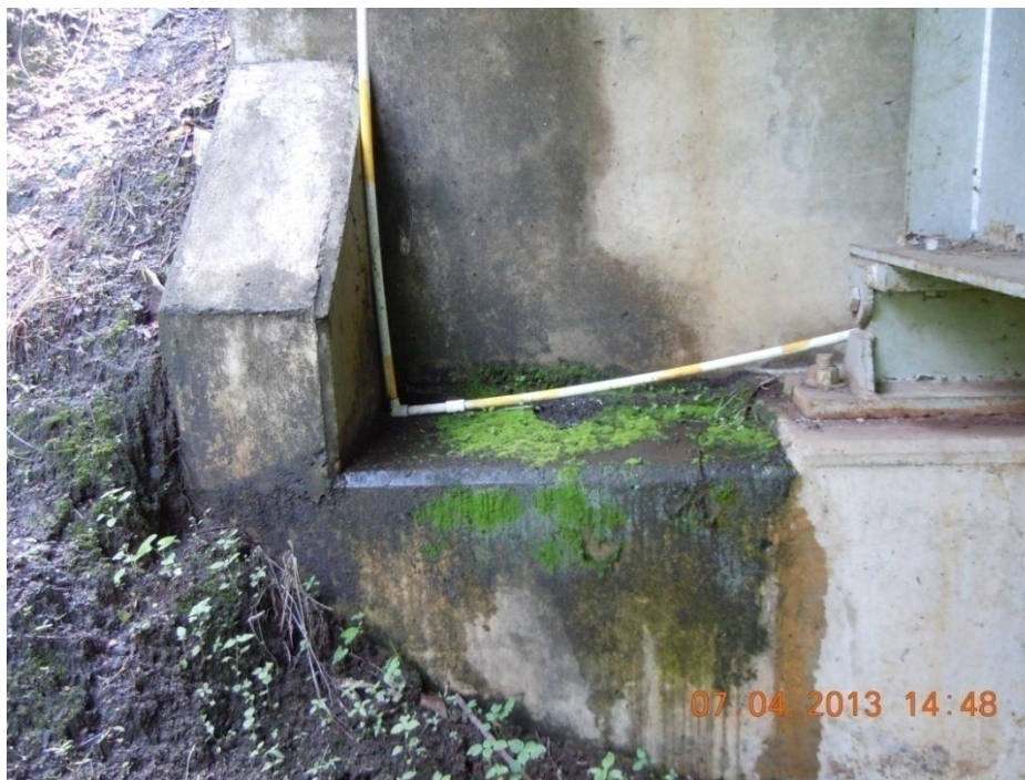
Figura 20: Ambiente húmedo cerca de los apoyos externos sobre el bastión 1 producto de una fuga de agua en la tubería que pasa entre el bastión y las vigas principales (típico).
