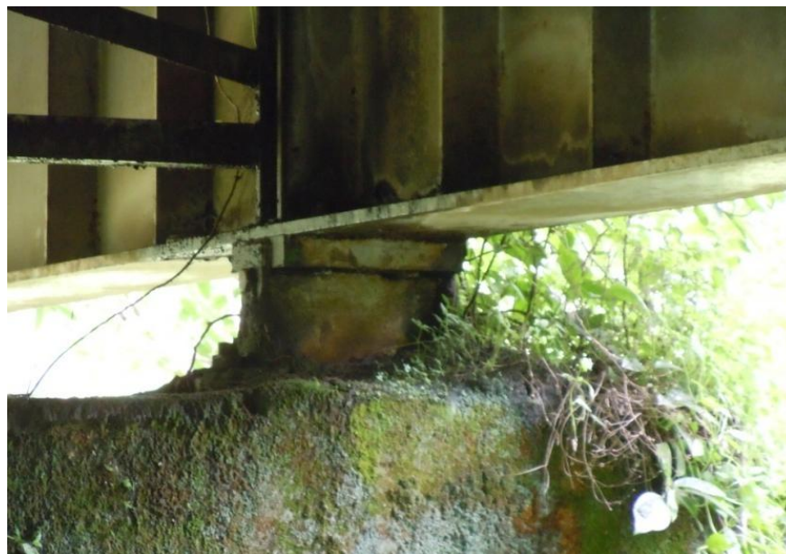
Figura 18: Detalle típico de corrosión en apoyo sobre la pilas y maleza que ha crecido producto del agua que ingresa por la junta de expansión de la losa ubicada sobre ambas pilas (vista de la pila 1).
