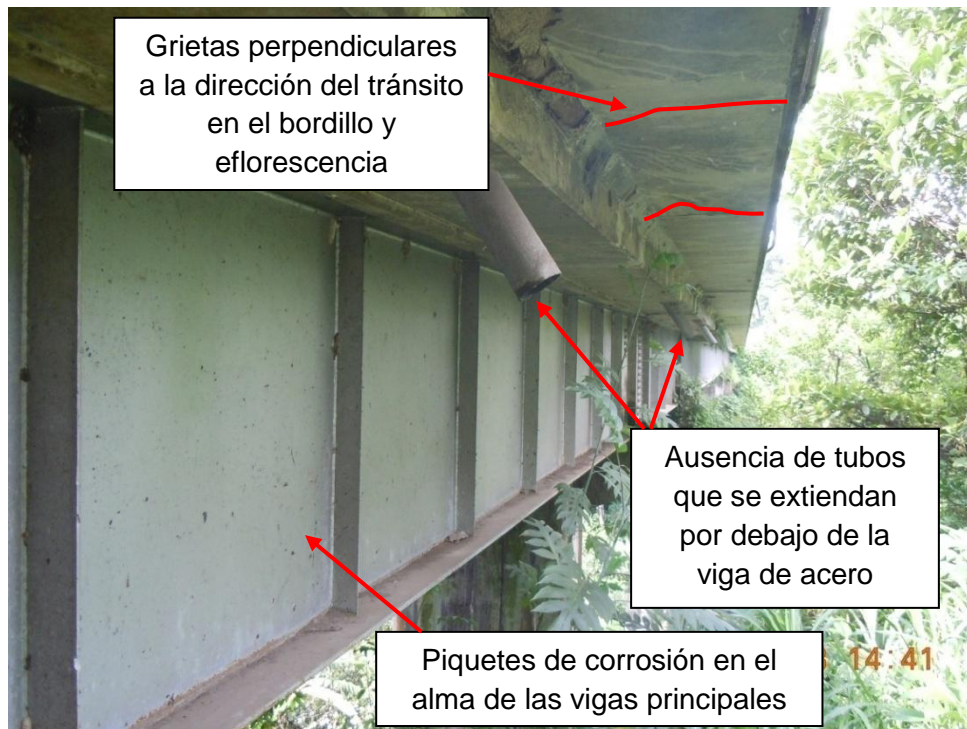
Figura 6: Eflorescencia y agrietamiento en la parte inferior del bordillo sureste (típico), ausencia de tubos de extensión en desagües y piquetes de corrosión en vigas principales.
