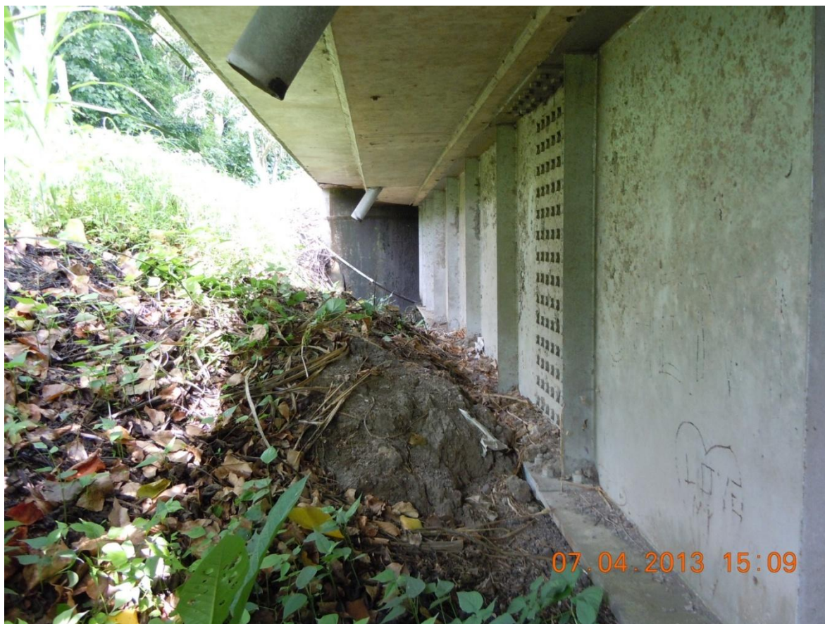
Figura 10: Terreno en contacto directo con el ala inferior de la viga principal externa noroeste cerca del bastión 2 y ausencia de sistema de drenaje en acceso 2.
