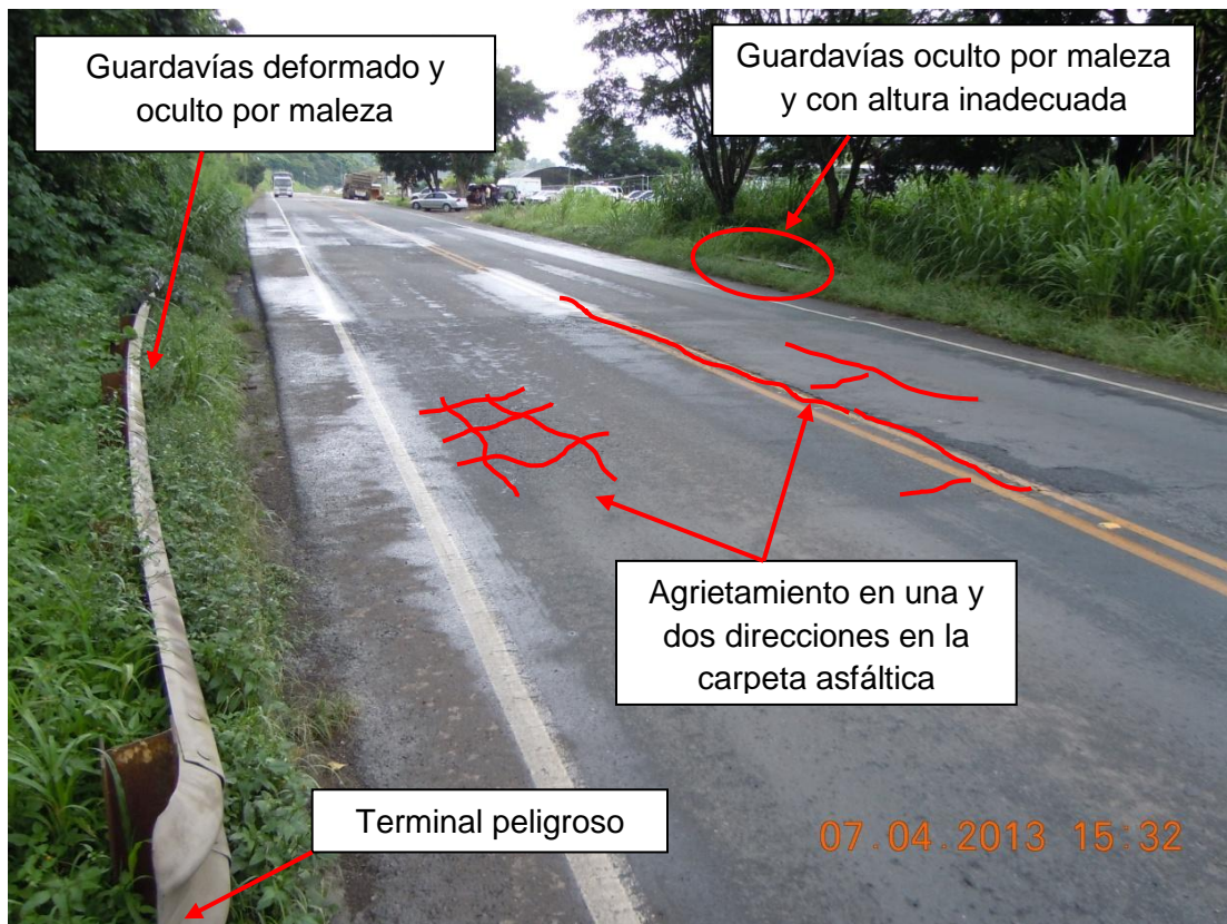
Figura 4: Acceso 2: Agrietamiento en una y dos direcciones en la carpeta asfáltica, guardavías con curvatura sin captaluces, con altura inadecuada, ocultos por maleza y con terminales peligrosos y sin anclar a la barrera vehicular.
