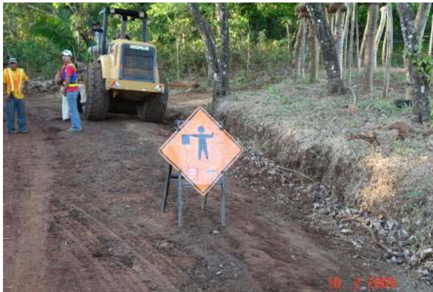
Fotografía No. 10: Señalización deficiente de control de obra. Ruta Nacional No. 901 sección de control 50671. Fecha de la fotografía 10 de febrero del 2009.
