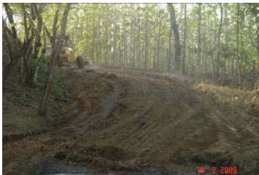
Fotografía No. 7: Conformación del camino en una sección curva sin control de niveles. Ruta Nacional No. 901 sección de control 50671. Fecha de la fotografía 10 de febrero del 2009.
