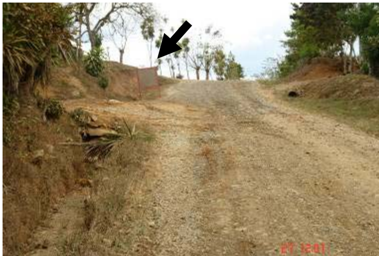
Fotografía No. 12: Señalización deficiente de control de obra. Ruta No.329, sección de control 10852. Fecha de la fotografía 27 de febrero del 2009.
