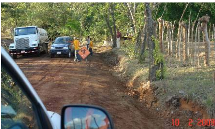
Fotografía No. 9: Señalización deficiente de control de obra. Ruta Nacional No. 901 sección de control 50671. Fecha de la fotografía 10 de febrero del 2009.
