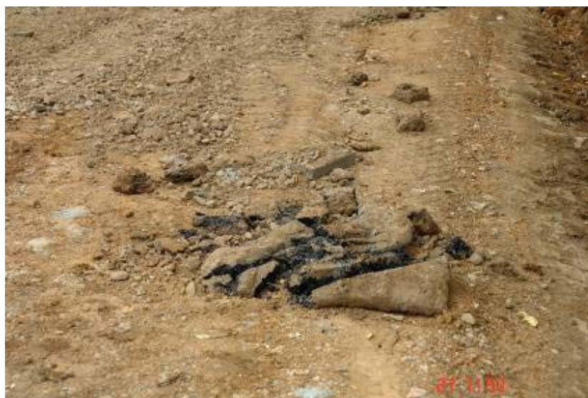
Fotografía No. 2: Fragmentos de concreto asfáltico a un lado del camino. Ruta No.329, sección de control 10852. Fecha de la fotografía 27 de febrero del 2009.
