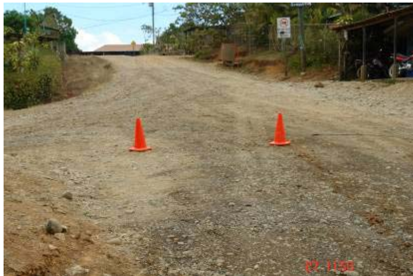
Fotografía No. 11: Señalización deficiente de control de obra. Ruta No.329, sección de control 10852. Fecha de la fotografía 27 de febrero del 2009.
