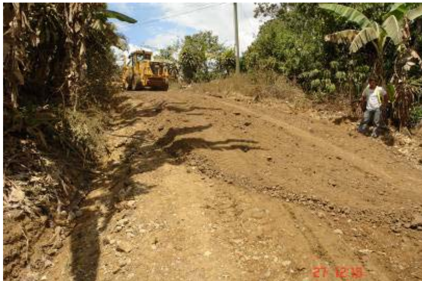
Fotografía No. 8: Conformación del camino en una sección curva sin control de niveles. Ruta No.329, sección de control 10852. Fecha de la fotografía 27 de febrero del 2009.
