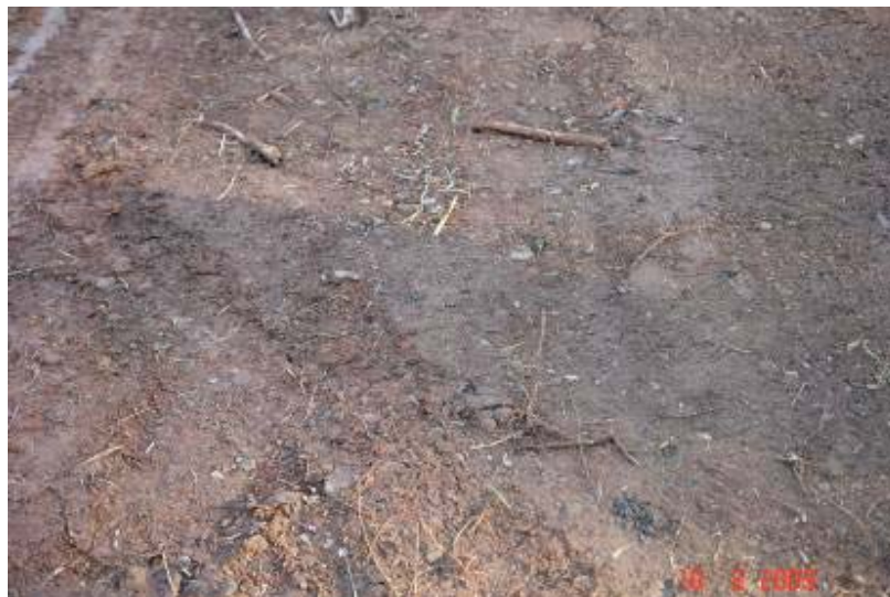
Fotografía No. 6: Material compactado contaminado con material vegetal. Ruta Nacional No. 901 sección de control 50671. Fecha de la fotografía 10 de febrero del 2009.
