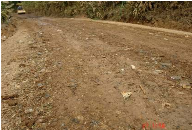
Fotografía No. 3: Material compactado contaminado con basura. Ruta No.329, sección de control 10852. Fecha de la fotografía 27 de febrero del 2009.
