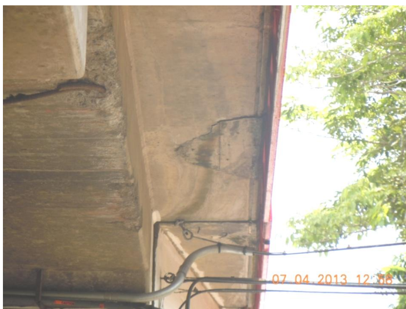
Figura 20: Delaminación del concreto en la superficie inferior de la losa bajo la barrera del costado sureste.
