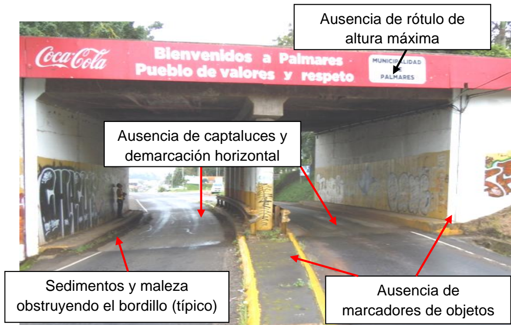
Figura 5: Obstrucción del bordillo con sedimentos y maleza, ausencia de captaluces, demarcación horizontal, marcadores de objetos y rótulo de altura máxima en la Ruta No. 135 bajo el paso a desnivel.
