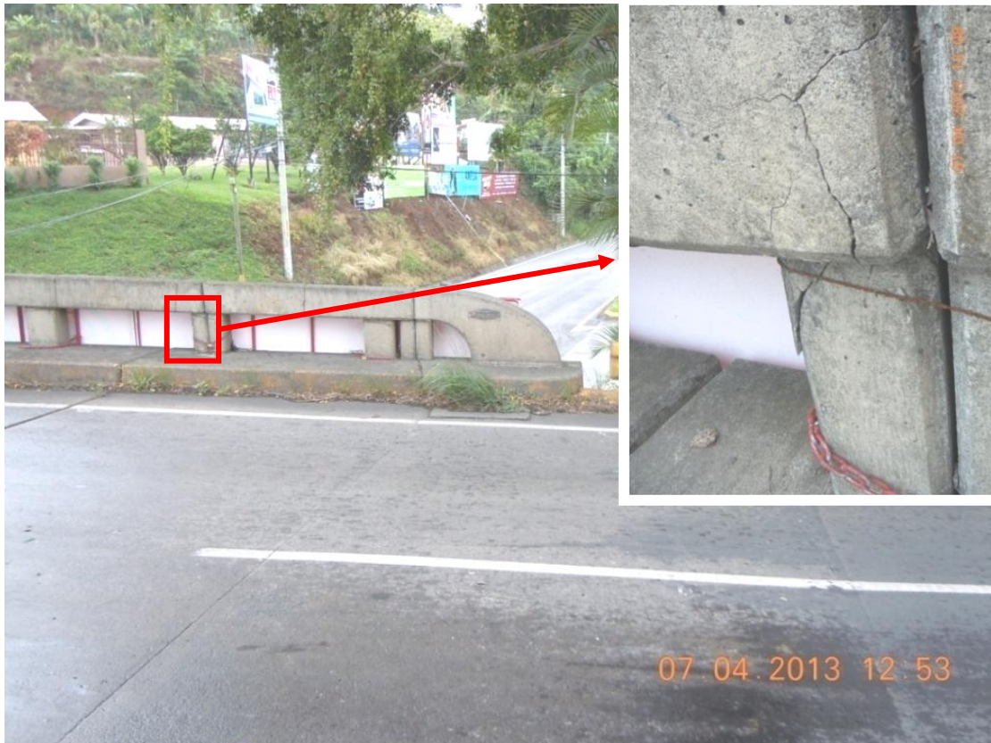
Figura 1: Grietas en la barrera noroeste producto de impactos vehiculares.
