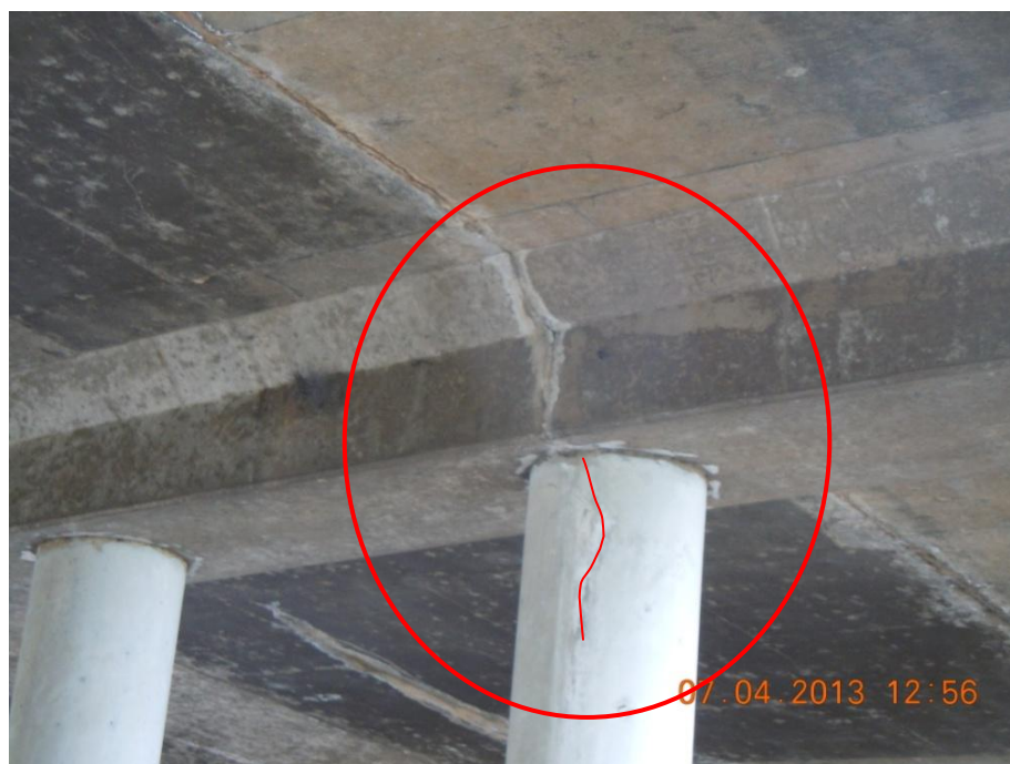
Figura 18: Grietas verticales en la viga cabezal y en la parte superior de una de las columnas de la pila producto del movimiento de las juntas de construcción de la losa paralelas a la dirección del tránsito.
