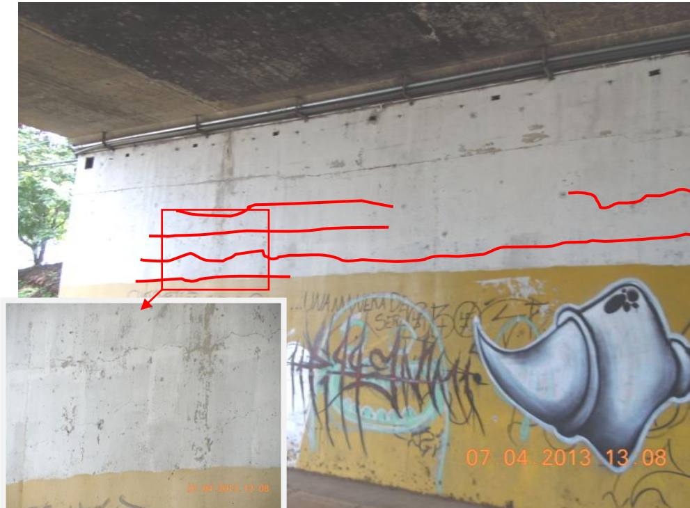
Figura 21: Grietas horizontales por flexión en el cuerpo del bastión 2 (típico).
