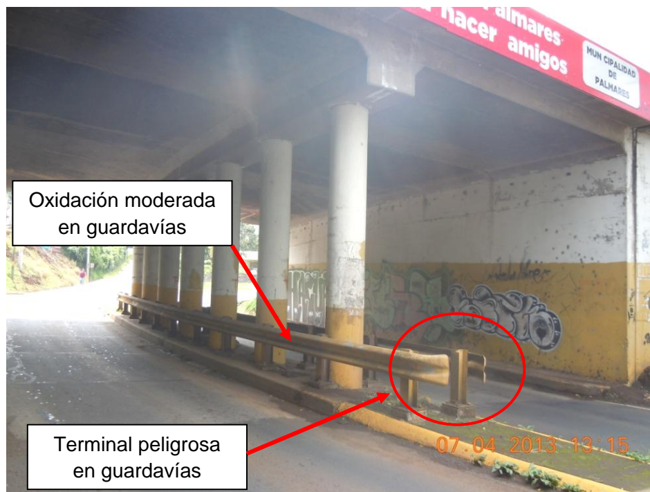
Figura 4: Guardavías colocados para proteger las pilas con oxidación moderada y terminales peligrosos.
