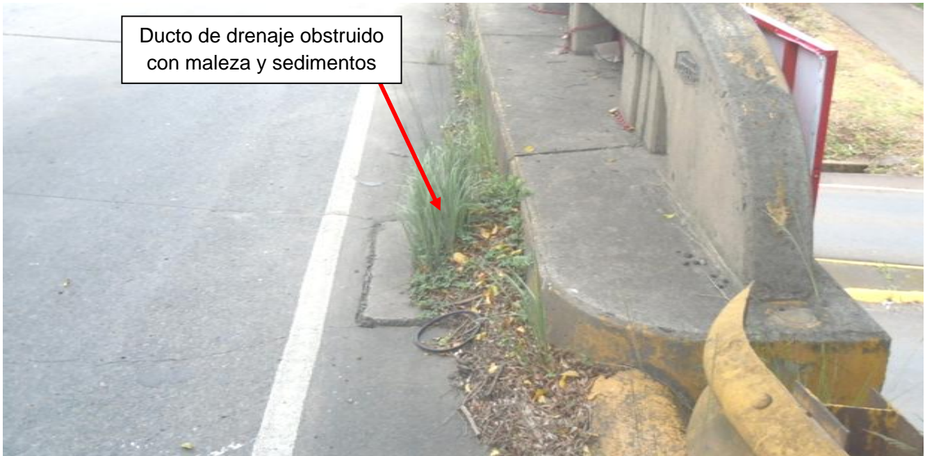
Figura 7: Ducto de desagüe en el acceso 2 obstruido por maleza y sedimentos (típico)
