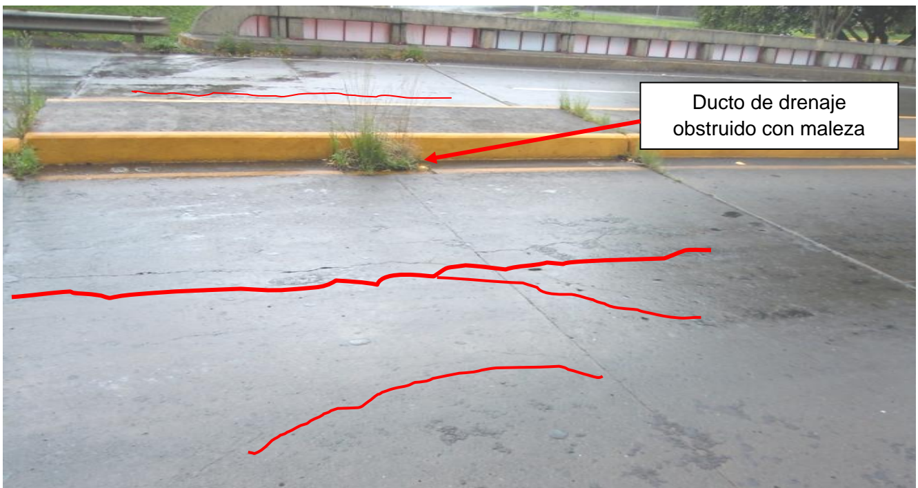
Figura 8: Ducto de drenaje obstruido con maleza y grietas paralelas a la dirección del tránsito en losa de aproximación del acceso 2.
