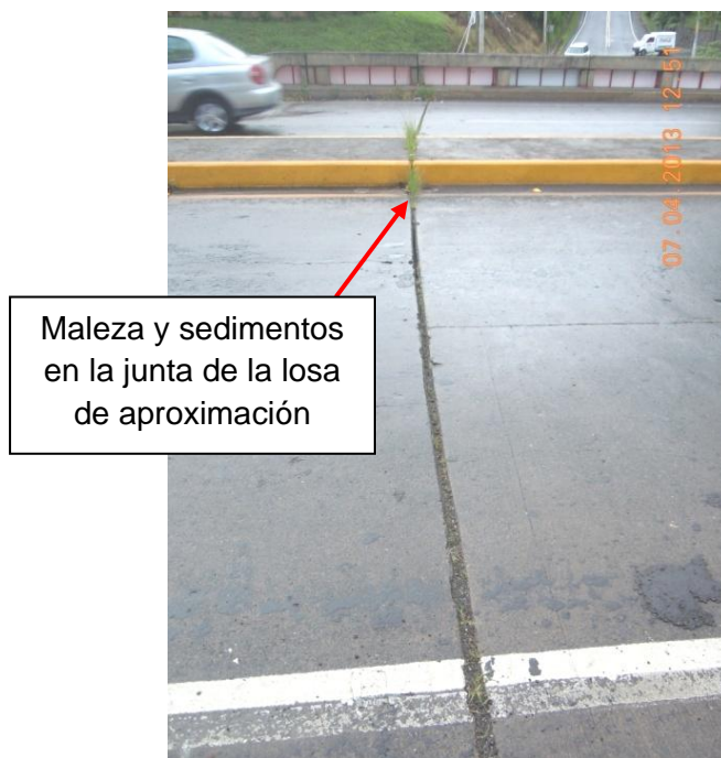
Figura 10: Maleza y sedimentos dentro de la junta entre la losa de aproximación y la losa del puente.
