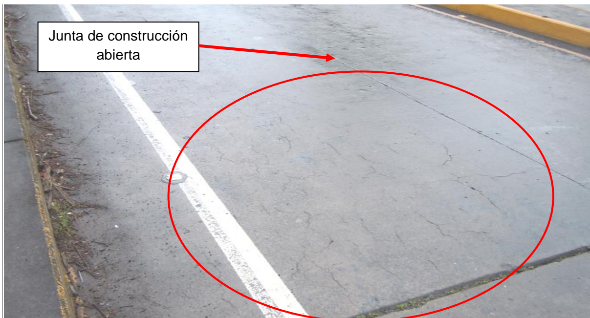
Figura 14: Grietas en dos direcciones típicas en la losa en la calzada sureste.
