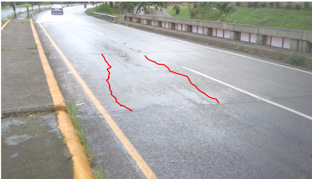
Figura 9: Grietas paralelas a la dirección del tránsito en losa de aproximación del acceso 1.
