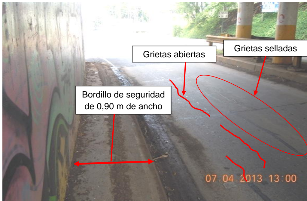
Figura 11: Grietas selladas y grietas abiertas paralelas a la dirección del tránsito en la superficie de rodamiento del paso a desnivel en la Ruta 135.
