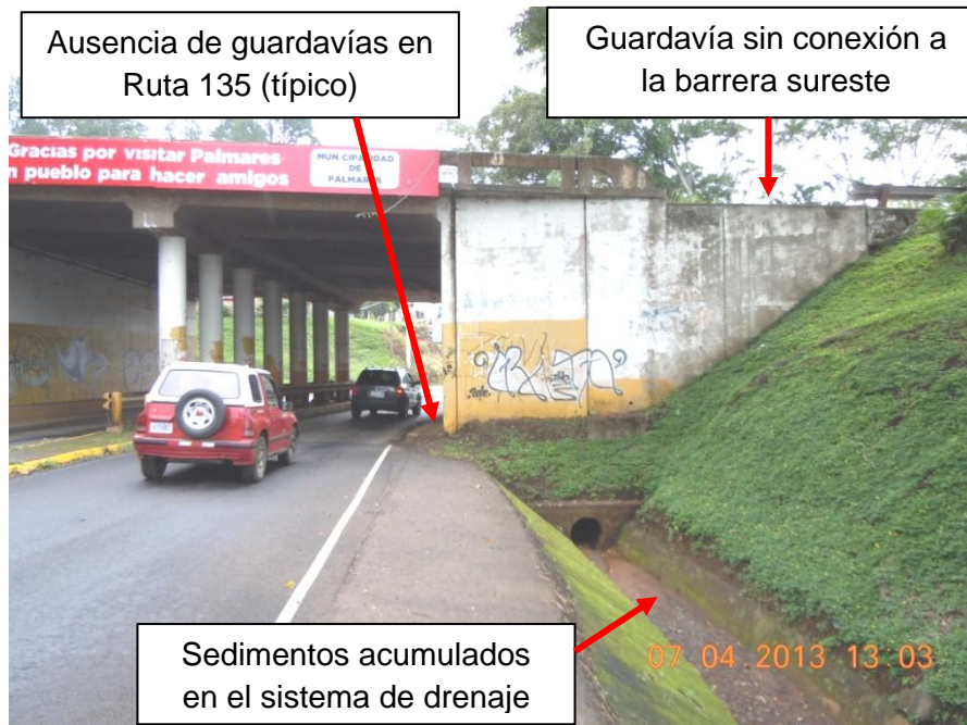
Figura 6: Ausencia de guardavías en acceso de la Ruta 135 al paso a desnivel, guardavía sin conexión a la barrera sureste y sedimentos acumulados en sistema de drenaje del acceso sureste al paso a desnivel en la Ruta No. 135.
