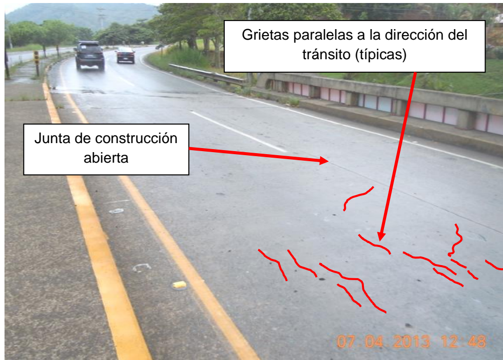
Figura 13: Grietas longitudinales típicas en la losa en la calzada noroeste.
