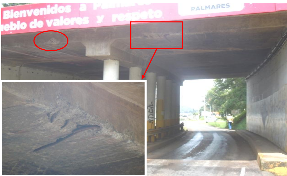
Figura 12: Desprendimientos de concreto con acero descubierto producto de impactos por parte de vehículos.
