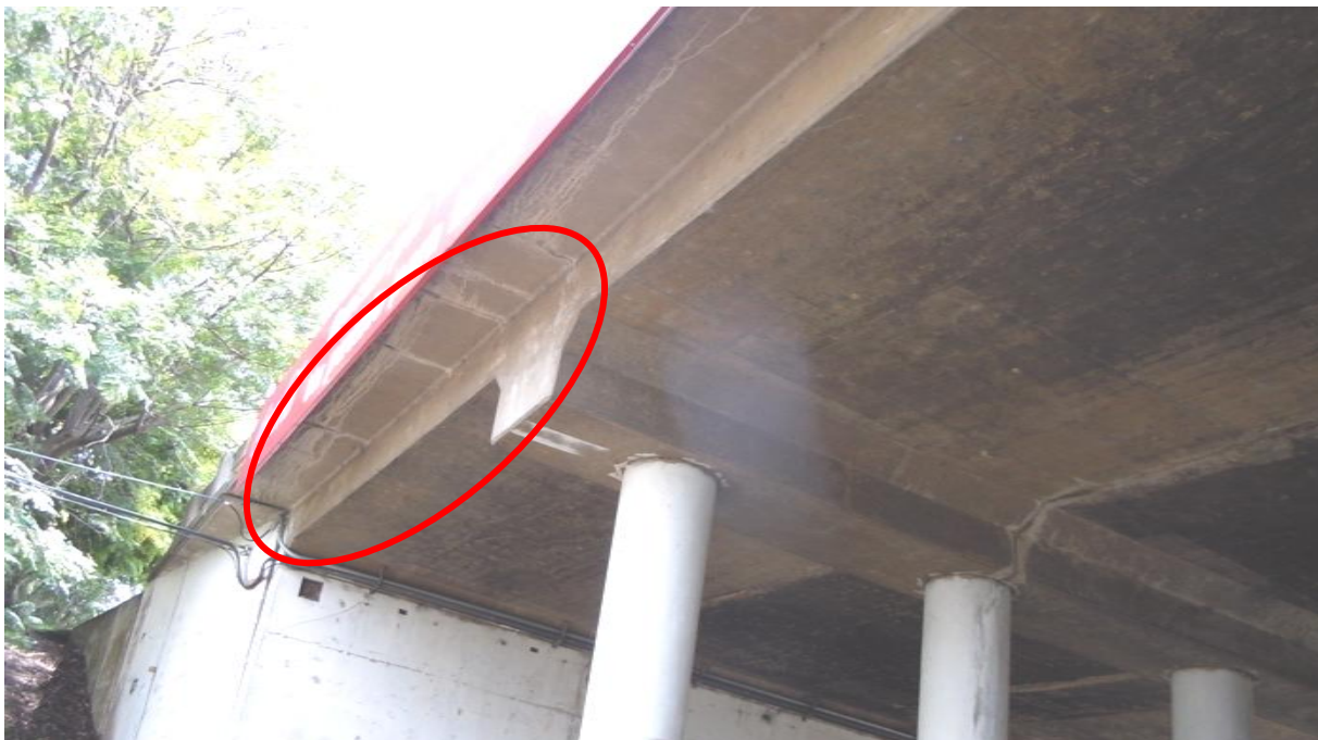
Figura 19: Grietas perpendiculares a la dirección del tránsito con eflorescencia producto de retracción del concreto en la superficie inferior de la losa justo bajo la barrera sureste.
