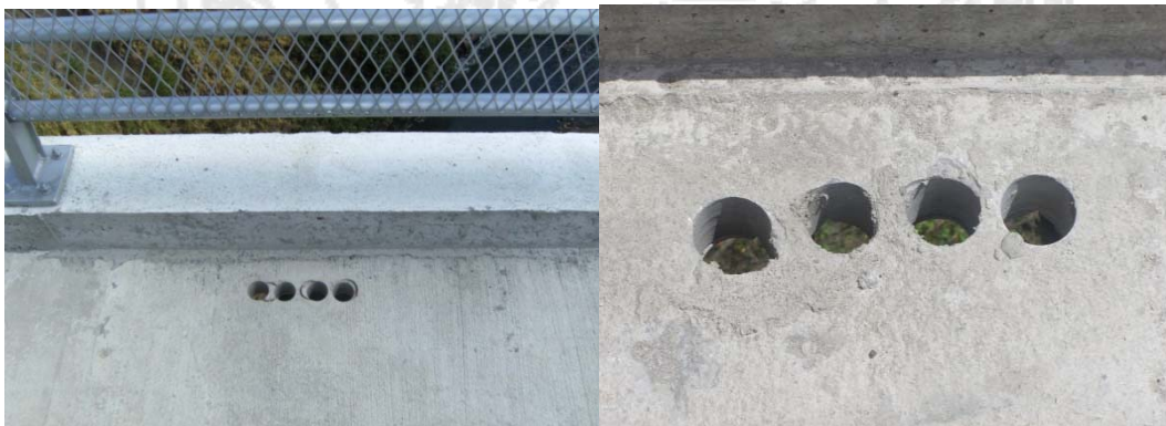
Fotografía 18. Drenajes construidos en el tablero del puente del lado de la acera peatonal.
