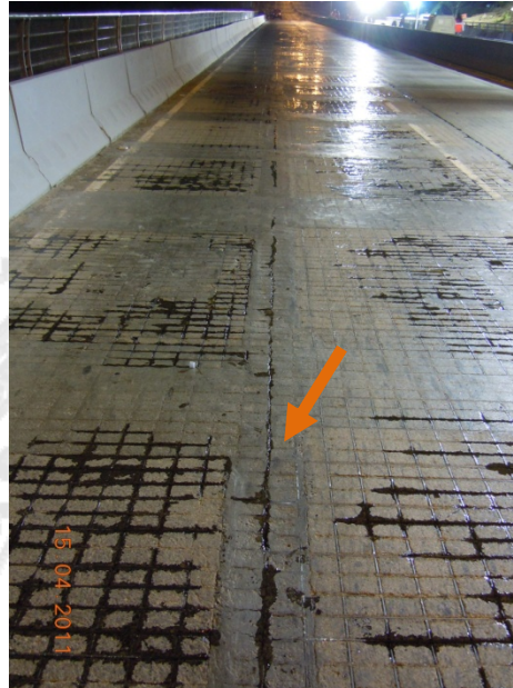
Fotografía 16. Separación formada en la unión de paneles tipo A y B. Fuente: LanammeUCR
