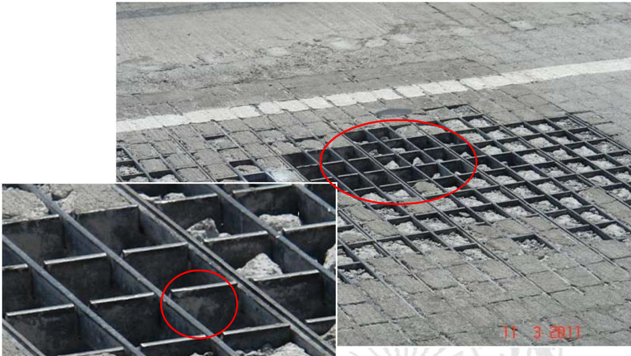
Fotografía 5. Adherencia insuficiente del concreto a las paredes de la rejilla de acero.
