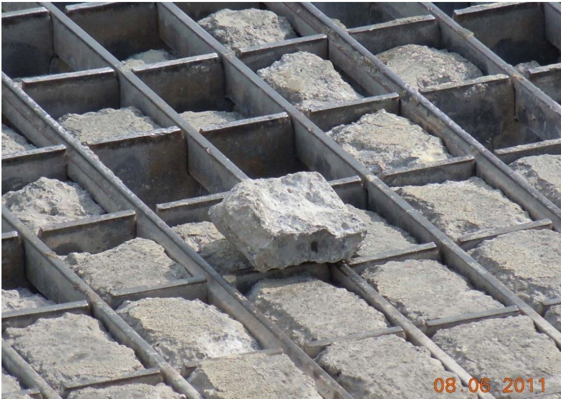
Fotografía 3. Desprendimiento del concreto en el sistema de la rejilla mixta
