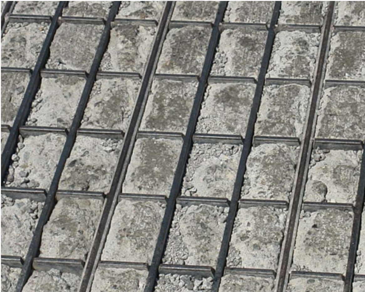
Fotografía 2. Desprendimiento del concreto en la rejilla mixta Fuente: LanammeUCR
