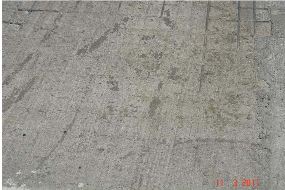
Fotografía 4. Acero expuesto por desgaste de pasta, no se ve evidencia de desgaste significativo por abrasión de la superficie de concreto. Fuente: LanammeUCR.
