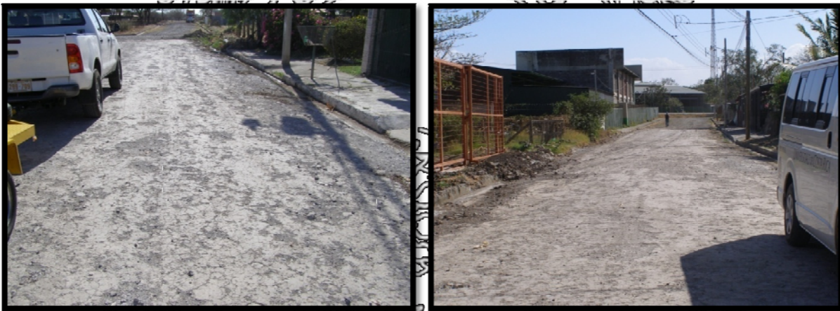
(a) (b) Imagen 11. Condición superficial del tramo, dos meses después (marzo 2012)
