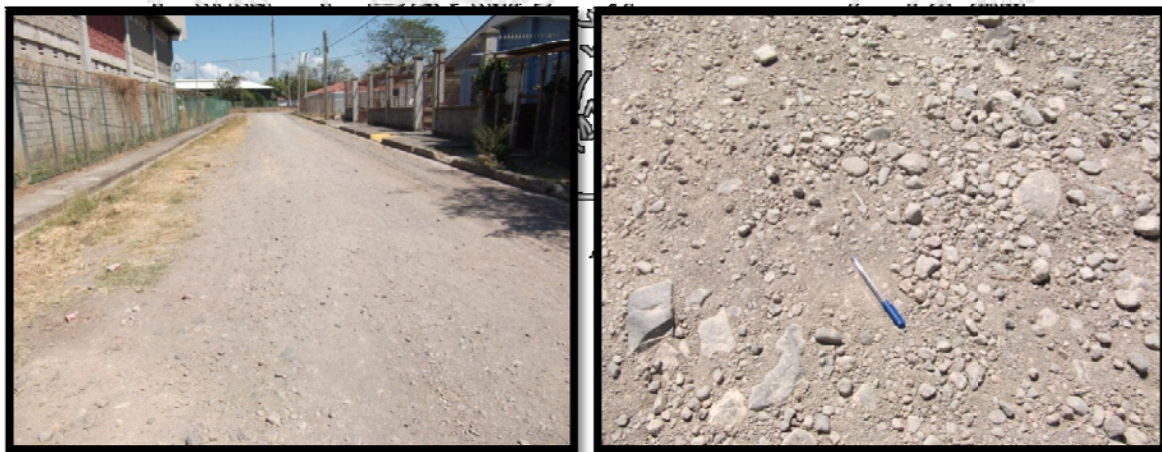
Imagen 15. Condición superficial del tramo, doce meses después (enero 2013)
