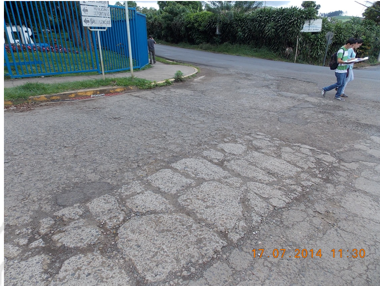
Figura 2. Malas condiciones en general de la calle de acceso
