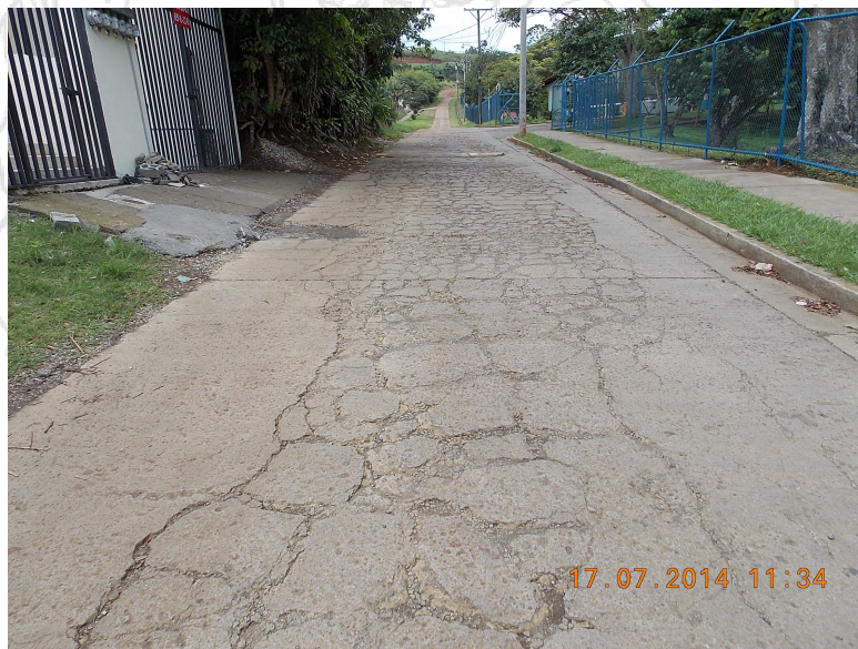
Figura 3. Agrietamientos del tipo cuero de lagarto en gran área del acceso
