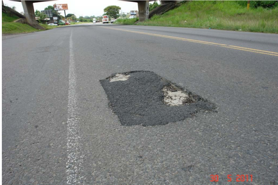
Figura 28. Kilómetro 1+600. Desprendimientos en la cobertura asfáltica colocada. Carril izquierdo.
