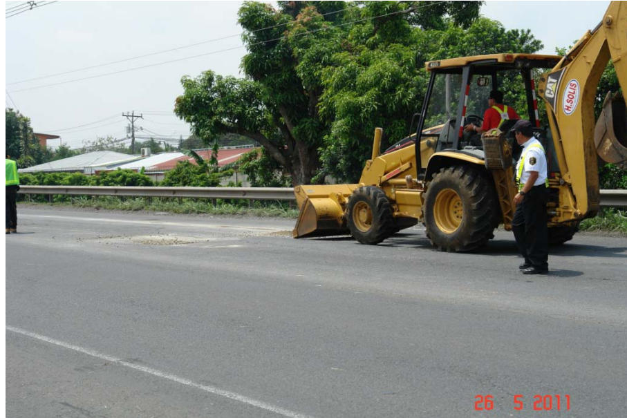
Figura 16. Kilómetro 2+650. El retroexcavador corta material en exceso para darle el acabado final.
