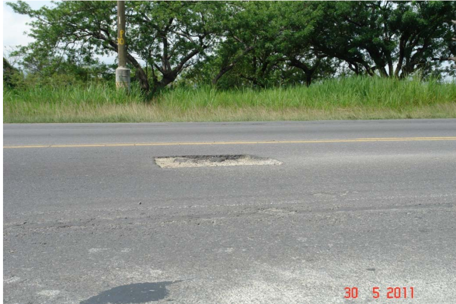
Figura 26. Kilómetro 3+220. Cielos abiertos encontrado en la segunda visita 30 mayo 2011. Carril izquierdo.
