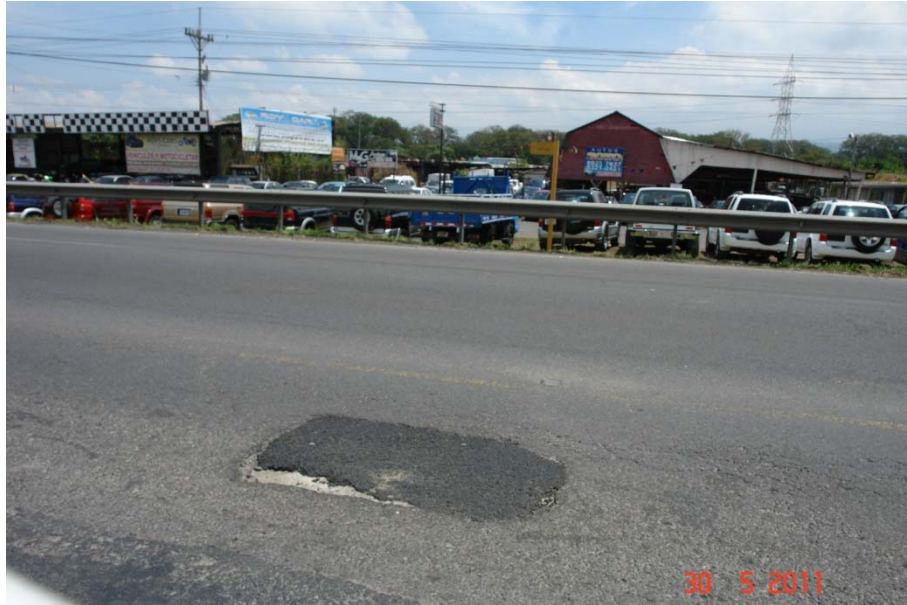
Figura 30. Kilómetro 2+650. Desprendimientos en la cobertura asfáltica colocada. Carril Izquierdo
