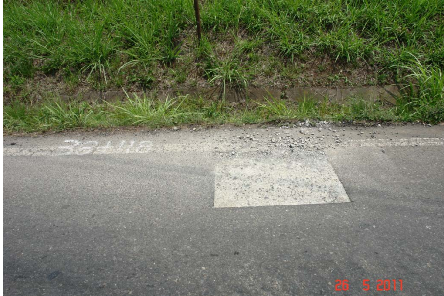
Figura 20. Kilómetro 38+118. Cielo abierto encontrado.
