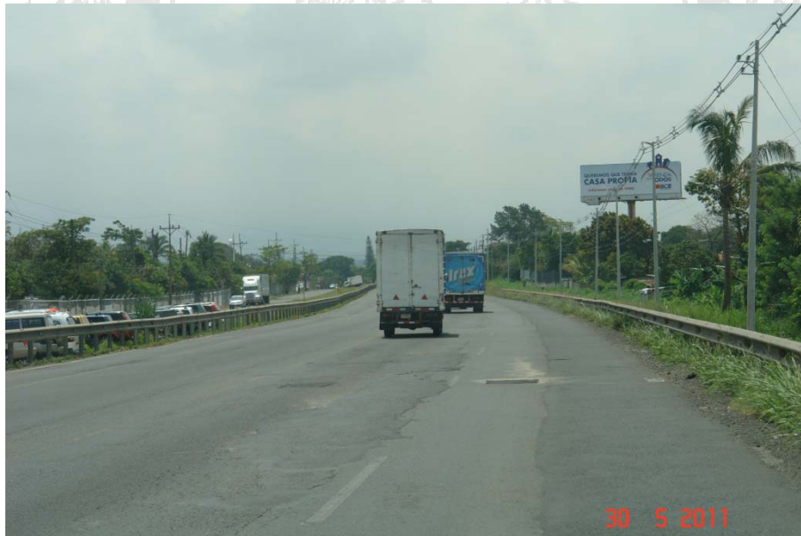
Figura 29. Kilómetro 2+650. Desprendimientos en la cobertura asfáltica colocada.
