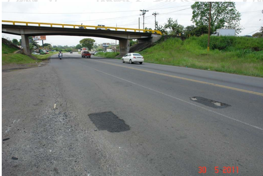
Figura 27. Kilómetro 1+600. Desprendimientos en la cobertura asfáltica colocada el 26 de mayo. Visita realizada el 30 de mayo.
