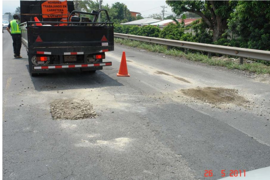
Figura 10. Kilómetro 2+650. Condición al momento de partir la cuadrilla. Se puede ver el material suelto en la superficie. Estos huecos se taparon con Mezcla ese mismo día en horas de la tarde.
