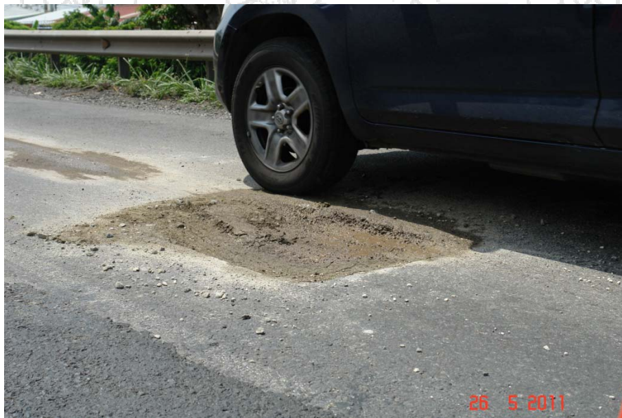
Figura 9. Kilómetro 2+650. Condición observada, compactación deficiente y material evidentemente saturado de agua.
