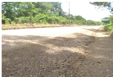
N°20 Acabado superficial existente Buena definición de cunetas pero con material de lastre arrastrado
