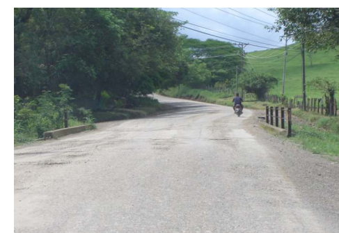
N°6 Estacionamiento 6+780 Puente sin contención vial en los accesos Baches en los accesos al puente
