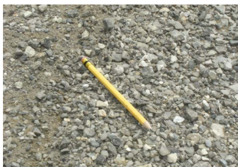
N°22 Agregado desprendido
