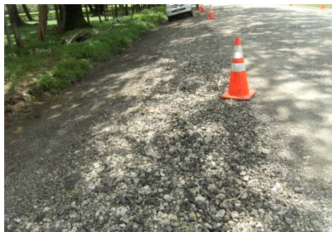
N°20 Desprendimiento de agregado
