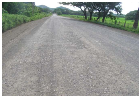
N°2 Estación 4+805, medición de pendiente. Desprendimiento de agregado y baches con nivel de deterioro bajo
