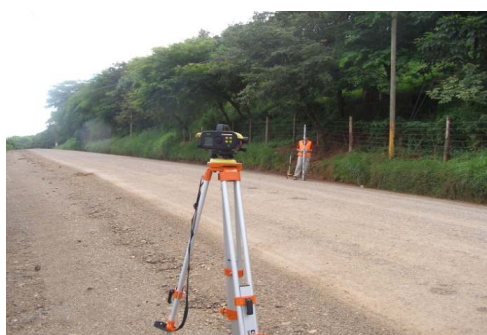
N°10 Estación 9+185, medición de pendiente Baches de nivel de deterioro bajo y desprendimiento de agregado
