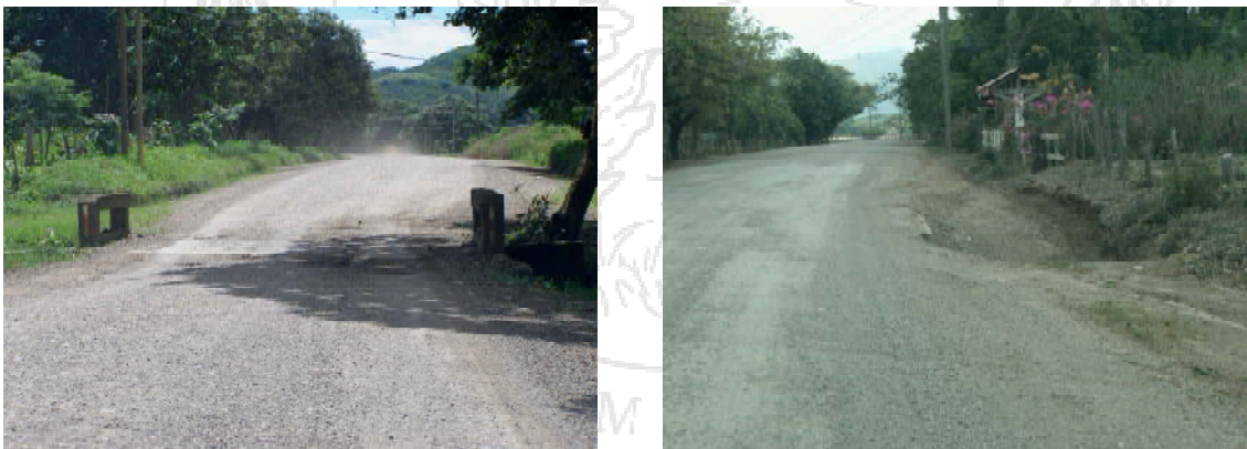
Fotografías N° 1: Izquierda: Ruta Nacional N° 152, Veintisiete de Abril (R.160)-Villarreal (R.15). Estrechez de calzada por puente y socavación con pérdida de área de calzada.
