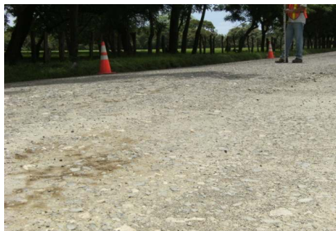
N°13 Desprendimiento de agregados
