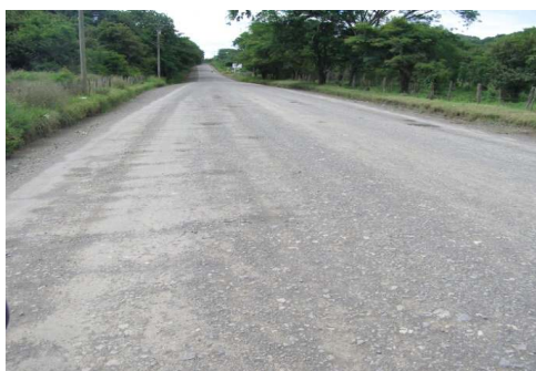
N°11 Estación 11+700, medición de pendiente. Se intervino con relastrado, no obstante muestra baches, corrugación y sección transversal inadecuada
