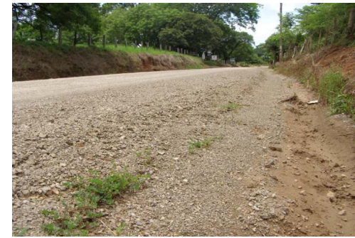
N°15 Buena definición de cunetas Se presenta cierta pérdida de agregado con nivel de deterioro bajo
