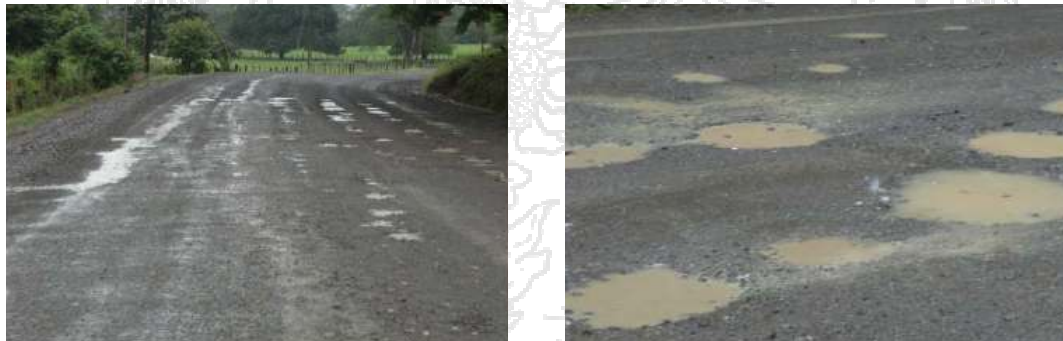
Estación 0+000 a 0+300: agua empozada por lluvias (visita 29-julio-2010).
