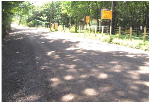
N°7 Roderas con nivel de deterioro bajo Bajo nivel de pérdida de agregado
