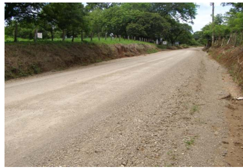
N°14 Acabado superficial existente, en buenas condiciones Se presenta cierta pérdida de agregado con nivel de deterioro bajo
