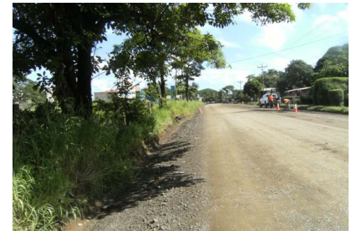
N°35 Desprendimiento de agregados
