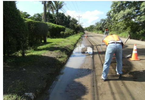
N°33 Inadecuado funcionamiento de los drenajes
