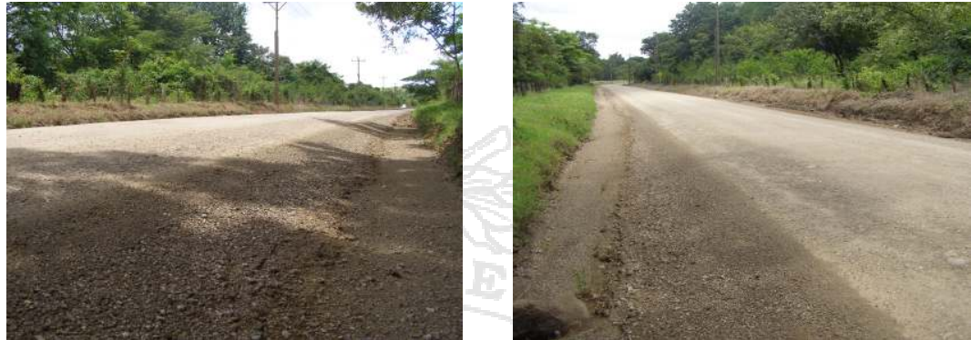
Fotografía N° 7: Camino Vecinal 5-03-067, Hacienda Pinilla-Plaza Paraíso. Km 15+705, buen acabado superficial con leve pérdida de agregado y buena definición geométrica de cunetas.
