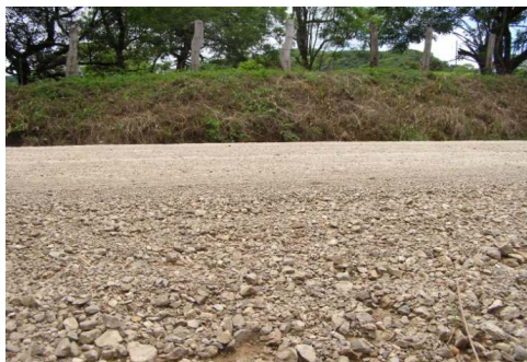
° 16 Se presenta cierta pérdida de agregado con nivel de deterioro bajo
