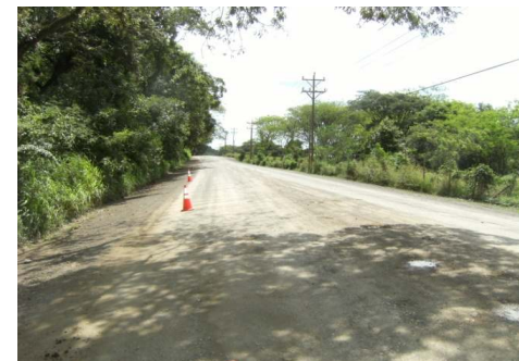
N°3 Corrugaciones y roderas (sección transversal existente)
