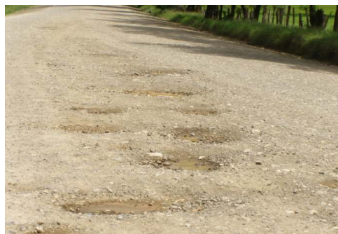
N°8 Estación 8+600 Baches con nivel de deterioro medio
