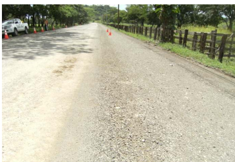
N°22 Desprendimiento de agregados y roderas
