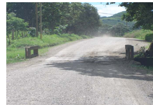
N°3 Estación 5+140 Puente sin contención vial en los accesos Baches en los accesos al puente
