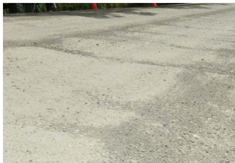
N°2 Sección transversal inadecuada existente
