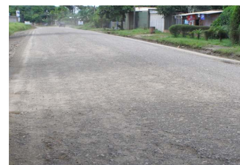
N°12 Estación 12+700, medición de pendiente. Con desprendimiento de agregado con nivel de deterioro bajo
