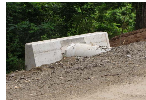
N°9 Estimación 9+000 Inadecuada colocación de alcantarilla
