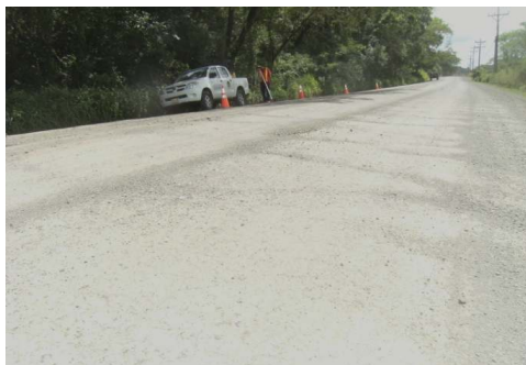
N°1 Sección transversal inadecuada existente
