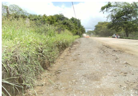
N°26 Agregado desprendido
