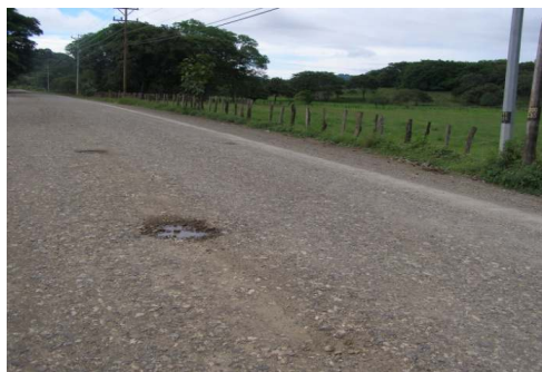
N°7 Estación 8+005, medición de pendiente Dos baches de nivel de deterioro medio y desprendimiento de agregado
