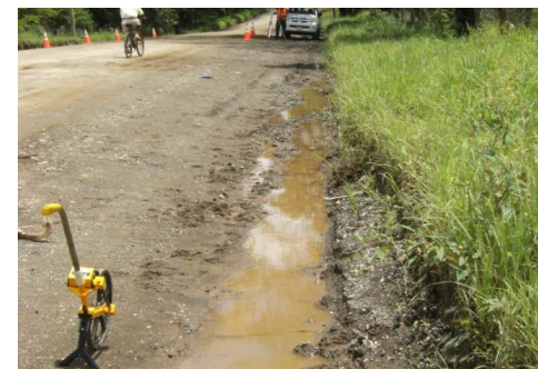
N°27 Inadecuado funcionamiento de los drenajes
