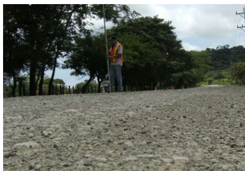
N°14 Desprendimiento de agregado
