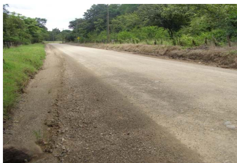
N°19 Roderas con nivel de deterioro bajo Bajo nivel de pérdida de agregado
