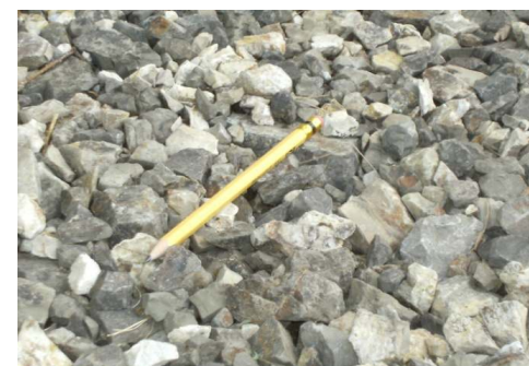
N°23 Agregado desprendido
