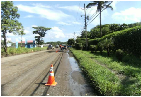
N°31 Inadecuado funcionamiento de los drenajes
