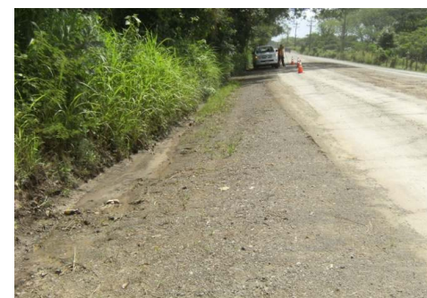
N°6 Inadecuado funcionamiento de los drenajes (pozos en cuneta) Desprendimiento de agregados
