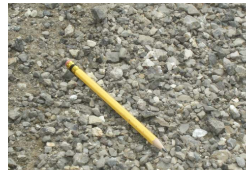
N°21 Desprendimiento de agregado
