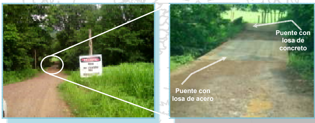
Puente con losa de acero sin barandas y sin contención vehicular en los accesos. (Fecha de fotografías 06-Mayo-2010)
