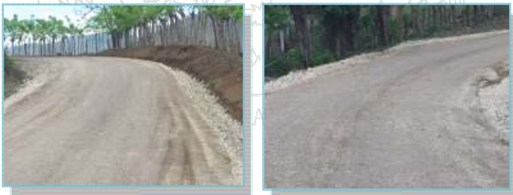
Fotografías N°5: Estación 5+300. Material calizo proveniente del Tajo San Buena, que en presencia de humedad muestra baja resistencia al deslizamiento, ver ahuellamiento por el paso vehicular. (Fecha de fotografía 06-May-2010).
