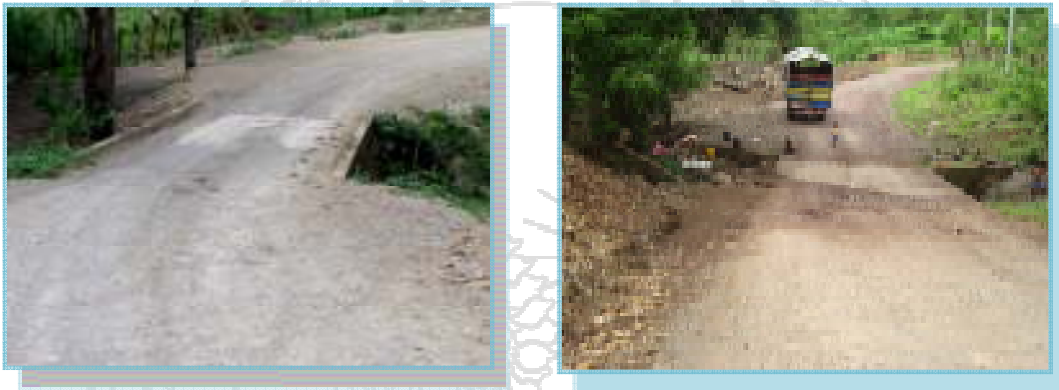
B) Vados sin señalización preventiva, Estación 0+700 y 0+900, respectivamente.
