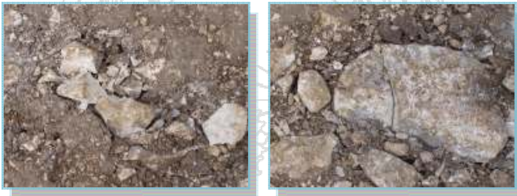
Fotografías N° 4: Material calizo extraído del Tajo San Buena, con poca resistencia a la fractura, Estación 5+150. (Fecha de fotografía 06-May-2010)
