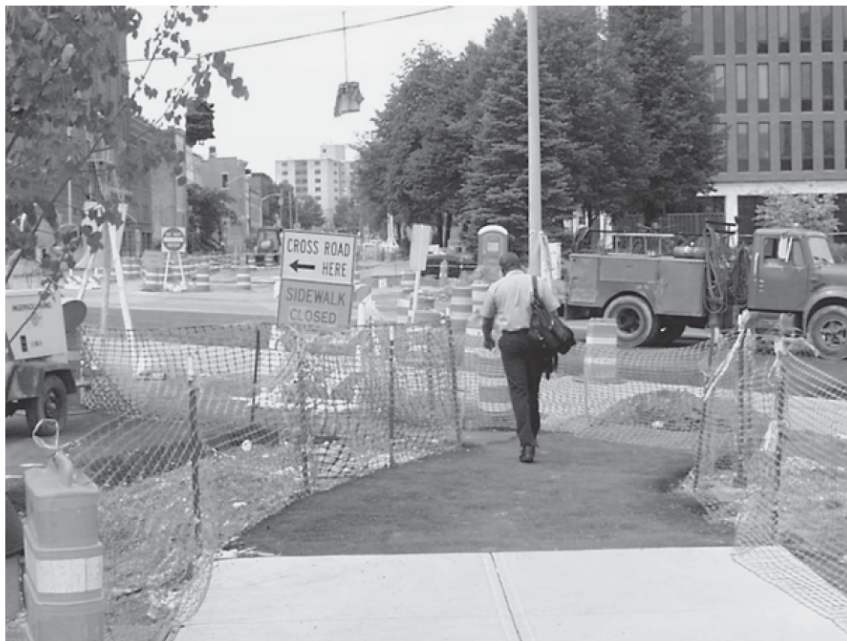
Figura A.3. Paso peatonal a través de una zona de trabajo.
