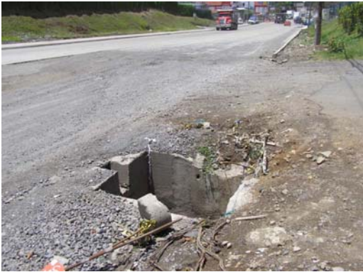
Fotografía 4.17. Alcantarilla descubierta y sin protección, ni señalización. (Fecha: 2 de febrero del 2009)
