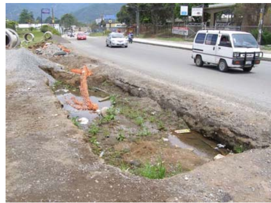
Fotografía 4.20. Zanja a un lado de la vía sin señalización. (Fecha: 20 de mayo, 2009)
