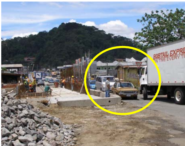
Fotografía 4.6. Puente con solo un carril habilitado, sin un adecuado manejo del tránsito. (Fecha: 20 de mayo del 2009)
