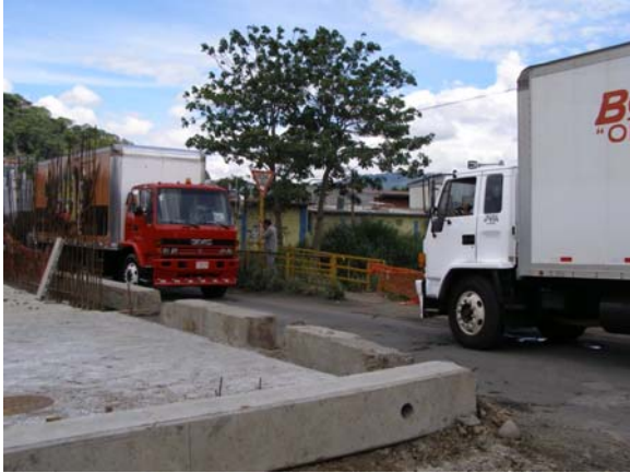
Fotografía 4.8. Puente con solo un carril habilitado, sin un adecuado manejo del tránsito. (Fecha: 20 de mayo del 2009)
