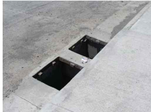
Fotografía 4.18. Alcantarilla descubierta y sin protección, ni señalización. (Fecha: 20 de mayo del 2009)
