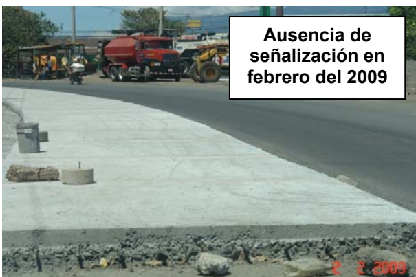
Fotografía 4.13. Carril inconcluso en febrero del 2009. (Fecha: 2 de febrero del 2009)
