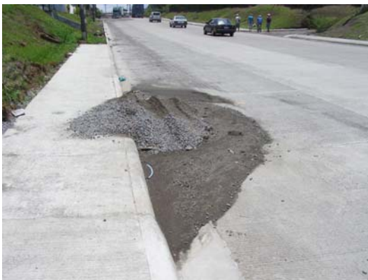
Fotografía 4.19. Residuos de material en la vía. (Fecha: 20 de mayo del 2009)
