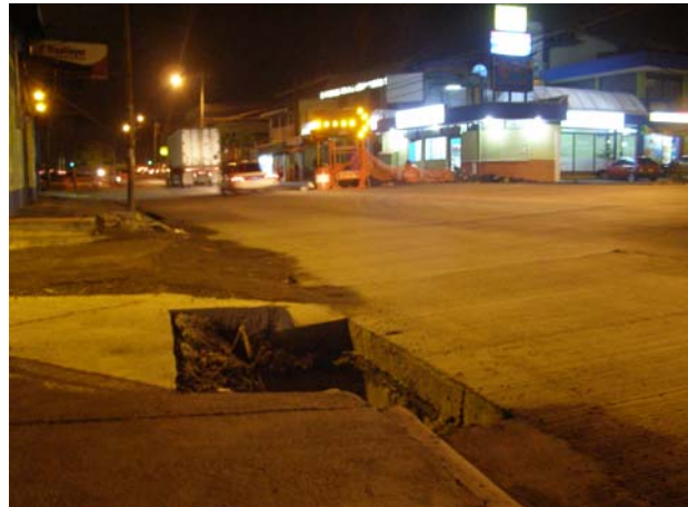
Fotografía 4.22. Alcantarilla descubierta y sin protección, ni señalización. (Fecha: 26 de junio del 2009)
