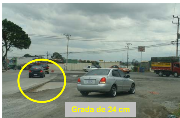
Fotografía 4.25. Persisten los desniveles sin una señalización adecuada. (Fecha: 8 de julio del 2009)
