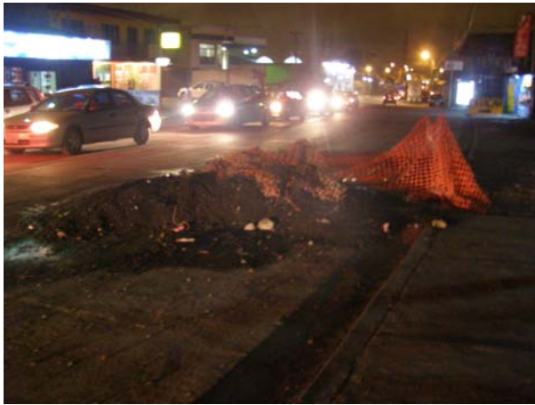
Fotografía 4.21. Montículos de material en la vía sin una adecuada señalización. (Fecha: 26 de junio del 2009)
