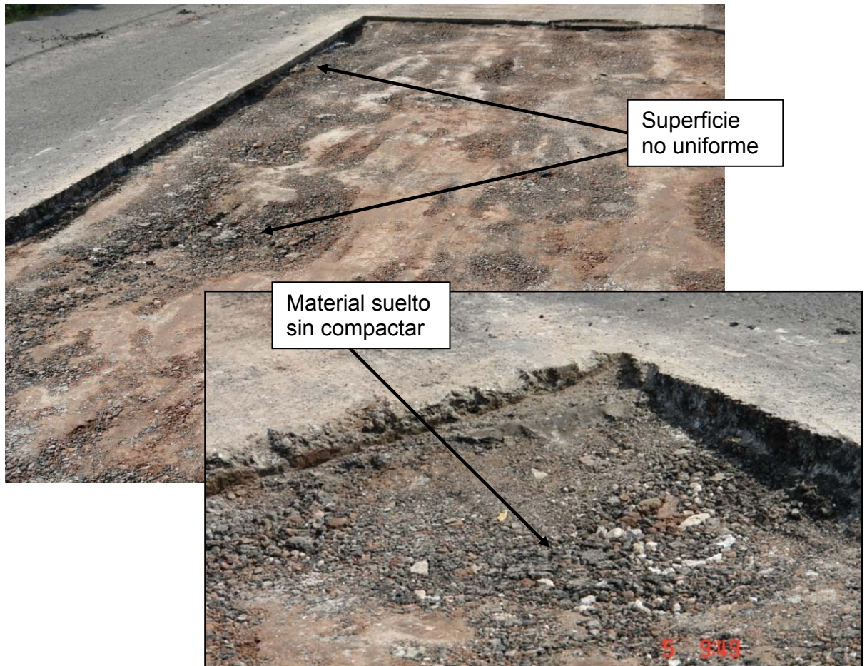
Fotografía No. 13: Colocación de mezcla asfáltica sobre base granular con problemas de compactación (se observa material suelto) e irregularidades y con espesores inferiores al mínimo requerido para el tipo de mezcla colocada. Zona 2-3, Ruta No. 164, Sección de Control 50392.
