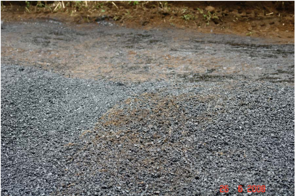
Fotografía No. 22: Contaminación de la mezcla con tierra.
