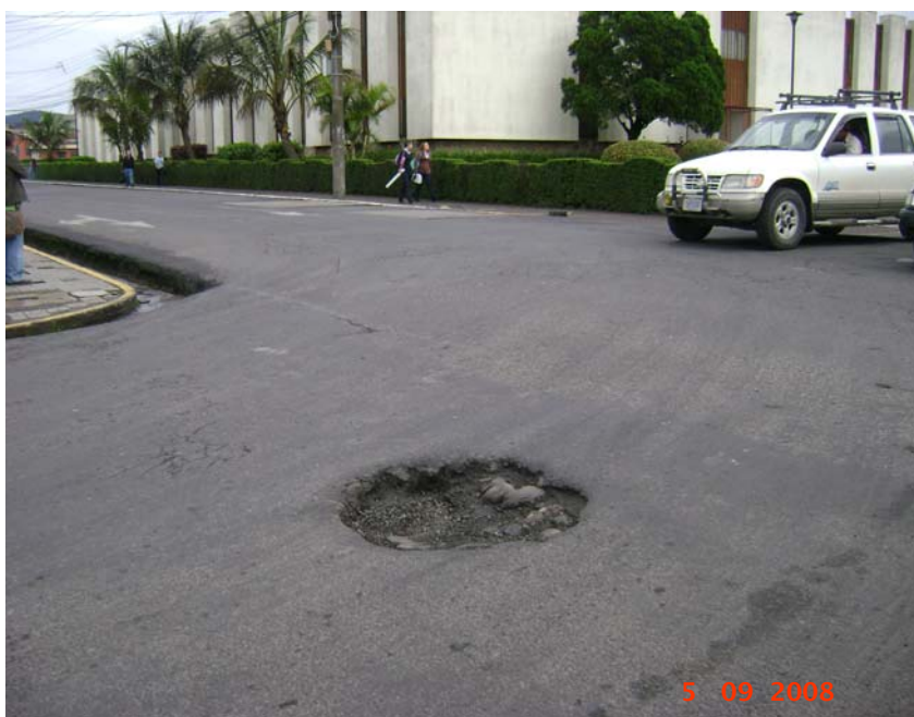
Fotografía No. 34: Bache observado el 5 de septiembre de 2008 en la sobrecapa colocada en todo el ancho de la calzada en los meses de septiembre y octubre de 2007 en la Zona 1-7, Ruta No. 231, Sección de Control 30290.
