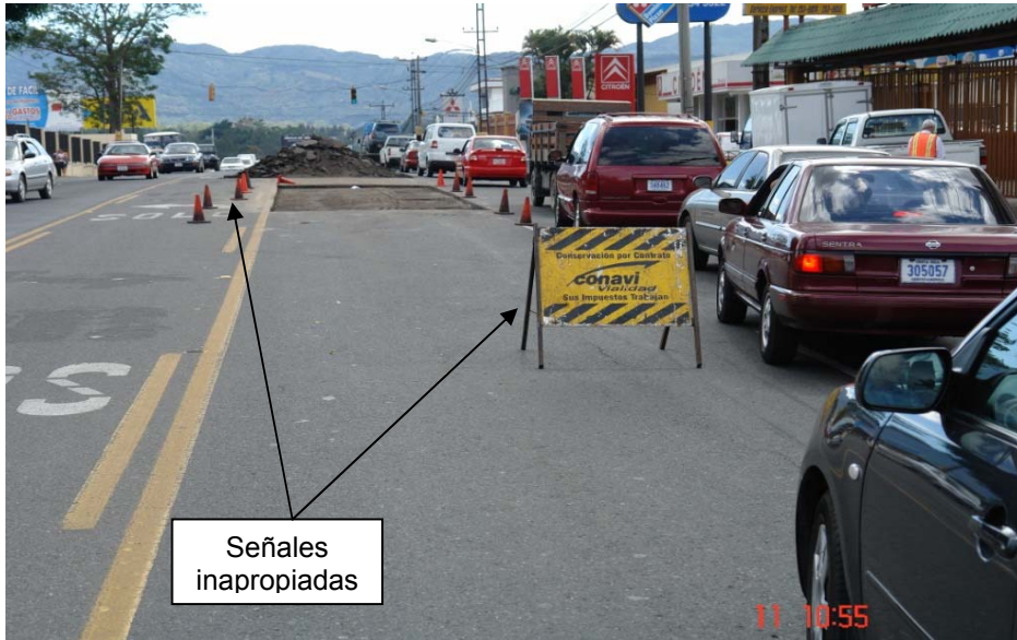
Fotografía No. 37: Señalización que no corresponde con lo especificado en el manual, ni el tipo ni la forma de colocación en vías muy transitadas. Fecha 11 de enero de 2008, frente a Colegio de Ingenieros.
