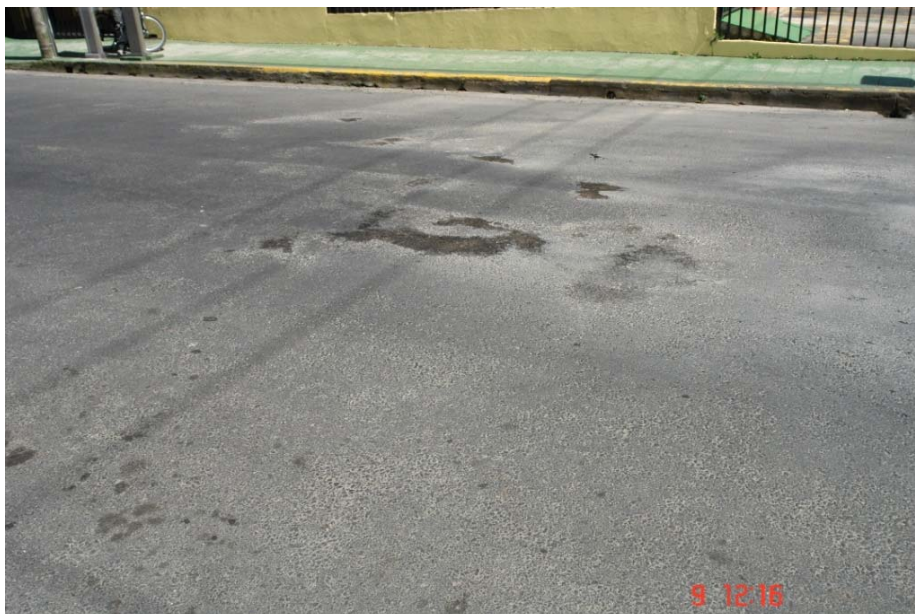
Fotografía No. 33: Deterioros observados posteriormente (9 de enero de 2008) en la sobrecapa colocada en todo el ancho de la calzada en los meses de septiembre y octubre de 2007 en la Zona 1-7, Ruta No. 231, Sección de Control 30290.
