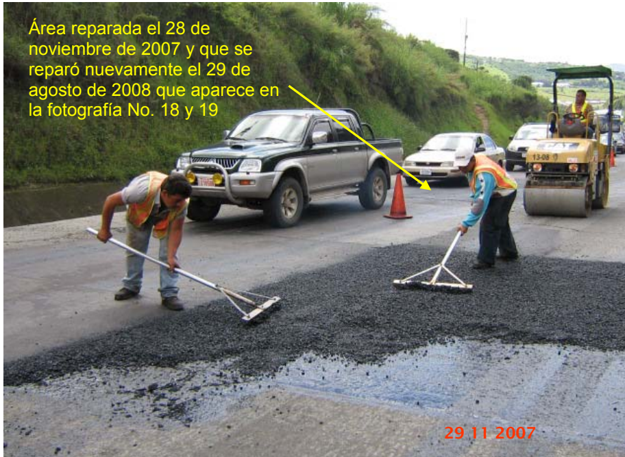
Fotografía No. 20: Colocación de mezcla asfáltica sobre losa de concreto fracturada y con espesores más pequeños que los adecuados. Zona 1-7 Ruta No. 2 en la subida a Ochomogo el día 29 de agosto de 2008.
