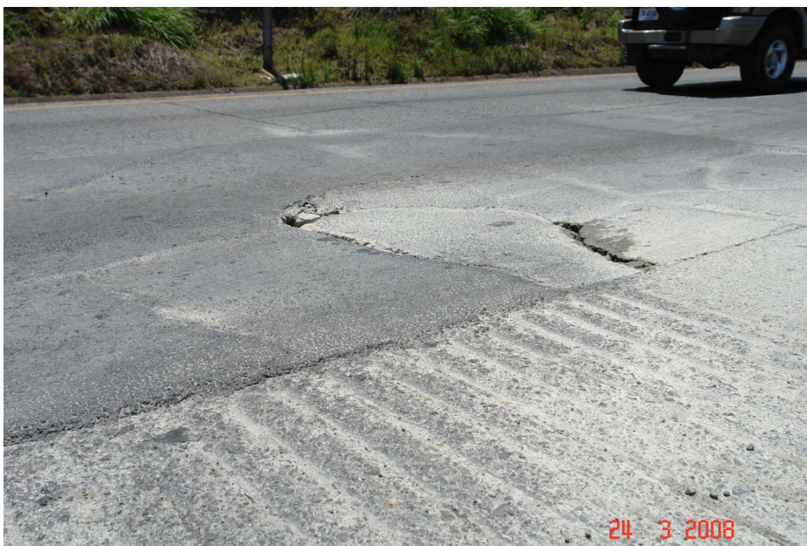
Fotografía No. 19: Deterioro observado en el mismo lugar de la fotografía No.13 cuatro meses después.
