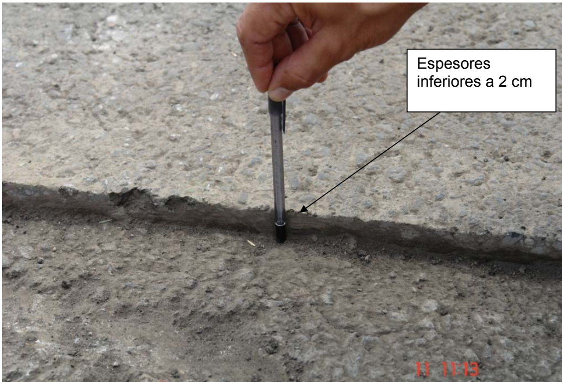
Fotografía No. 11: Superficie donde se colocó la mezcla asfáltica en caliente con espesores inferiores a los autorizados en el cartel de Licitación Pública LP-01-05. Zona 1-3, Ruta 2 sección de control 19006, en Curridabat. Fecha 11 de diciembre de 2007.
