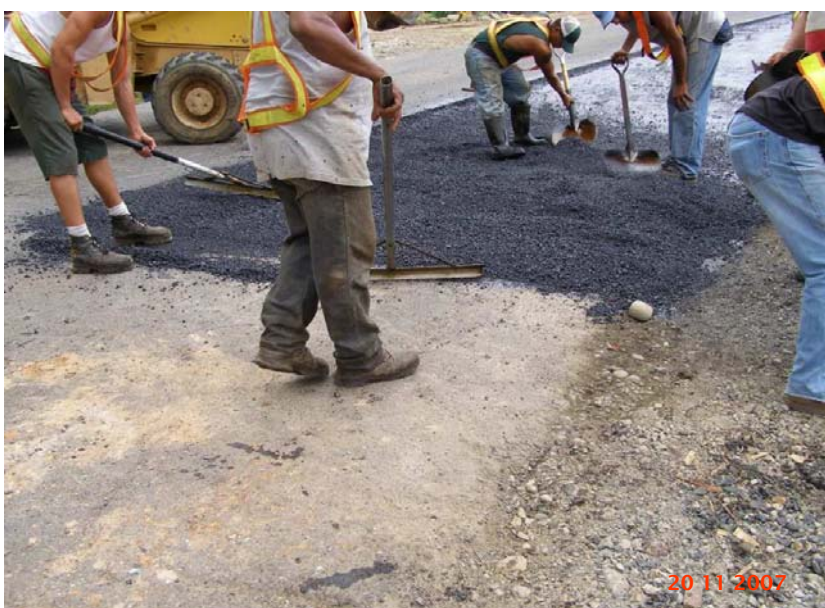
Fotografía No. 7: Colocación de mezcla asfáltica sin chequeo de la regularidad superficial (acabado superficial para función de confort) utilizando sólo rastrillo en la Zona 4-1 (Pérez Zeledón y La Osa) Ruta 2, Sección de Control 10020, cerca de la Ese.
