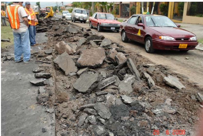
Fotografía No. 24: Bacheo en casi todo el ancho de la calzada en la sección de control 40620, de la ruta 119, zona 1-9.
