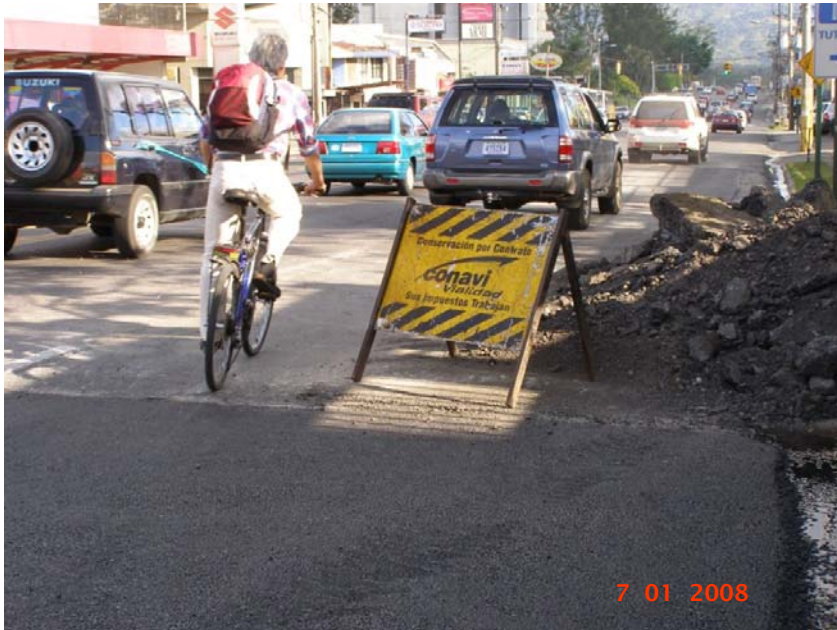
Fotografía No. 29: Material sobrante de la actividad de bacheo dejado en la calzada de la carretera después de concluida la jornada de trabajo. Zona 1-3, Ruta No. 2, Sección de Control 19006, en Crridabat.
