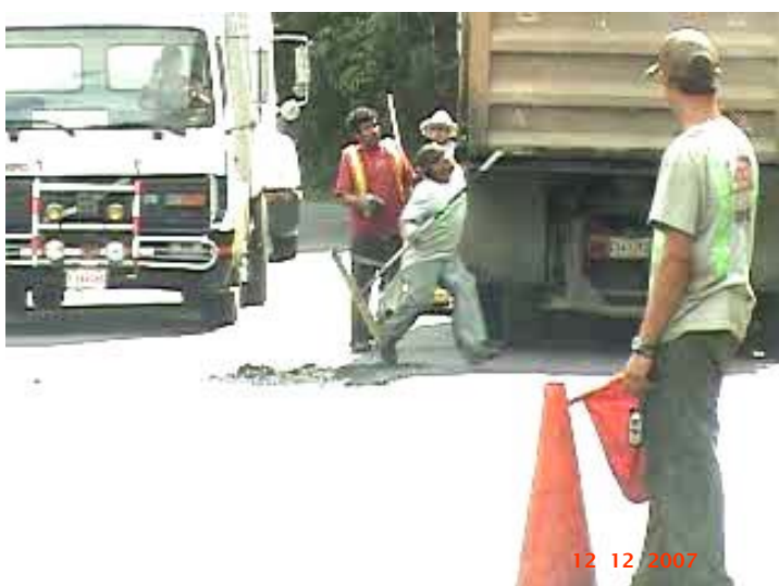
Fotografía No. 15: Colocación de mezcla asfáltica caliente comprendida en la actividad de bacheo de urgencia en la Zona 3-1, Ruta No. 1, Sección de Control 60200. Se observa como el obrero esquia la mezcla asfáltica caliente que es lanzada desde la vagoneta. Cerca de Cerro Esquivel.
