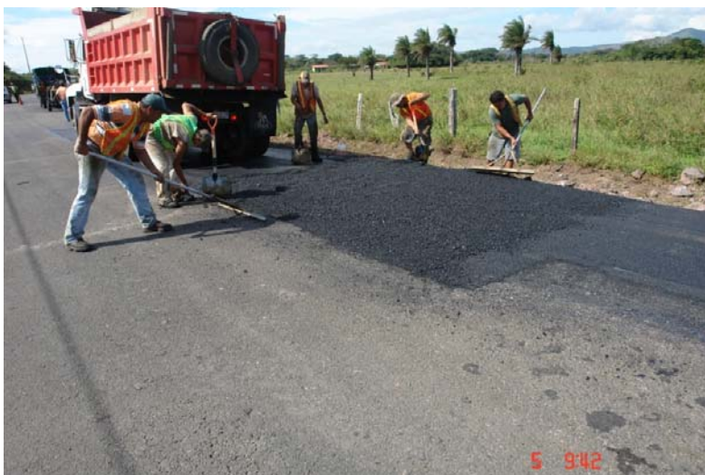
Fotografía No. 6: Colocación de mezcla asfáltica sin chequeo de la regularidad superficial utilizando sólo rastrillo. Zona 2-3 (Bagaces, Santa Cruz y Carrillo) Ruta 164 sección de control 50392 el 5 de diciembre, cerca de Guayabo.
