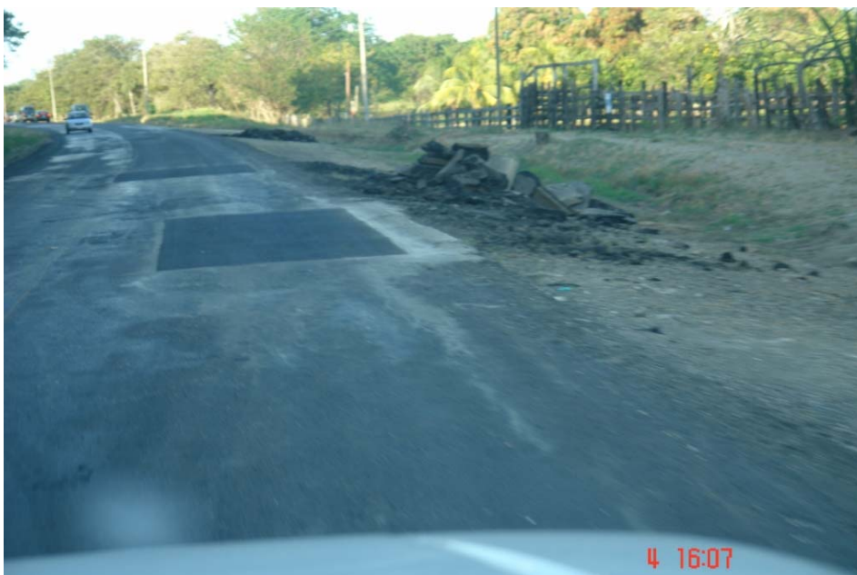
Fotografía No. 30: Material sobrante de la actividad de bacheo dejado en el espaldón de la carretera a 400 metros antes del lugar de trabajo. Zona 2-3, Ruta No. 21, Sección de Control 50100, cerca de Santa Cruz. Fecha 4 de diciembre de 2007.
