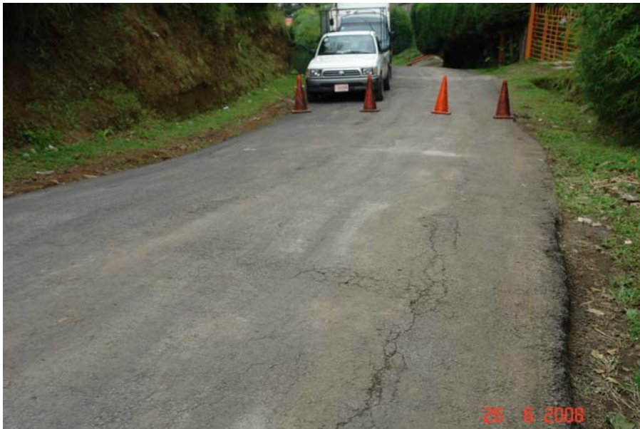
Fotografía No. 38: Cierre total de la vía incumpliendo las especificaciones constructivas de la actividad de bacheo y el Cartel de Licitación Pública LP-01-05. Ruta 114 sección de control 40410, por cruce Sacramento.
