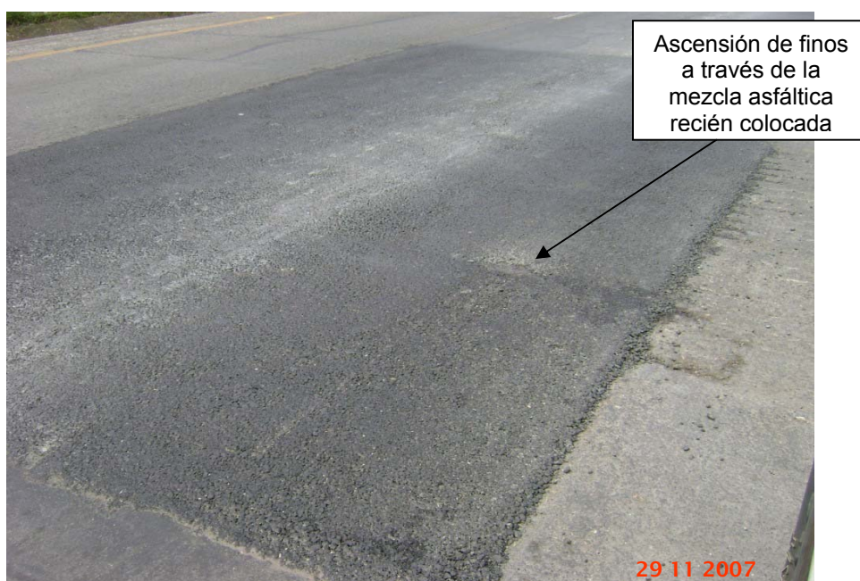
Fotografía No. 18: Deterioro observado dos días después de colocado un bacheo de urgencia con mezcla asfáltica sobre pavimento de concreto en la Zona 1-7, Ruta No. 2, Sección de Control 30740 (Ochomogo). Se observa ascensión de finos y agua del material de la base lo que trae un deterioro acelerado del trabajo ejecutado.
