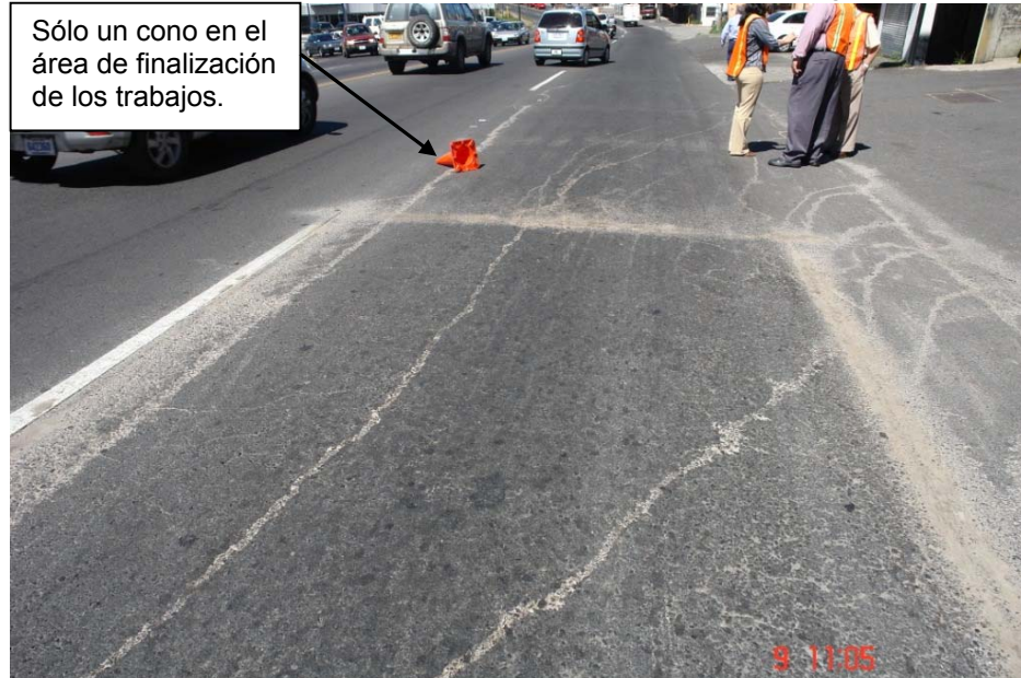
Fotografía No. 35: Final de trabajos en la vía mal señalizado en el área de finalización. Fecha 9 de enero de 2008. Ruta 2, sección de control 19006, Plaza del Sol.
