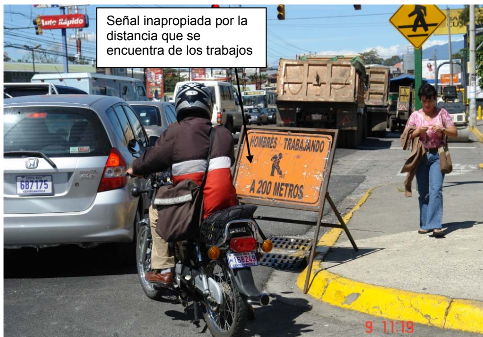
Fotografía No. 36: Señales no adecuadas y colocadas en lugares no adecuados en vía de alto tránsito. Fecha 9 de enero de 2008, Curridabat.
