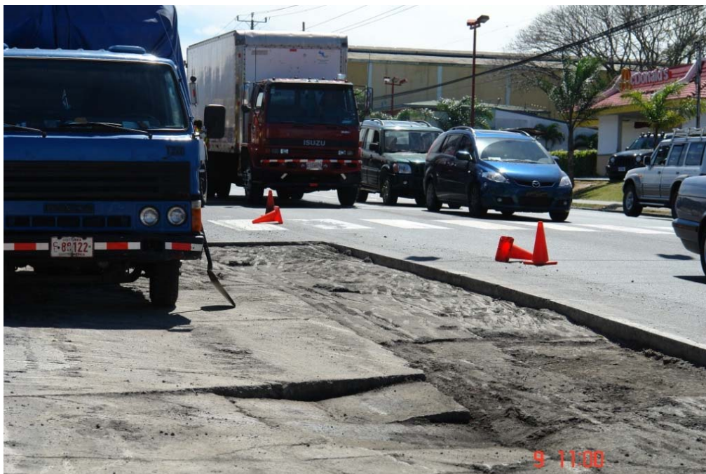
Fotografía No. 12: Colocación de mezcla asfáltica sobre base con problemas de soporte e irregularidades. Zona 1-3, Ruta No. 2, Sección de Control 19006. Frente a Plaza del Sol en Curridabat.
