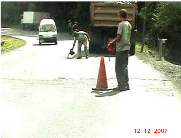
Fotografía No. 17: Riego de liga sin dosificación y forma de colocación inadecuada para la actividad de bacheo de urgencia, directamente sobre la superficie sin cortar los bordes, realizado en la Zona 3-1, Ruta No. 1, Sección de Control 60200. Señalización de obra que incumple lo estipulado en el cartel de licitación LP-01-05.
