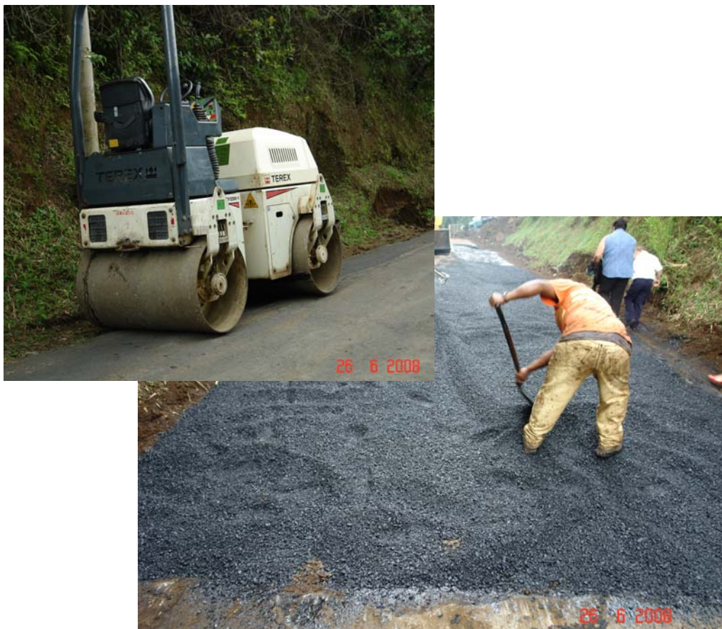
Fotografía No. 23: Colocación de mezcla asfáltica de 20 centímetros en todo el ancho de la calzada que será compactada con el equipo de compactación presente en la obra.
