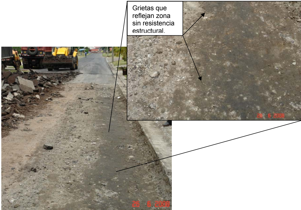
Fotografía No. 27: Superficie preparada para la colocación de la carpeta asfáltica con problemas de humedad y de soporte estructural.
