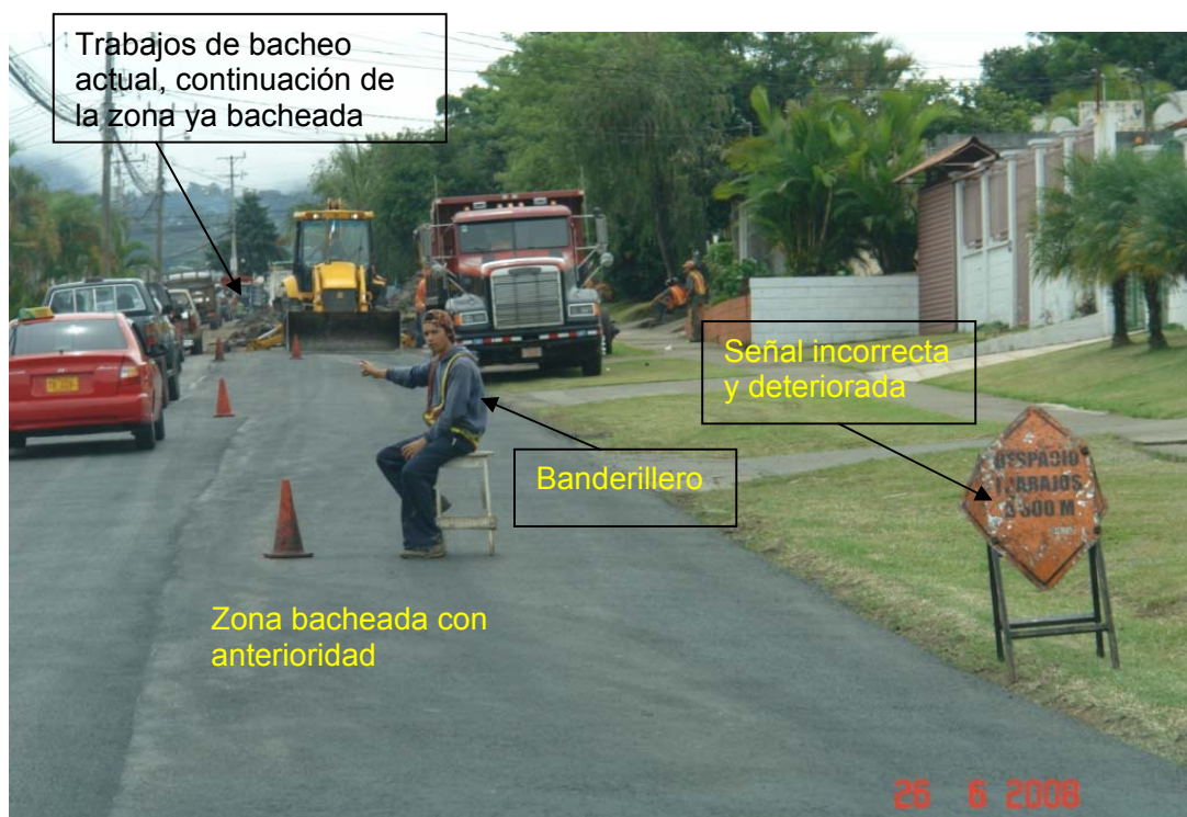
Fotografía No. 2: Trabajos de bacheo en la Zona 1-9 (Heredia, santo Domingo, Belén, Flores), Ruta No. 119, Sección de Control 40620, lugar conocido como San Roque, el 26 de junio de 2008.
