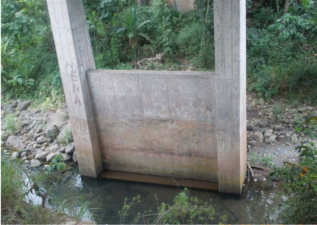
Figura 15. Socavación en ubicación de la pila P2. A nivel del agua lo que se observa es una losa de concreto en la terminación del muro de relleno del marco.
