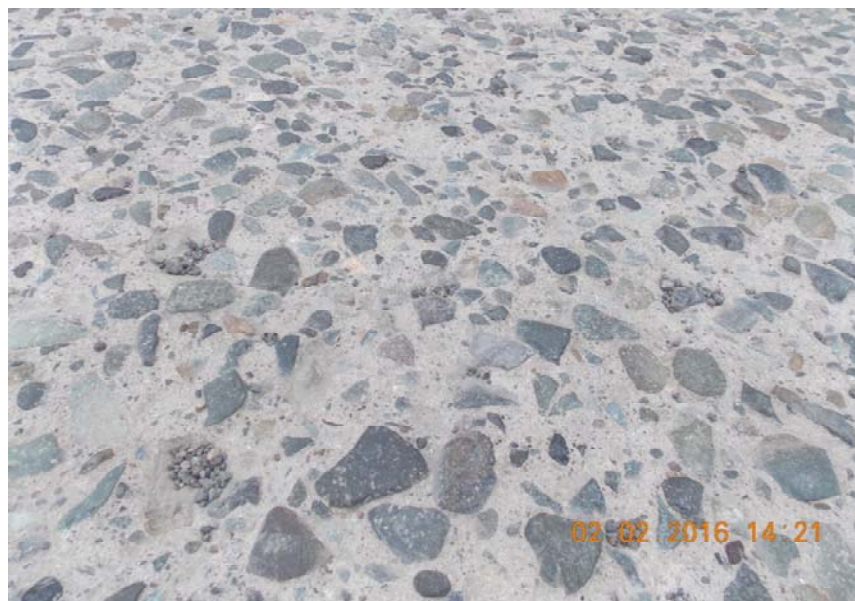
Figura 8. Desgaste superficial de losa de concreto.
