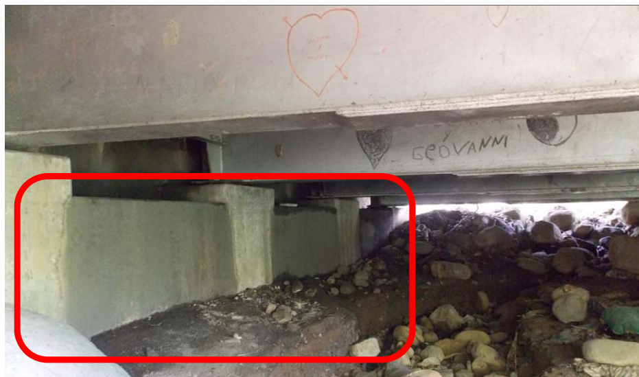
Figura 12. Filtración de agua en más del 50% del área de la viga cabezal del bastión B1.
