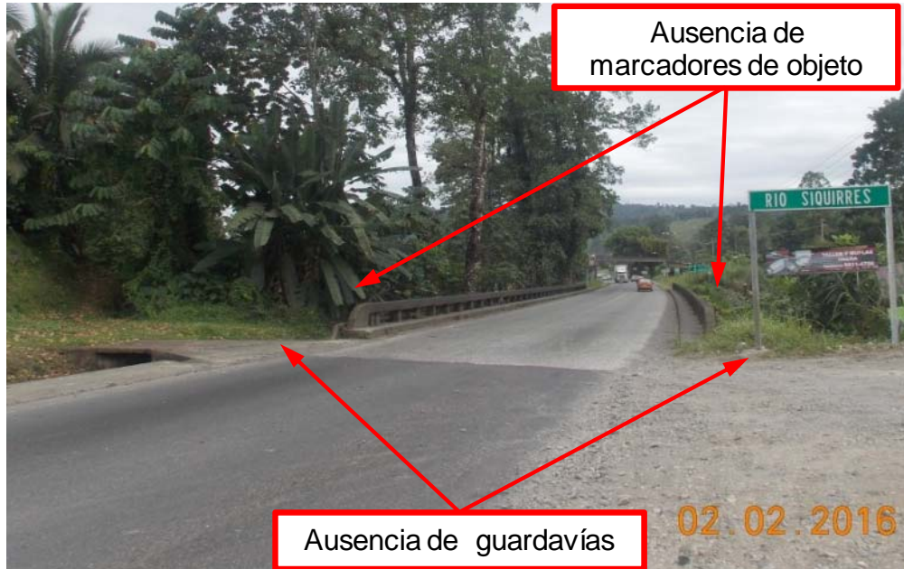
Figura 1. Ausencia marcadores de objeto y guardavías en ambos accesos. Caso del acceso 1.
