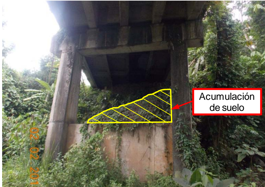
Figura 13. Filtración de agua en pila P1 así como acumulación de suelo en la cara oeste del muro de relleno del marco.
