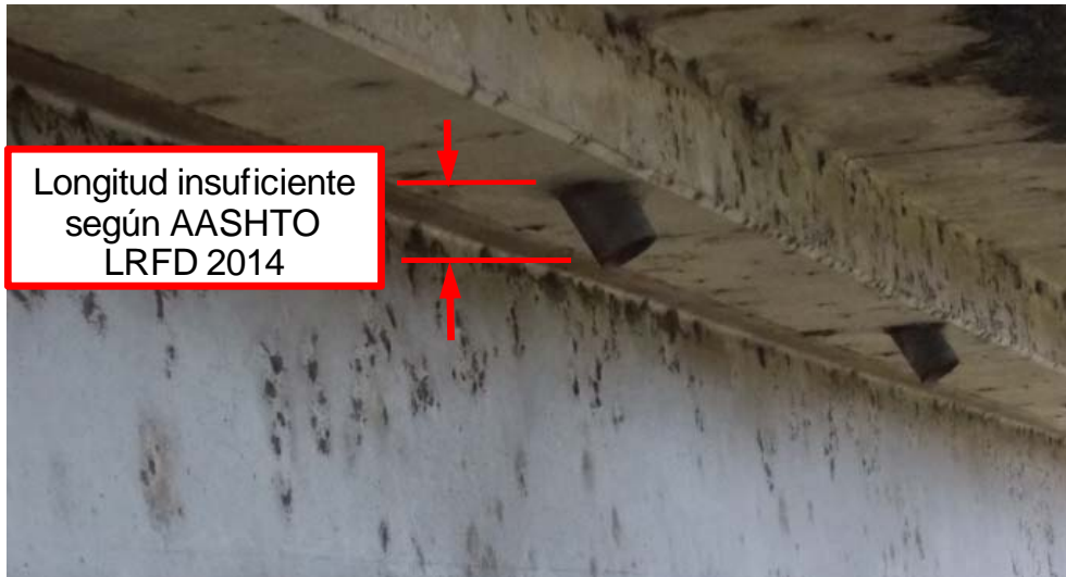
Figura 3. Longitud insuficiente de los ductos de drenaje según los requerimientos de la sección 2.6.6.4 del AASHTO LRFD 2014.
