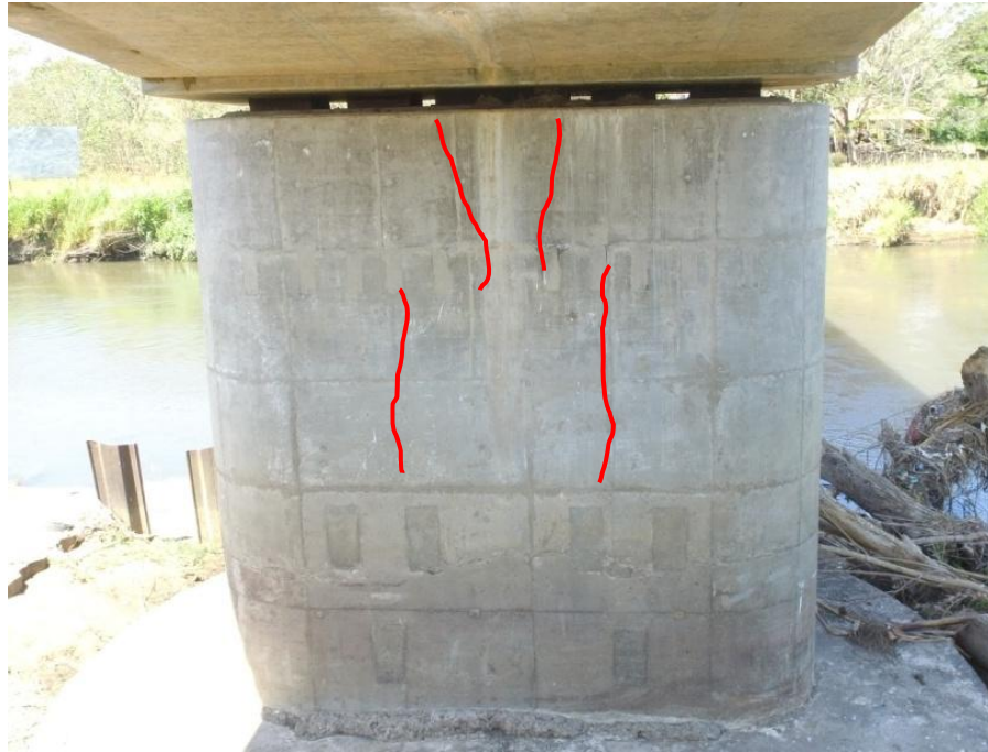
Figura 20. Agrietamiento en cuerpo de pila 2 detectado gracias a vehículo aéreo no tripulado (Cara hacia Tárcoles).
