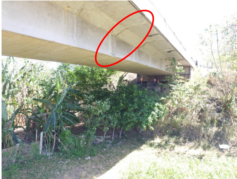
Figura 9. Eflorescencia en extremos de la losa superior del cajón.
