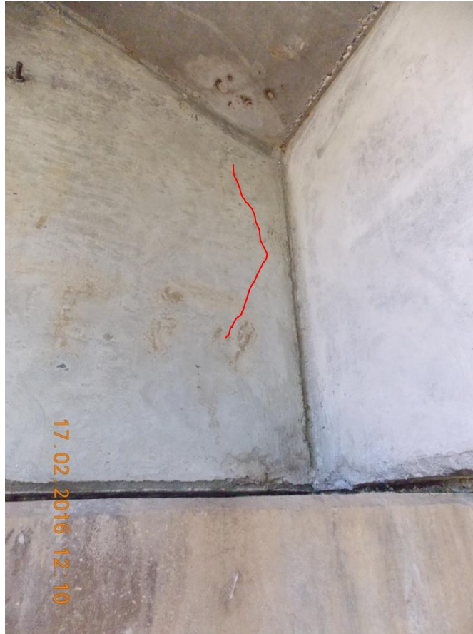
Figura 13. Grieta en viga diafragma del extremo sobre el bastión 2.
