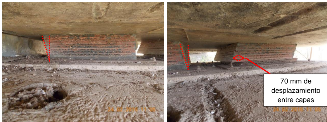
Figura 14. Apoyos elastoméricos deformados y con desprendimiento de placas sobre pila 1.
