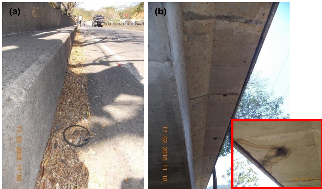
Figura 6. Deficiencias en el sistema de drenaje del puente: (a) Sedimentos con basura en bordillos y entradas del sistema de drenaje; (b) Falta de tubos de extensión en salidas del sistema de drenaje
