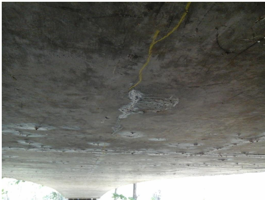
Figura 10. Grieta longitudinal en el tramo 1 del puente y eflorescencia en grietas.
