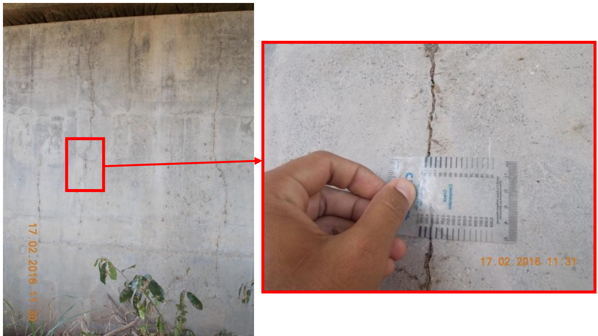
Figura 19. Agrietamiento en cuerpo de pila 1 (Cara hacia Tárcoles).
