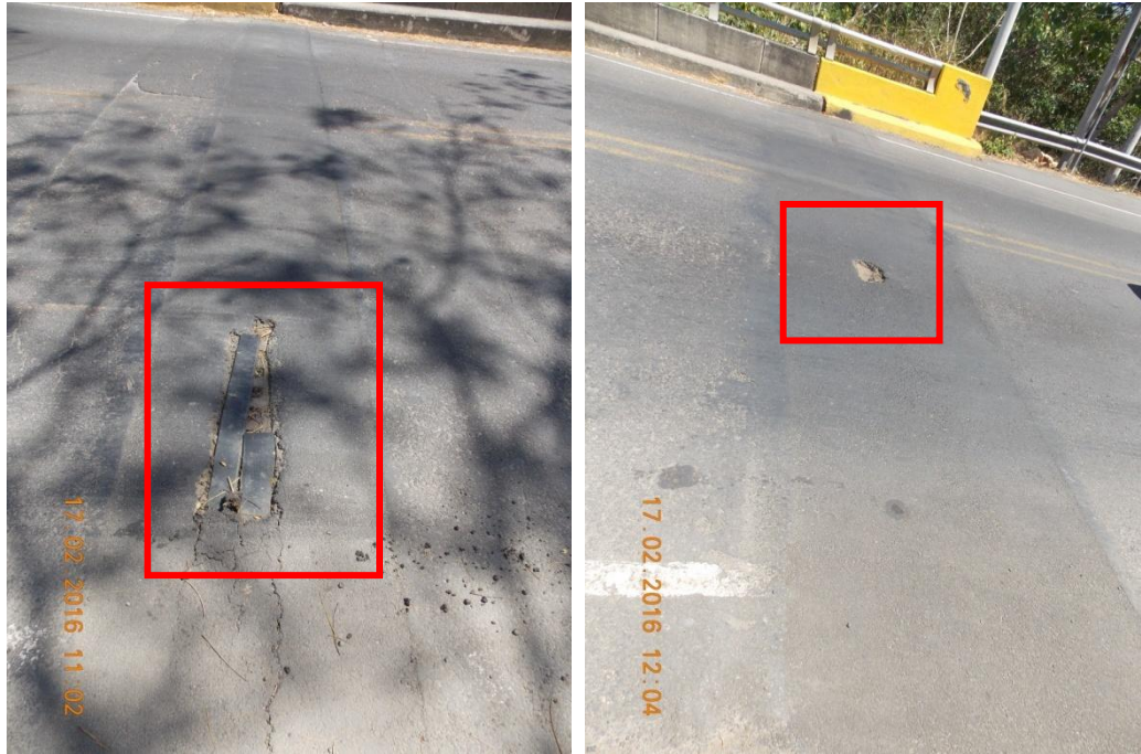
Figura 7. Juntas de expansión obstruidas con asfalto y con agujeros: (a) Junta de expansión sobre bastión 1; (b) Junta de expansión sobre bastión 2
