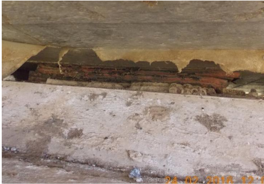
Figura 16. Apoyo con evidencia de falla por compresión, rotación y de cortante por deslizamiento entre capas en pila 3.
