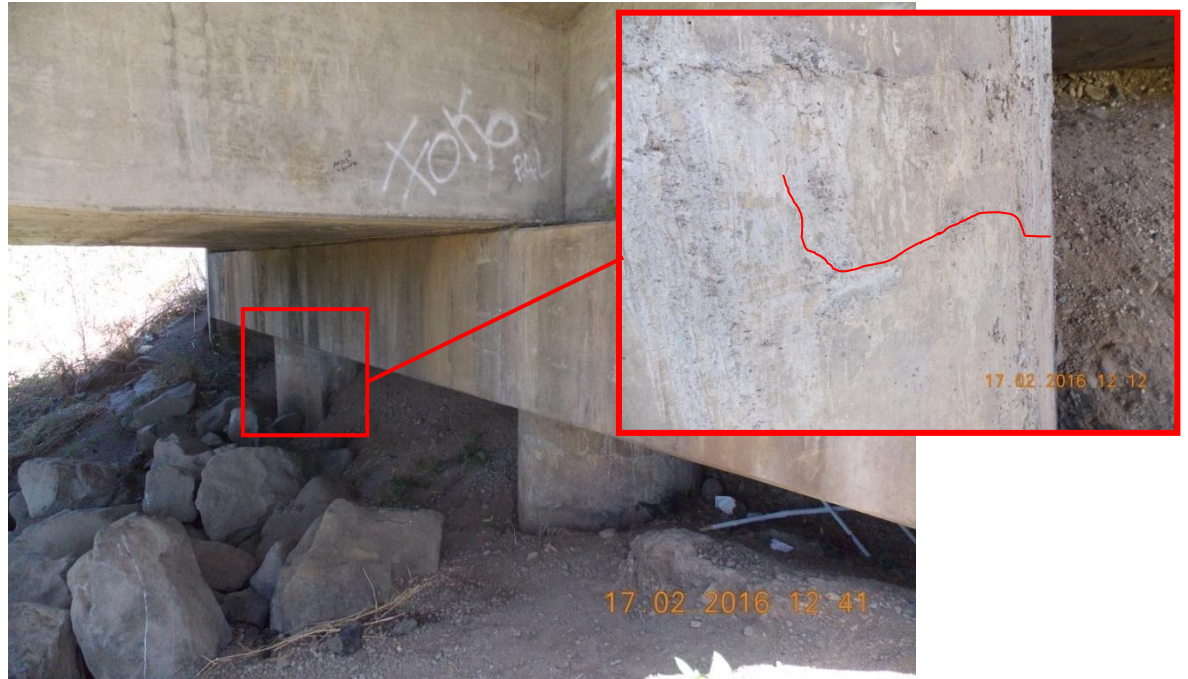
Figura 18. Columnas del bastión 2 expuestas y agrietamiento en columnas.
