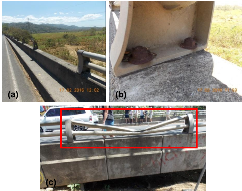
Figura 1. Daños observados en sistema de contención vehicular del puente: (a) Faltante de elementos, (b) Oxidación de pernos y (c) deformación de elementos
