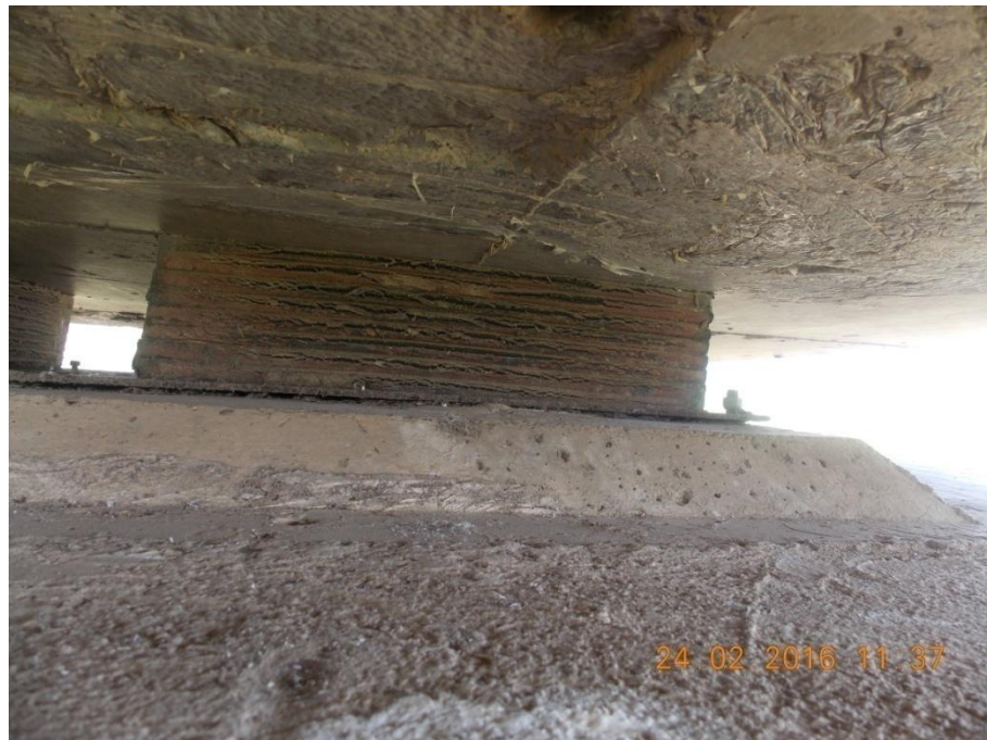
Figura 17. Apoyo deformado y con grietas en el material elastomérico en pila 4.
