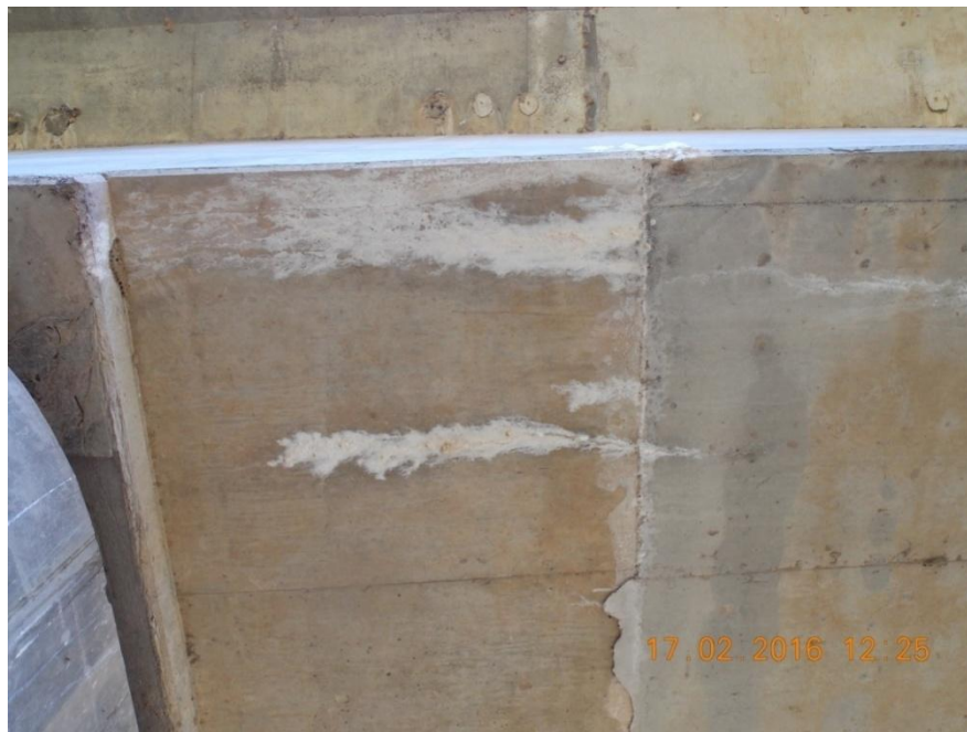
Figura 12. Eflorescencia en la junta de construcción y grietas de la losa inferior del tramo 4, contiguo a la pila 4.
