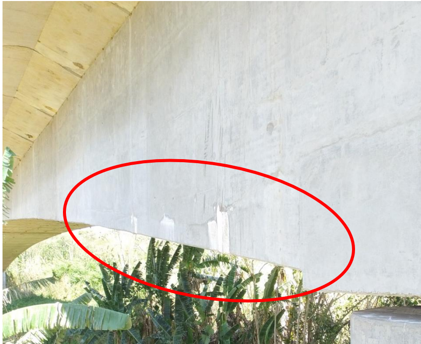
Figura 11. Eflorescencia en juntas de construcción de las paredes del cajón de concreto.
