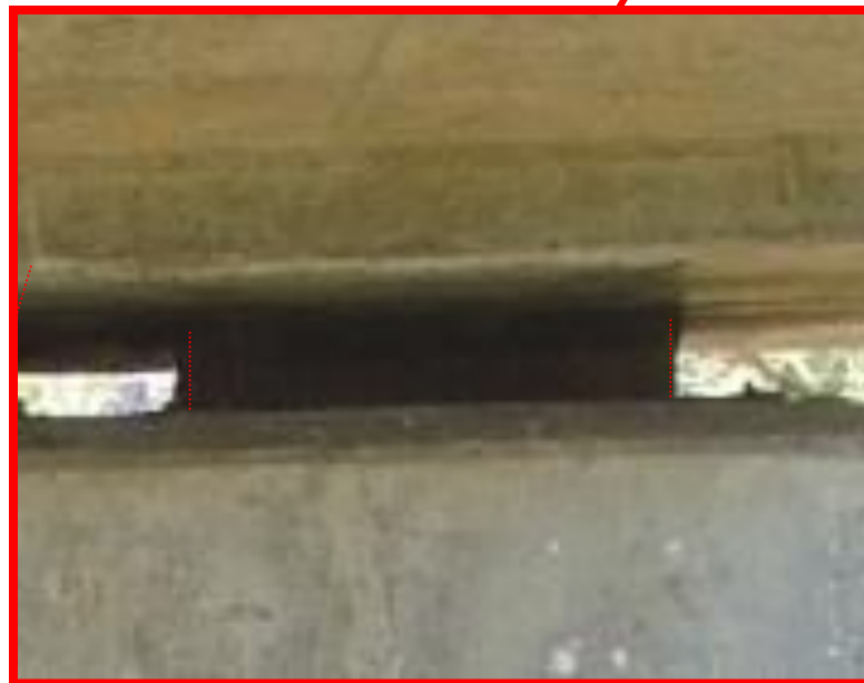
Figura 15. Deformaciones en los apoyos sobre la pila 2.
