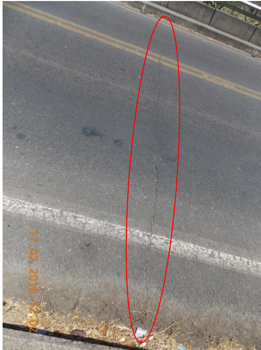
Figura 5. Ejemplo de grieta transversal en superficie de rodamiento asfáltica del puente
