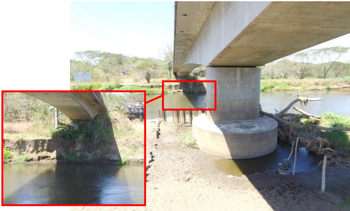
Figura 23. Acumulación de escombros alrededor de pila 2, evidencia de socavación de la pila 2 y erosión de margen derecha.
