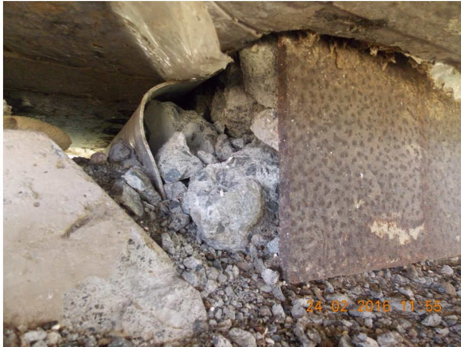
Figura 22. Llave de corte en pila 3 con concreto fallado por aplastamiento.
