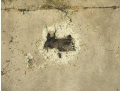
Figura 6-31 El acero de refuerzo está expuesto dentro de la cavidad
