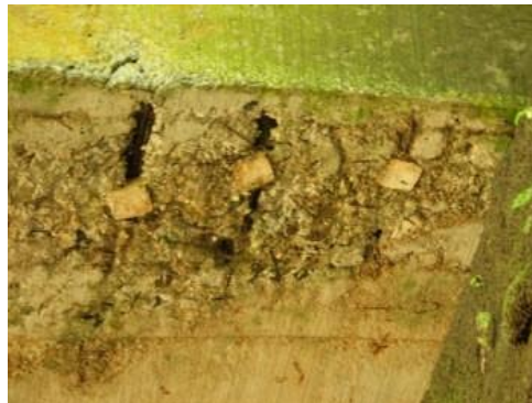
Figura 6-16 Refuerzo expuesto (grado 5)
