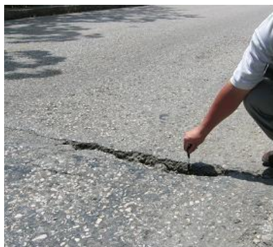
Figura 6-4 Sobrecapas en el pavimento (grado 5)
