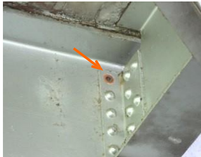
Figura 6-21 Pérdida de pernos
