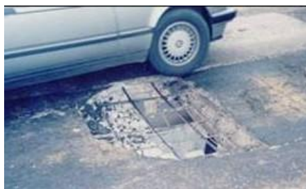
Figura 6-19 Agujero en la losa (grado 5)
