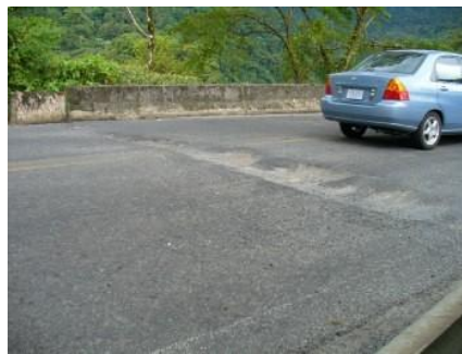
Figura 6-1 Ondulaciones en el pavimento
