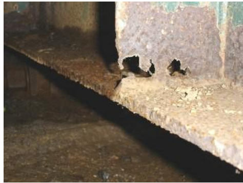
Figura 6-24 Corrosión del atiesador vertical (grado 5)
