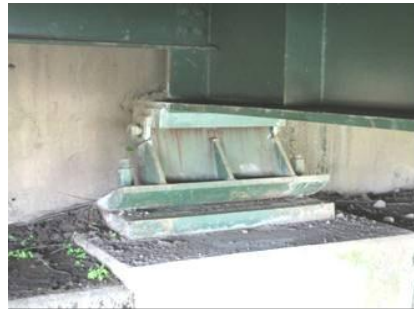
Figura 6-36 Inclinación del apoyo (grado 5)
