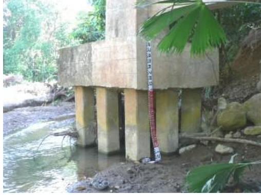
Figura 6-42 Socavación en la fundación (grado 5)
