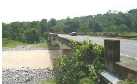
Figura 6-8 Falta baranda-barrera vehicular de acero (grado 5)
