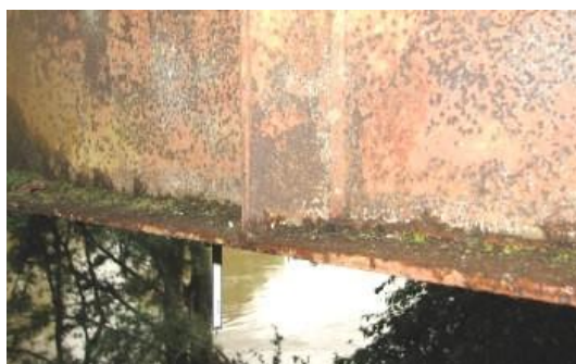
Figura 6-20 Oxidación en la viga principal
