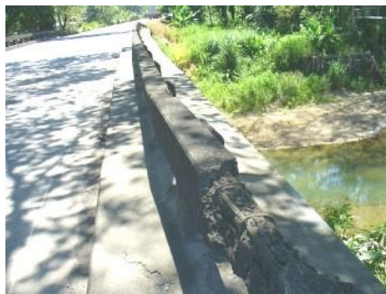
Figura 6-9 Acero de refuerzo expuesto (baranda-barrera vehicular de concreto)
