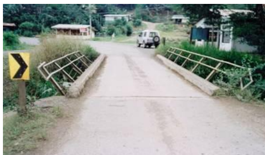
Figura 6-5 Deformación de la baranda (grado 5)
