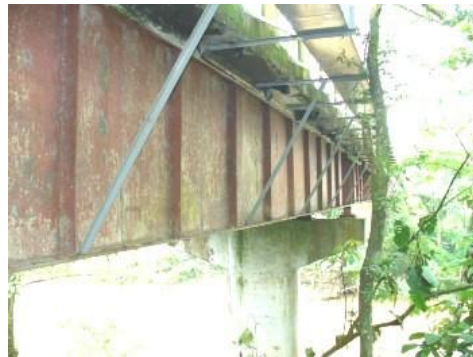
Figura 6-26 Decoloración de la viga principal
