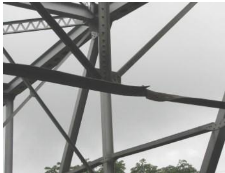
Figura 6-25 Rotura del elemento inferior del diafragma superior (Grado 3)
