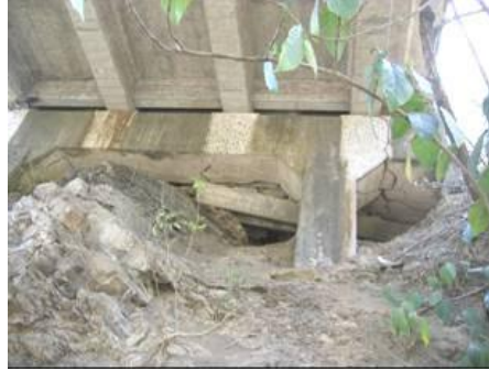
Figura 6-39 Colapso de la protección enfrente del bastión (Grado 5)
