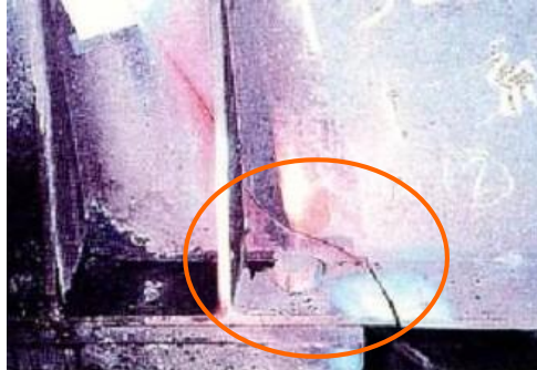
Figura 6-22 Grieta cerca del apoyo de la viga principal
