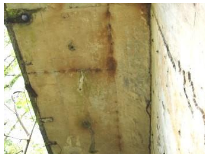
Figura 6-30 Oxidación en el acero de refuerzo.
