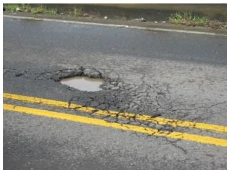
Figura 6-3 Baches en el pavimento (grado 2)
