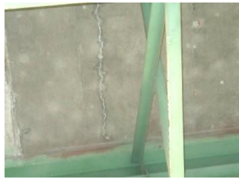
Figura 6-14 Grieta en una dirección en la losa
