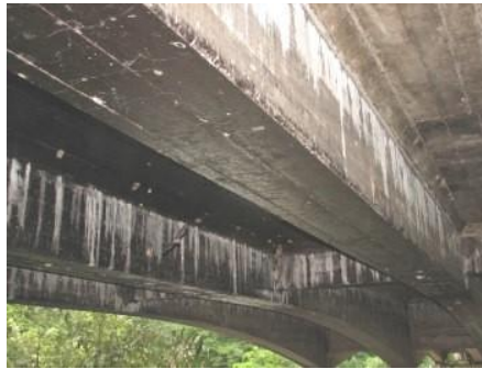
Figura 6-32 Eflorescencia en la viga principal (grado 4)
