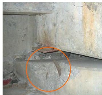
Figura 6-34 Pernos de anclaje cortados
