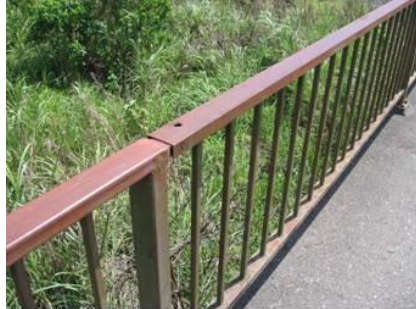
Figura 6-7 Corrosión en la baranda-barrera vehicular de acero (grado 3)
