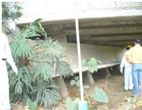
Figura 6-40 Inclinación del bastión por sismo (grado 5).
