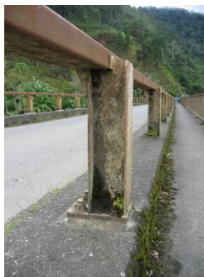
Figura 6-6 Oxidación (baranda de acero)
