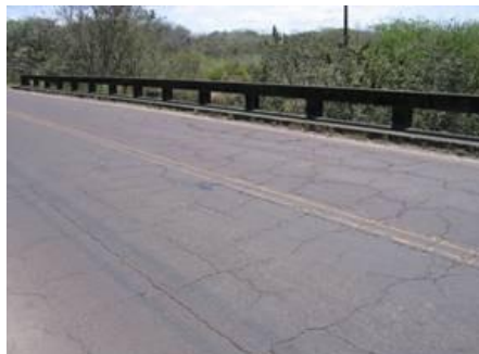
Figura 6-2 Grietas en el pavimento (grado 4)
