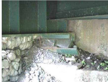
Figura 6-35 Deformación del apoyo (grado 5)
