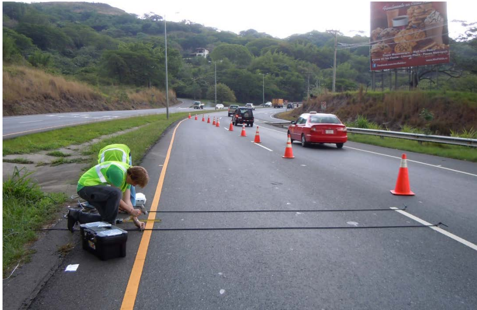
Figura 3. Ejemplo de instalación de contador neumático
