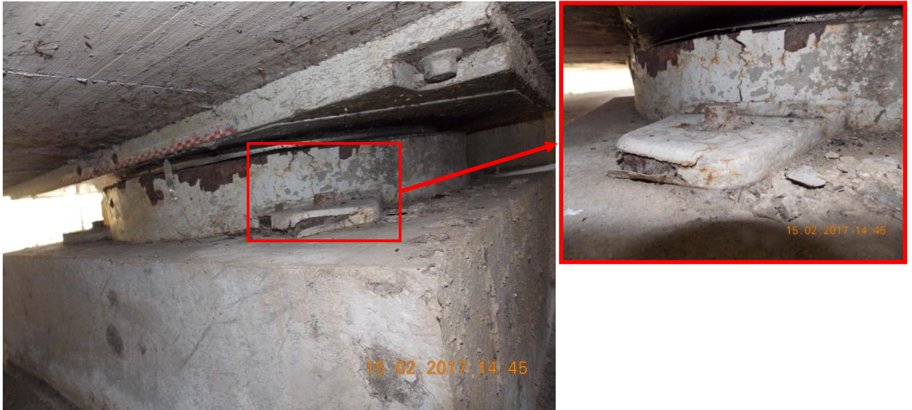
Figura 16. Oxidación y desprendimiento de pintura en el apoyo del lado aguas abajo sobre el bastión 2.
