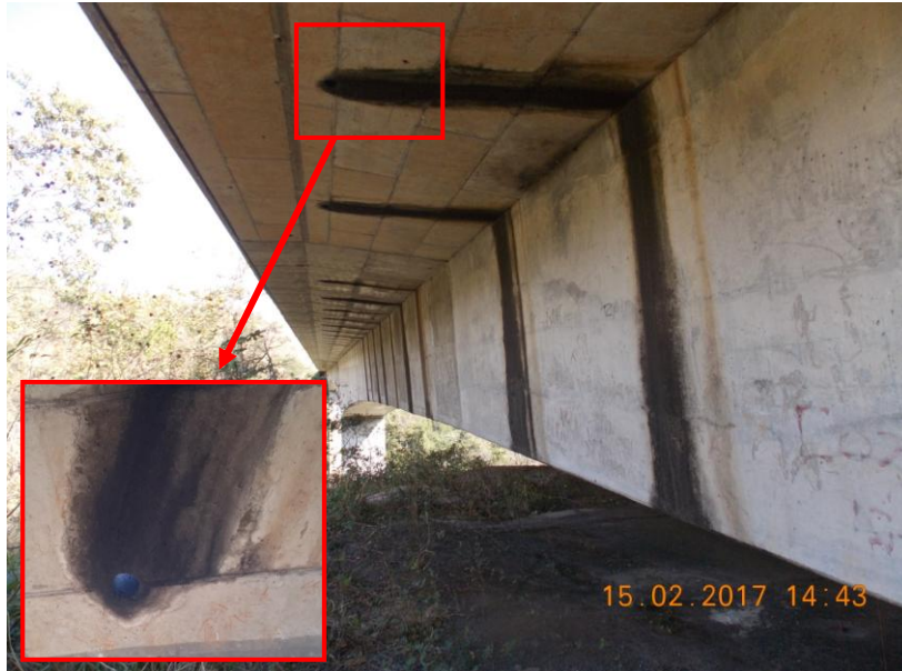
Figura 3. Ausencia de ductos de salida para el sistema de drenaje del puente.
