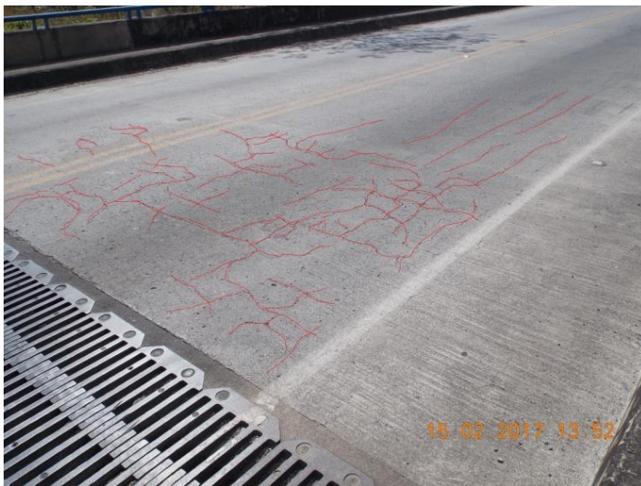
(a) Grietas en dos direcciones cerca de la junta de expansión 1
