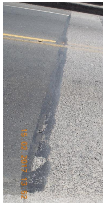
Figura 8. Junta entre ménsula ubicada sobre los bastiones y superficie de rodamiento asfáltica con angular de protección desprendido y atendida con la aplicación de material bituminoso.
