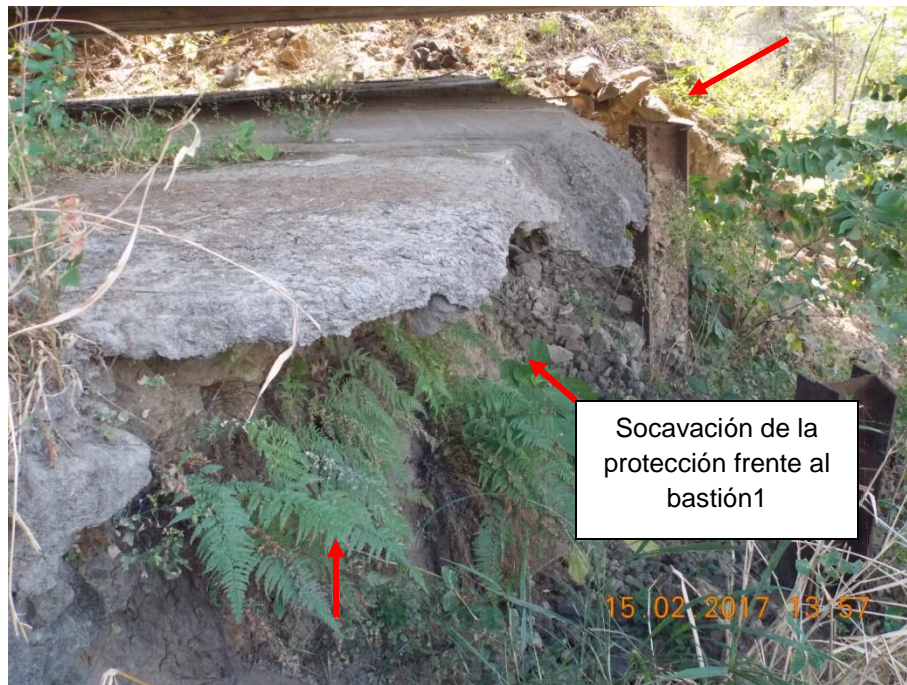
Figura 17. Erosión del talud frente al bastión 1 y socavación de la protección por mal manejo de agua de escorrentía.
