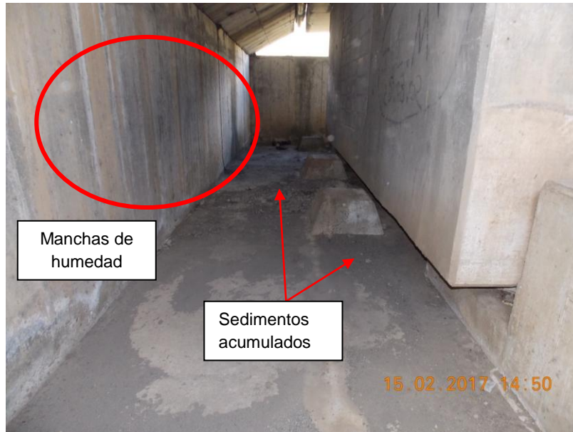
Figura 7. Acumulación de sedimentos en la zona detrás de la viga cajón y manchas de humedad en la pared del cabezal del bastión 2.
