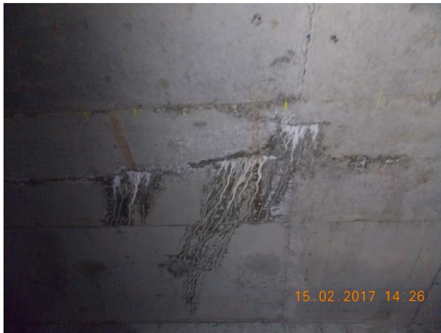
Figura 13. Grietas con eflorescencia en la cara inferior del tablero.
