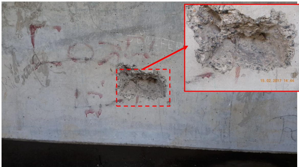
Figura 15. Desprendimiento de concreto con acero expuesto en la cara externa de la pared del costado aguas arriba del cajón de concreto.
