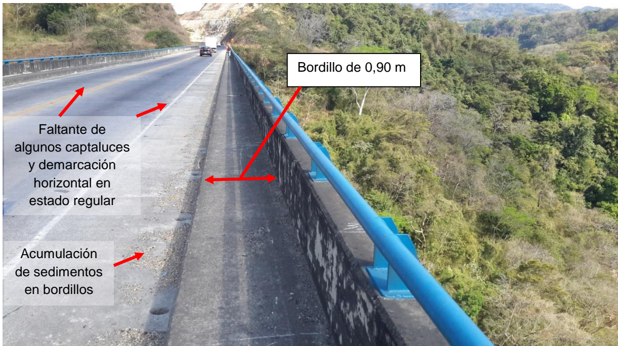
Figura 2. Demarcación horizontal en estado regular, ausencia de algunos captaluces, bordillo de seguridad de 0,90 m y acumulación de sedimentos en bordillos
