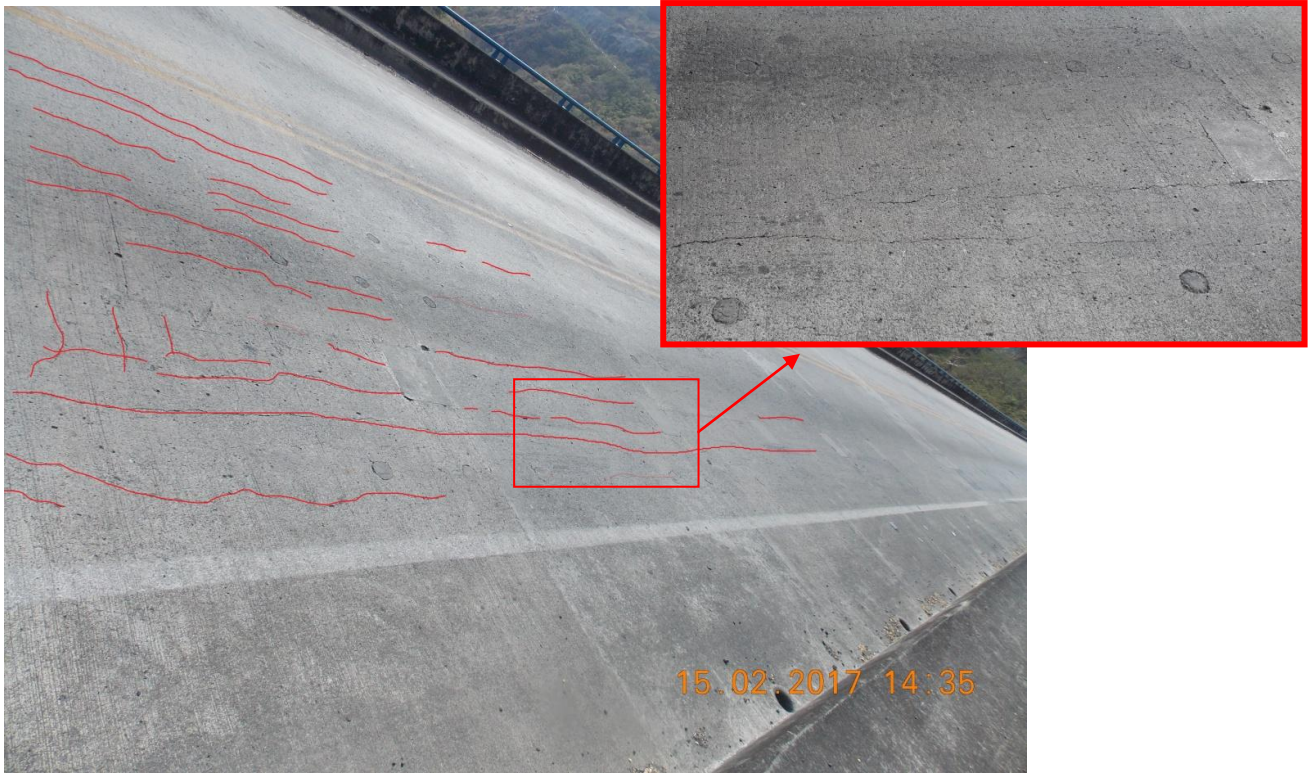
Figura 10. Grietas en sentido paralelo a la dirección del tránsito en cara superior del tablero.
