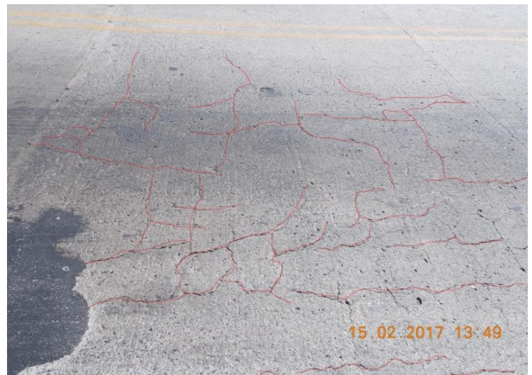
(b) Grietas en dos direcciones ubicadas cerca del centro del puente
