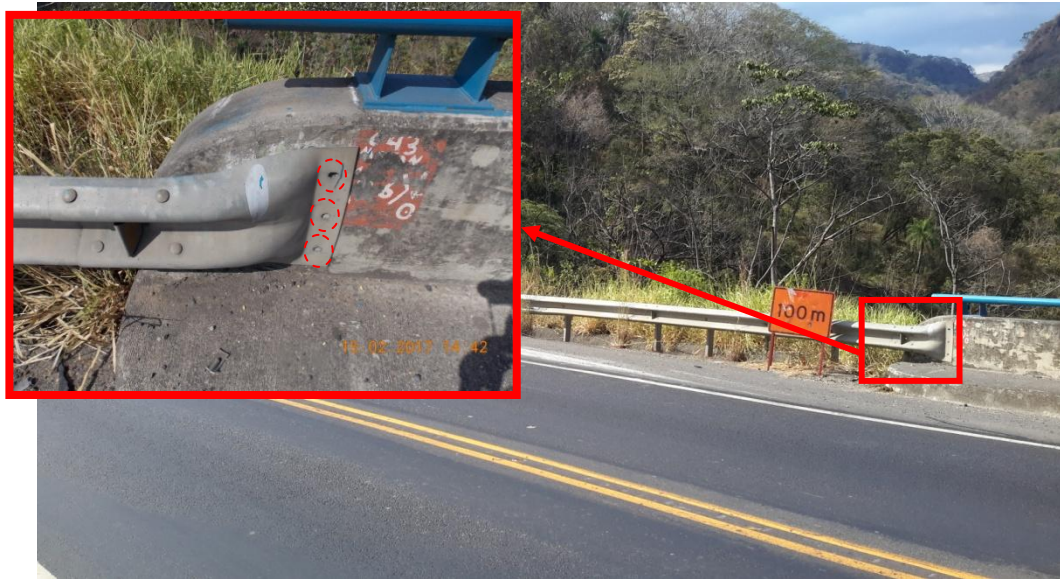
Figura 1. Guardavías del acceso 2 al costado aguas abajo sin tornillos de anclaje
