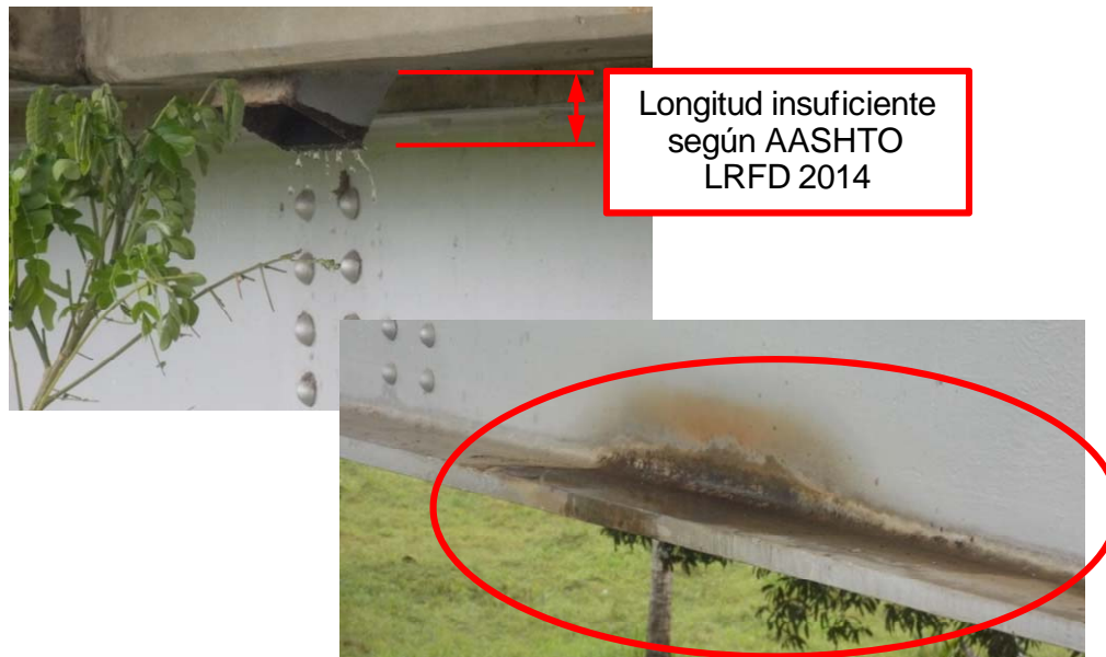
Figura 4. Longitud insuficiente de los ductos de drenaje según los requerimientos de la sección 2.6.6.4 del AASHTO LRFD 2014 y descarga del agua sobre el ala inferior de vigas principales externas.
