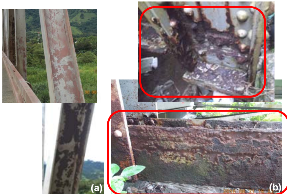
Figura 12. Armaduras de las superestructuras 5, 6 y 7: (a) Deterioro del sistema de protección de pintura y corrosión; (b) Estado de corrosión avanzado con pérdida de sección en cuerda inferior de superestructura 7 en bastión B2.
