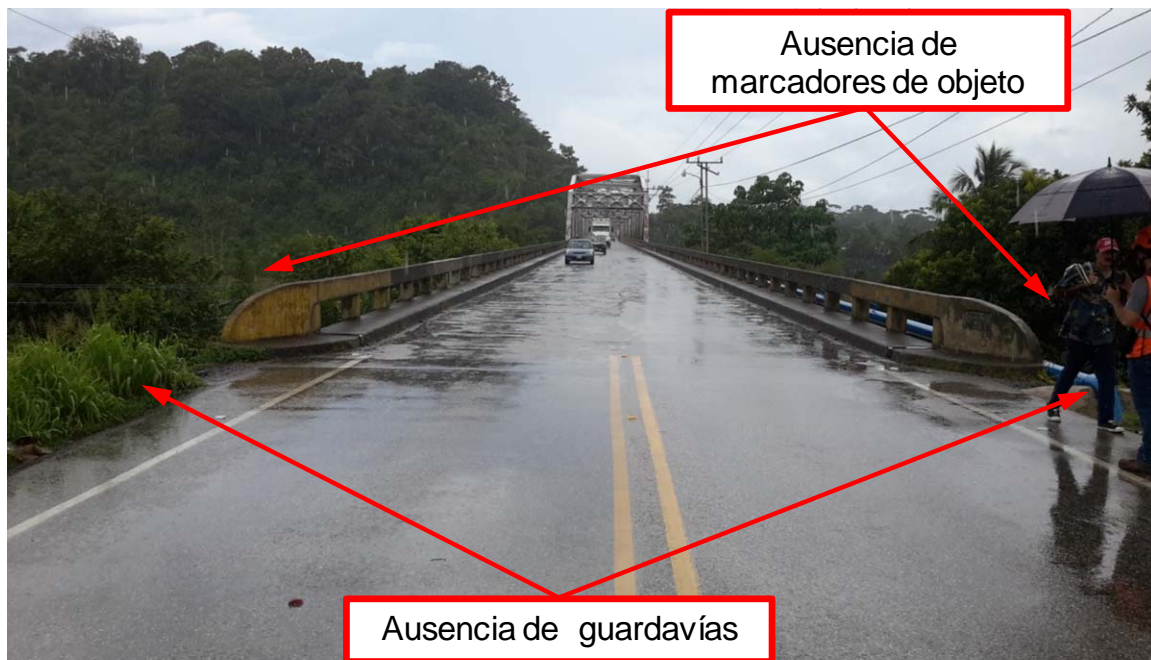
Figura 2. Ausencia marcadores de objeto y guardavías en ambos accesos. Caso del acceso 1.
