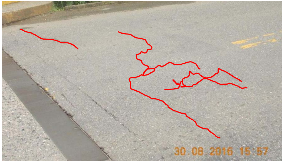
Figura 5. Zona intervenida de la superficie de rodamiento del acceso 2 con evidencia de agrietamiento en ambas direcciones que coinciden con deformaciones permanentes.
