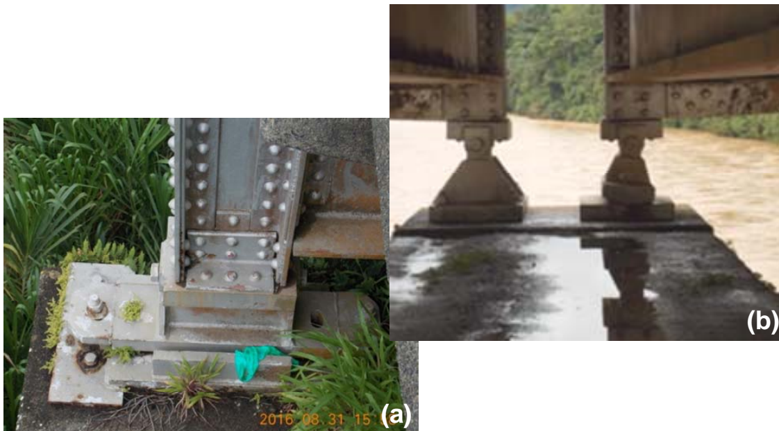
Figura 16. Apoyos en pilas: (a) Zonas con corrosión superficial, acumulación de sedimentos y crecimiento de vegetación; (b) Acumulación de agua y apoyo móvil de superestructura 7 con desplazamiento en pila P6.
