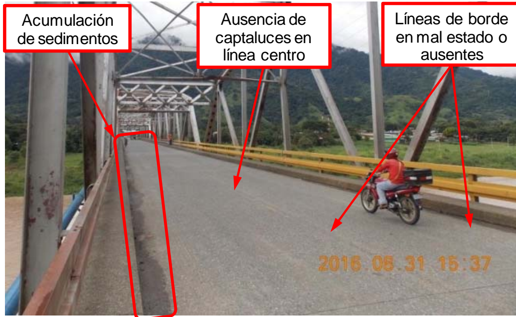
Figura 3. Estado de conservación deficiente de la señalización así como acumulación de sedimentos en los bordillos.
