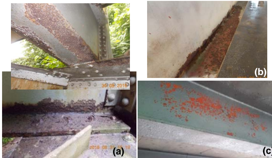
Figura 14. Deterioro del sistema de protección de pintura y corrosión en elementos de superestructuras 5, 6 y 7: (a) Estado de corrosión avanzado con pérdida de sección en vigas transversales cerca de bastión B2; (b) Corrosión en viga transversal de superestructura 6 en pila P6; (c) Deterioro en sistema de protección de pintura de viga de piso, superestructura 7.
