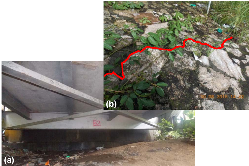
Figura 17. Zona de los bastiones: (a) Filtración de agua en 100% del área de la viga cabezal del bastión B2; (b) Grieta en protección del talud frente al bastión B1; vista superior.
