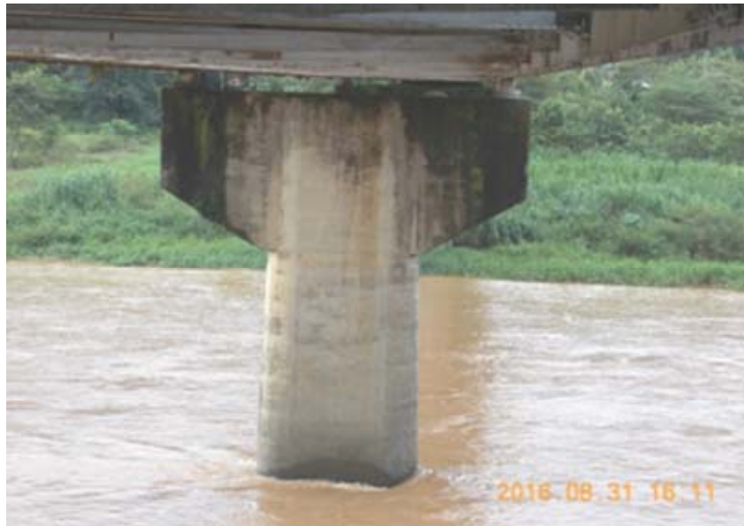
Figura 18. Filtración de agua en aproximadamente 50% del área de la viga cabezal en pilas; caso de la pila P6.
