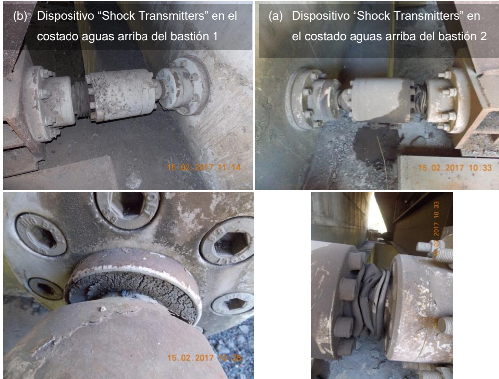
Figura 20. Deterioro por falta de mantenimiento en dispositivos “Shock Transmitters”.
