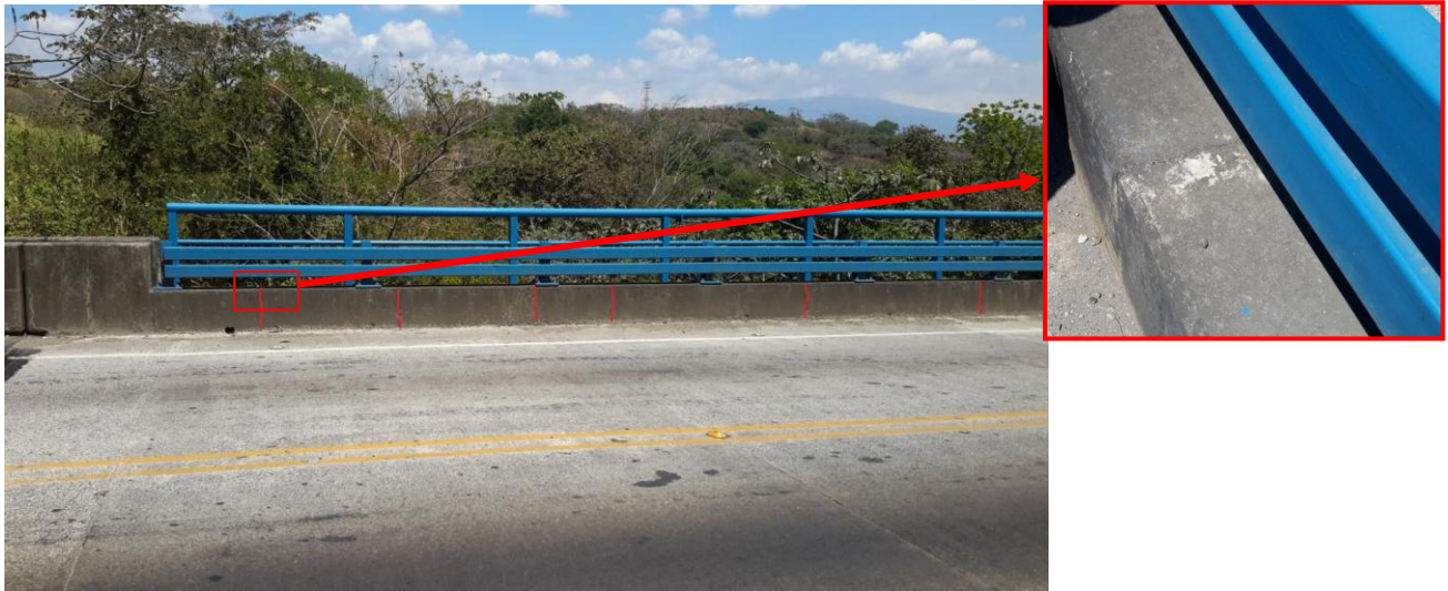
Figura 1. Grietas en murete de la barrera vehicular.
