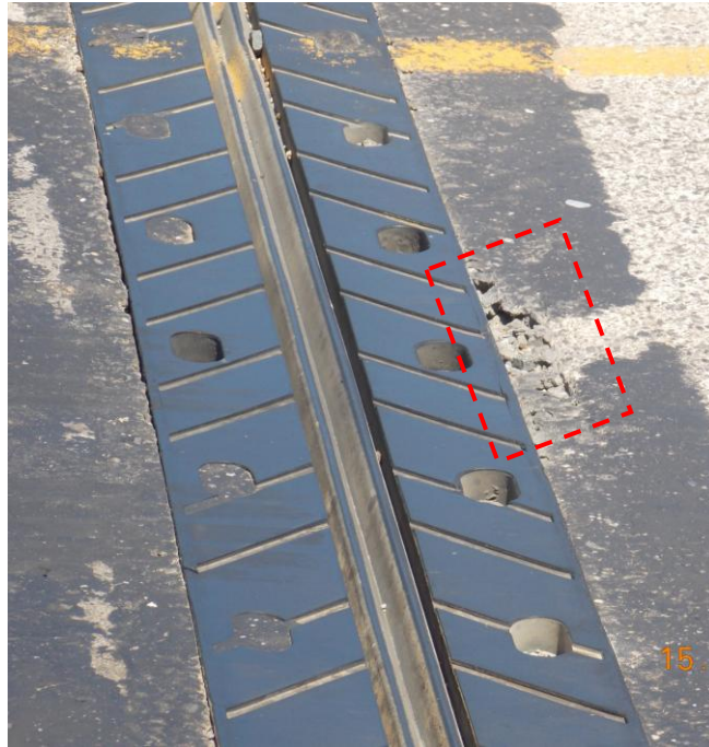
Figura 7. Desprendimiento de concreto en borde de junta de expansión 2.
