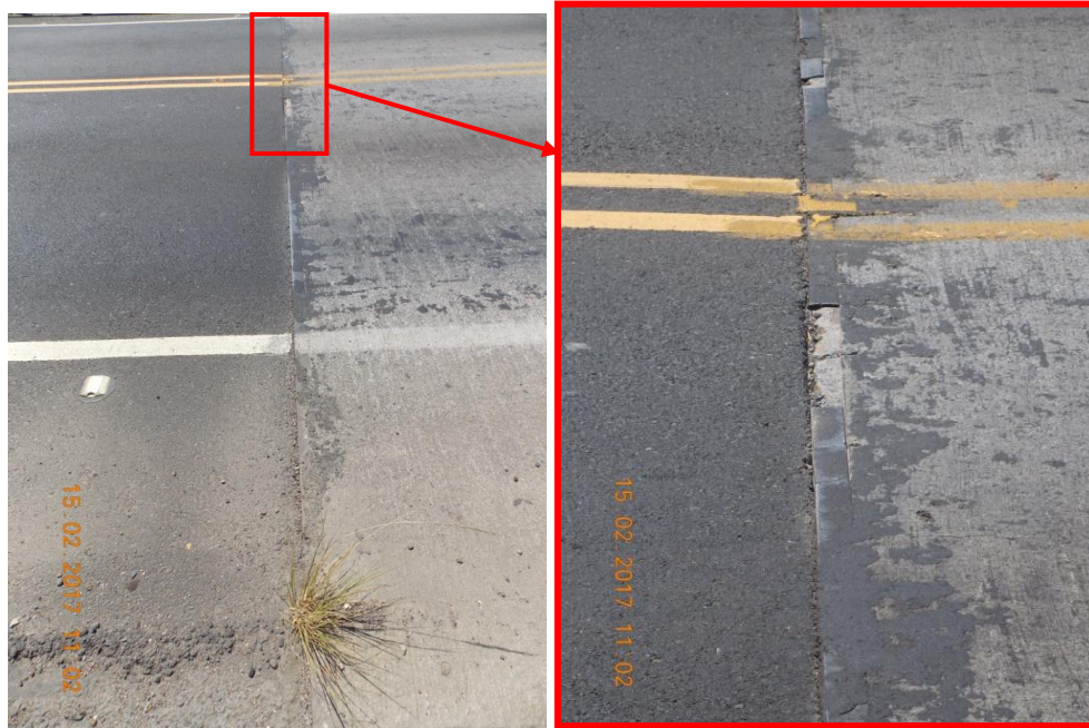
Figura 12. Desprendimiento del angular de protección de la losa de aproximación en la junta entre la losa de aproximación y la carpeta asfáltica del acceso 1.
