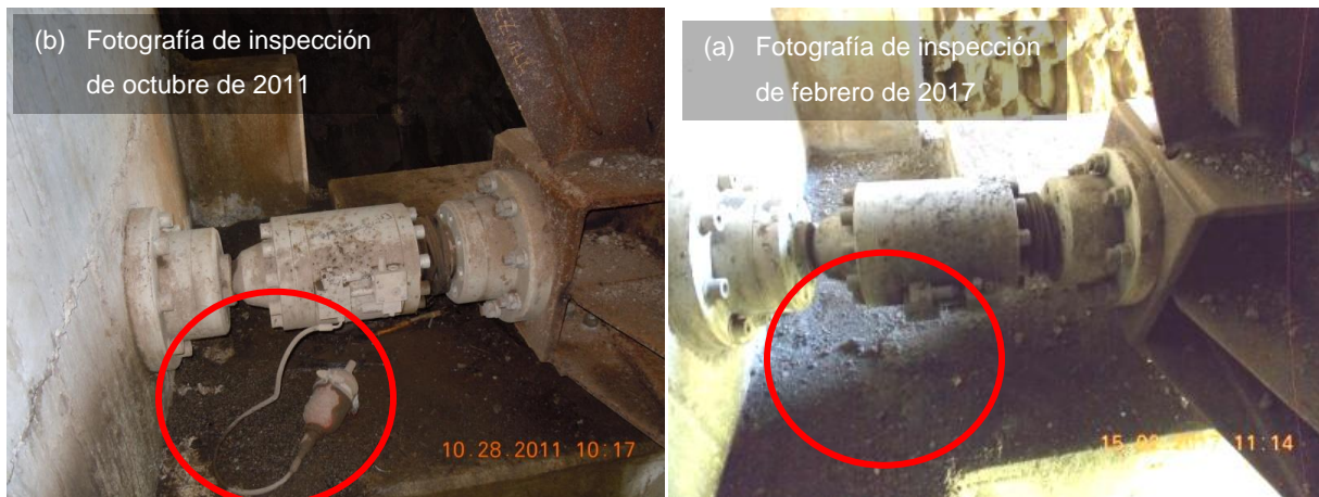
Figura 21. Ausencia de elemento relacionado con el flujo de aceite en dispositivos “Shock Transmitters”.
