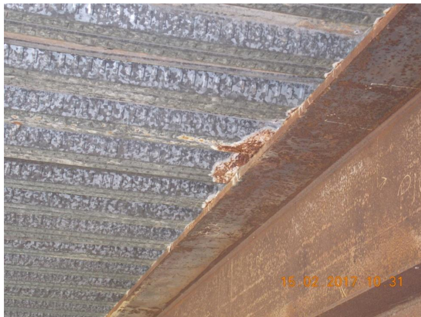
Figura 15. Mancha blanca puntual en lámina metálica de la cara inferior de la losa sobre viga principal del costado aguas arriba.
