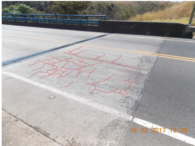
Figura 11. Grietas en dos direcciones en la losa de aproximación (Vista de la losa de aproximación del acceso 2).
