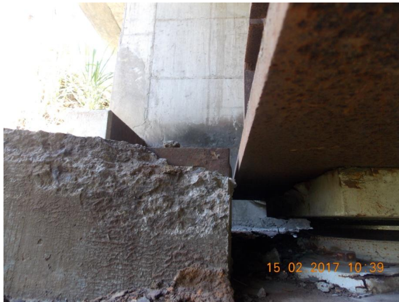
Figura 19. Desprendimiento de concreto en esquina de bloque antisísmico del costado aguas abajo del bastión 2.
