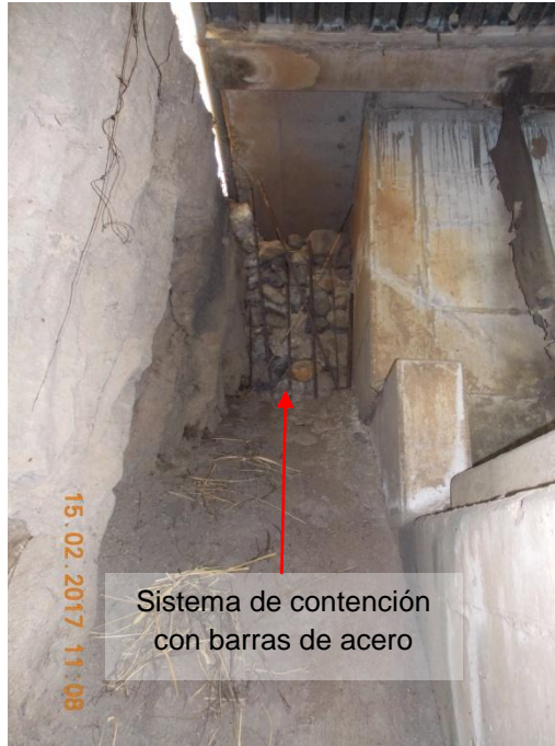
Figura 10. Talud en el costado aguas arriba al bastión 1 con vulnerabilidad a deslizamientos.
