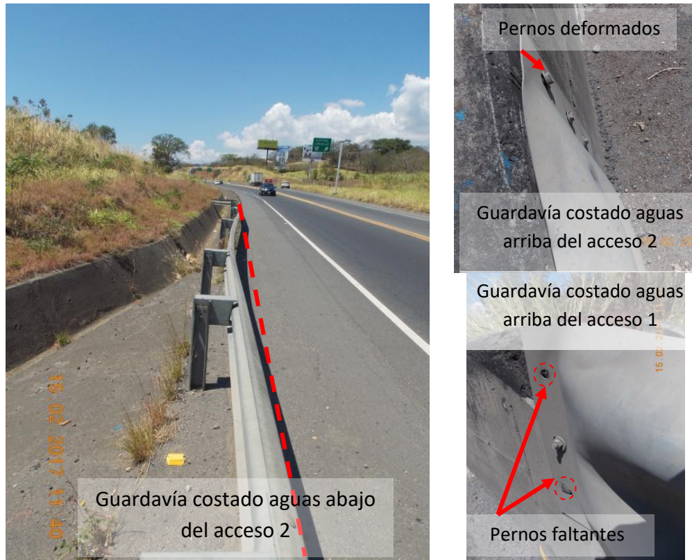
Figura 2. Guardavía deformado y deficiencias en sistema de anclaje de guardavías a barrera rígida del puente.
