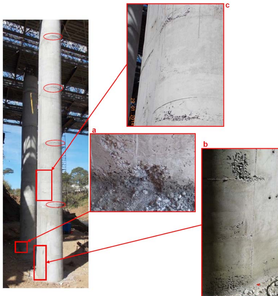
Figura 2. Ejemplos de nidos de piedra en columnas de la pila del eje 3 (según planos estructurales). Fecha: Febrero, 2014.
