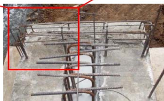
Figura 5. Diferencia con respecto a planos estructurales del refuerzo utilizado en el bloque cortante Este de la pila sobre el eje 3.
