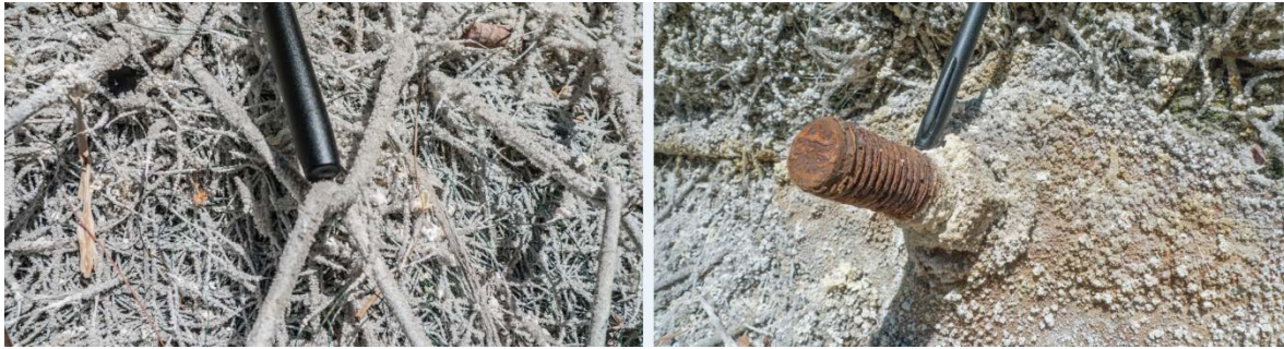
a) b) Figura 51 Mineralización y oxidación de materiales en talud
