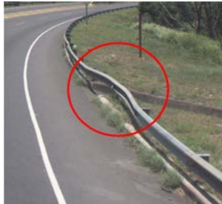
Caldera - San José Est. 38+410 d)
