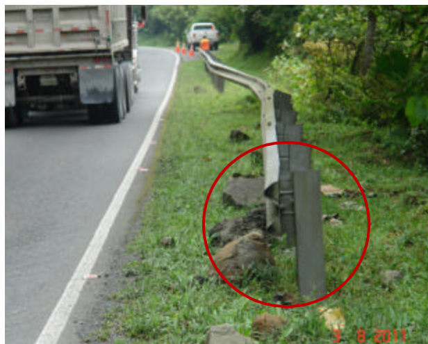
Fotografía 10. SCV sin terminal adecuada. Ubicación: Ubicación: Kilómetro 28, Ruta Nacional N°32 Fecha: 3 Agosto 2011, Fuente: LanammeUCR
