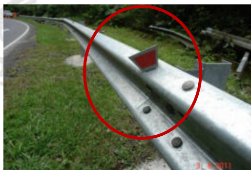
Fotografía 9. Captafaro colocado en punto no dispuesto para ese fin. Ubicación: 130 m antes del Túnel, sentido San José-Limón Fecha: 3 Agosto 2011, Fuente: LanammeUCR
