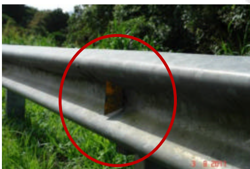
Fotografía 8. Captafaro con suciedad. Ubicación: 100 m de la Estación del Peaje, sentido San José-Limón Fecha: 3 Agosto 2011, Fuente: LanammeUCR
