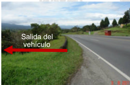
Fotografía 2. Ejemplo de SCV que no cubre la totalidad del obstáculo. Ubicación: 1,3 km de la estación del Peaje, sentido San José-Limón Fecha: 3 Agosto 2011, Fuente: LanammeUCR
