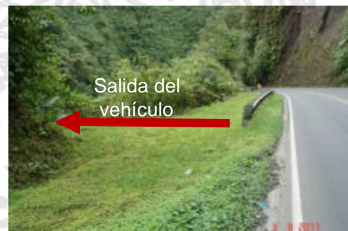
Fotografía 3. Ejemplo de SCV que no cubre la totalidad del obstáculo. Ubicación: 300m después del Túnel, sentido San José-Limón Fecha: 3 Agosto 2011, Fuente: LanammeUCR
