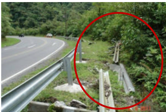
Fotografía 6. Barreras sustituidas no fueron retiradas del sitio.
