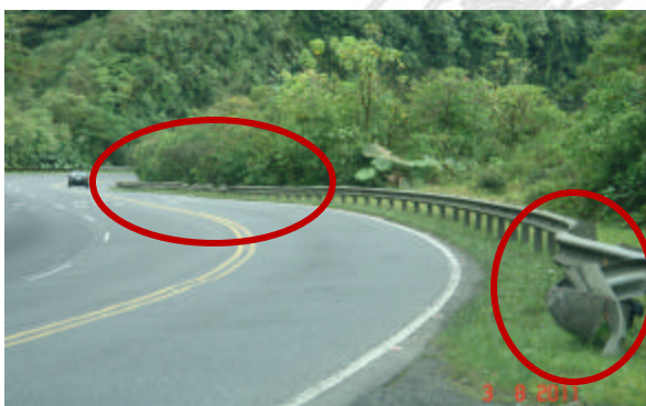
Fotografía 4. Curva sinuosa con el SCV colisionado en varios tramos.
