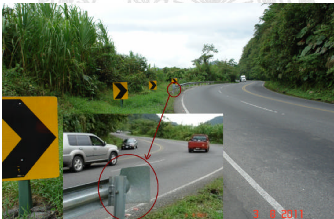
Fotografía 11. Uso de “cola de pez” como terminal. Ubicación: Kilómetro 25, Ruta Nacional N°32 Fecha: 3 Agosto 2011, Fuente: LanammeUCR
