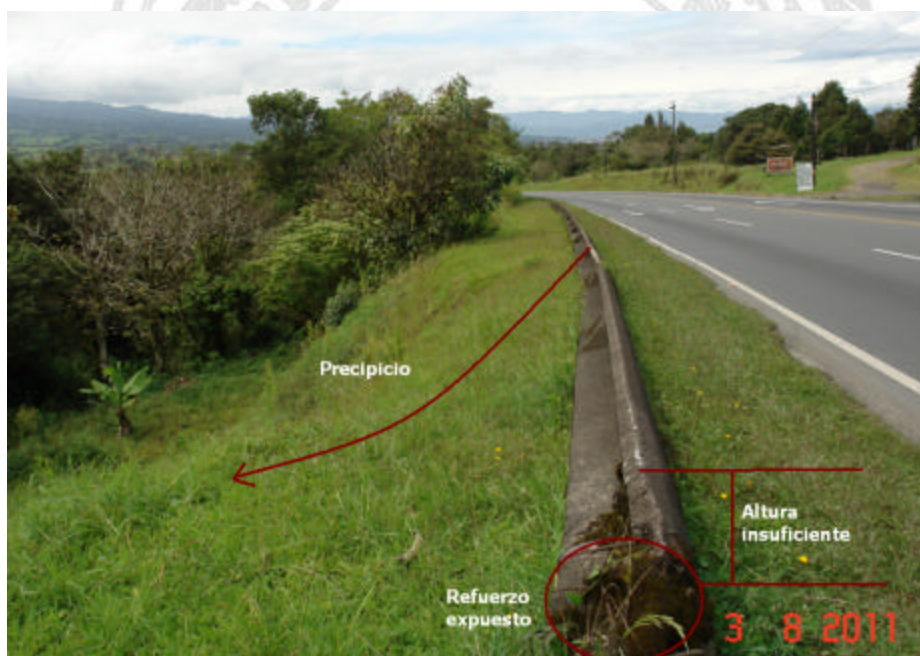
Fotografía 1. Ejemplo de barrera que no se encuentra clasificada en la guía de AASHTO. Ubicación: Kilómetro 14,9 de la Ruta Nacional N° 32. Fecha: 03 de agosto 2011, Fuente: LanammeUCR.
