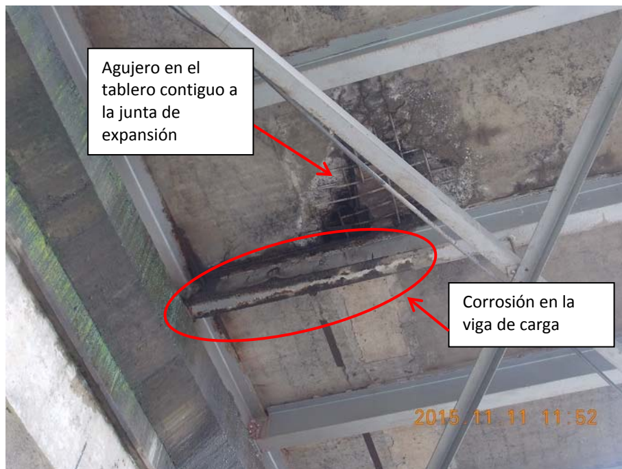
Figura 14. Agujero en el tablero y corrosión en viga de carga. Fotografía del día 11 de noviembre del año 2015.
