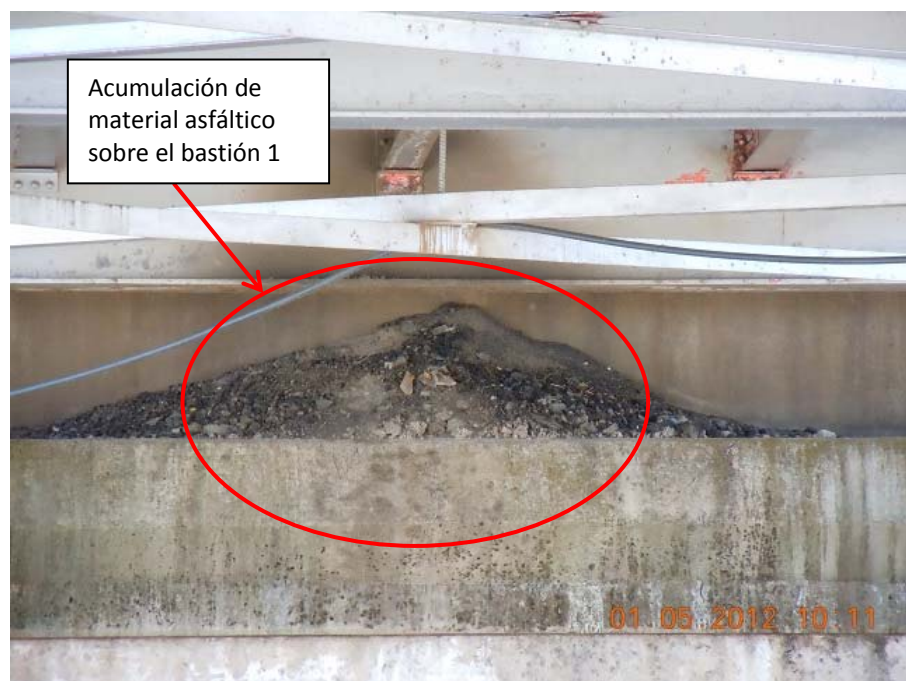
Figura 8. Acumulación de asfalto sobre el bastión 1, material utilizado para rellenar el hueco en el tablero. Foto del día 5 de enero del año 2012.
