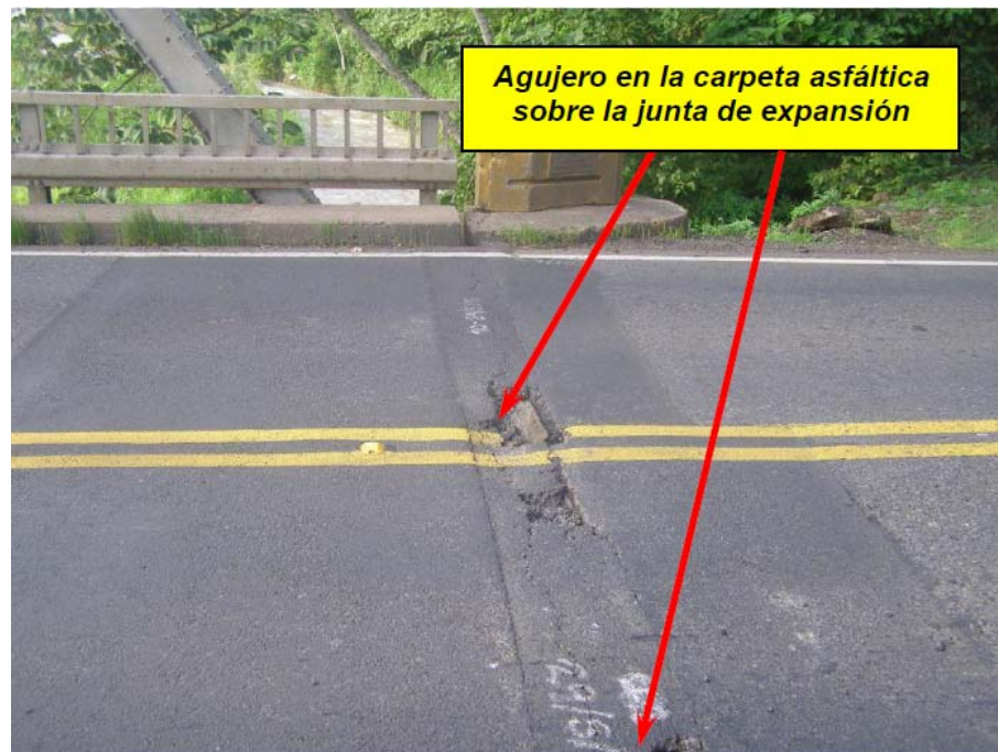
Figura 7. Fotografía tomada del informe de inspección visual de noviembre del 2011 [ref. 3] presentado el estado observado de la junta.
