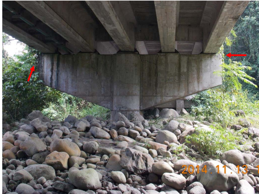
Figura 13. Manchas de humedad en la pila y maleza que ha crecido cerca de los apoyos.
