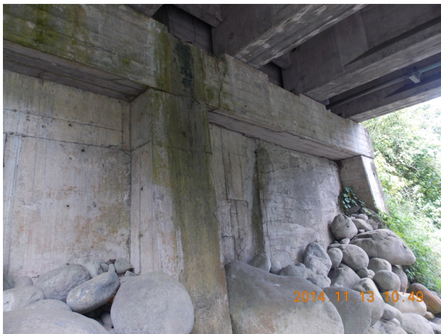
Figura 12. Manchas de humedad en los elementos del bastión 2.
