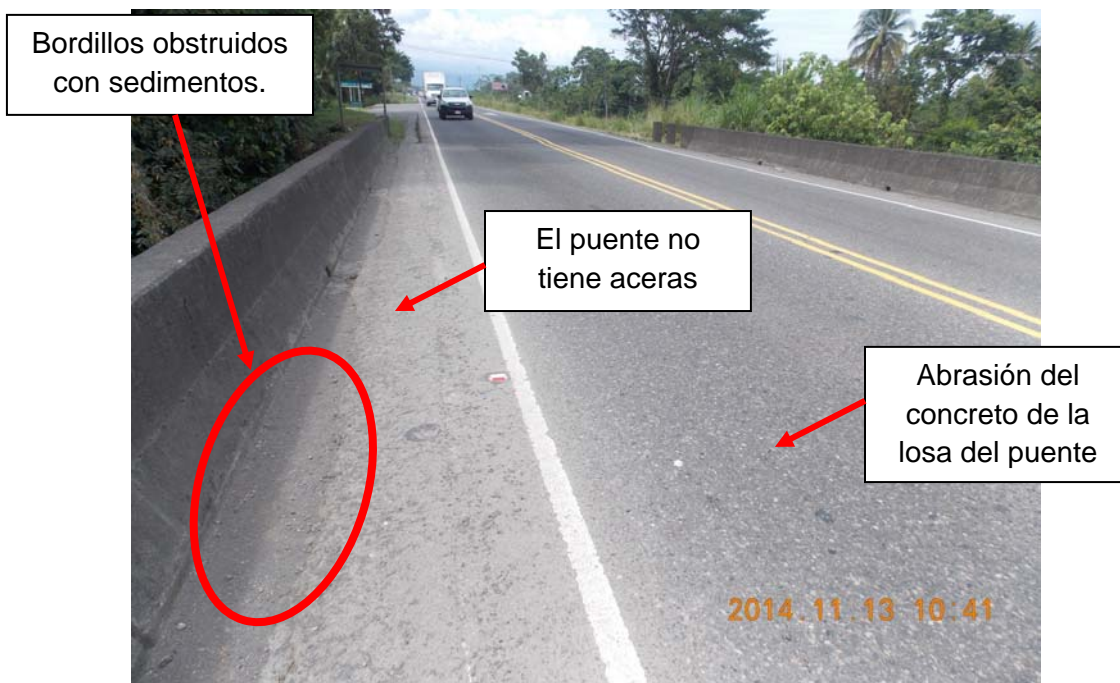
Figura 2. Ausencia de aceras, bordillos obstruidos con sedimentos, demarcación y captaluces en buen estado. Desgaste de la losa del puente.
