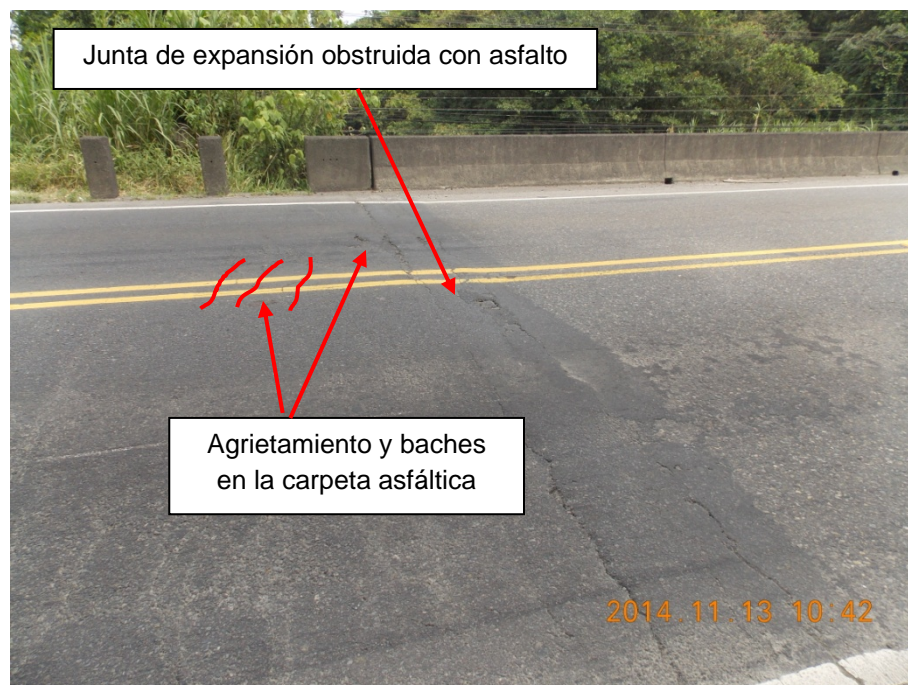
Figura 6. Junta de expansión obstruida con asfalto sobre el bastión 2.
