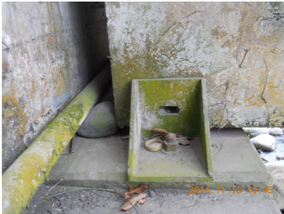
Figura 11. Pernos faltante en elementos de apoyo sobre el bastión 2 y musgo cubriendo el elemento debido a ambiente húmedo.
