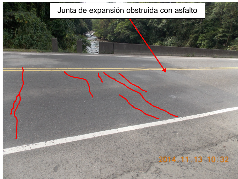
Figura 5. Junta de expansión obstruida con asfalto sobre el bastión 1. Agrietamiento en el pavimento del acceso 1.
