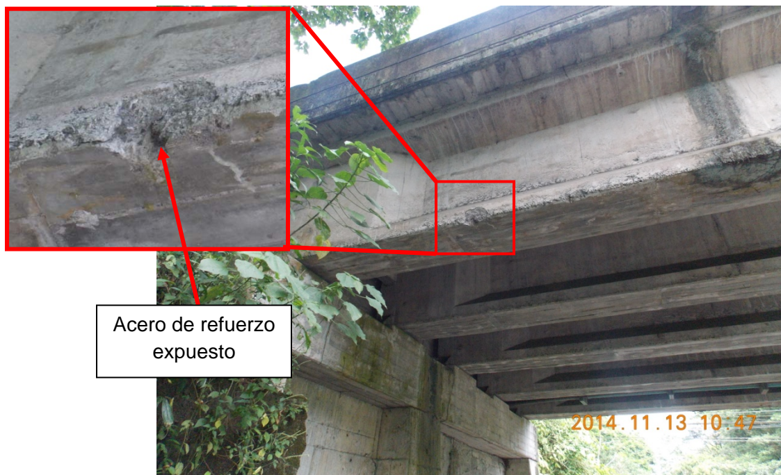
Figura 8. Desprendimiento de concreto con acero de refuerzo expuesto en viga externa sur de la superestructura 2.
