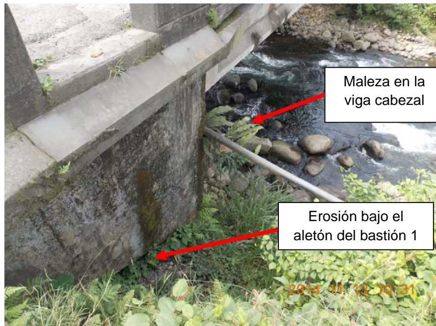
Figura 7. Erosión bajo el aletón norte del bastión 1 y maleza que ha crecido en la zona de apoyos del bastión 1.
