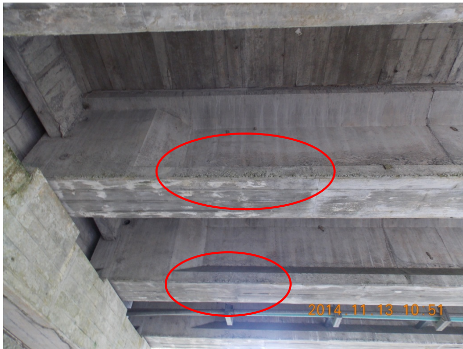
Figura 9. Nidos de piedra generalizados en vigas de concreto.
