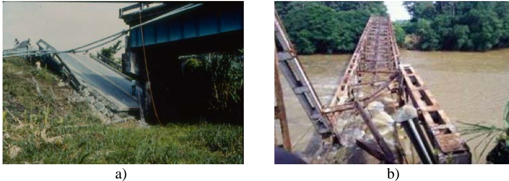
Figura 1.- a) Colapso de tramo del puente sobre el Río Chirripó, terremoto de Limón 1991 ( LANAMME-UCR 1991 ), b) colapso total puente sobre el Río Sarapiquí, terremoto de Samara 2012 ( EP 2012 )
