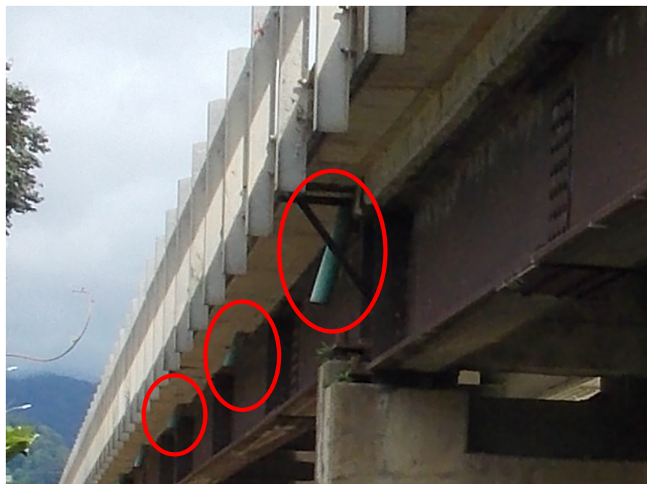
Figura 6: Tubos de extensión de los drenajes con longitud insuficiente.
