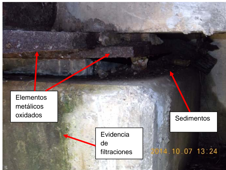
Figura 14: Apoyo en contacto con sedimentos y elementos metálicos con oxidación
