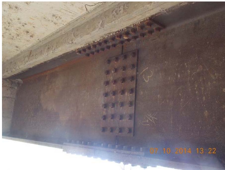
Figura 10: Oxidación generalizada en viga de acero y conexión.
