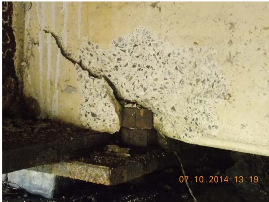
Figura 13: Desprendimiento de concreto de la viga por contacto con el apoyo
