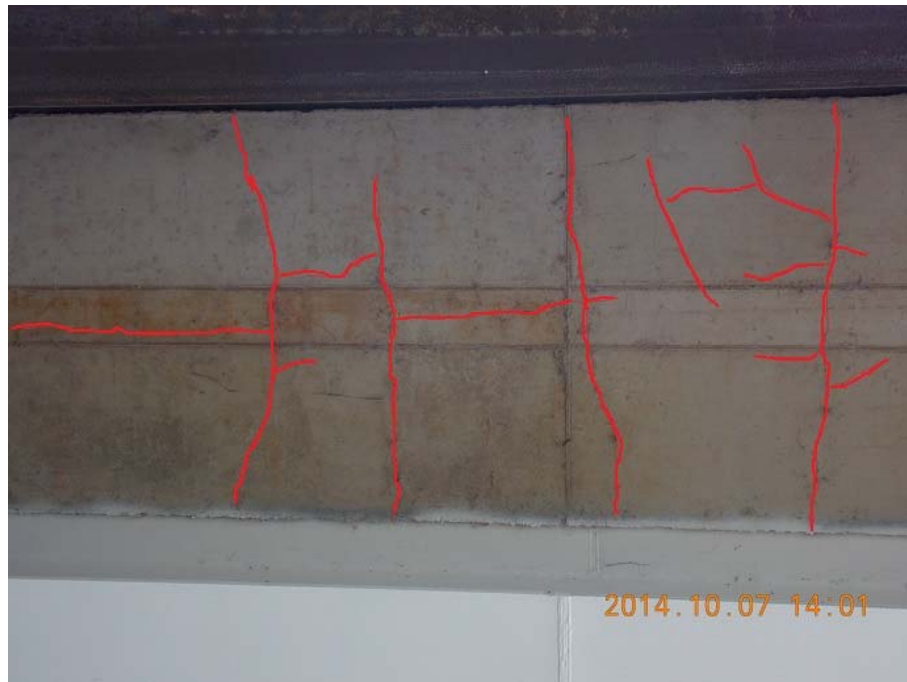
Figura 9: Agrietamiento en dos direcciones en la cara inferior del tablero en el tramo 3.
