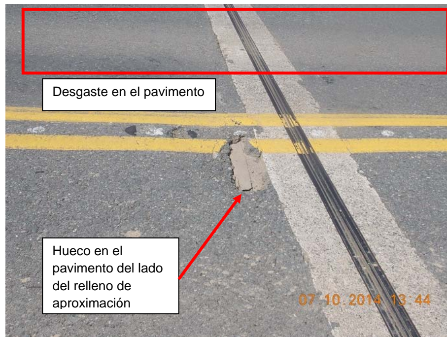
Figura 4: Desgaste en el pavimento del acceso oeste.
