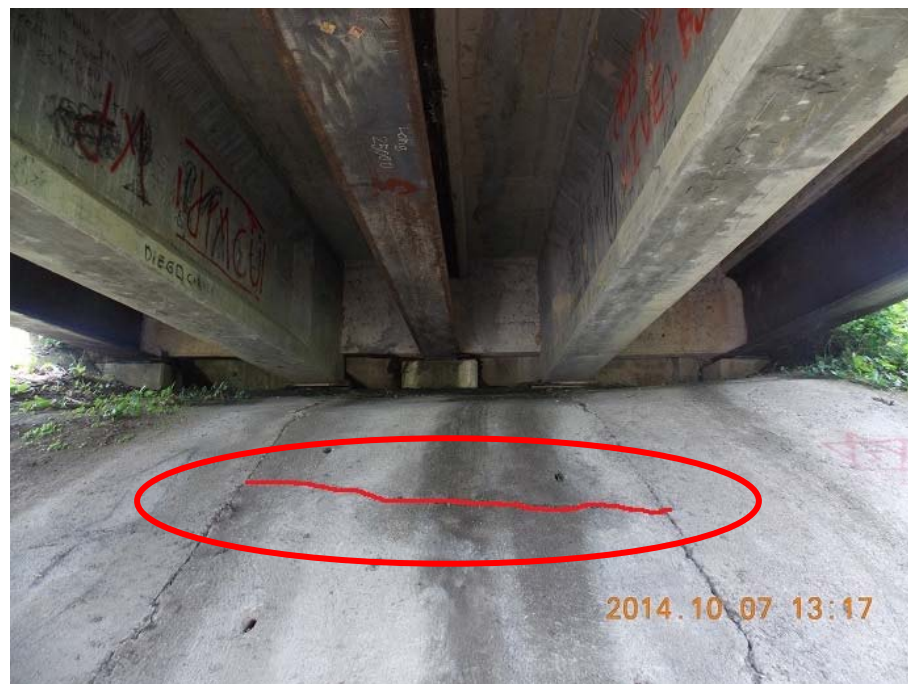
Figura 16: Agrietamiento de la protección frente al bastión 2 (oeste).
