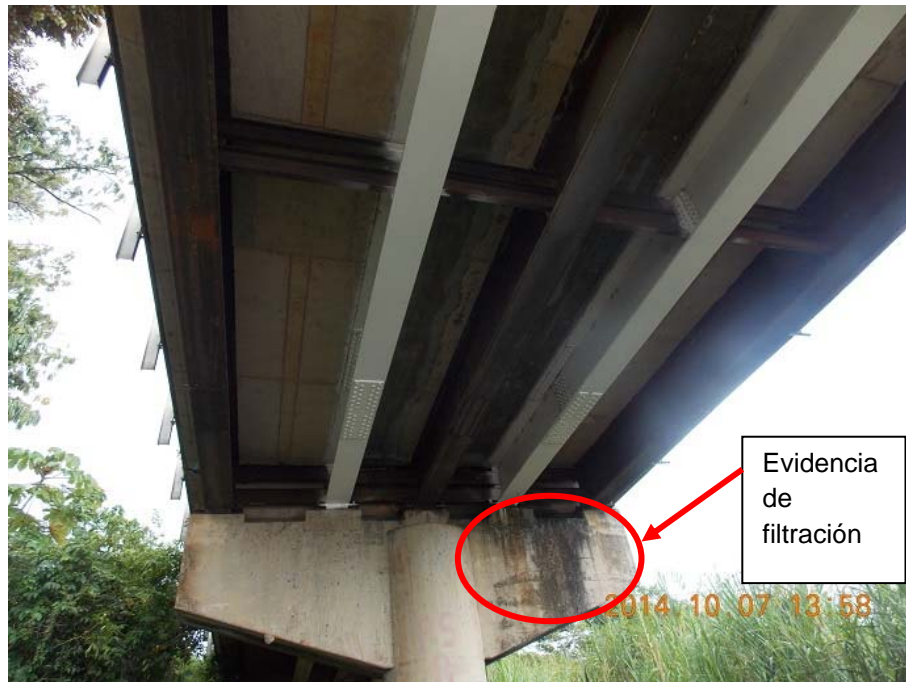
Figura 11: Oxidación en 3 de las 5 vigas del tramo 2 y los diafragmas y filtración sobre pila 2
