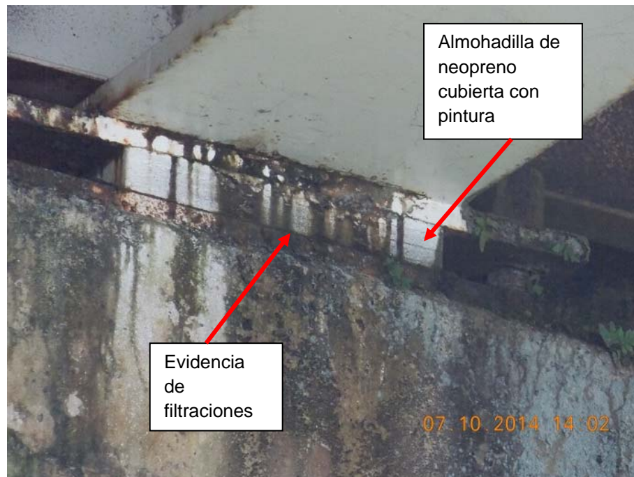
Figura 15: Apoyo expuesto a filtraciones. Las almohadillas de neopreno fueron pintadas.
