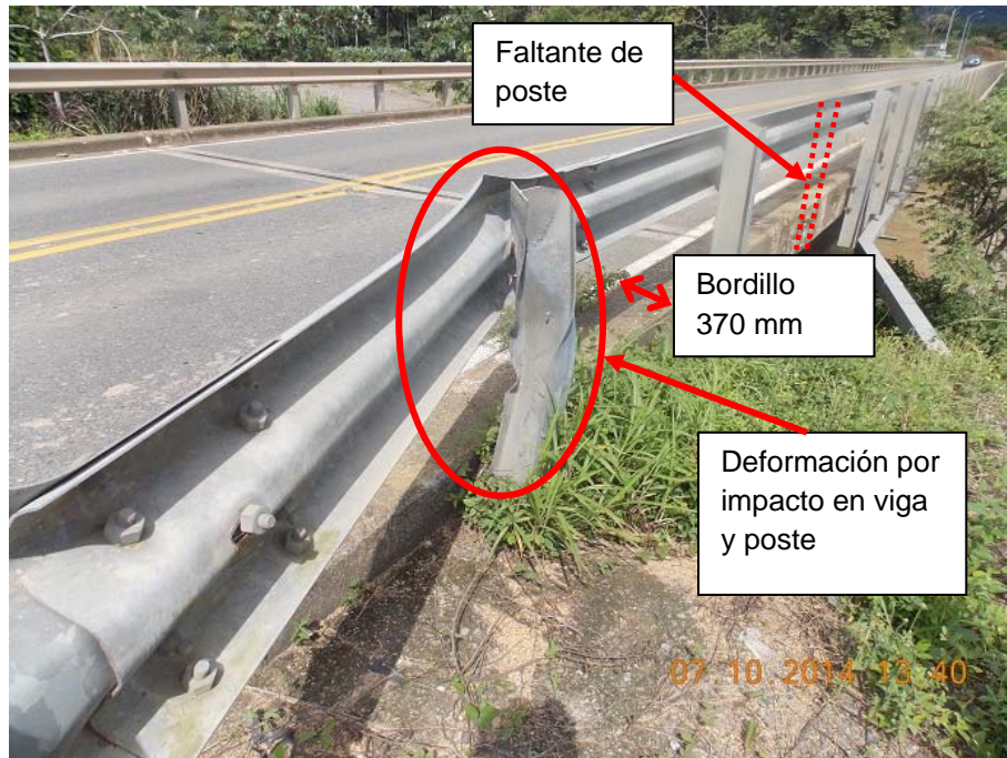
Figura 2: Deformación en barrera vehicular del costado sur
