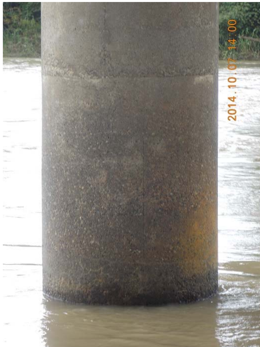
Figura 17: Abrasión en la columna de la pila 2.
