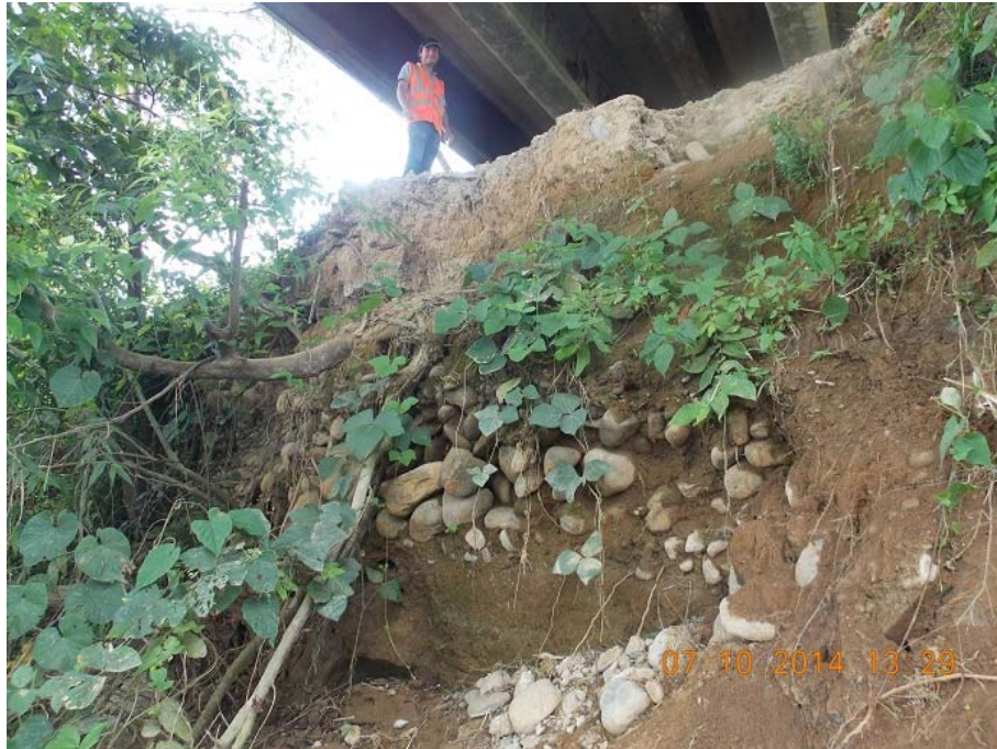
Figura 7: Erosión de la margen izquierda (oeste).
