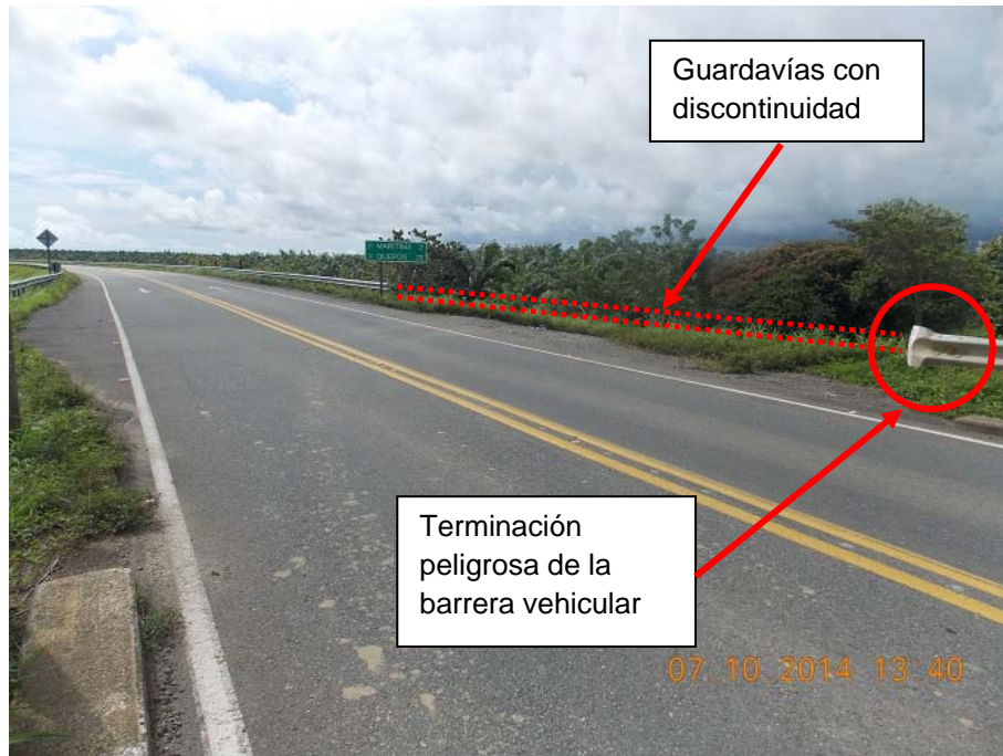
Figura 1: Guardavías incompleto y la terminación peligrosa de la barrera vehicular
