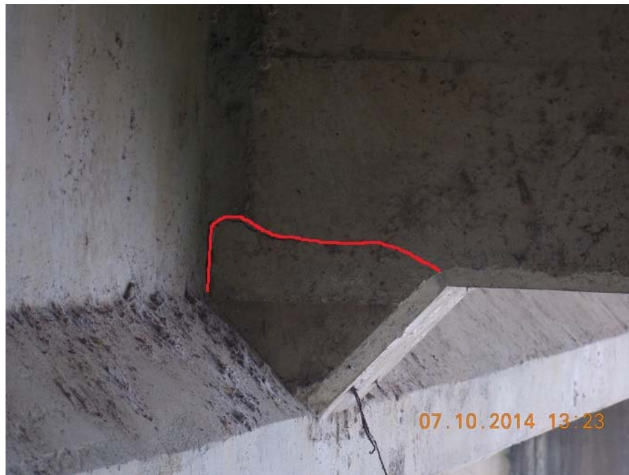
Figura 12: Agrietamiento en viga diafragma
