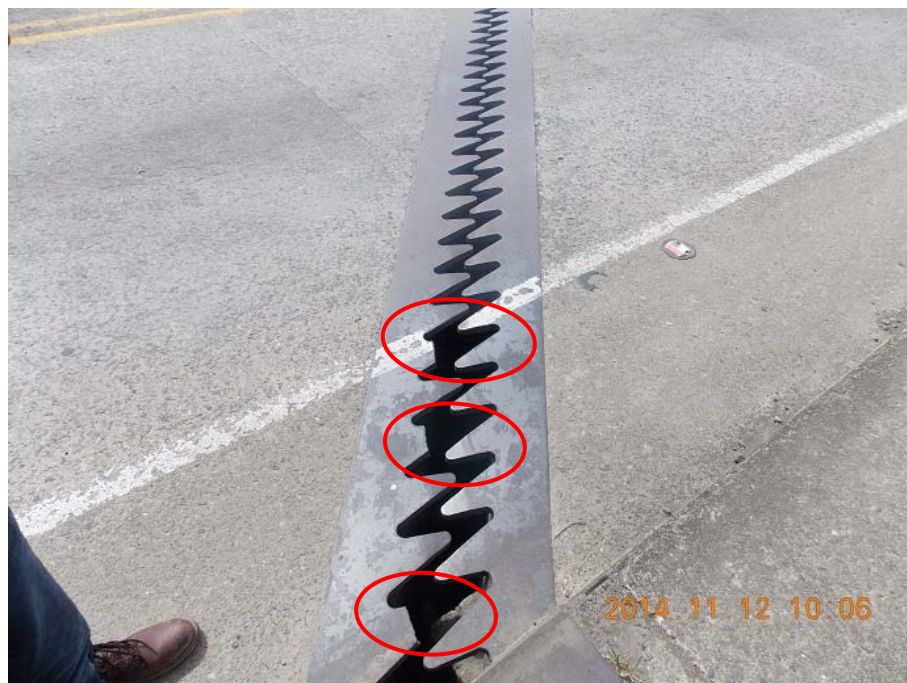
Figura 7: Daños en junta dentada entre superestructuras 1 y 2.
