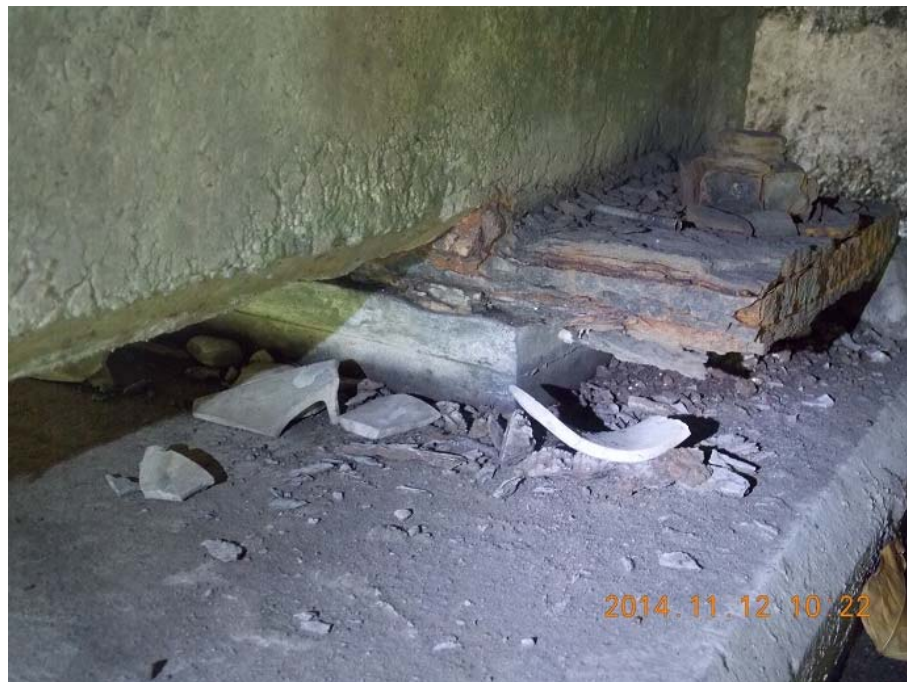
Figura 14: Corrosión en elementos metálicos de apoyo fijo sobre bastión 2.
