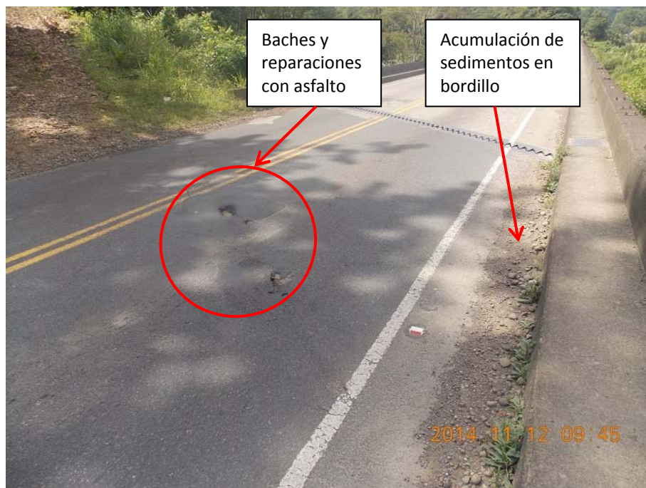
Figura 8: Daños en superficie de rodamiento del acceso 1.
