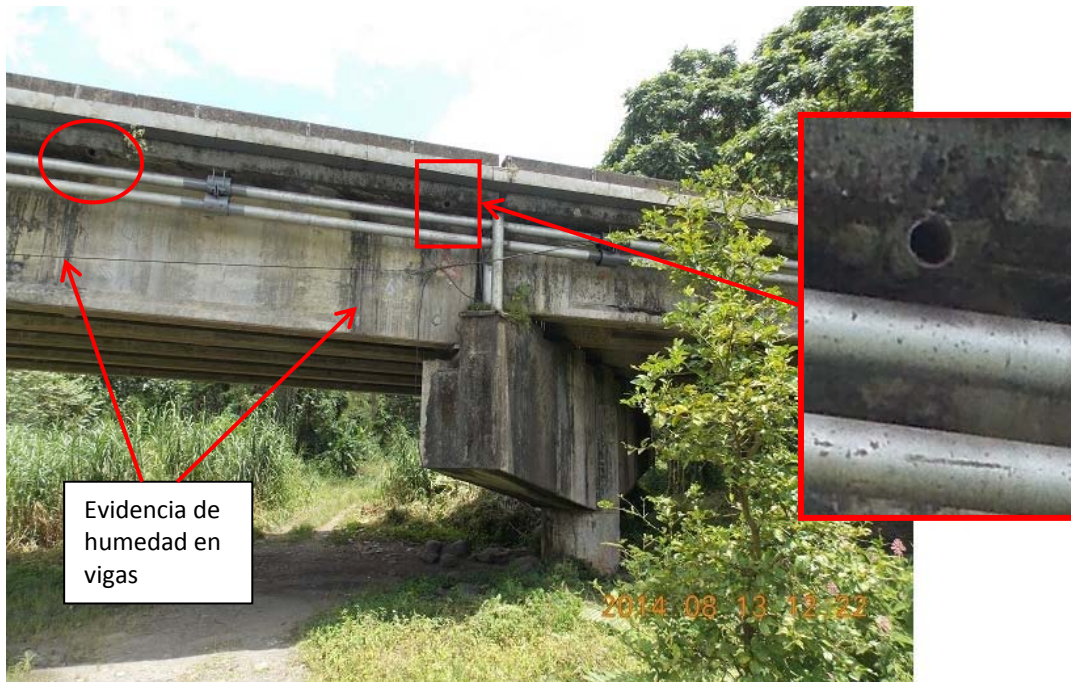
Figura 6: Drenajes sin tubos de extensión y evidencia de filtraciones sobre vigas.
