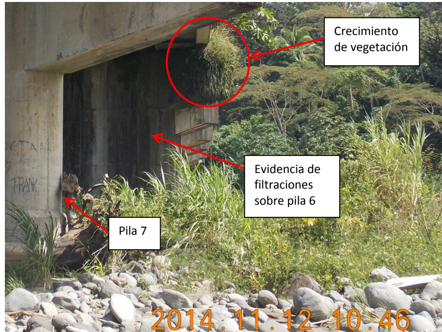
Figura 17: Evidencia de filtraciones y crecimiento de vegetación sobre la pila 6.
