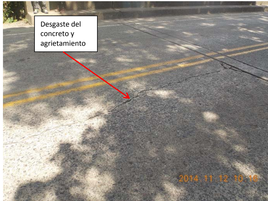
Figura 9: Daños en losa de aproximación del acceso 2.
