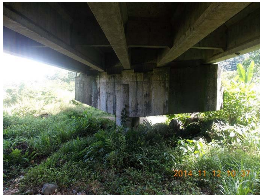
Figura 18: Evidencia de filtraciones sobre la pila 9.
