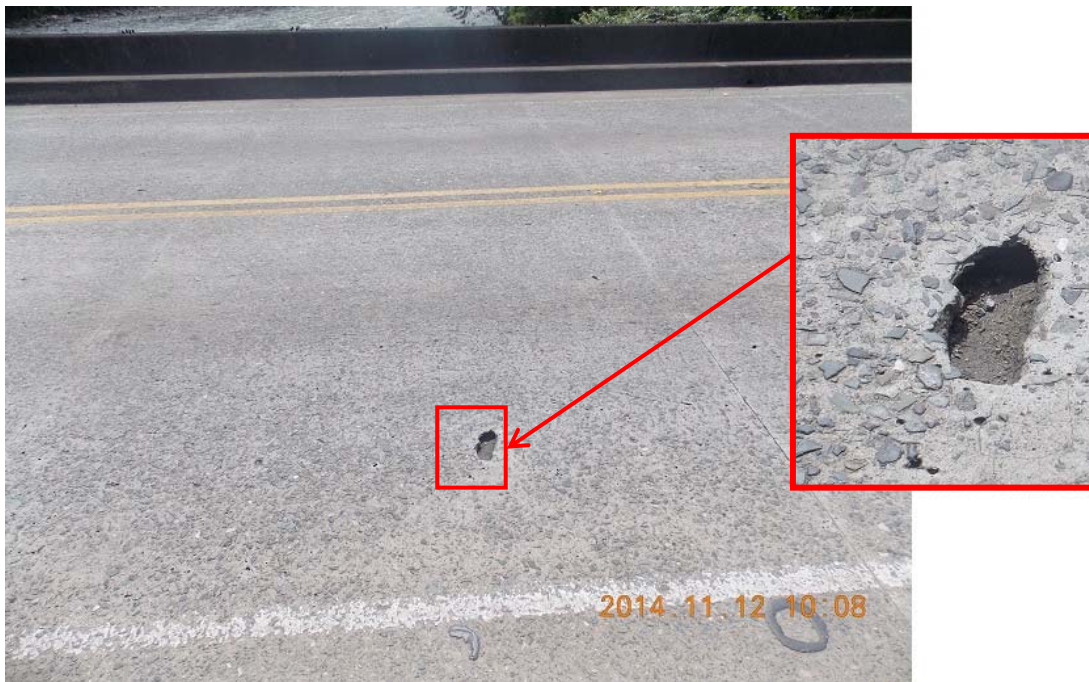
Figura 12: Desgaste y agujeros en la losa del tablero.
