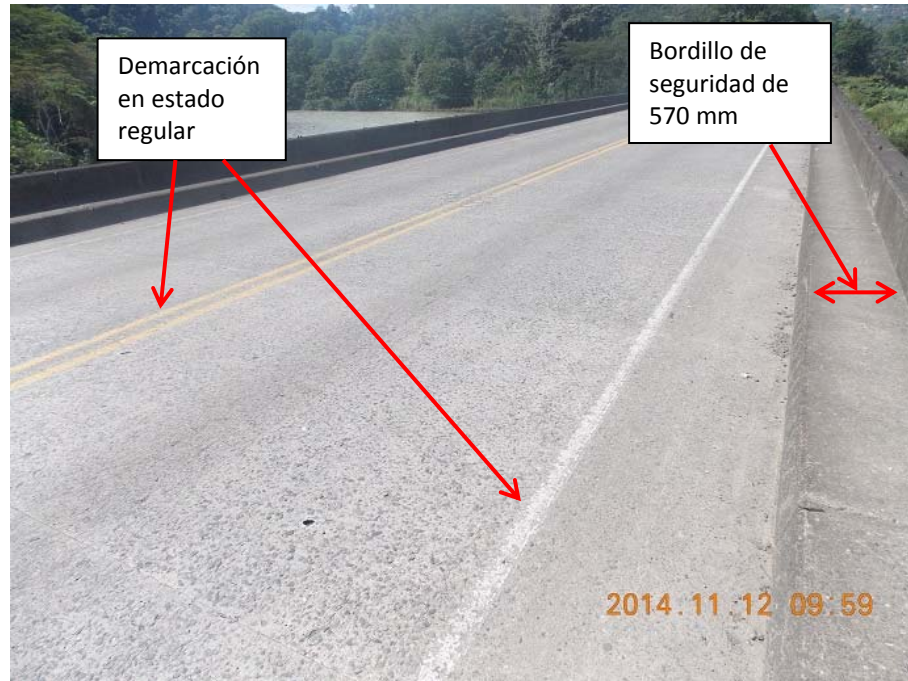
Figura 3: Ausencia de acera y estado de la demarcación
