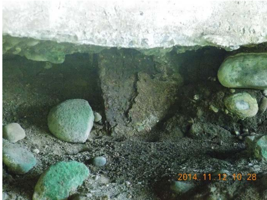
Figura 19: Corrosión en pilote expuesto del bastión 2.
