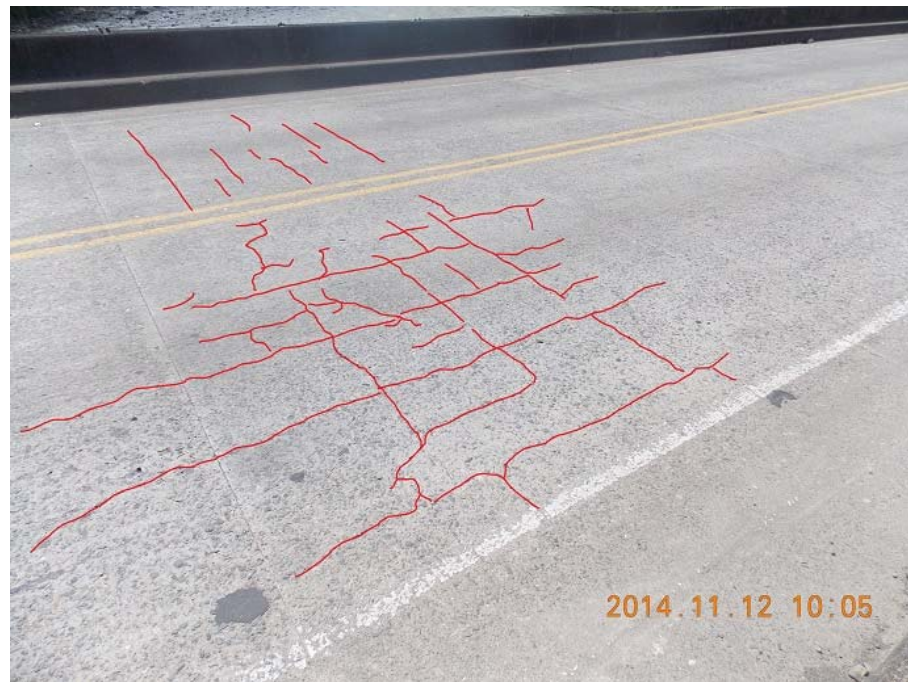
Figura 10: Agrietamiento en dos direcciones en la losa del tablero.
