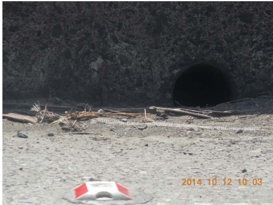
Figura 5: Acumulación de sedimentos frente a drenaje
