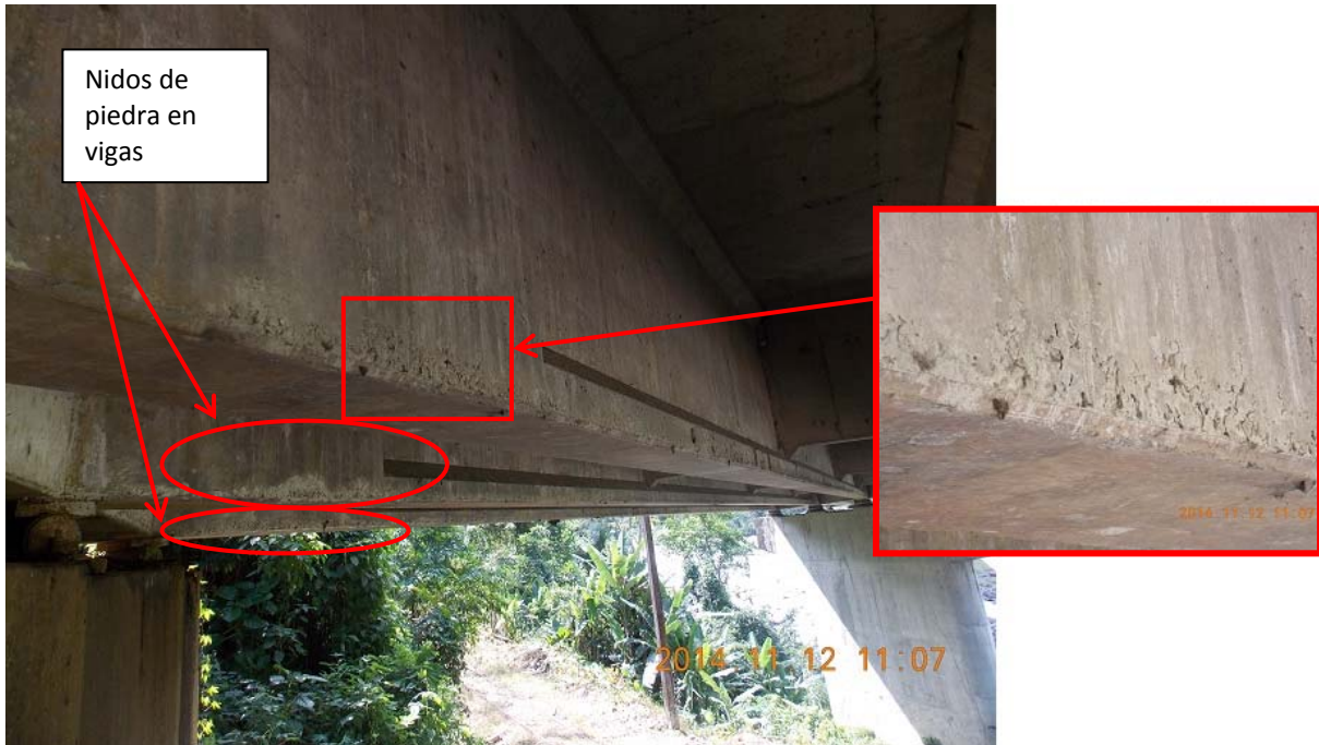
Figura 13: Nidos de piedra en vigas del tramo 1.
