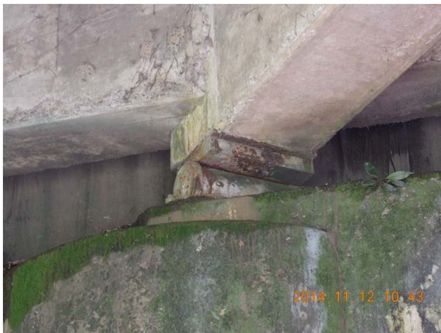
Figura 15: Piquetes de óxido en apoyo de rodillo sobre pila 9.
