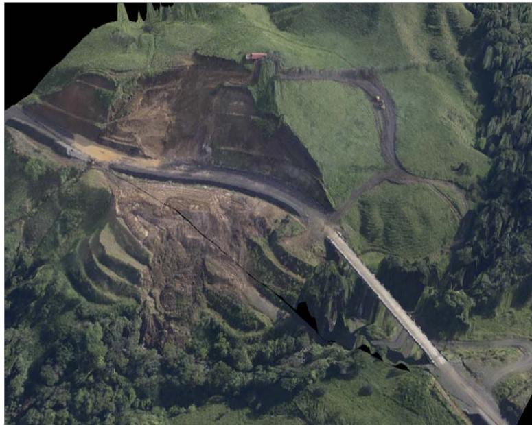
Figura No.2 Imagen del deslizamiento en el kilómetro 25+300 generada con la tecnología LIDAR y suministrada a la Administración del proyecto.
