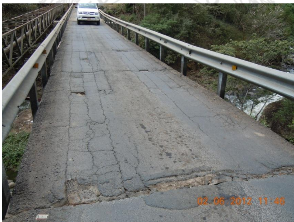
Figura 4. Agrietamiento generalizado de la sobrecapa de asfalto.
