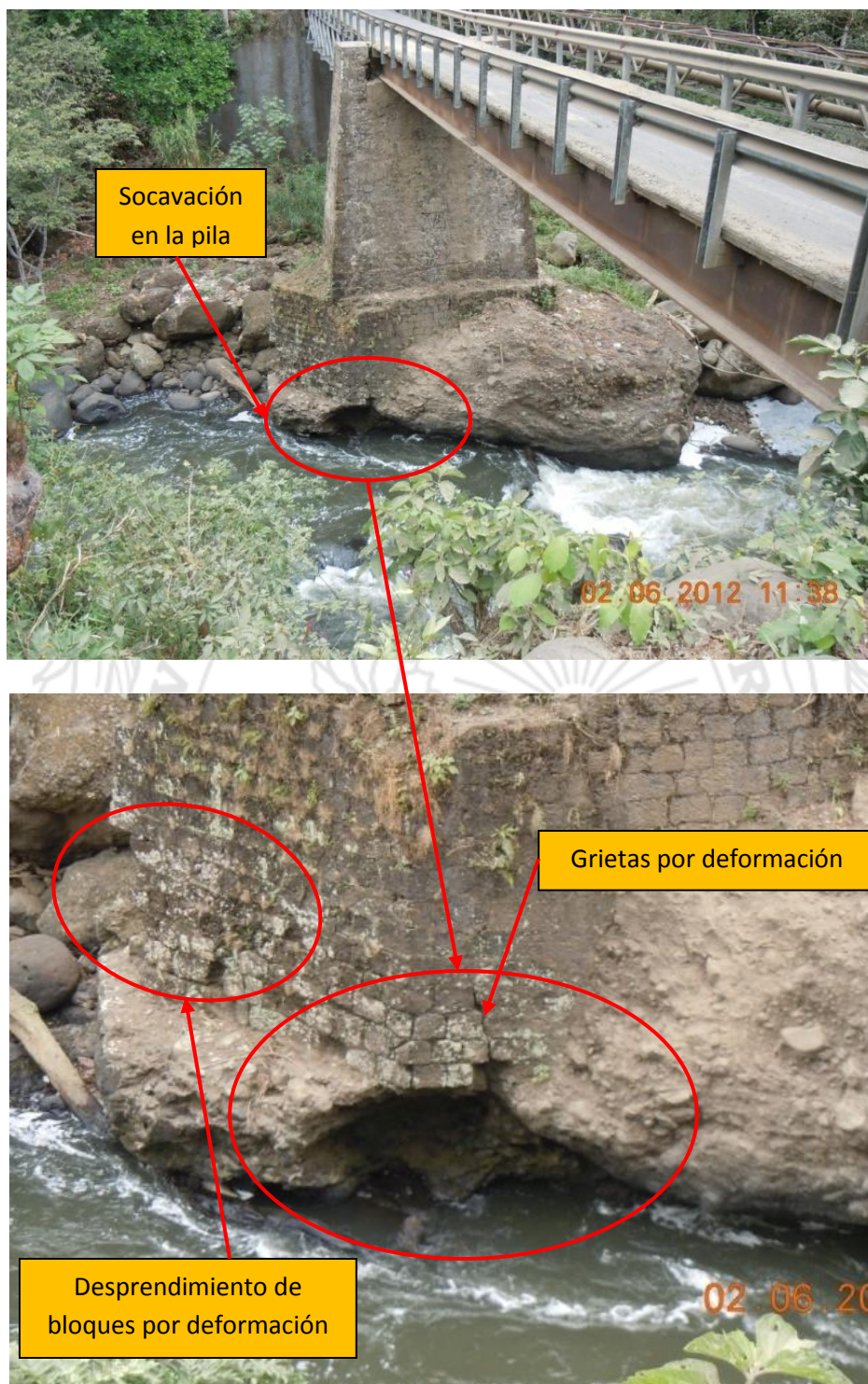
Figura 9. Socavación del cemento de la pila
