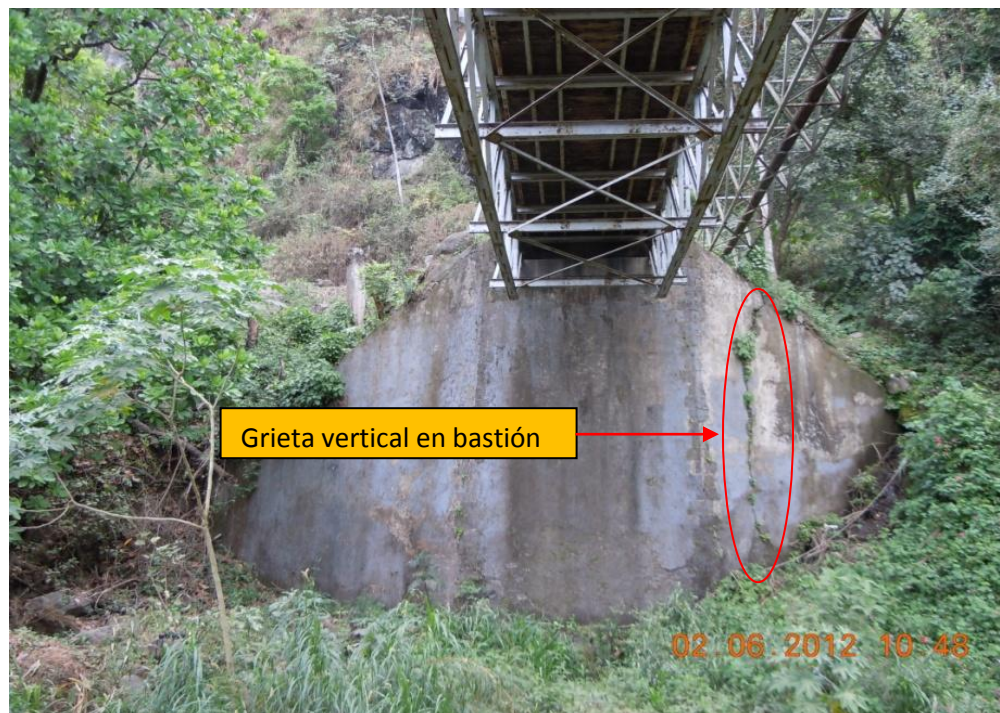
Figura 12. Grieta vertical en aletón del bastión este
