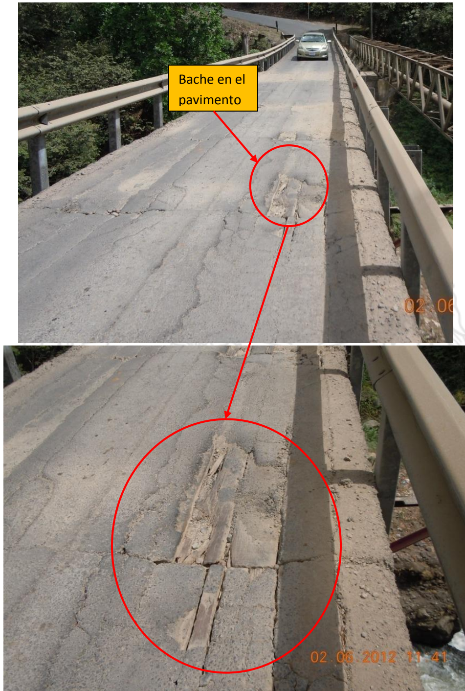
Figura 5. Presencia de baches en la sobrecapa de asfalto.
