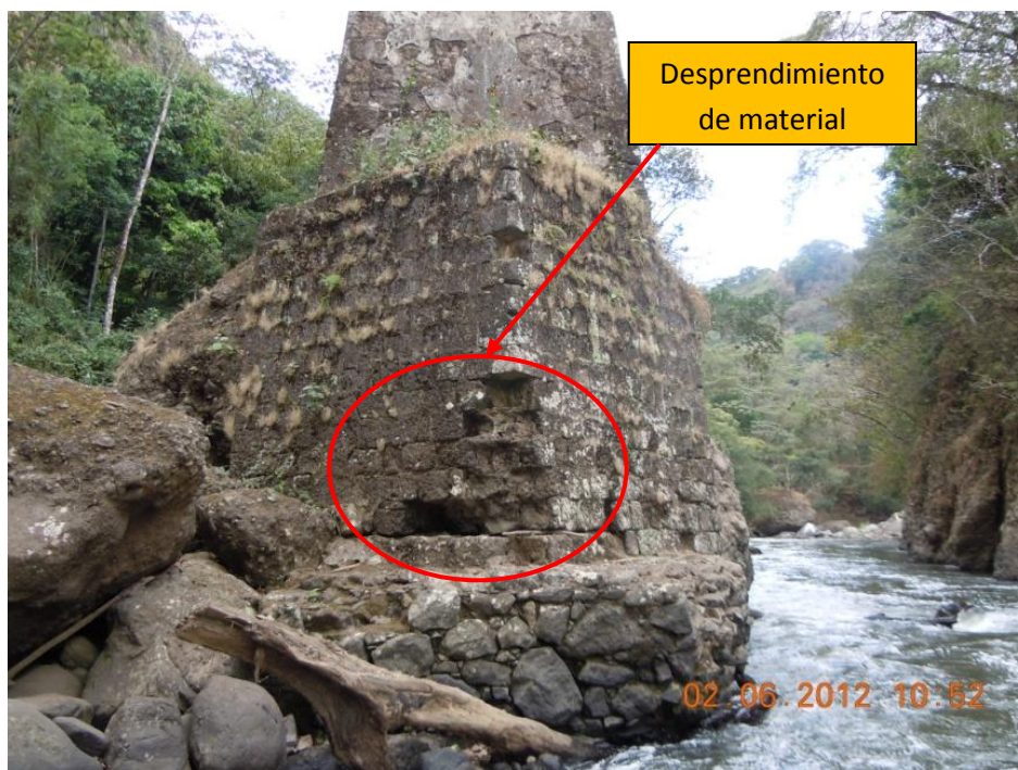
Figura 10. Desprendimiento de la mampostería de roca de la pila por deformación de la cimentación
