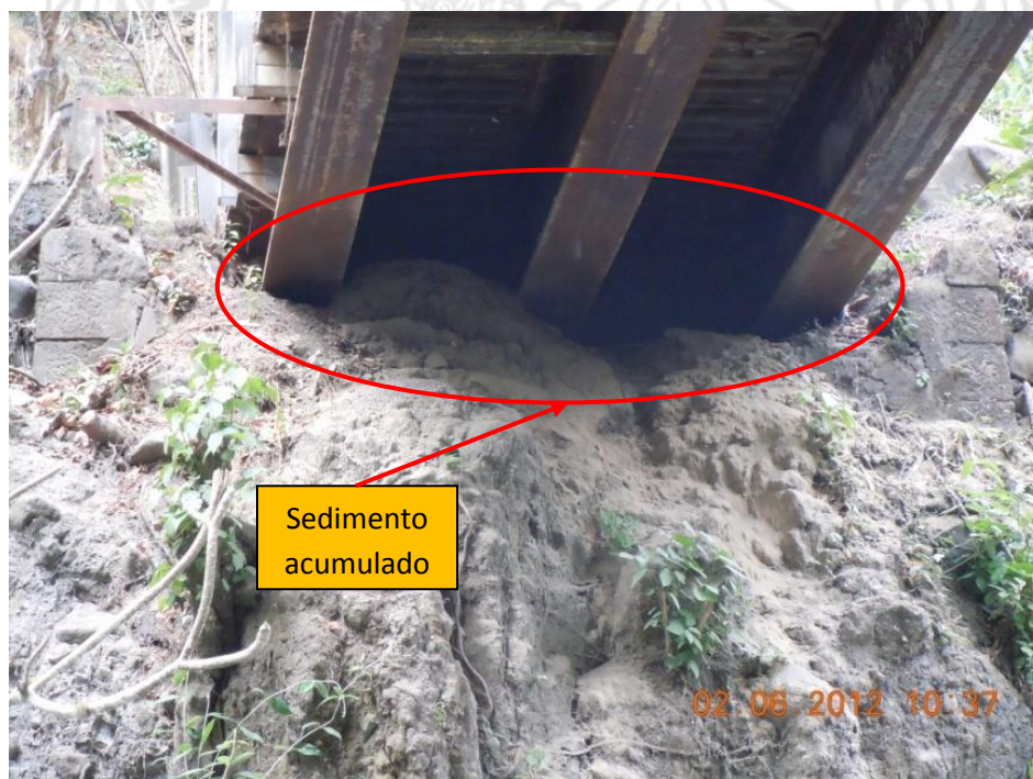
Figura 11. Acumulación de sedimento en el bastión oeste
