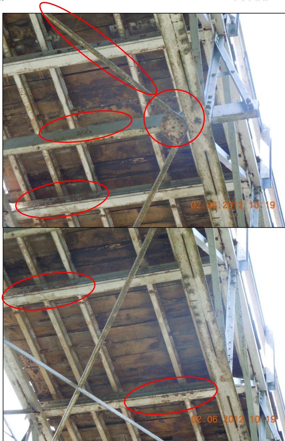
Figura 8. Inicios de oxidación en elementos de la cercha principal y su sistema de arriostramiento. Superestructura tramo este
