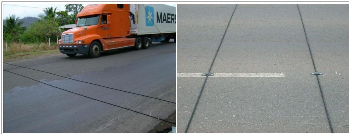
Figura 4. Mangueras y contadores automáticos en sitio.
