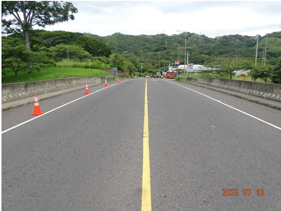
Figura 4.2. Vista a lo largo de la línea de centro del puente (hacia el oeste)
