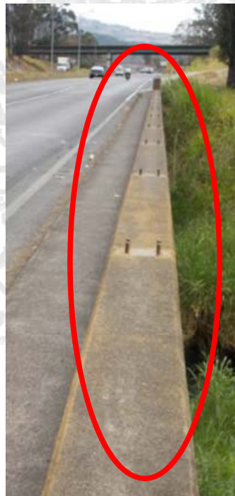
Figura 5.38. Faltante del 100% de la barrera de contención vehicular.
