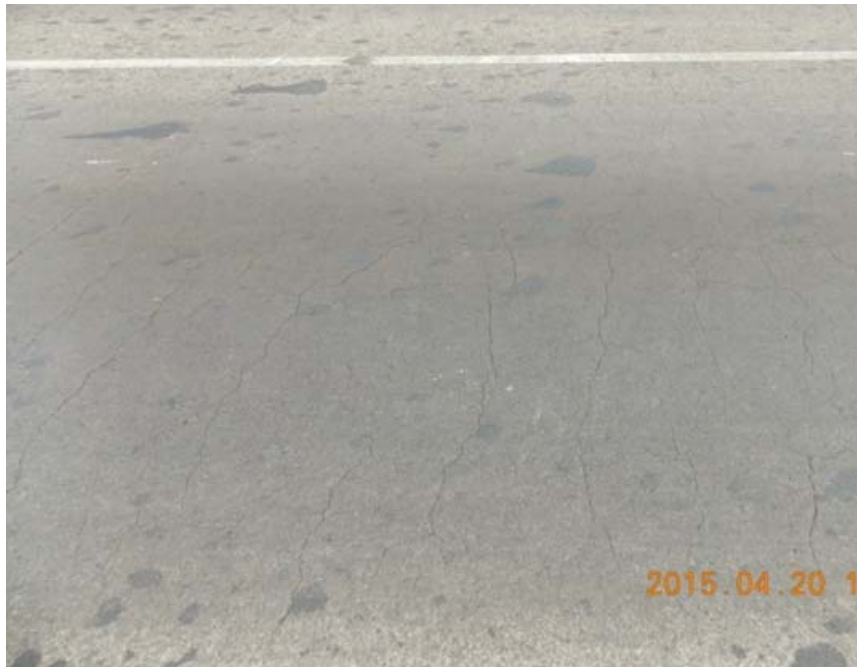
Figura 5.37. Agrietamiento generalizado de la superficie superior de la losa de concreto con mayor incidencia en la dirección transversal y en las zonas de momento negativo sobre las pilas.
