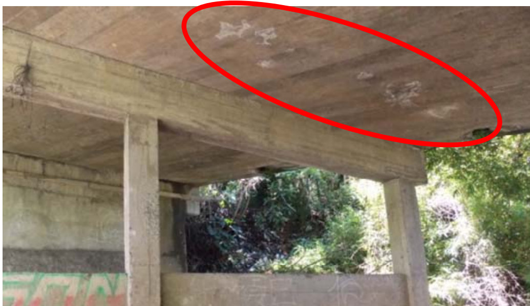
Figura 5.73. Evidencia de agrietamiento y eflorescencia en la superficie inferior de la superestructura.
