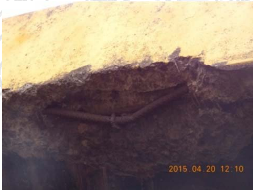
Figura 5.61. Evidencia de la limitada distancia libre inferior del paso a desnivel son los daños por desprendimiento del concreto en la parte superior de los accesos inferiores.
