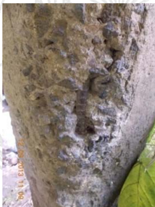
Figura 5.67. Los elementos de concreto de la subestructura, las pilas en este caso, mostraban evidencia de daños por impacto de objetos de gran tamaño arrastrados por la corriente.
