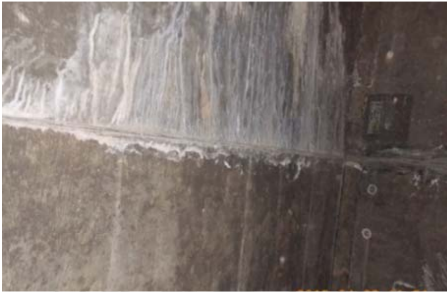
Figura 5.55. El paso a desnivel poseía juntas con evidencia de eflorescencia generalizada.
