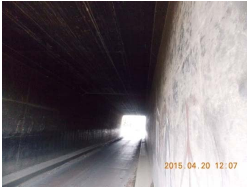
Figura 5.60. Vista de la estructura tipo alcantarilla de cuadro desde el acceso sur.
