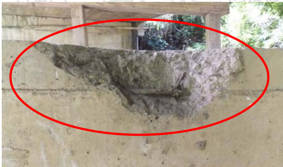
Figura 5.74. Los elementos de concreto de la subestructura, las vigas de amarre de las pilas en este caso, mostraban evidencia de daños por impacto de objetos de gran tamaño arrastrados por la corriente.
