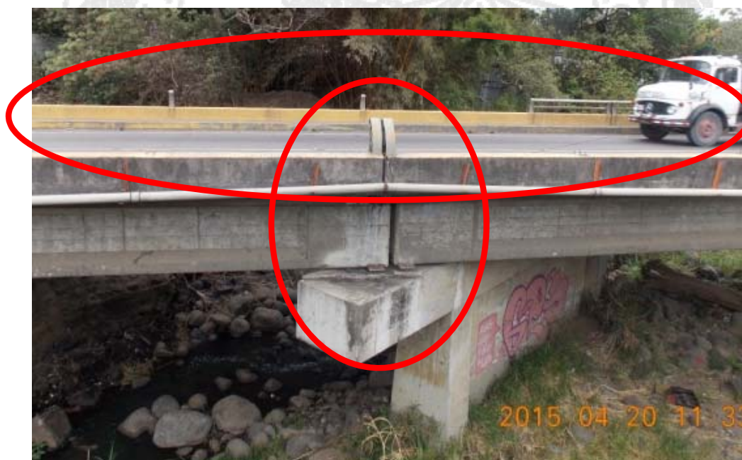
Figura 5.49. Ausencia de las barreras de contención vehicular, daños en el parapeto de concreto por colisión y deterioro de la zona de la junta de expansión.
