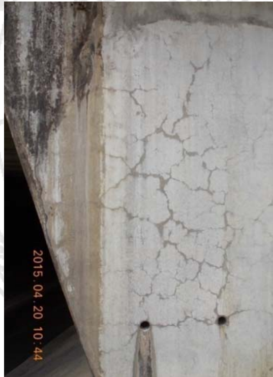
Figura 5.31. Evidencia de de laminación por corrosión del acero en el lado noroeste del bastión oeste.
