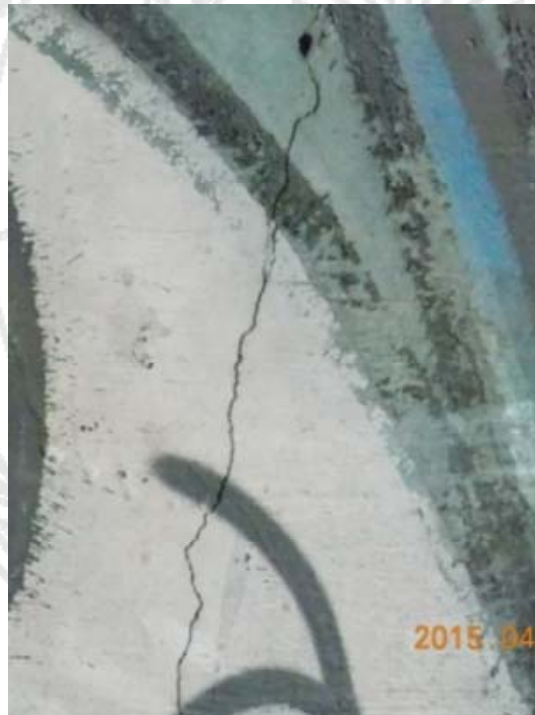
Figura 5.63. La estructura tipo alcantarilla de cuadro evidenciaba agrietamiento en el sentido vertical con espesores de hasta 0,50mm.
