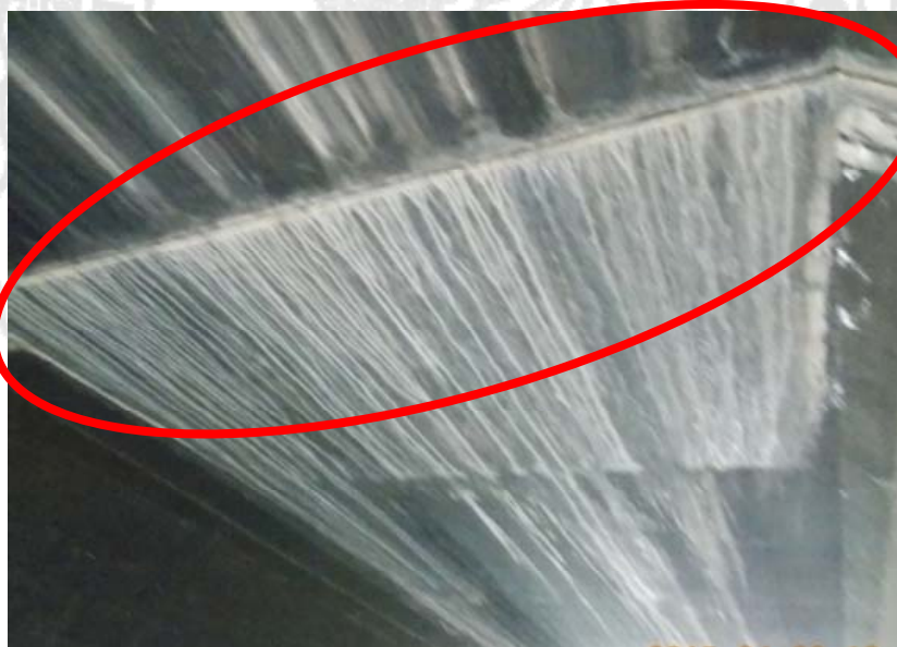
Figura 5.20. El paso a desnivel poseía juntas con evidencia de eflorescencia generalizada.
