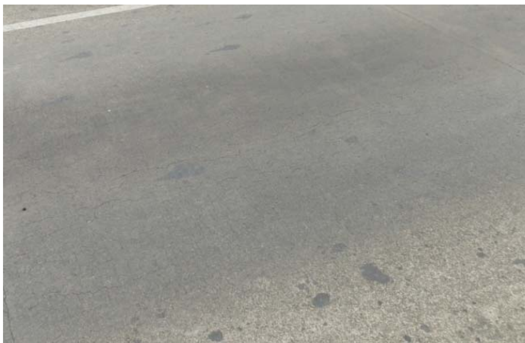
Figura 5.48. Agrietamiento generalizado en ambas direcciones de la superficie superior de la losa de concreto.
