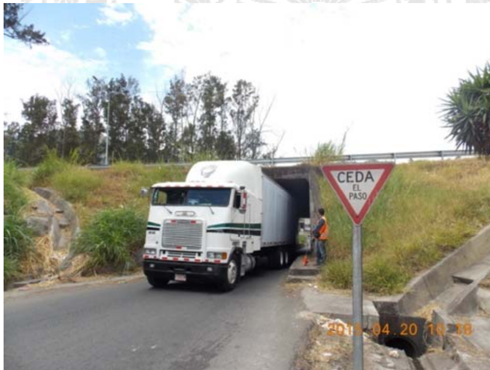
Figura 5.18. Vista lateral del lado sur en donde se puede observar al paso del camión mostrando la limitada distancia libre inferior del paso a desnivel.
