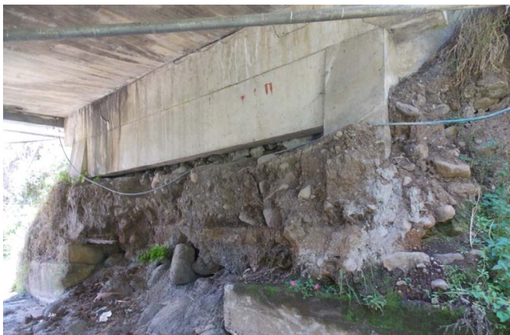
Figura 5.66. El talud de protección del talud al frente del bastión este aún se encontraba socavado tal y como se había identificado en el 2013.
