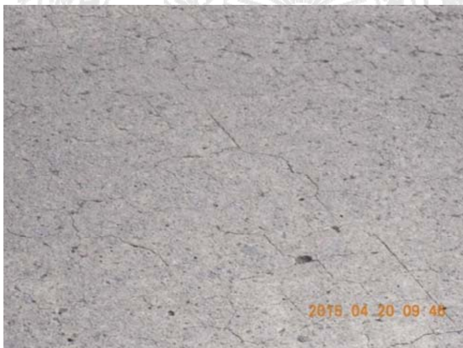
Figura 5.7. Agrietamiento generalizado en ambas direcciones de la superficie superior de la losa de concreto reforzado.
