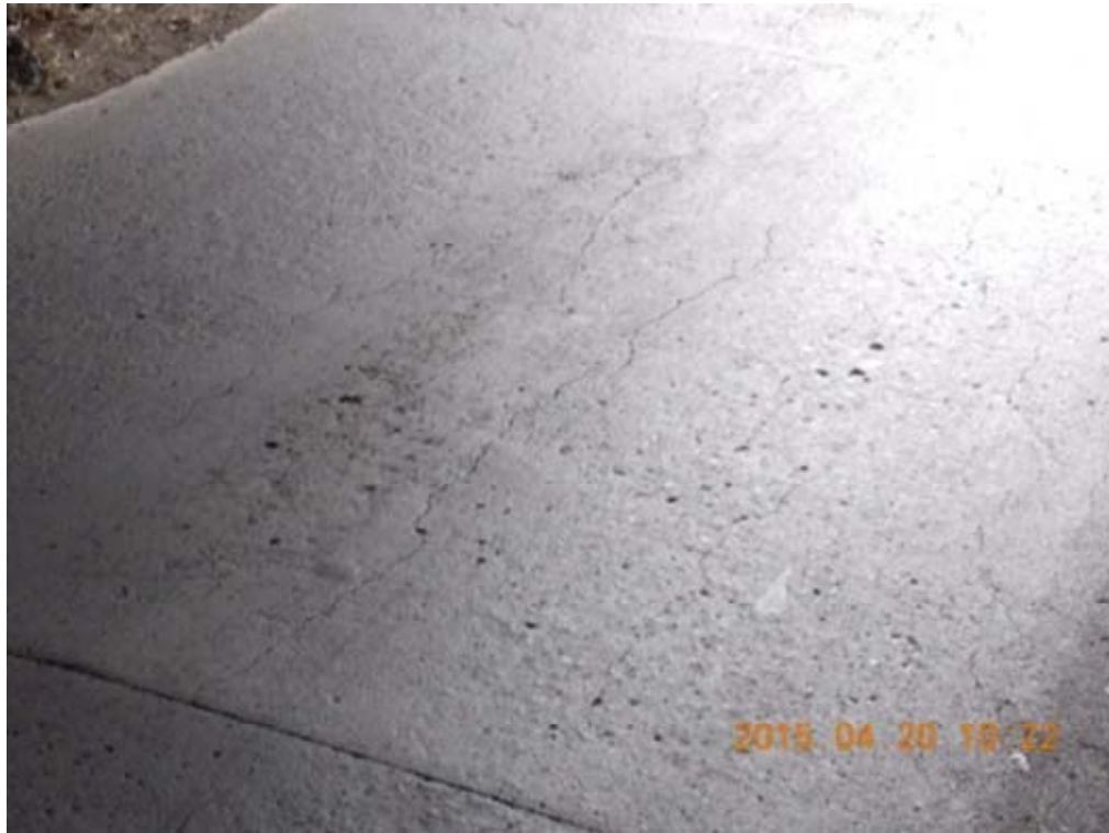
Figura 5.21. La losa de concreto de rodamiento de la alcantarilla de cuadro evidenciaba agrietamiento generalizado y principalmente longitudinal al eje de la alcantarilla.
