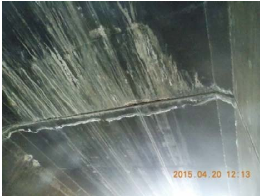
Figura 5.62. El paso a desnivel poseía juntas con evidencia de eflorescencia generalizada.
