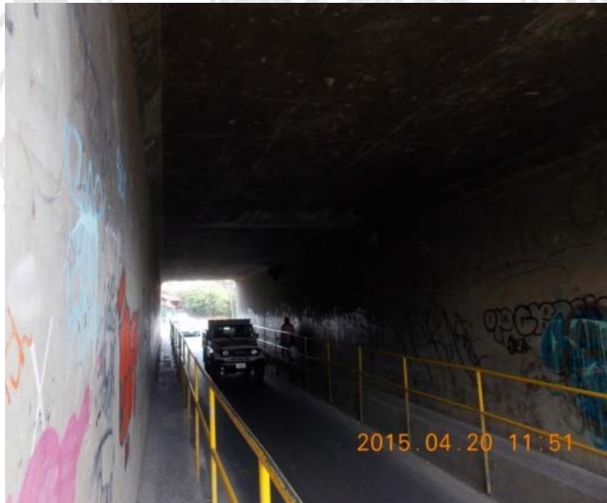
Figura 5.54. Vista de la estructura tipo alcantarilla de cuadro desde el acceso sur.
