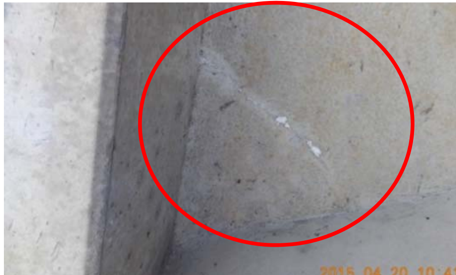
Figura 5.32. Agrietamiento diagonal con evidencia de eflorescencia en la superficie inferior de la losa de concreto.
