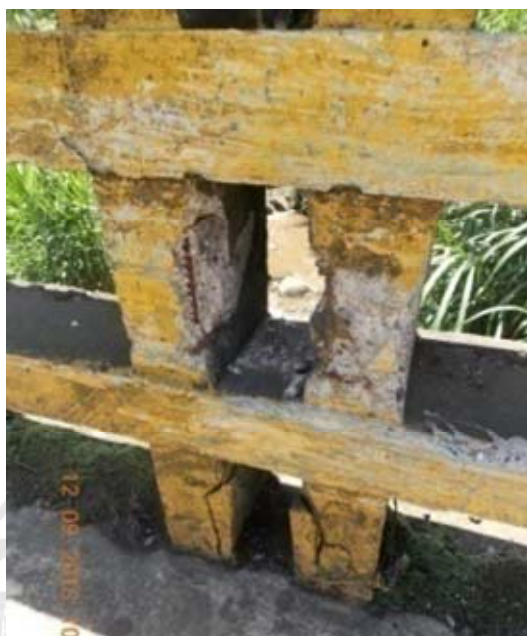
Figura 5.68. Deterioro avanzado de la barrera de contención vehicular. No hay evidencia de cumplir con los requisitos para la velocidad y cantidad de vehículos pesados que transitan por la ruta.
