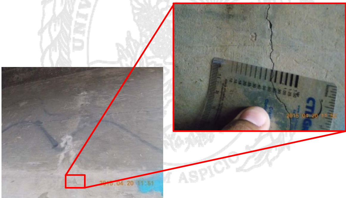
Figura 5.56. La estructura tipo alcantarilla de cuadro evidenciaba agrietamiento en el sentido vertical con espesores de hasta 0,50mm.
