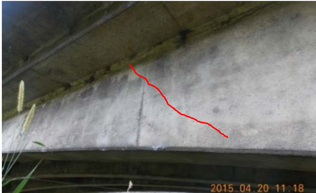
Figura 5.39. Evidencia de agrietamiento de cortante en la zonas cercanas a las pilas.
