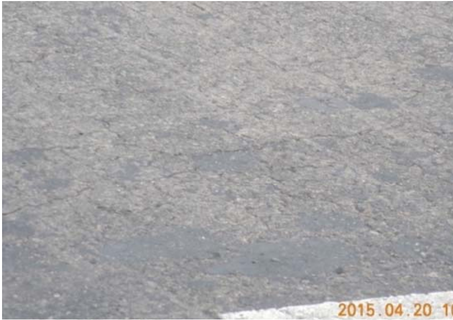
Figura 5.30. Evidencia de agrietamiento generalizado en ambas direcciones de la superficie superior de la losa de concreto.
