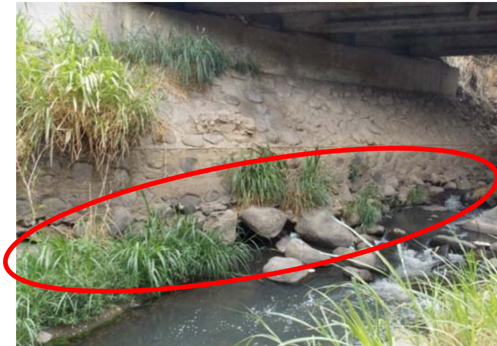
Figura 5.50. Evidencia de inicios de socavación en la protección del talud al frente del bastión oeste del puente aguas arriba..
