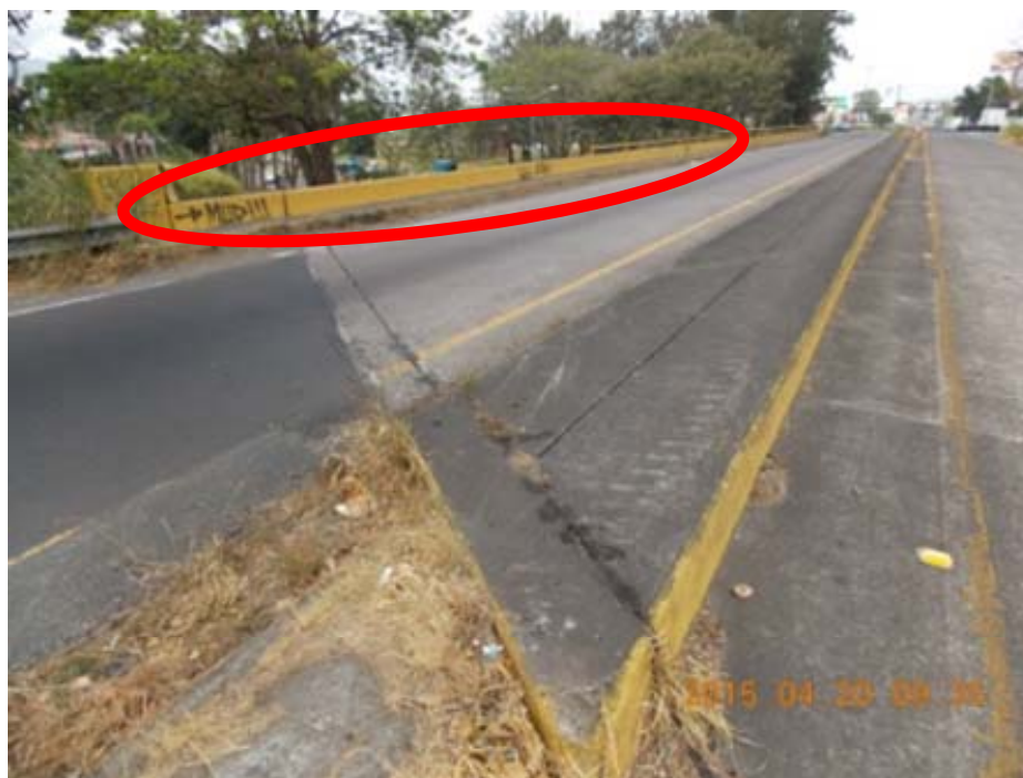
Figura 5.6. Ausencia de algunas secciones de la barrera de contención vehicular de acero.
