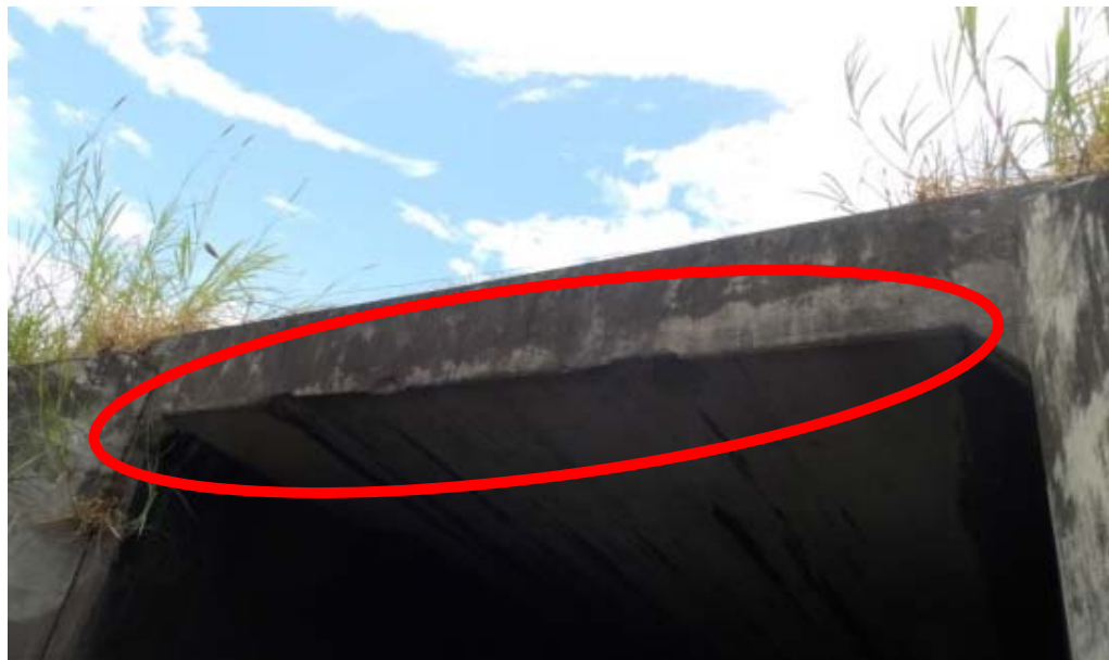
Figura 5.19. Evidencia de la limitada distancia libre inferior del paso a desnivel son los daños por desprendimiento del concreto en la parte superior de los accesos inferiores.
