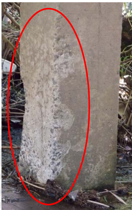
Figura 5.75. Los elementos de concreto de la subestructura, las pilas en este caso, mostraban evidencia de daños por impacto de objetos de gran tamaño arrastrados por la corriente.
