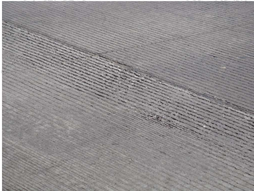
Figura 5. Desprendimiento de Agregados
