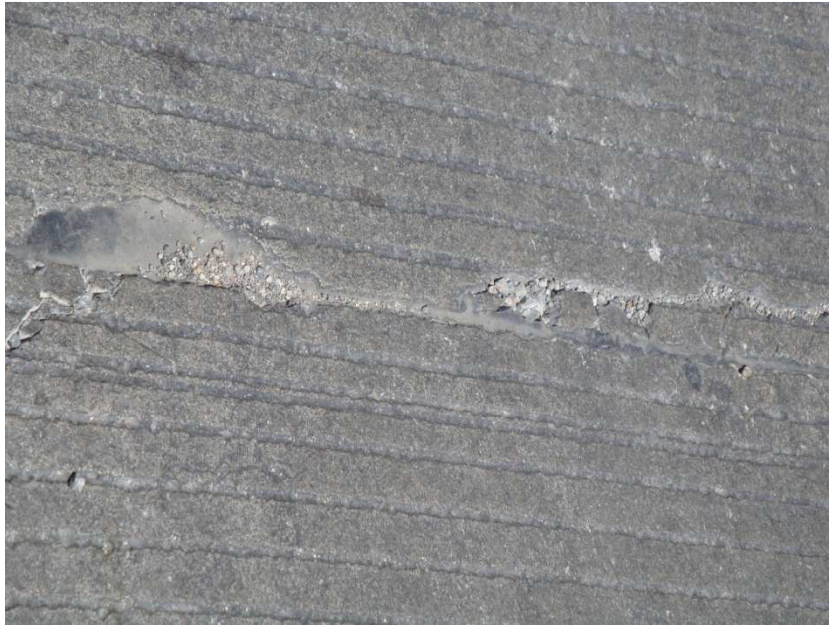
Figura 8. Grieta Severa a través del ancho del carril
