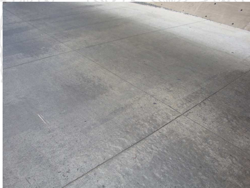
Figura 11. Falta de ranuras contra deslizamiento
