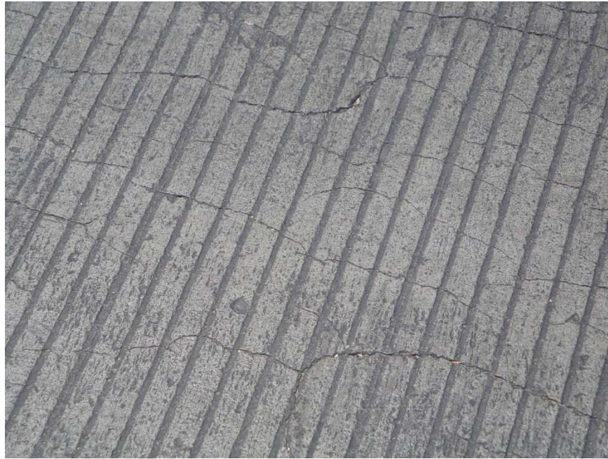
Figura 10. Fisuramiento longitudinal ramificado
