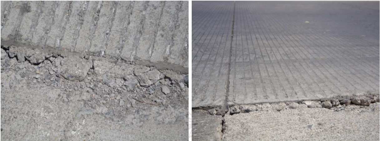
Figura 6. Problemas en los bordes que colindan con la cuneta
