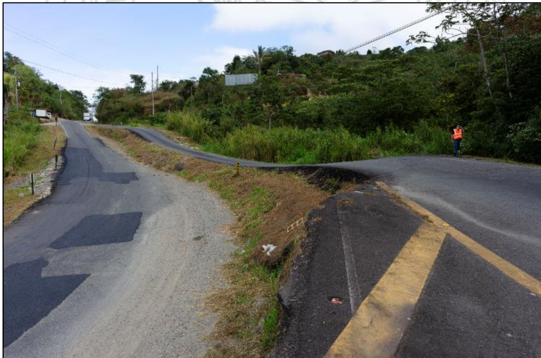
Fotografía No.3: Sitio de hundimiento sobre Ruta Nacional No.1. Nótese la ausencia total de elementos de seguridad vial y contención vehicular
