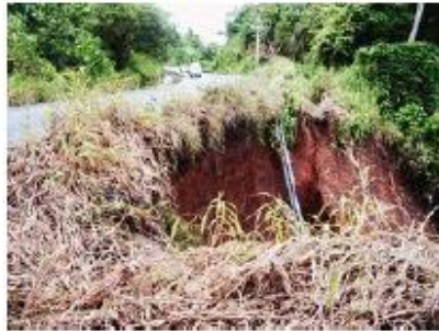
Un derrumbe socavó en octubre la vía a Jacó cerca de la entrada a Punta Leona. Mario del Vecchio para LN
