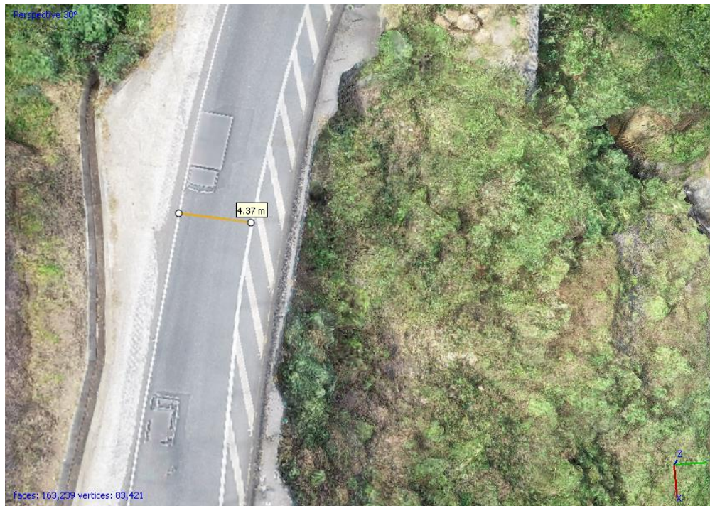
Fotografía No.5: Vista en planta de la sección en uso. El ancho del carril que se está utilizando para el paso de vehículos es de 4.37 m aproximadamente.
