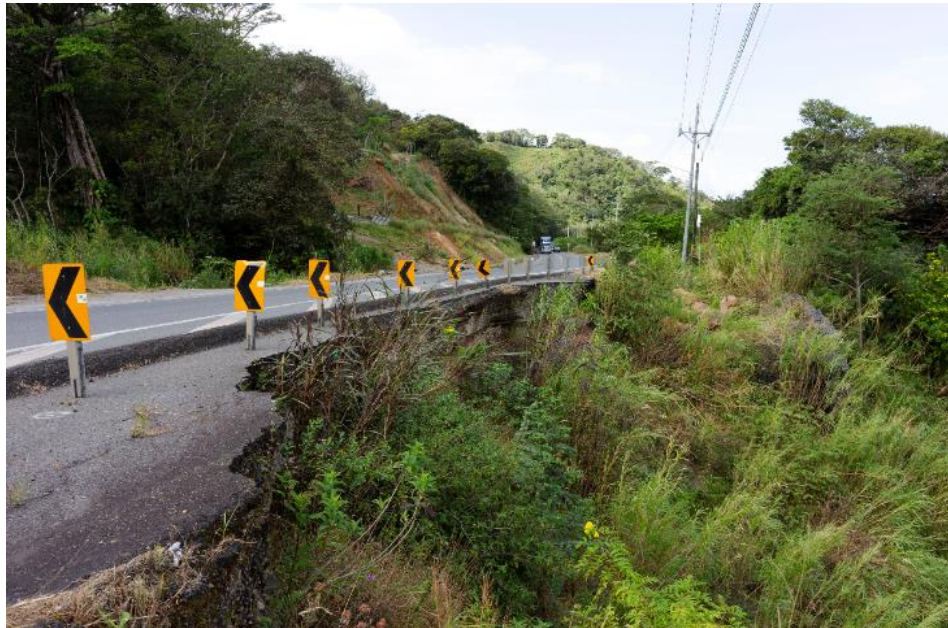
Fotografía No.4: Sitio de colapso de ladera adyacente al paso vehicular en la Ruta Nacional No.1. Nótese la existencia de un tramo de la ruta en
