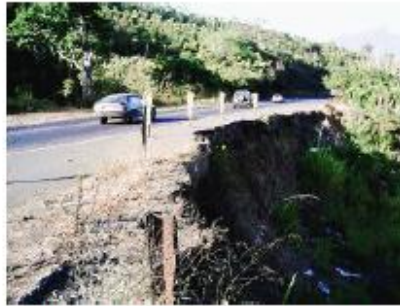
Este hundimiento, un kilómetro al oeste de la entrada a Palmares, tiene varios años. Zoyia Rita Mora para LN
