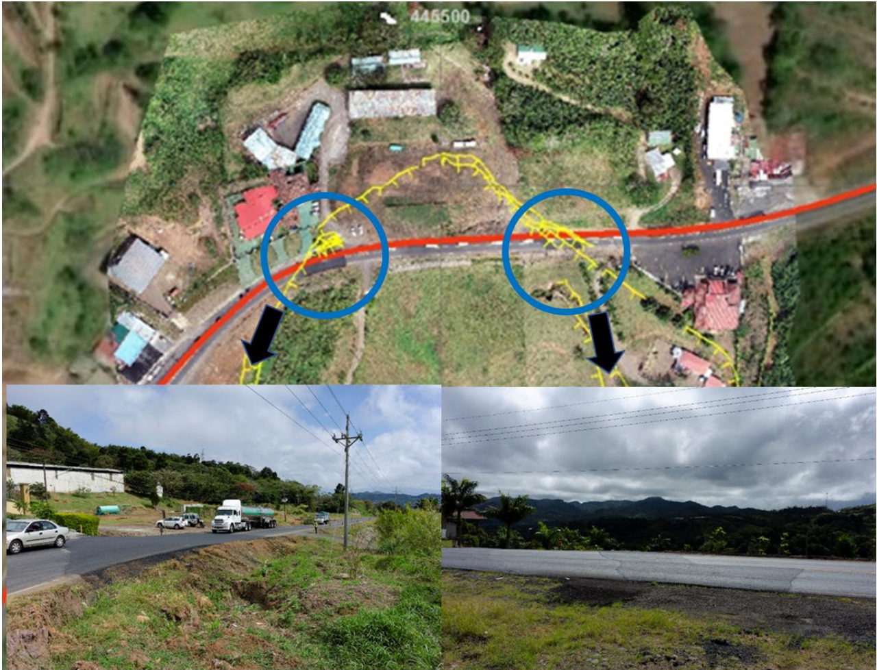
Figura No.5. Ubicación y registro de bacheos recientes sobre el trazado de la falla detectada. Se evidencia que es una falla activa que genera afectación sobre la Ruta Nacional No.1.
