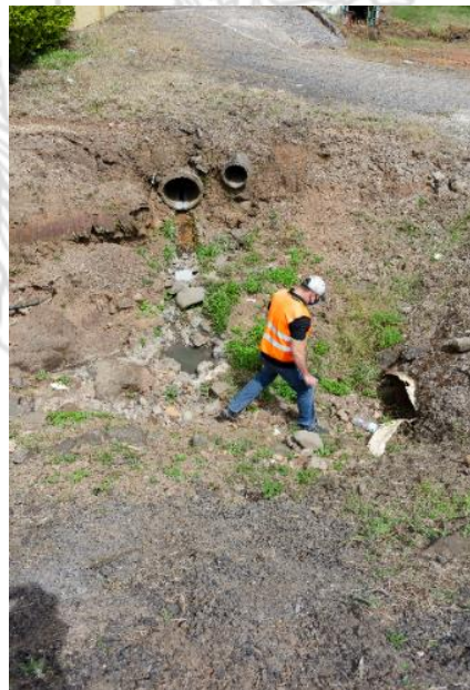
Fotografía No.2: Elementos de drenaje sub-superficial que muestran obstrucción dentro de la zona de inestabilidad detectada. Se evidencia la falta de mantenimiento en estos activos viales.
