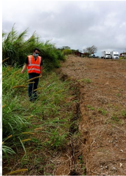
Fotografía No.1: Desnivel generado en el sector oeste de la corona del deslizamiento principal con una diferencia de altura de 60 cm aproximadamente.
