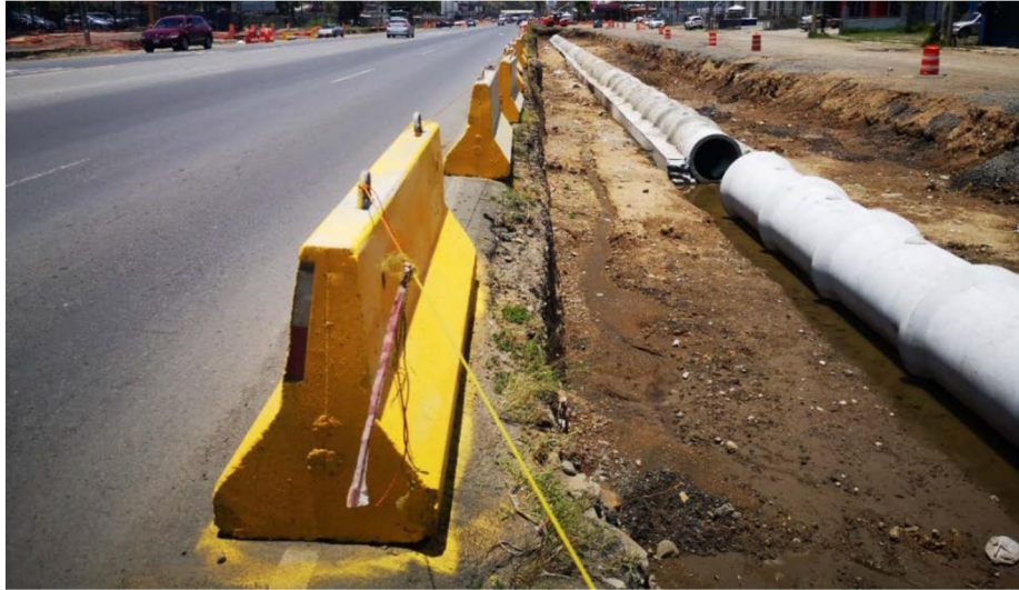
Figura 4. Barreras de concreto discontinuas y sin anclaje apropiado para contener una colisión
