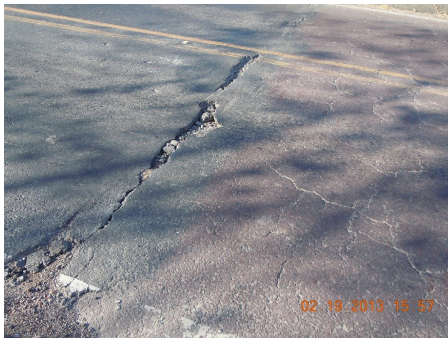
Figura 10: Junta de expansión obstruida por una sobrecapa asfáltica.
