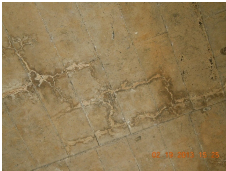
Figura 12: Grietas en dos direcciones en las superficie inferior de la losa de concreto.
