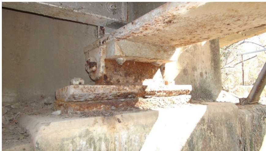
Figura 18: Corrosión avanzada del apoyo expansivo.
