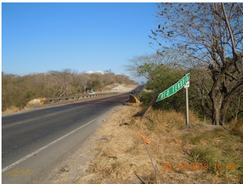
Figura 6: Rótulo de identificación dañado.
