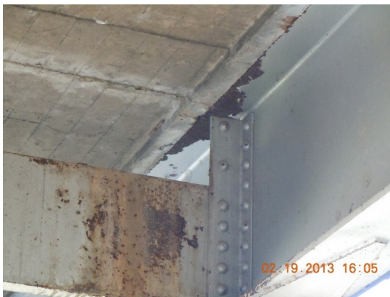
Figura 16: Inicios de corrosión en viga diafragma interna por filtración de agua a través de grietas en la losa.
