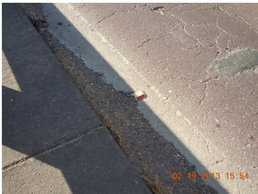
Figura 8: Acumulación de sedimentos en los bordillos y obstrucción de los ductos de desagüe.
