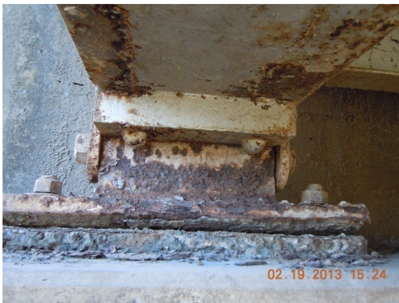
Figura 17: Corrosión avanzada del apoyo expansivo.
