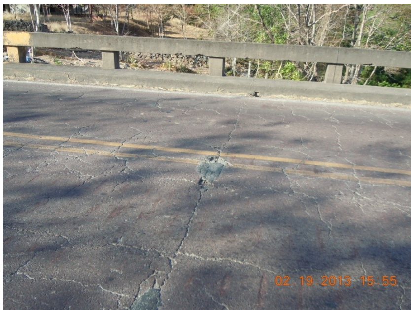
Figura 7: Agrietamiento y baches en la carpeta asfáltica.
