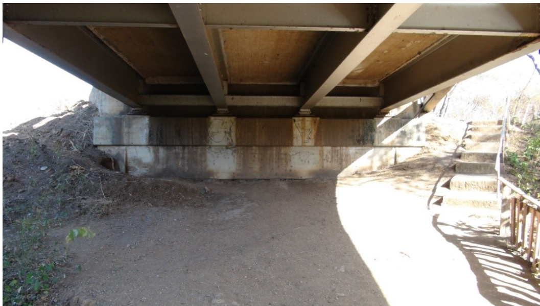
Figura 9: Filtración de agua a través de las juntas de expansión sobre el bastión sur.
