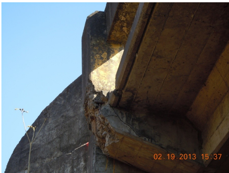
Figura 5: Daño en la barrera en el acceso sur (agrietamiento y acero de refuerzo expuesto).
