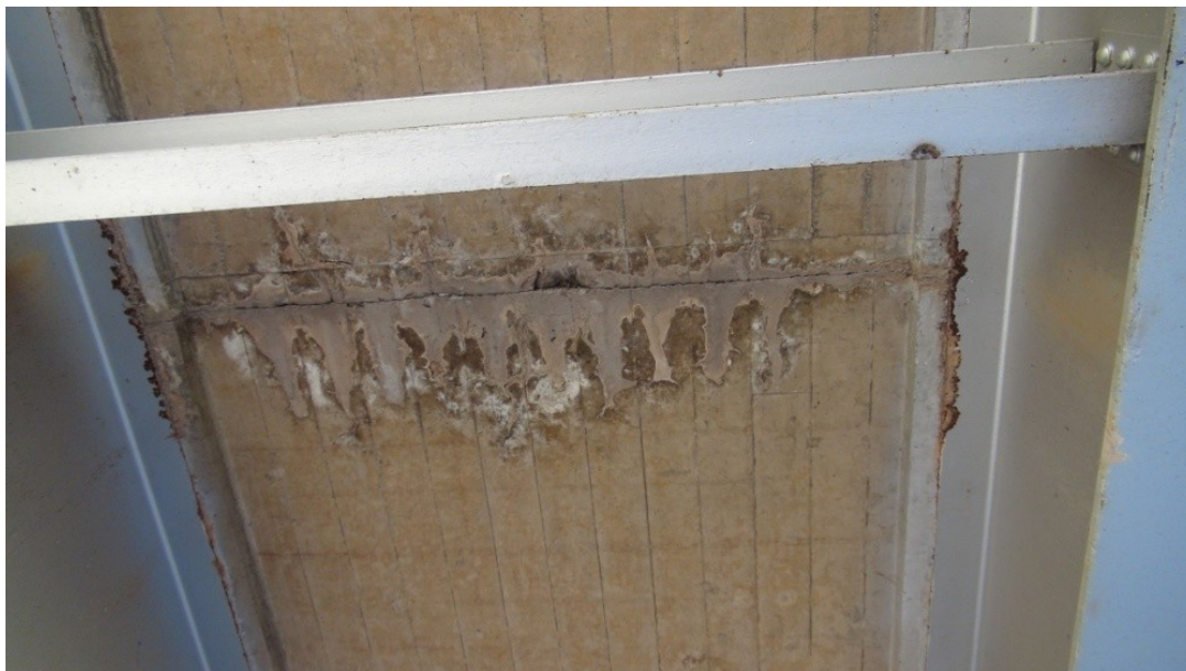
Figura 13: Filtraciones a través de juntas de construcción en la losa de concreto.
