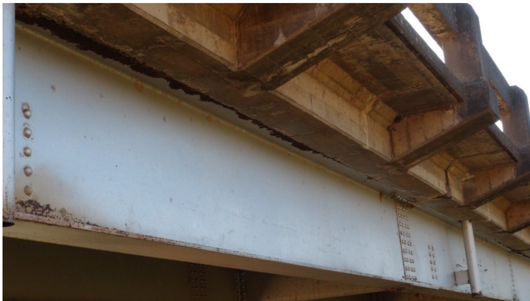
Figura 14: Corrosión en la viga externa en la interface entre la viga con la losa de concreto.
