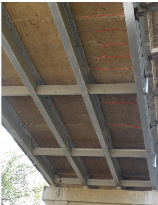
Figura 11: Grietas transversales y eflorescencia en la losa de concreto.
