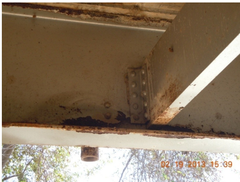
Figura 15: Corrosión en viga externa e inicios de corrosión del diafragma transversal por filtración de agua por grietas en la losa.
