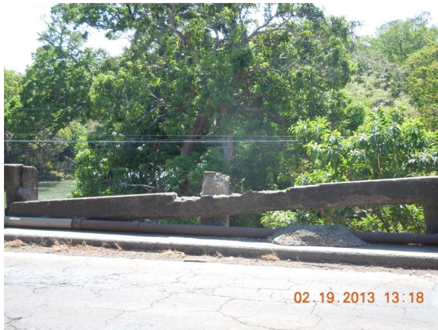
Figura 5: Daño en la barrera vehicular cercana al acceso sur.
