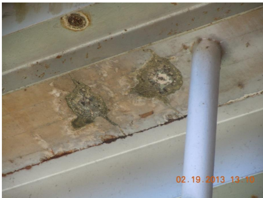
Figura 15: Descascaramiento del concreto en parte de la losa de la superestructura 2 junto a un ducto de desagüe.
