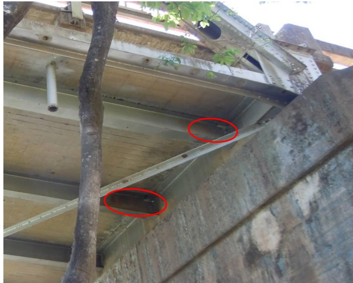
Figura 21: Corrosión en vigas de piso de la cercha.
