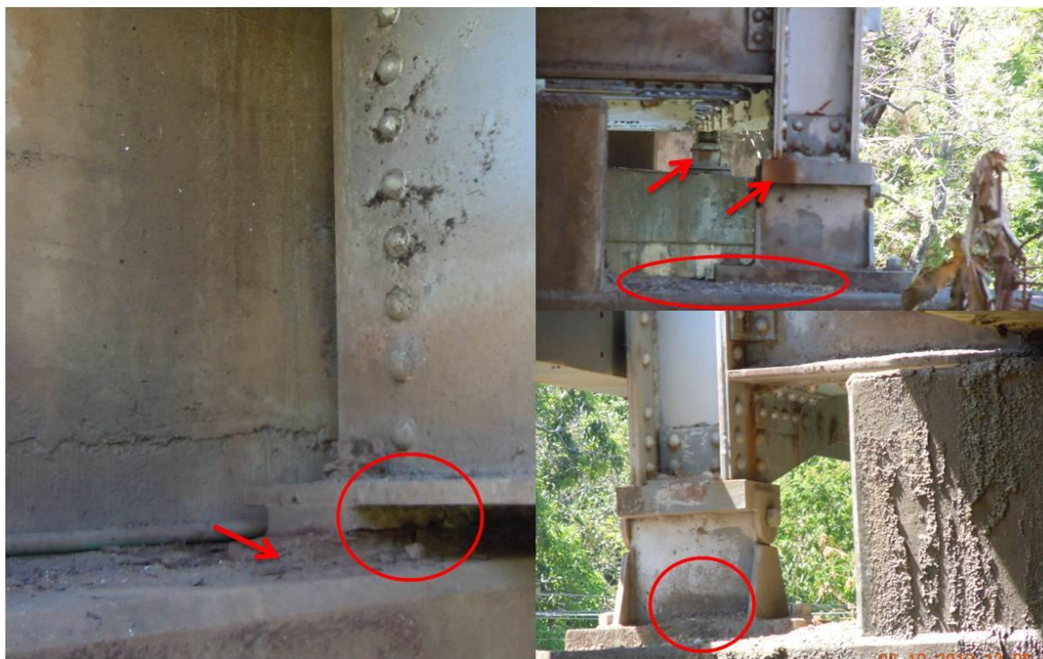
Figura 25. Oxidación en los apoyos y acumulación de sedimentos a su alrededor.
