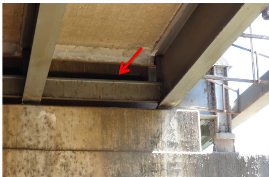
Figura 14: Piquetes de corrosión en las vigas diafragma de la superestructura de vigas de acero.
