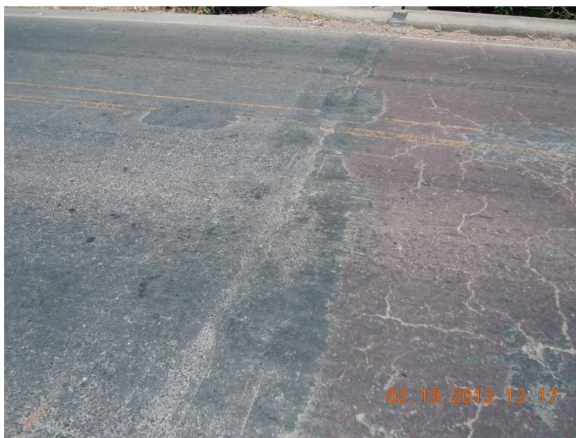
Figura 10: Obstrucción de la junta de expansión sobre el acceso norte con una sobrecapa de asfalto.
