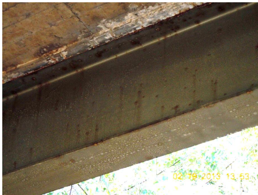
Figura 13: Piquetes de corrosión en las vigas principales de acero.
