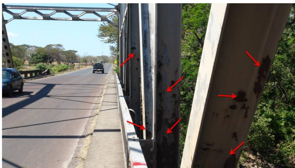
Figura 16: Descascaramiento y corrosión en elementos de la armadura
