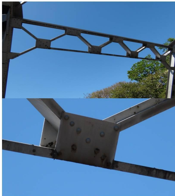
Figura 22: Corrosión en portales de la cercha.
