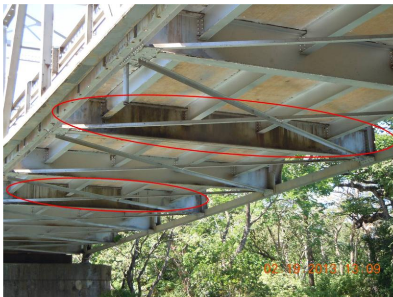
Figura 19: Corrosión en vigas transversales debido a filtraciones a través de grietas en la losa.
