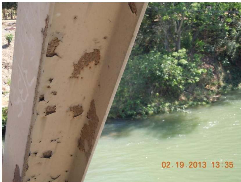
Figura 17: Descascaramiento de pintura y corrosión en elemento diagonal de la armadura.
