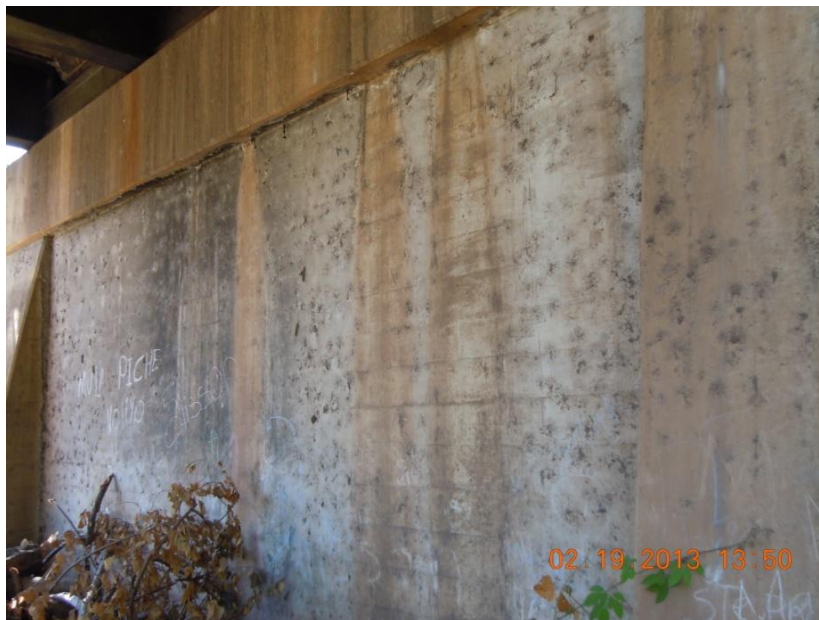
Figura 11: Evidencia de filtración de la escorrentía superficial a través de la junta de expansión sobre la pila 1.
