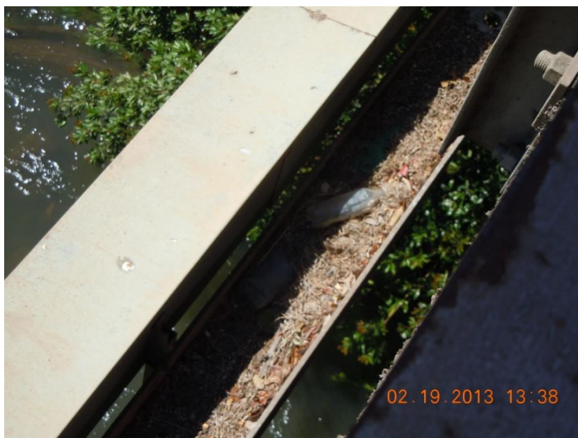
Figura 18: Acumulación de sedimento, vegetación y basura en la cuerda inferior de la cercha.
