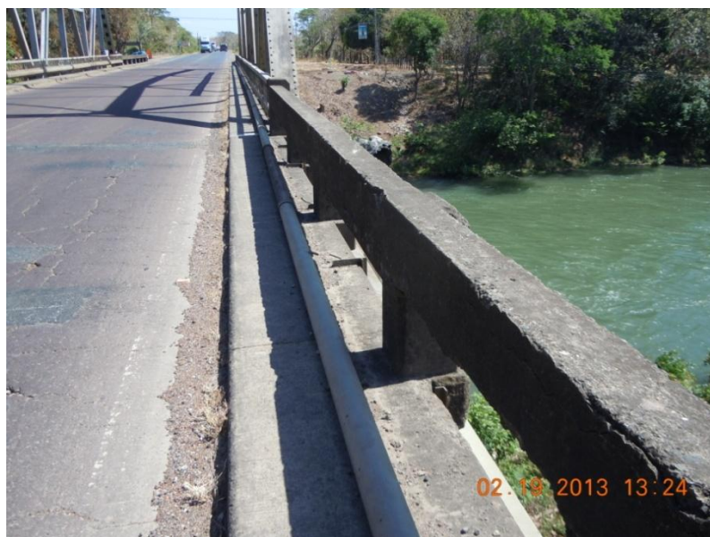
Figura 8: Obstrucción de los ductos de drenaje del puente por acumulación de sedimento y vegetación a lo largo del bordillo.
