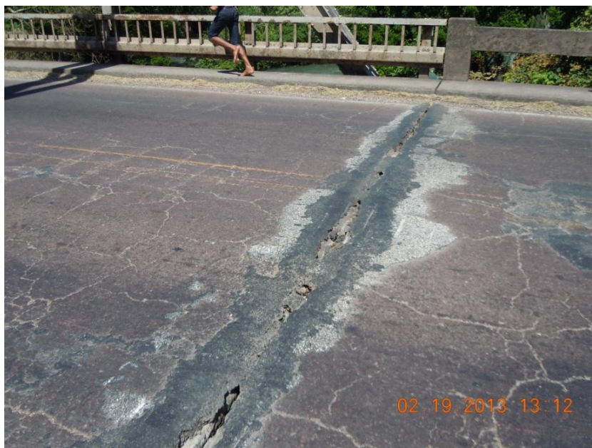
Figura 9: Junta de expansión tipo placa deslizante sobre la pila 1 la cual está en malas condiciones y estaba cubierta con asfalto.
