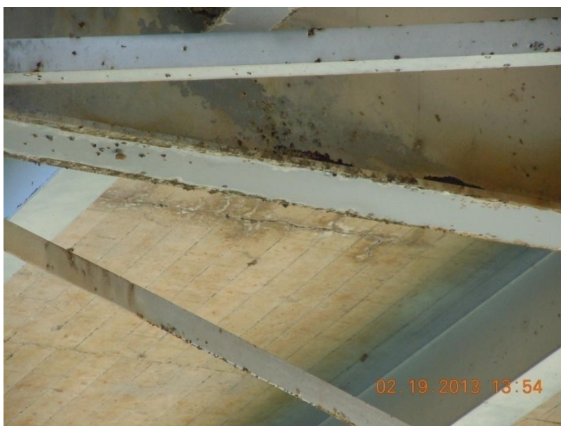
Figura 20: Piquetes de corrosión en vigas transversales y arriostres inferiores entre armaduras.
