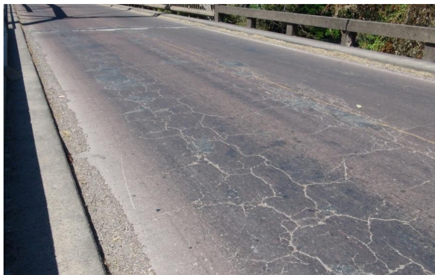
Figura 6: Agrietamiento en red de la carpeta asfáltica colocada sobre la losa de concreto del puente.
