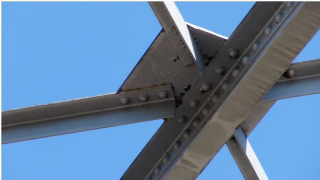
Figura 24: Corrosión en conexión del sistema de arriostramiento lateral superior de la cercha.
