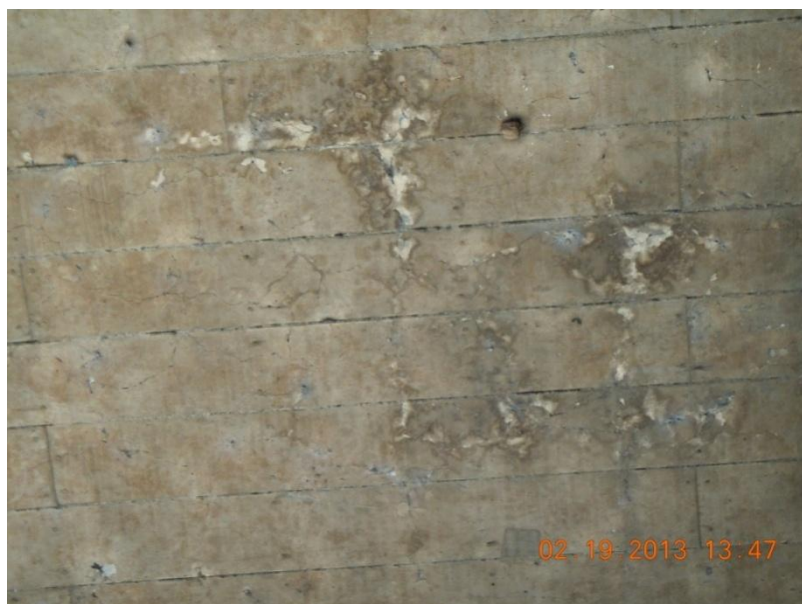
Figura 12: Superficie inferior de la losa de la superestructura 1 mostrando grietas en dos direcciones y eflorescencia.
