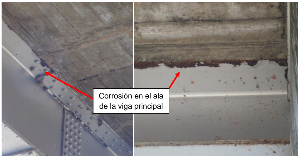
Figura 26. Corrosión en ala superior de las vigas principales de acero en contacto con la losa (tramo 2)
