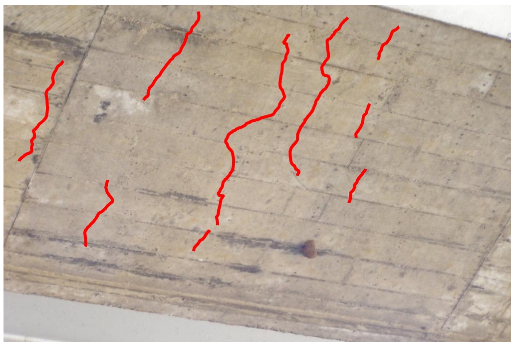
Figura 16. Grietas transversales en la superficie inferior de la losa del tramo 2.
