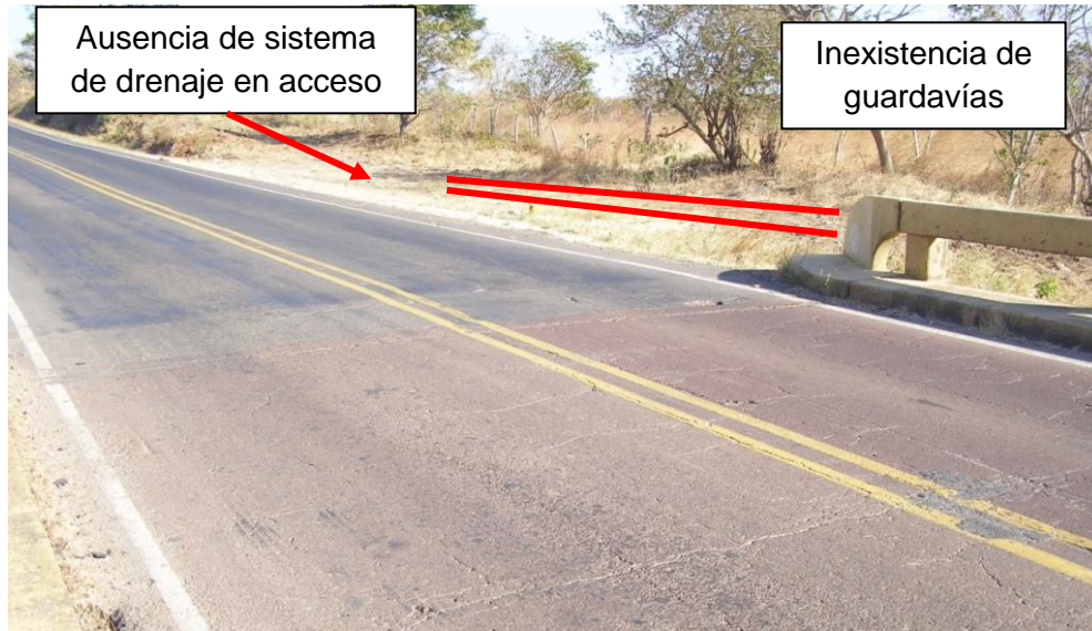
Figura 9. Inexistencia de guardavías en el acceso oeste.
