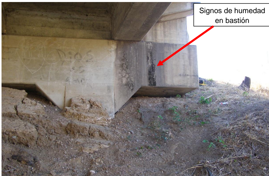
Figura 31. Signos de humedad por filtración de agua a través de la junta del bastión 2.
