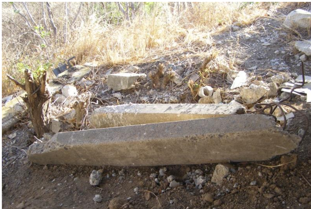
Figura 7. Disposición inadecuada de escombros producto de la reparación de la barrera Sur del tramo No 3.
