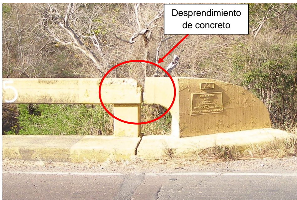
Figura 8. Desprendimiento de concreto en la barrera norte del tramo 1.
