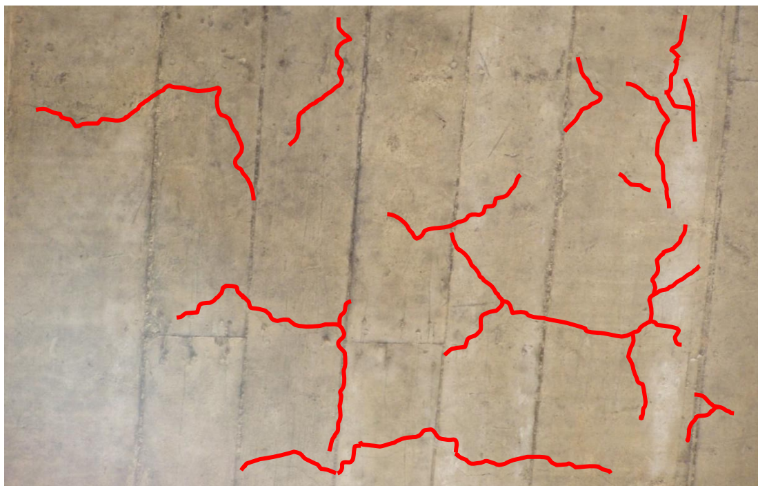
Figura 17. Grietas en dos direcciones presentes en la zona central de la losa del tramo 2.
