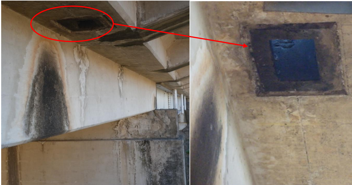
Figura 13. Ductos de desagüe sin tubos de extensión y manchas de humedad en vigas.
