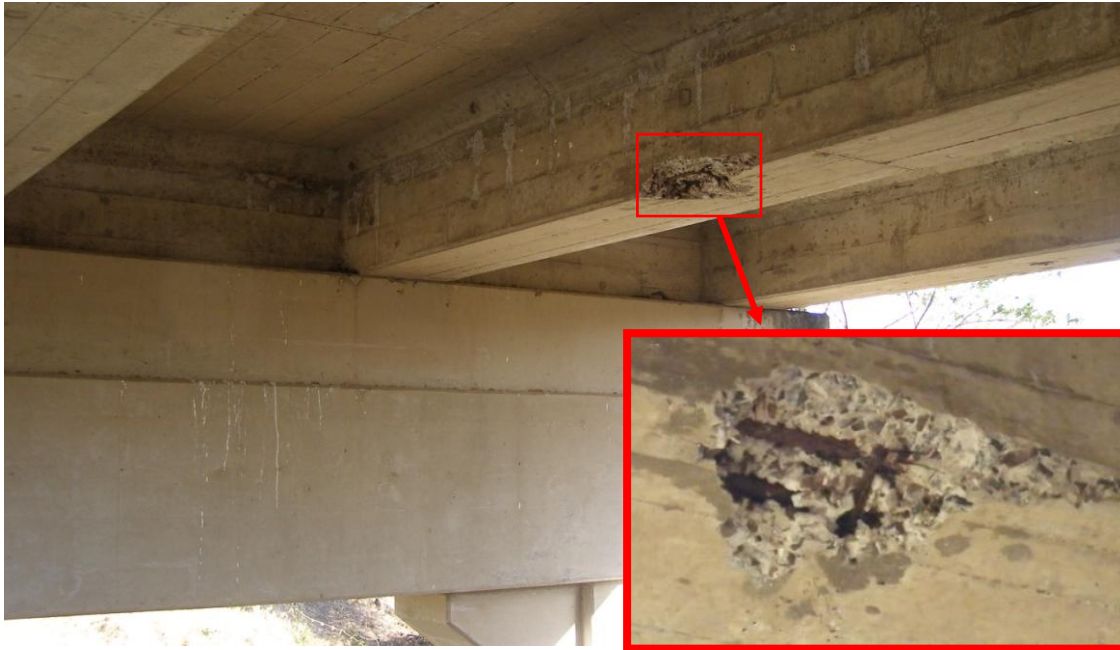
Figura 21. Desprendimiento de concreto y acero de refuerzo al descubierto en viga principal (tramo 3).
