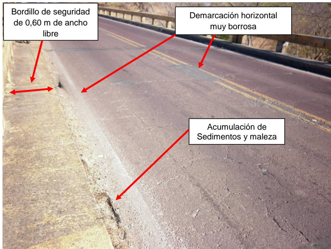
Figura 10. Demarcación horizontal borrosa y ausencia de captaluces.
