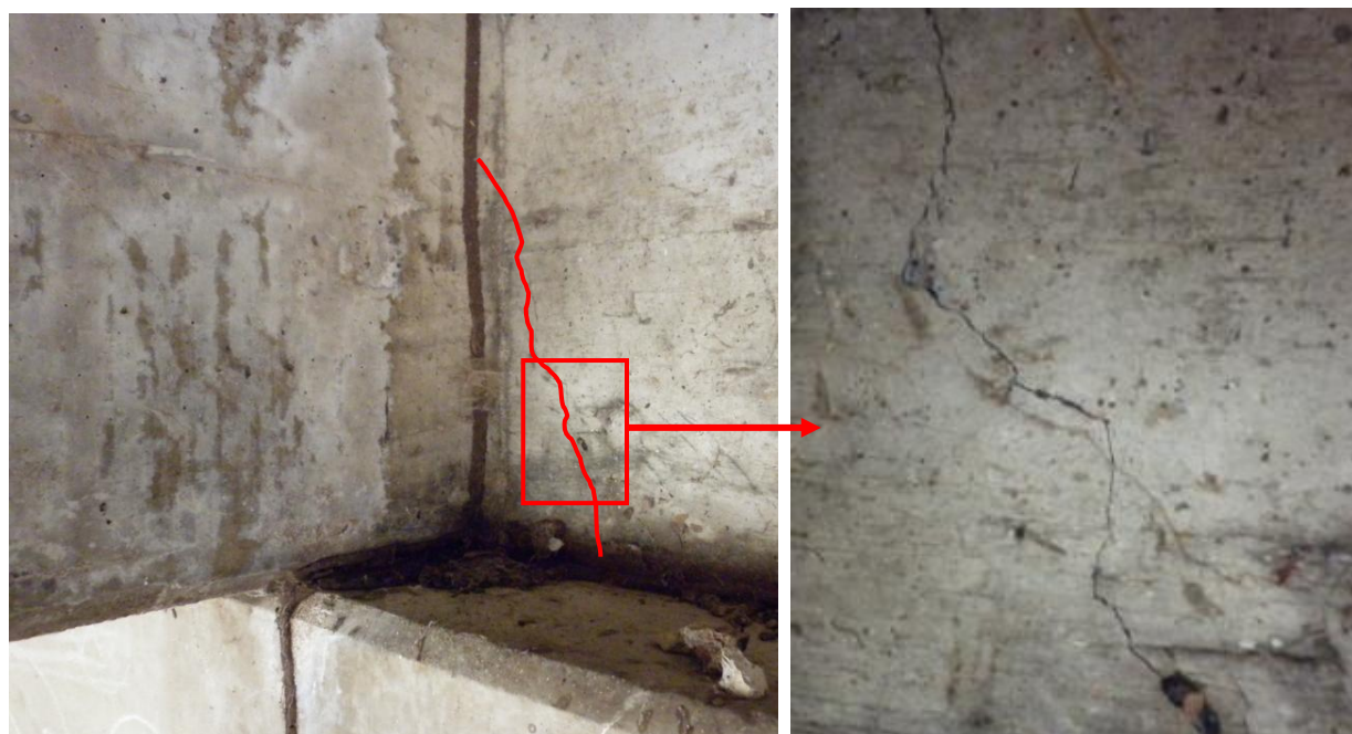
Figura 30. Grieta por cortante en viga diafragma de concreto sobre el bastión 2.
