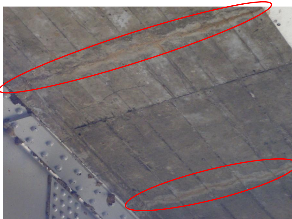
Figura 19. Detalle de eflorescencia en grietas transversales (tramo 2).
