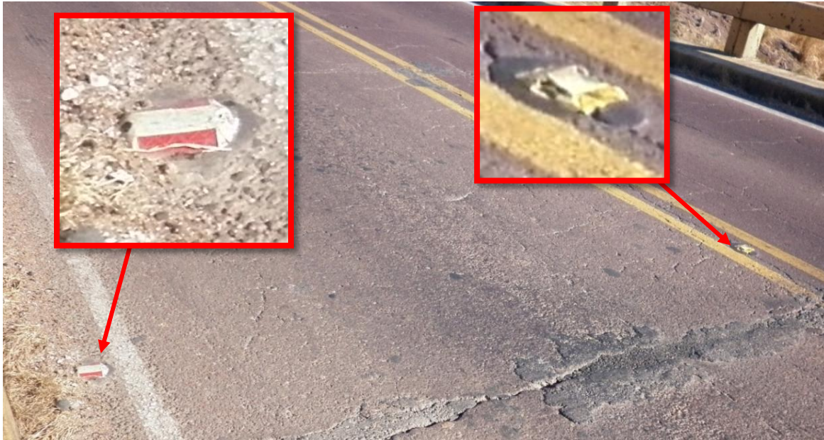
Figura 11. Captaluces en mal estado.
