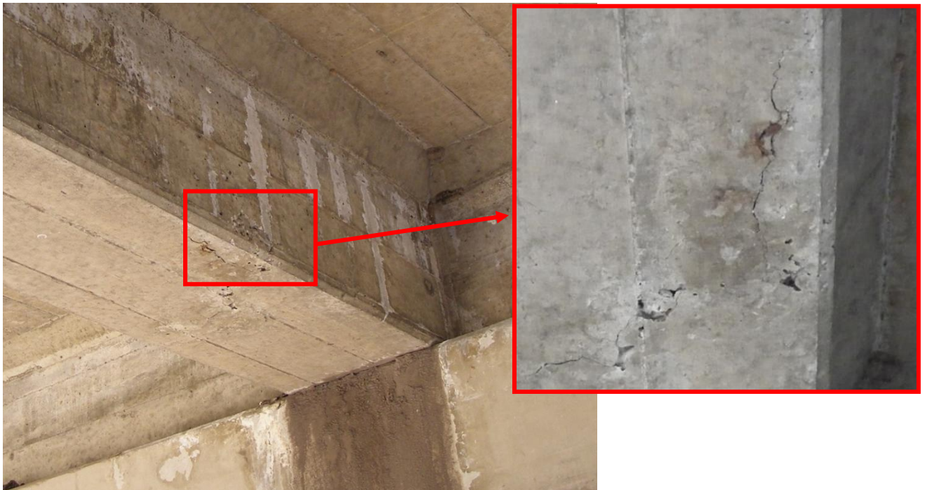
Figura 20. Indicio de desprendimientos de concreto en viga principal (tramo 1).
