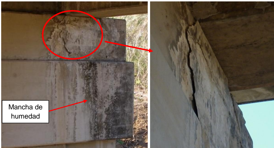
Figura 28. Desprendimiento de concreto y signos de humedad por filtración de agua a través de la junta en la viga cabezal de la pila 1.
