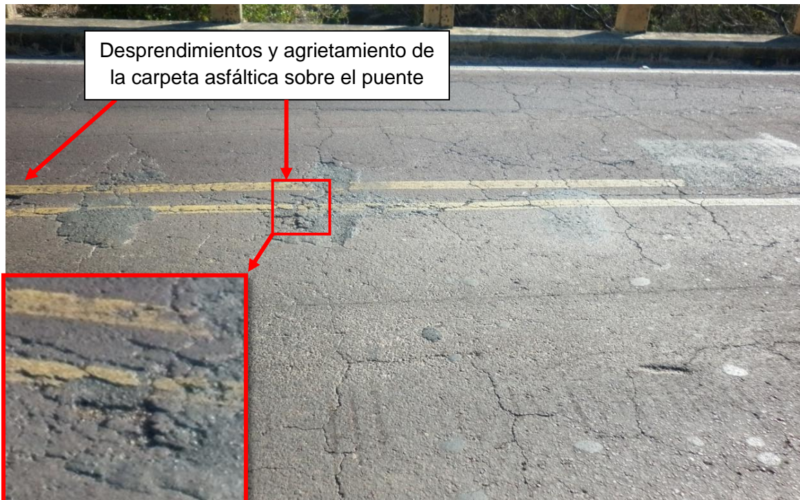
Figura 12. La carpeta asfáltica mostraba agrietamiento en dos direcciones y desprendimientos puntuales
