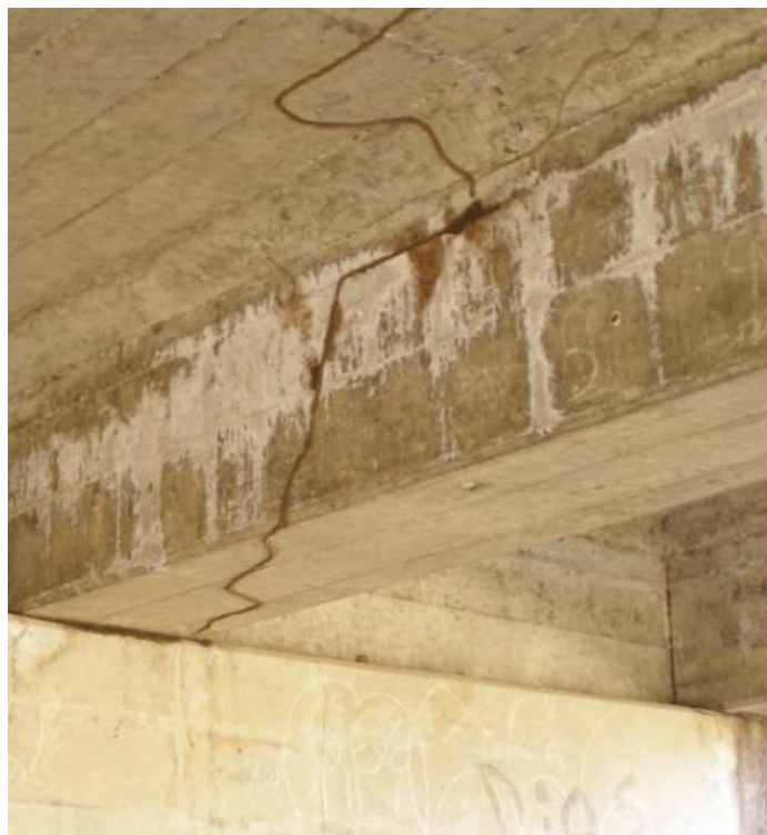
Figura 24. Eflorescencia a ambos lados de las vigas principales de concreto (tramo 1).
