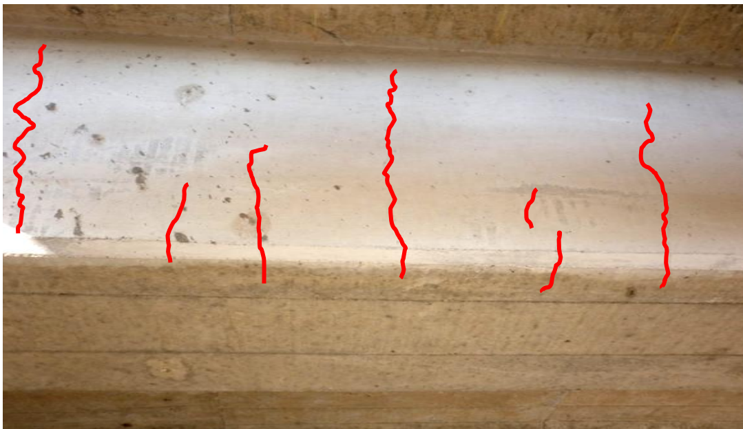
Figura 23. Grietas por flexión al centro de la viga principal externa (tramo 3).
