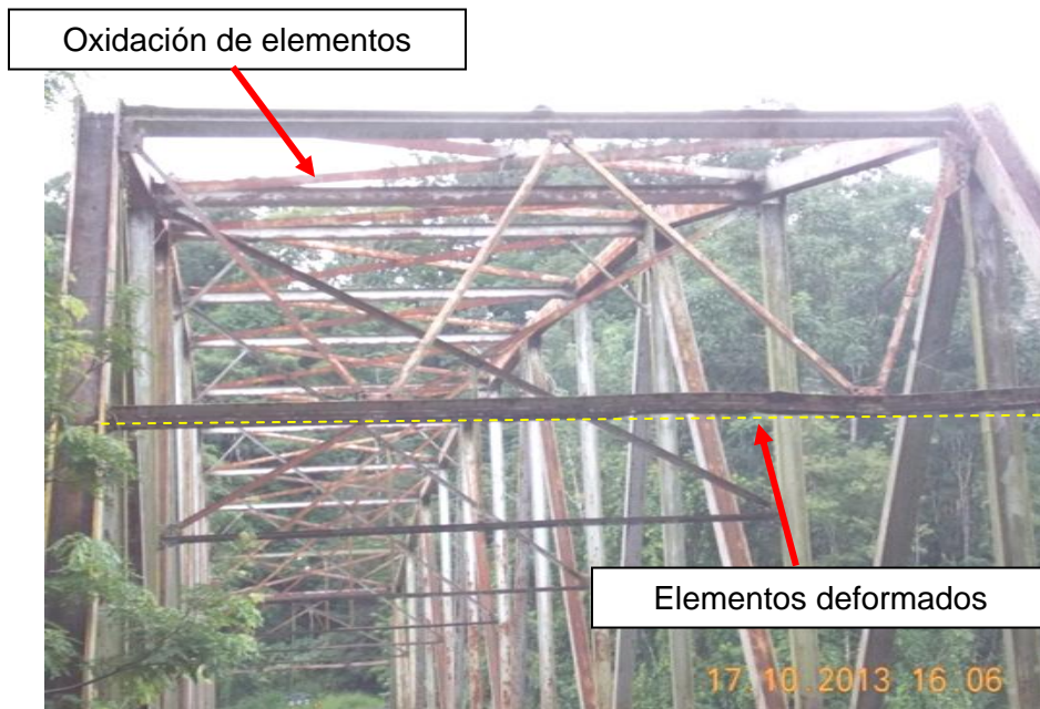
Figura 12: Oxidación del sistema de arriostramiento superior del puente y deformación de elementos por impactos en los arriostres verticales. (típico)
