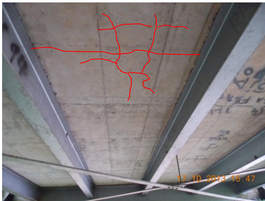
Figura 6: Agrietamiento en dos direcciones en la superficie inferior de la losa cerca del bastión 1
