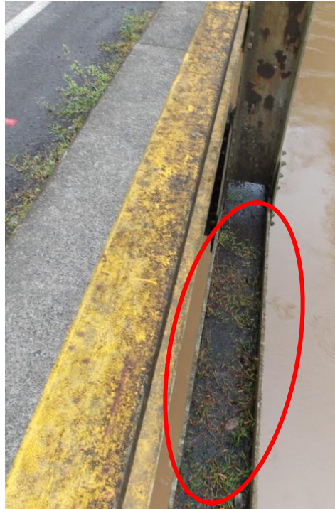
Figura 11: Acumulación de sedimentos, agua y vegetación en cuerda inferior de la armadura
