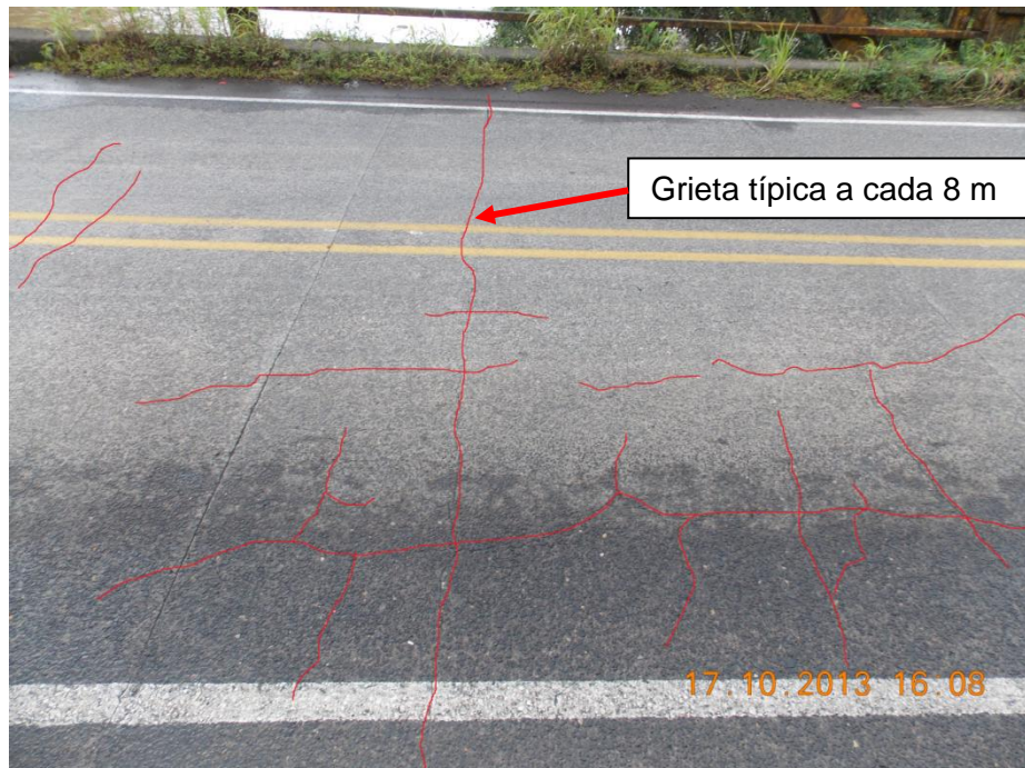
Figura 5: Agrietamiento en dos direcciones en la superficie superior de la losa del puente. (típico)
