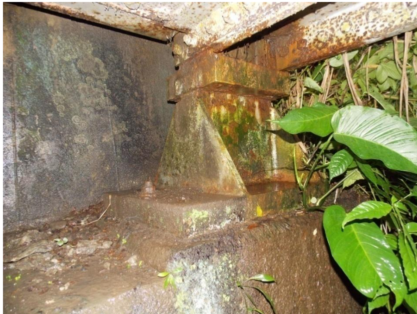
Figura 18: Oxidación y ambiente húmedo en el apoyo fijo sur sobre el bastión 1
