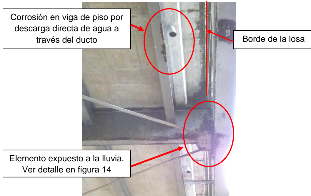
Figura 13: Ductos de drenaje sin extensión que descargan el agua directamente sobre los elementos estructurales y elementos expuestos directamente a la intemperie. (típico)
