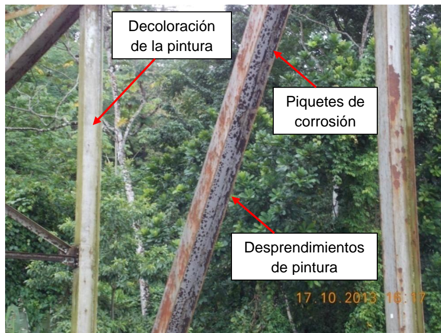
Figura 10: Detalle de decoloración, desprendimientos de la pintura y piquetes de corrosión en elementos principales de la armadura (típico)
