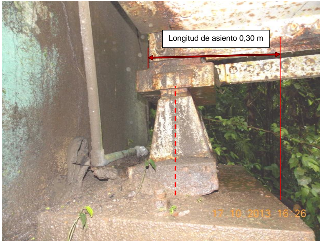
Figura 19: Longitud de asiento, inclinación, oxidación y ambiente húmedo en el apoyo expansivo sur sobre el bastión 2
