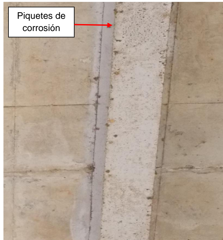
Figura 17: Detalle típico mostrando piquetes de corrosión en las vigas de piso longitudinales.
