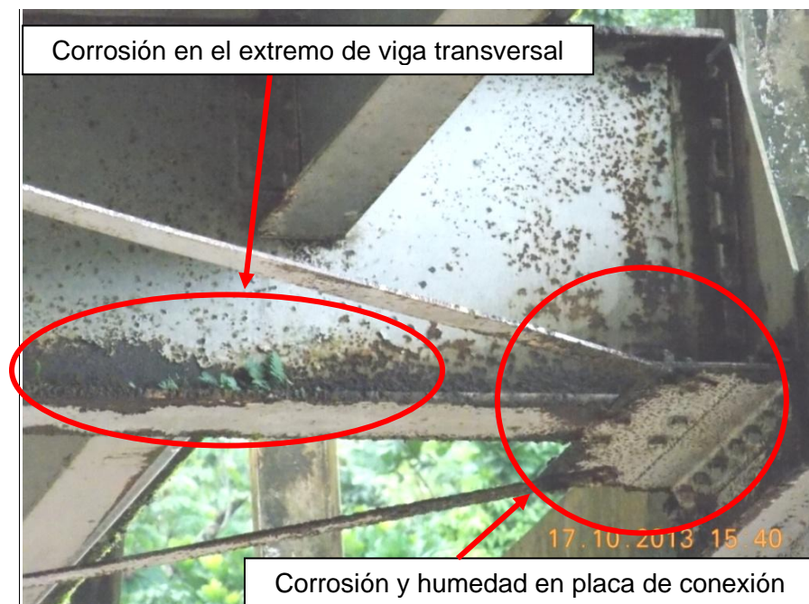
Figura 14: Corrosión en las conexiones del sistema de arriostramiento inferior y en las vigas transversales debido a la exposición directa a la lluvia (típico)
