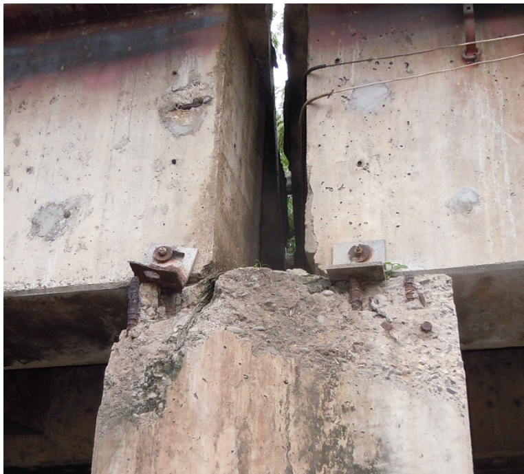
Fotografía n.º 5: Desplazamiento de la superestructura, desprendimientos, acero de refuerzo expuesto y corroído y pernos de anclaje fallados en apoyos del puente (pila n.º 4) (Fuente: Castillo-Barahona, 2013)
