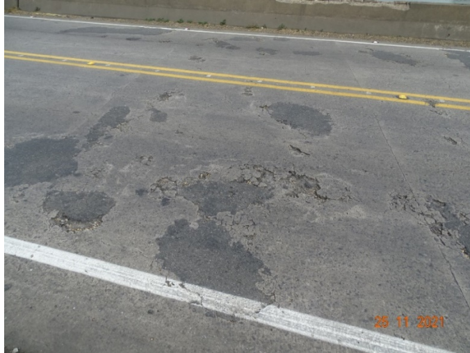
Fotografía n.º 4: Grietas, desprendimientos de concreto y la mala práctica de rellenar los baches del tablero con mezcla asfáltica.
