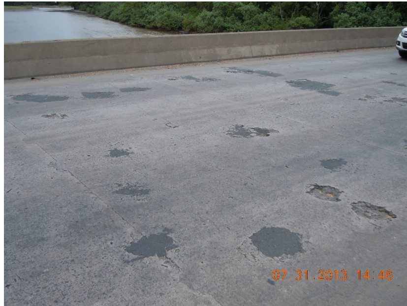
Fotografía n.º 6: Grietas, desprendimientos de concreto y la mala práctica de rellenar los huecos del tablero con mezcla asfáltica.
