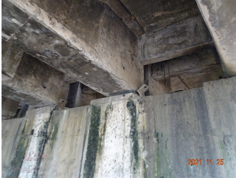
Fotografía n.º 2: Placas desalineadas en apoyos de cabezal de pila n.º 4.
