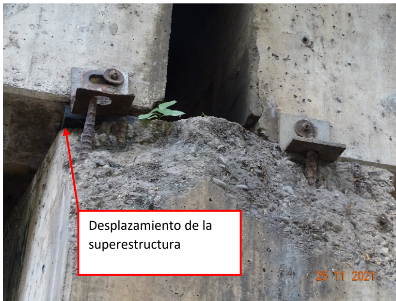
Fotografía n.º 1. Desplazamiento de la superestructura debido a la pérdida de restricción del apoyo por a la falla de los pernos de anclaje (pila n.º 4).
