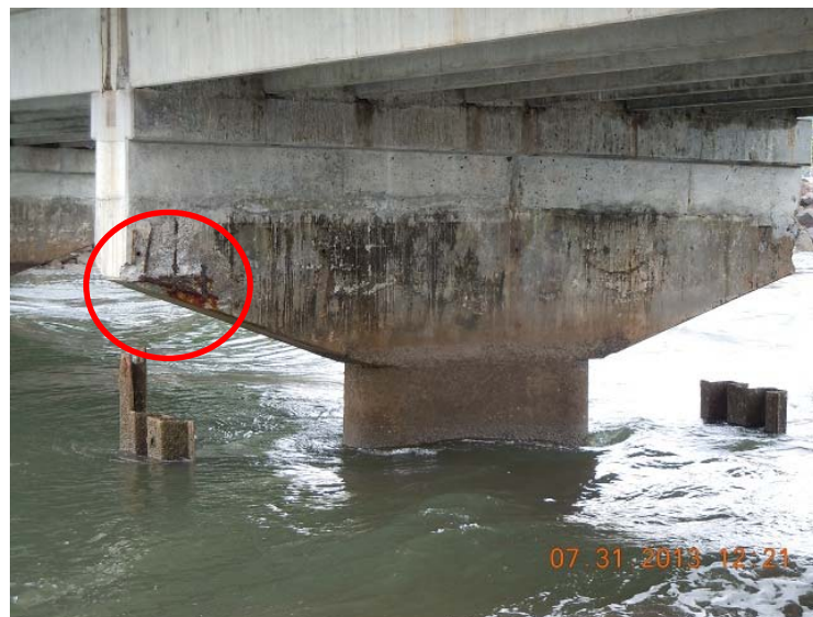
Figura 12: Vista de pila 1. Nótese el desprendimiento del recubrimiento y el acero de refuerzo corroído.
