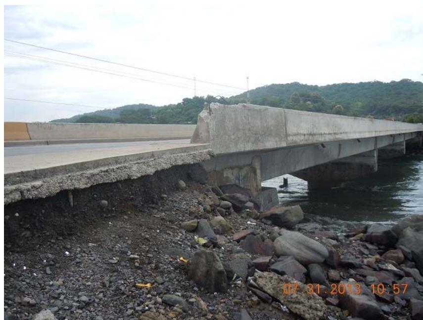
Figura 4: Erosión del talud lateral del acceso norte.
