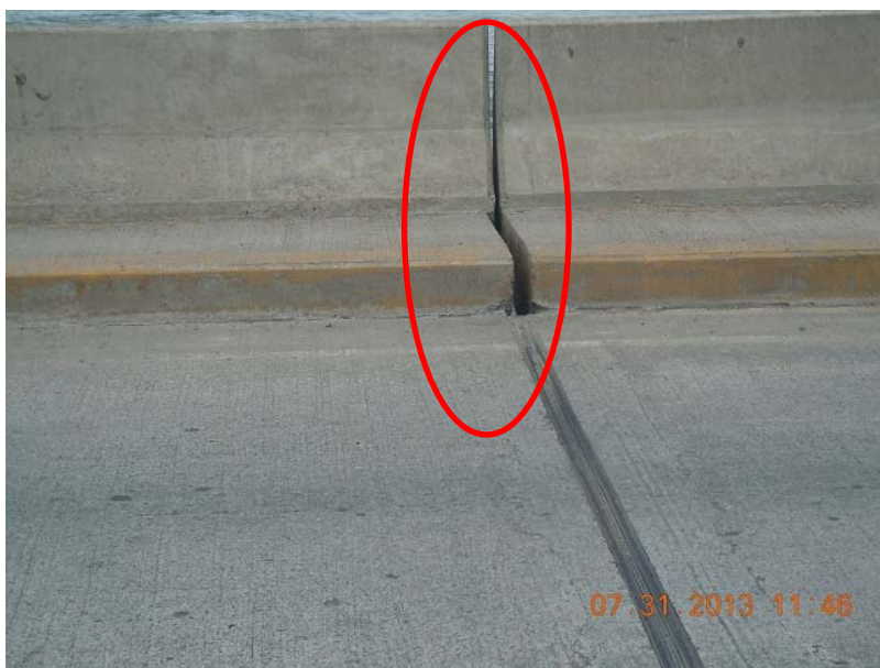
Figura 6: Junta de expansión, nótese que en acera no hay sello.
