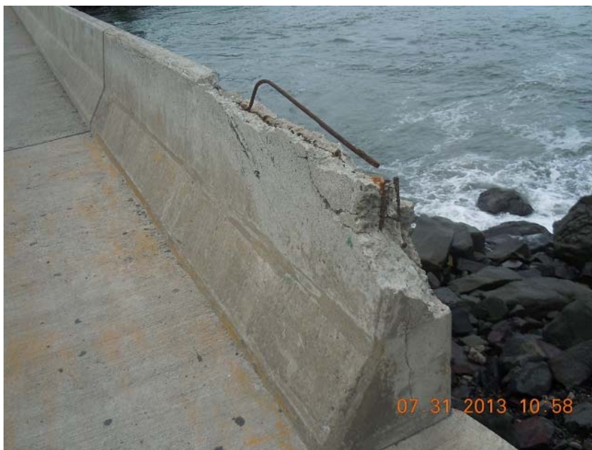
Figura 1: Daño en la barrera vehicular en el acceso norte (desprendimiento del concreto y acero de refuerzo expuesto).
