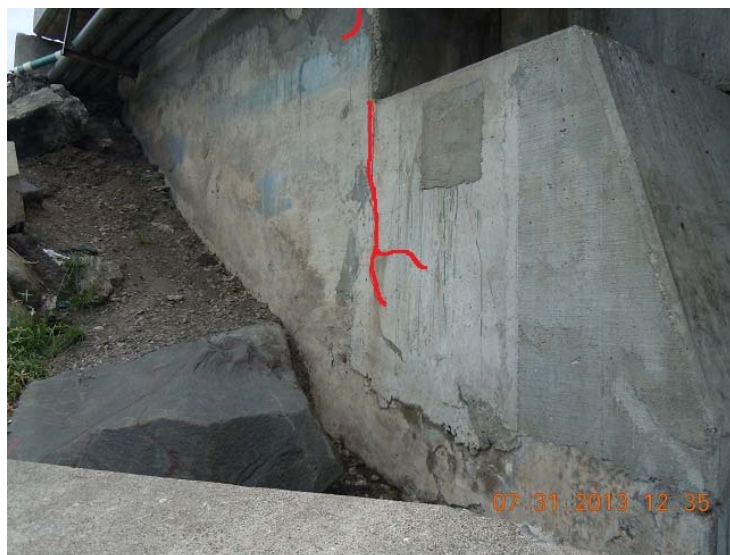
Figura 15: Vista de bastión 2. Se resalta el agrietamiento observado en el cuerpo del bastión 2
