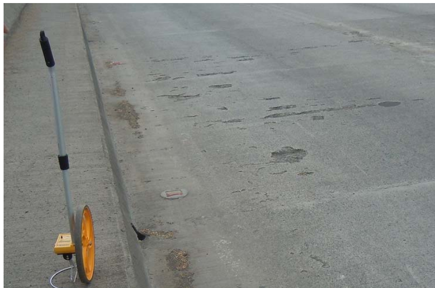
Figura 3: Baches en la superficie de rodamiento.
