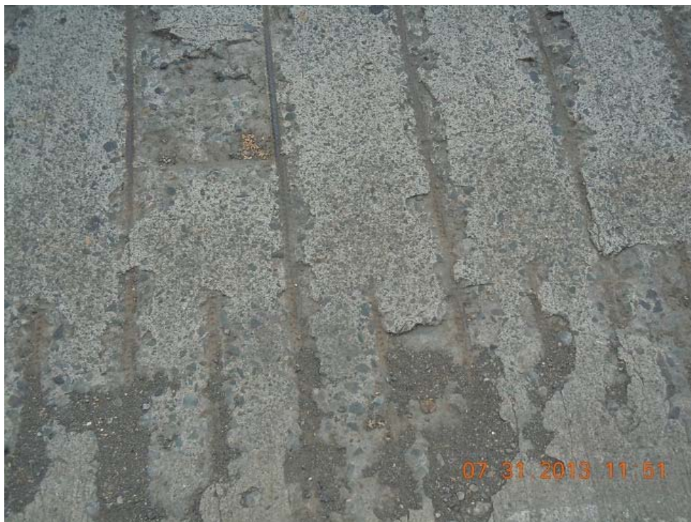
Figura 8: Descascaramiento de la losa de concreto, nótese que el refuerzo transversal de la losa está expuesto a la intemperie.
