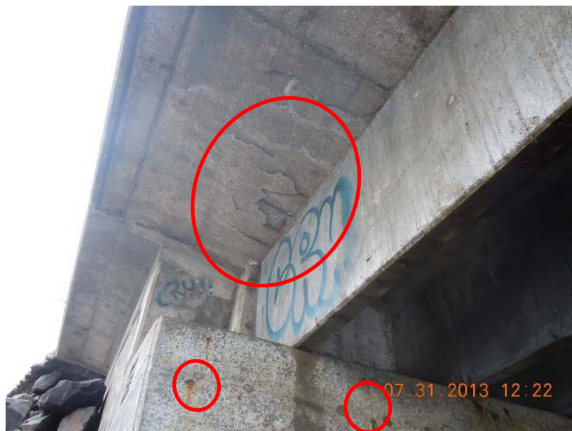
Figura 10: Agrietamiento en voladizo y manchas de oxidación en bastión 1.
