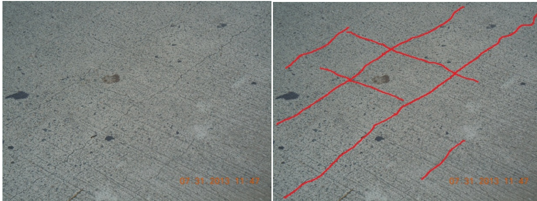
Figura 7: Grietas en la losa de concreto, resaltadas a la derecha.
