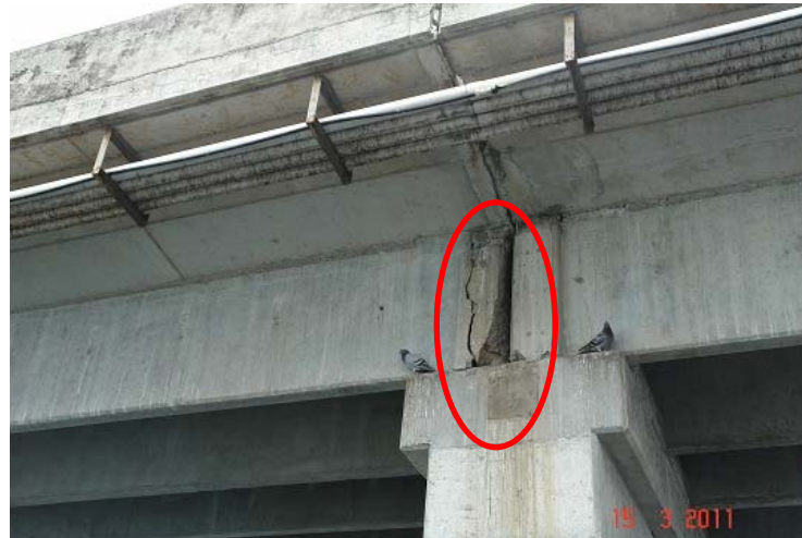
Figura 11: Viga doble T apoyada sobre la pila 1. Nótese la grieta vertical en el extremo de la viga externa del costado este.
