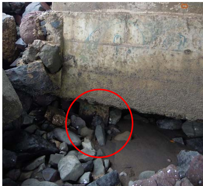
Figura 16: Socavación en fundación del bastión 1. Nótese que el pilote de acero está expuesto y presenta corrosión
