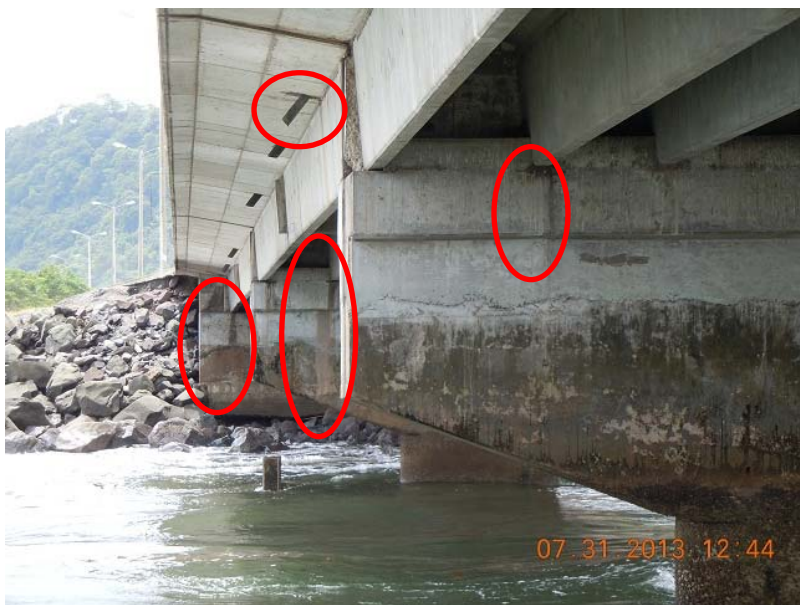
Figura 5: Filtración de agua a través de las juntas de expansión de las aceras sobre pilas y bastión 1. Longitud de tubos de extensión no cumple la normativa AASHTO LRFD 2012
