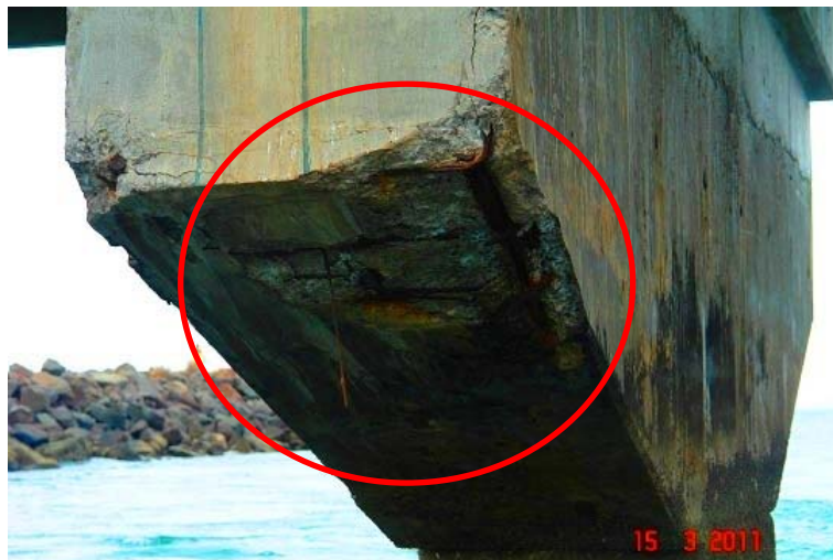
Figura 13: Vista de pila 2. Nótese el desprendimiento del recubrimiento concreto y el acero de refuerzo corroído.
