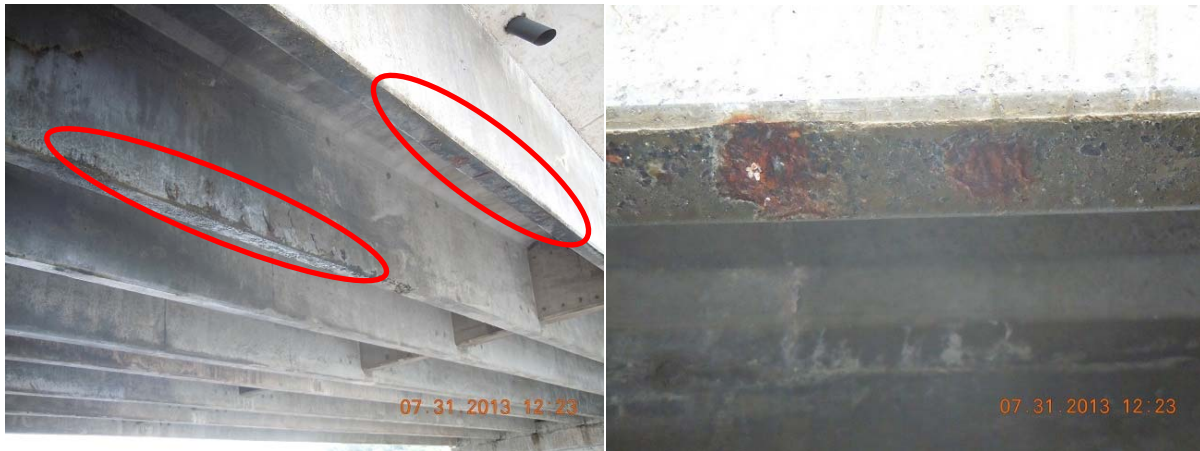
Figura 9: Oxidación en almas de viga oeste de tramo 1.
