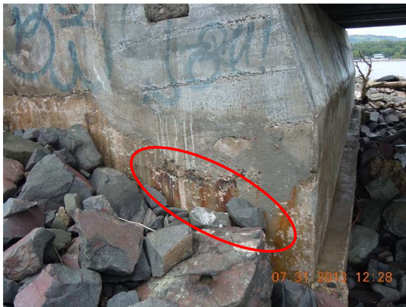
Figura 14: Cara oeste del bastión 1. Nótese las manchas de oxidación producto del contacto con el agua de mar.
