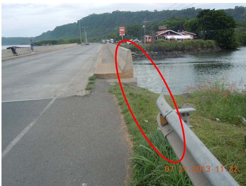
Figura 2: Guardavía del acceso sur. Nótese que no está conectado a la barrera del puente
