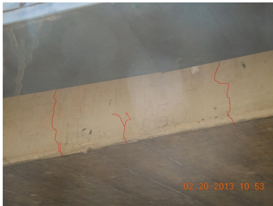
Figura 9: Grietas de flexión en el medio del tramo 1 de la losa de concreto.
