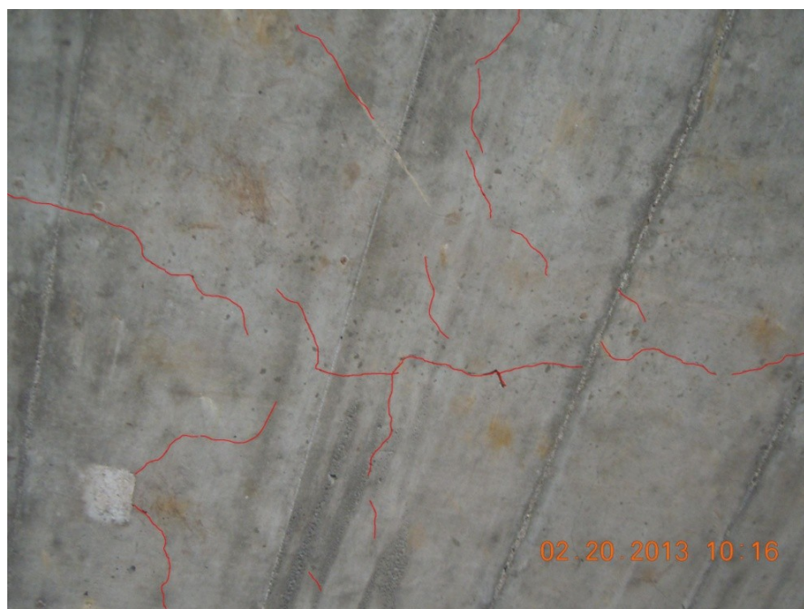
Figura 10 Grietas en dos direcciones en el medio del tramo 1 de la losa de concreto.
