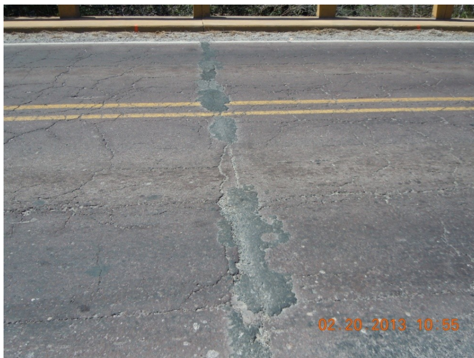
Figura 8: Juntas de expansión sobre el marco 4 cubierta por una sobrecapa de asfalto.
