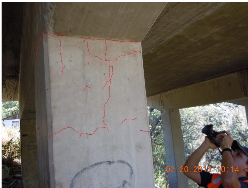
Figura 13: Agrietamiento en la columna este de pila 1.
