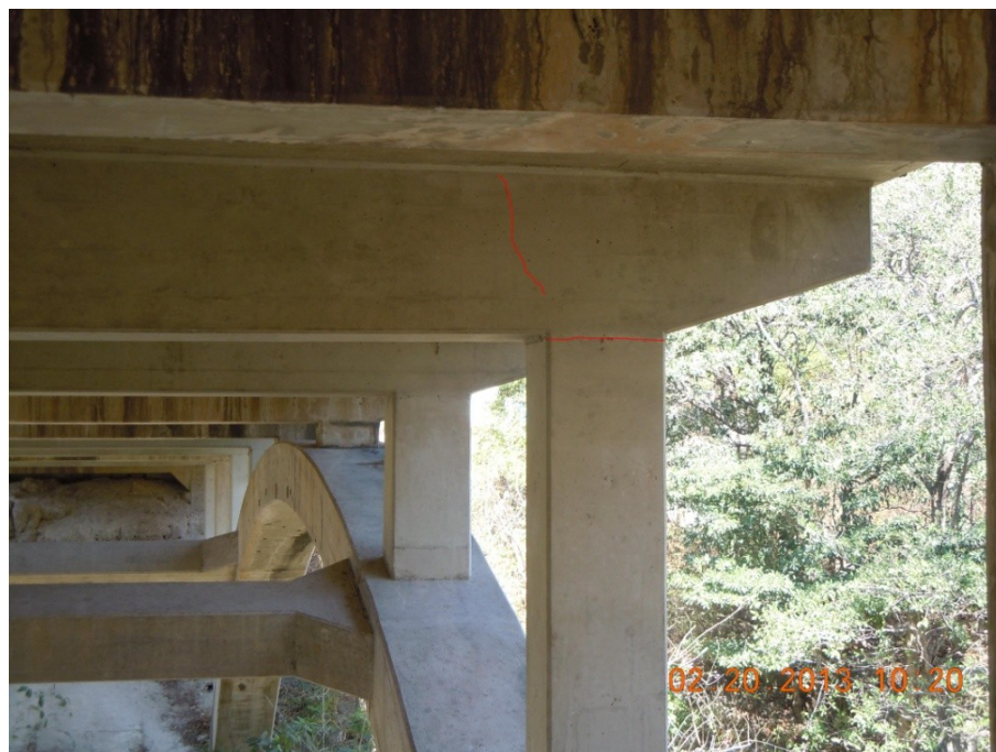
Figura 11: Grietas en el marco 2 del arco.
