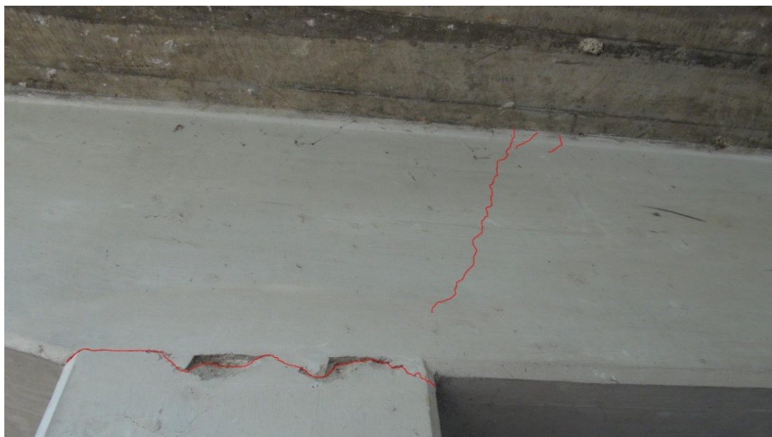
Figura 14: Grietas de cortante en el nudo oeste de la pila 1.
