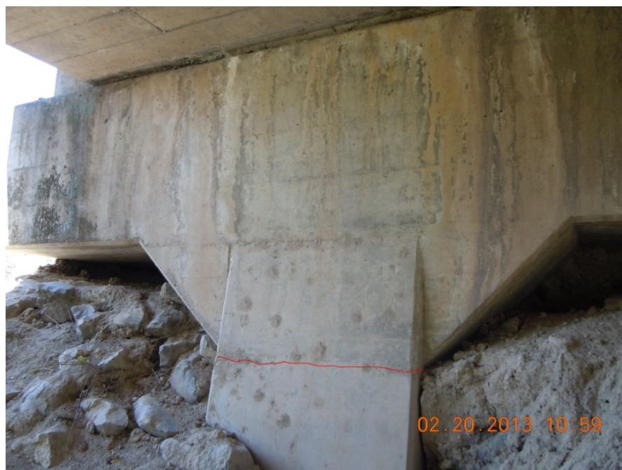
Figura 12: Grieta transversal en columna del bastión 1.
