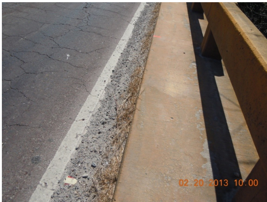
Figura 6: Acumulación de sedimentos en los bordillos y obstrucción de los ductos de desagüe.
