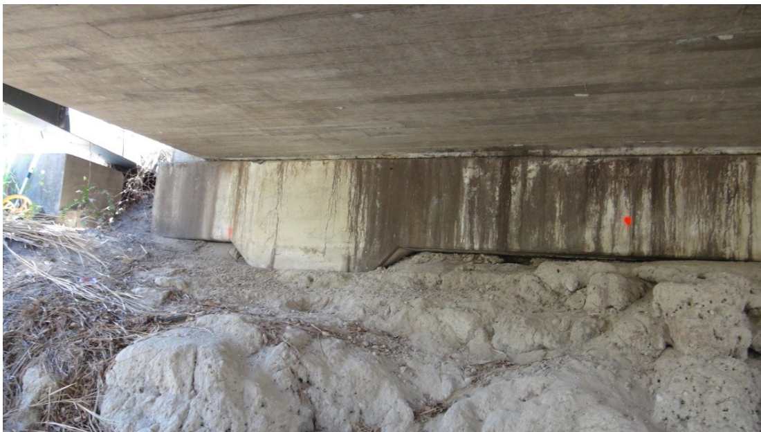
Figura 7: Evidencia de filtraciones a través de las juntas de expansión sobre el bastión norte.
