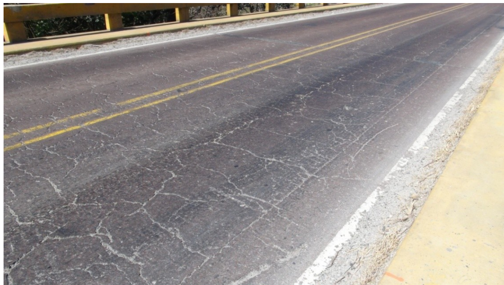
Figura 5: Carpeta asfáltica severamente agrietada, ausencia de captaluces y demarcación horizontal borrosa.
