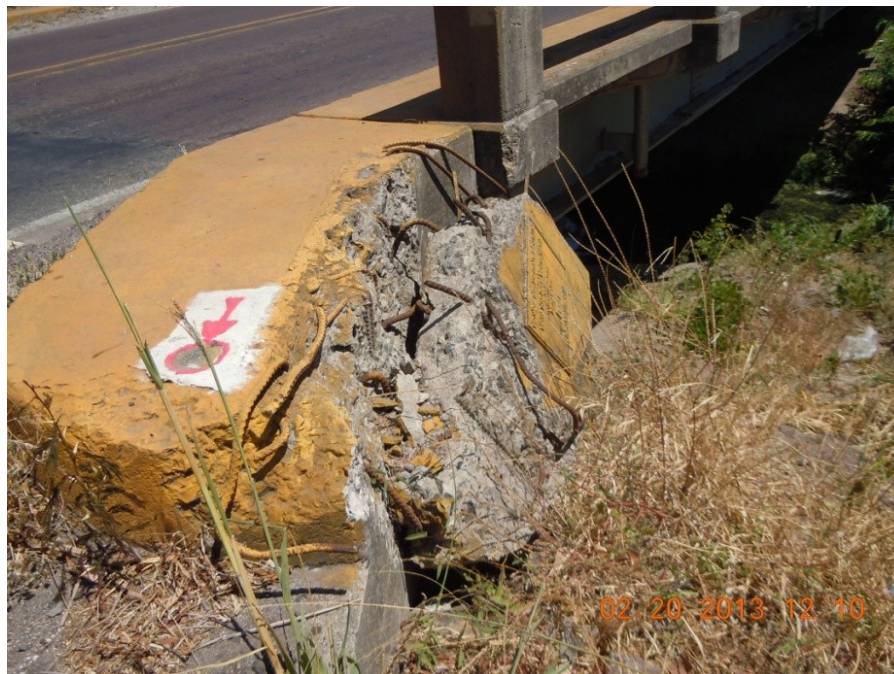
Figura 4: Daño en la barrera de concreto del acceso sur.
