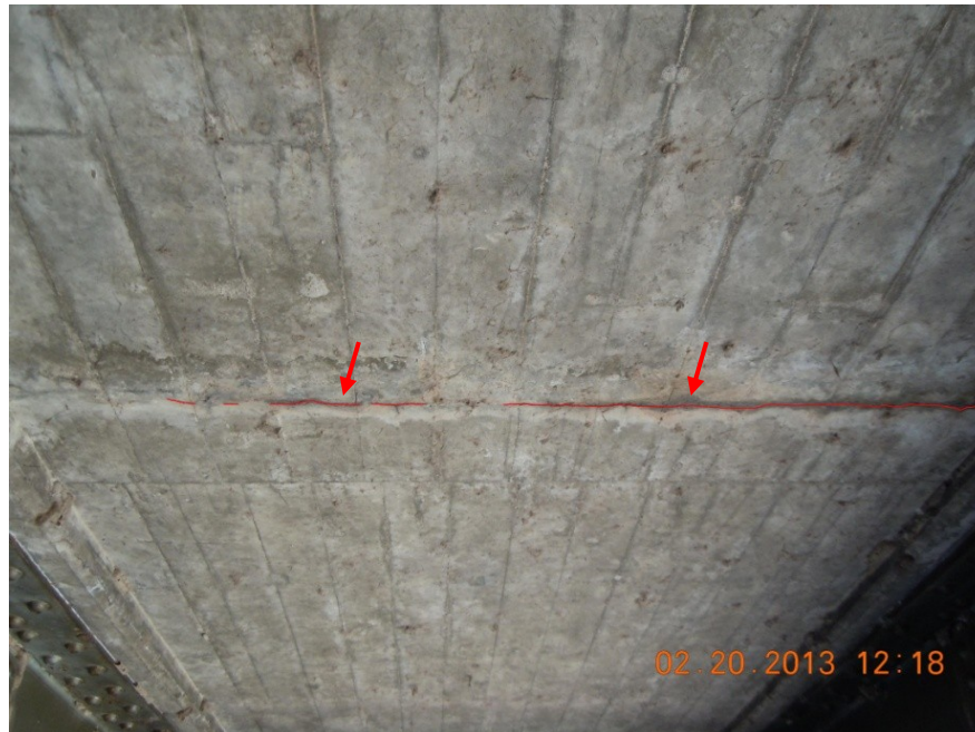
Figura 9: Grietas transversales en la losa de concreto.
