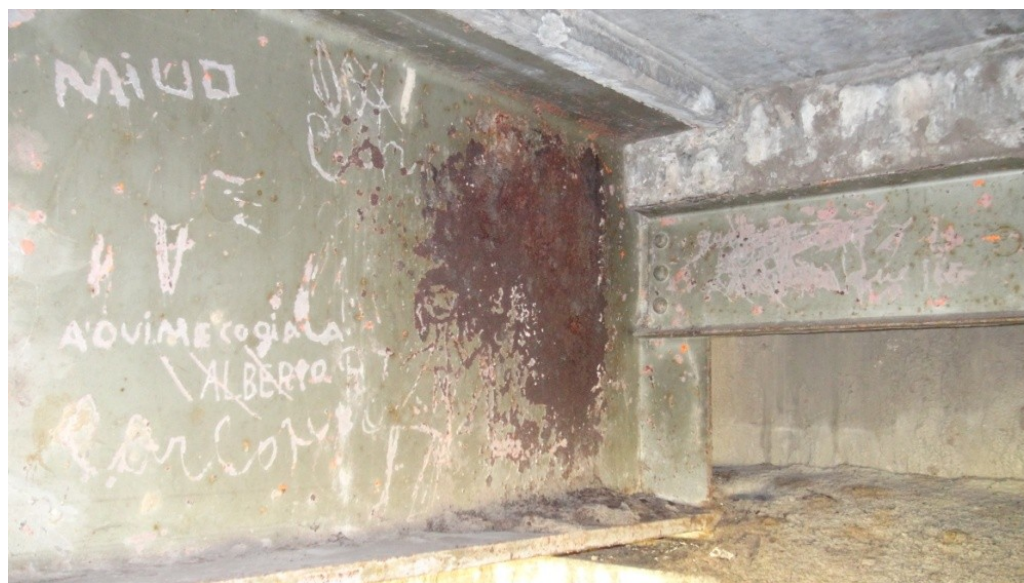
Figura 11: Corrosión en el extremo de una viga principal.
