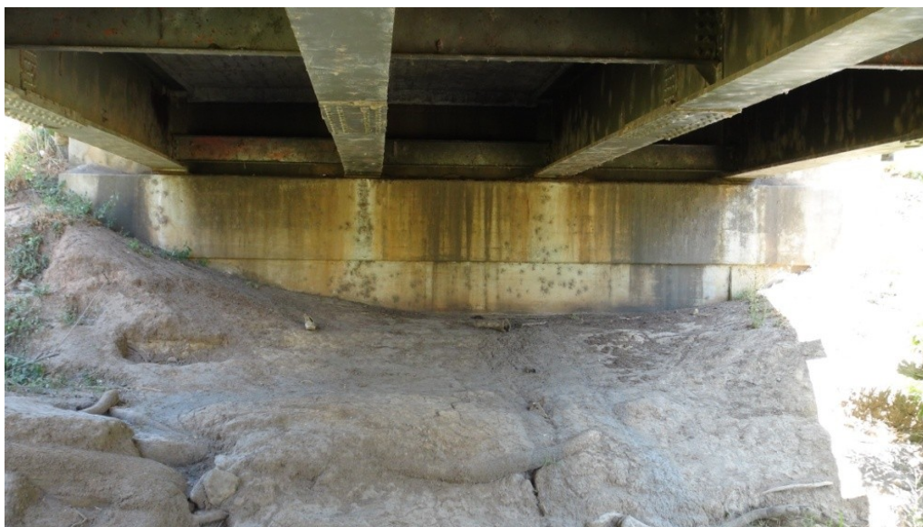
Figura 7: Evidencia de filtraciones a través de las juntas de expansión del bastión sur.
