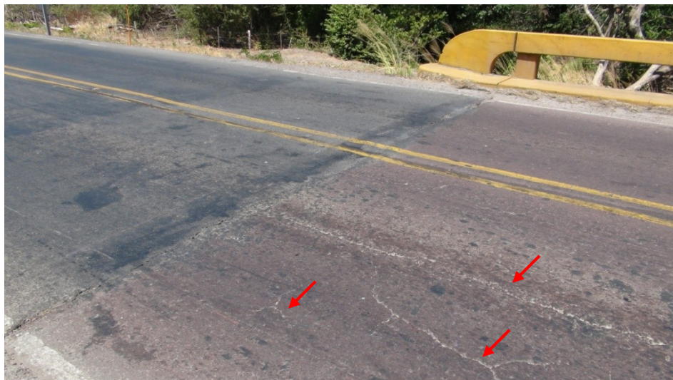
Figura 5: Grietas en la carpeta asfáltica sobre el puente.
