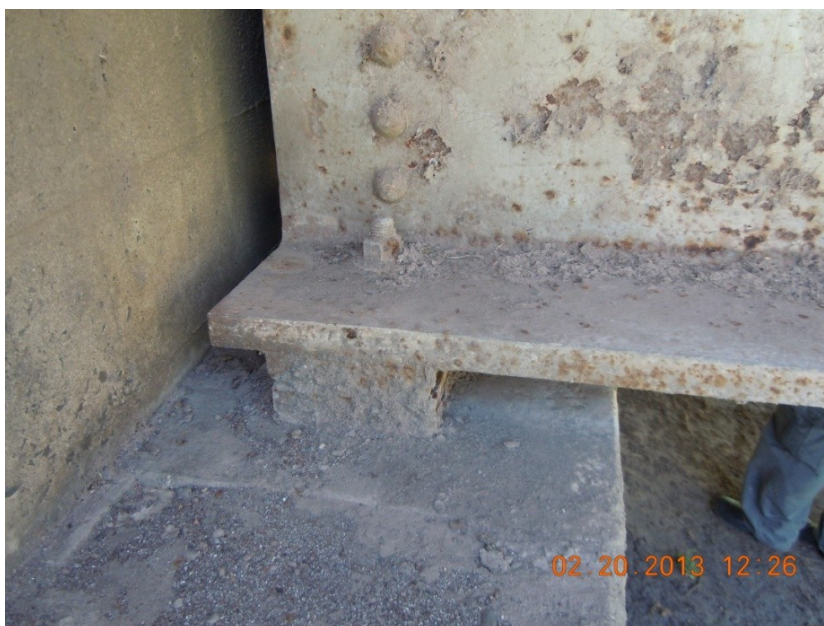
Figura 15: Corrosión de los apoyos y la viga principal de acero.
