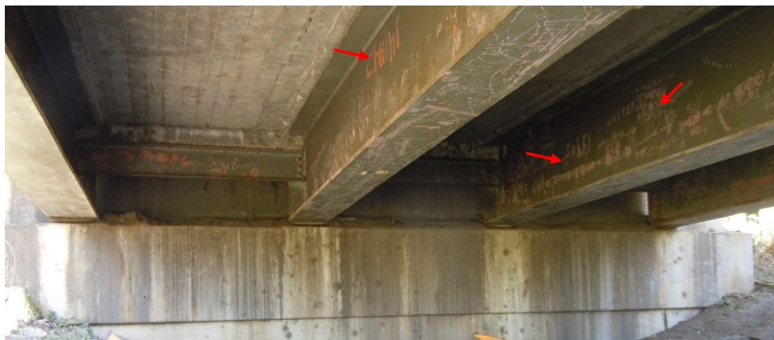
Figura 13: Daño ocasionado en varias zonas por el grafiti y desprendimiento de la capa superficial de pintura.
