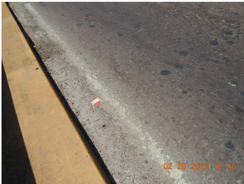
Figura 6: Acumulación de sedimentos en los bordillos y obstrucción de los ductos de desagüe.
