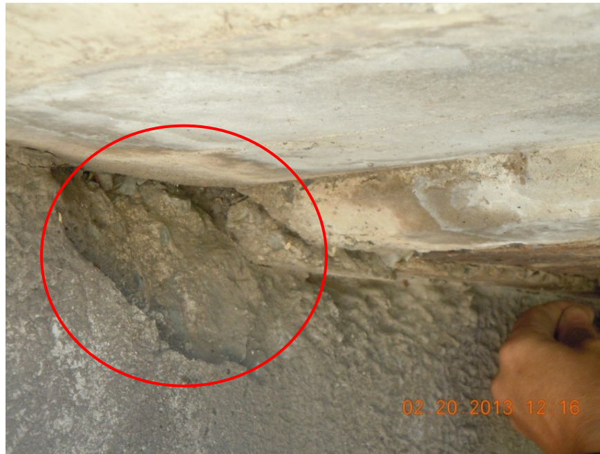
Figura 16: Desprendimiento de concreto en el contacto de la losa con la viga cabezal del bastión.
