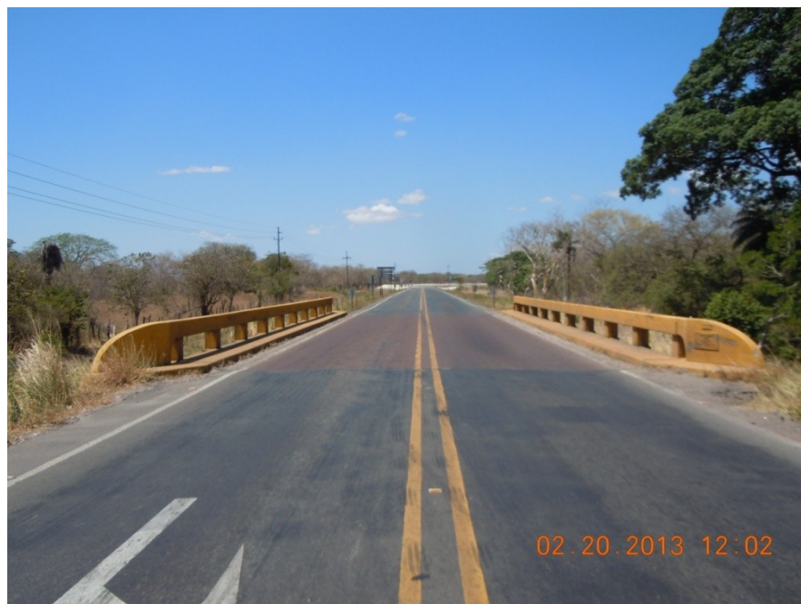
Figura 2: Vista a lo largo de la línea de centro del puente sobre el Río Bagaces.
