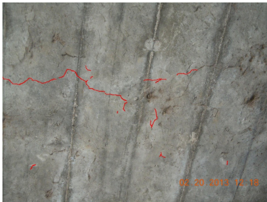
Figura 10: Grietas en dos direcciones en la losa de concreto.
