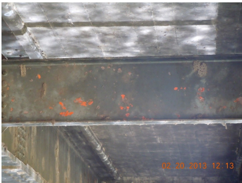
Figura 14: Desprendimiento de la capa superficial del sistema de protección de pintura.
