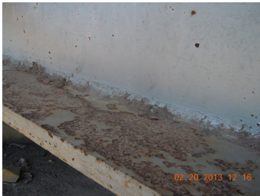
Figura 12: Inicios de corrosión en vigas principales.
