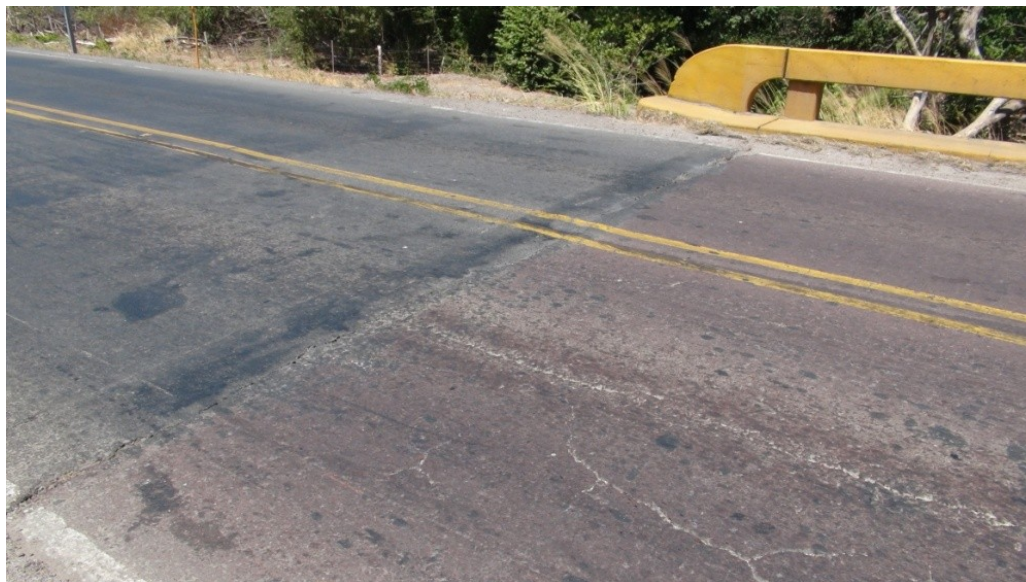
Figura 8: Juntas de expansión sobre el bastión norte obstruida por una sobrecapa de asfalto.
