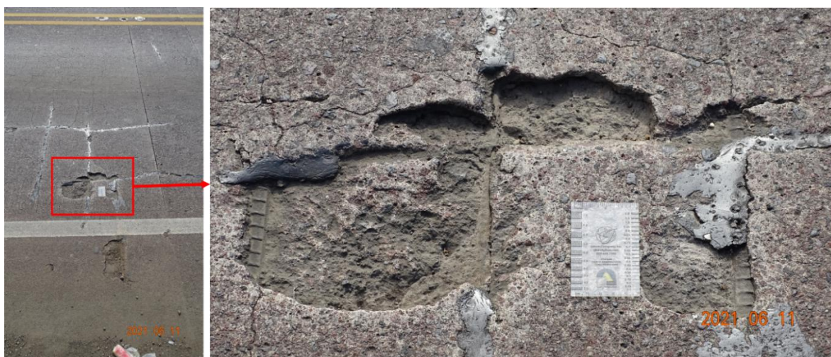
Figura 5.13. Agrietamiento en una y dos direcciones y desprendimientos de concreto con acero expuesto en la cara superior del tablero del tramo n.º 6 del puente (inspección de junio de 2021).
