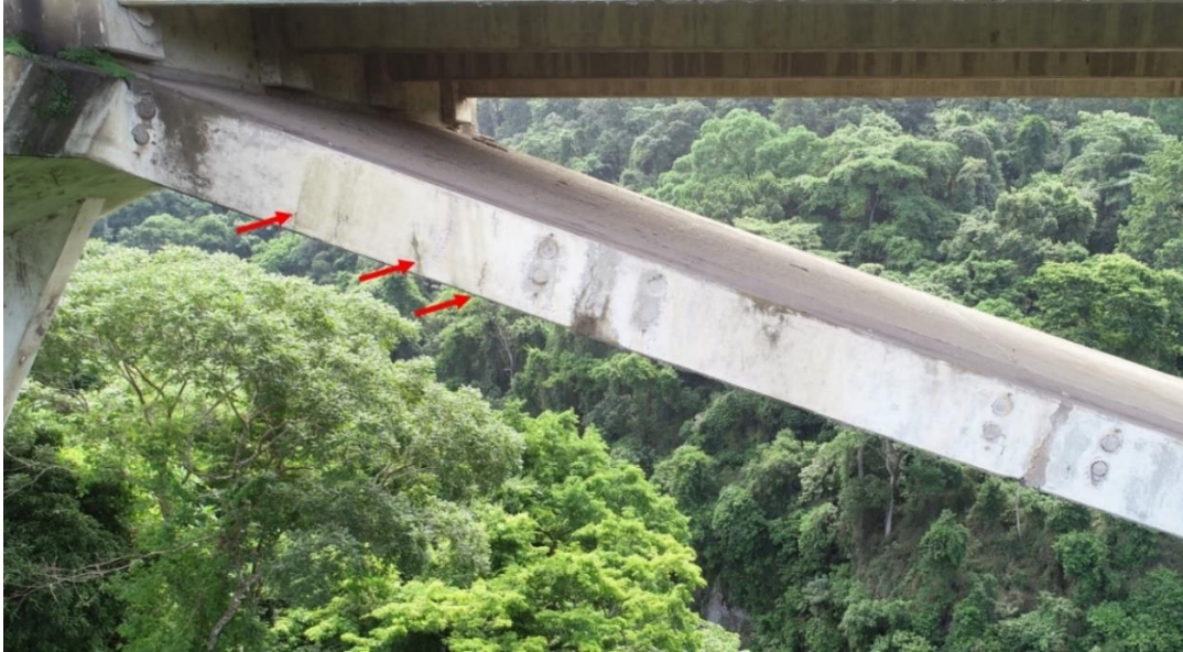
Figura 5.15. Agrietamiento en la banda tensada del tramo n.º 7.
