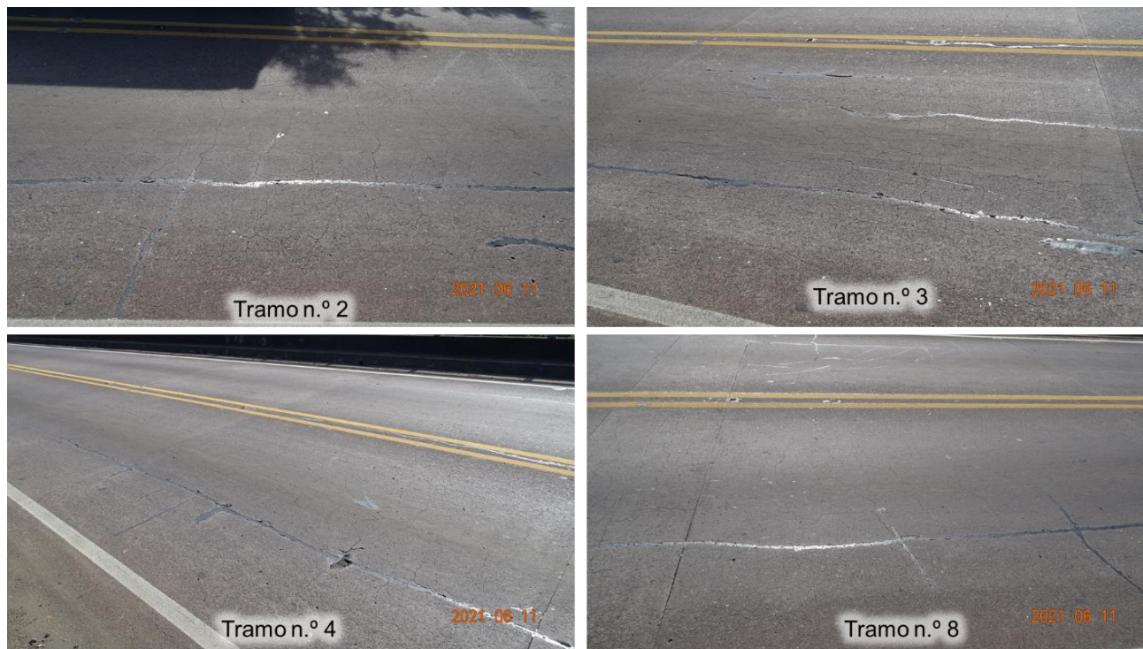
Figura 5.12. Agrietamiento en una y dos direcciones en la cara superior del tablero del puente (inspección de junio de 2021).
