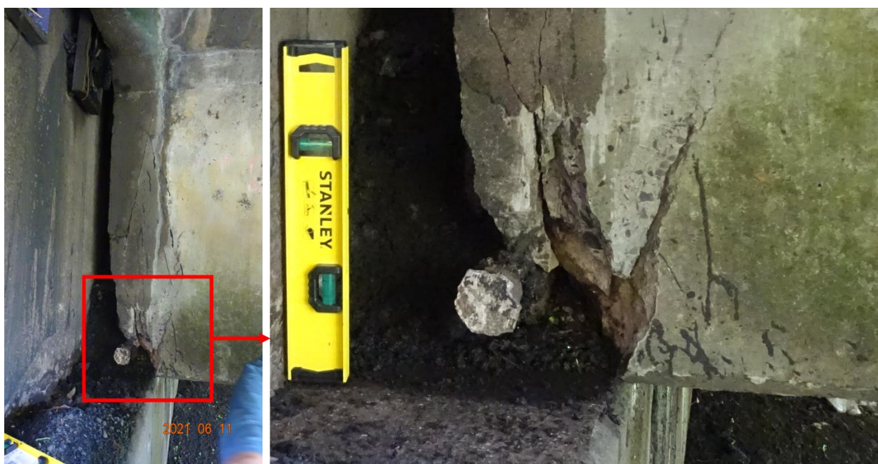
Figura 5.9. Desprendimientos de concreto en el extremo de la viga T externa, al costado aguas abajo del tramo n.º 9 (inspección de junio de 2021).
