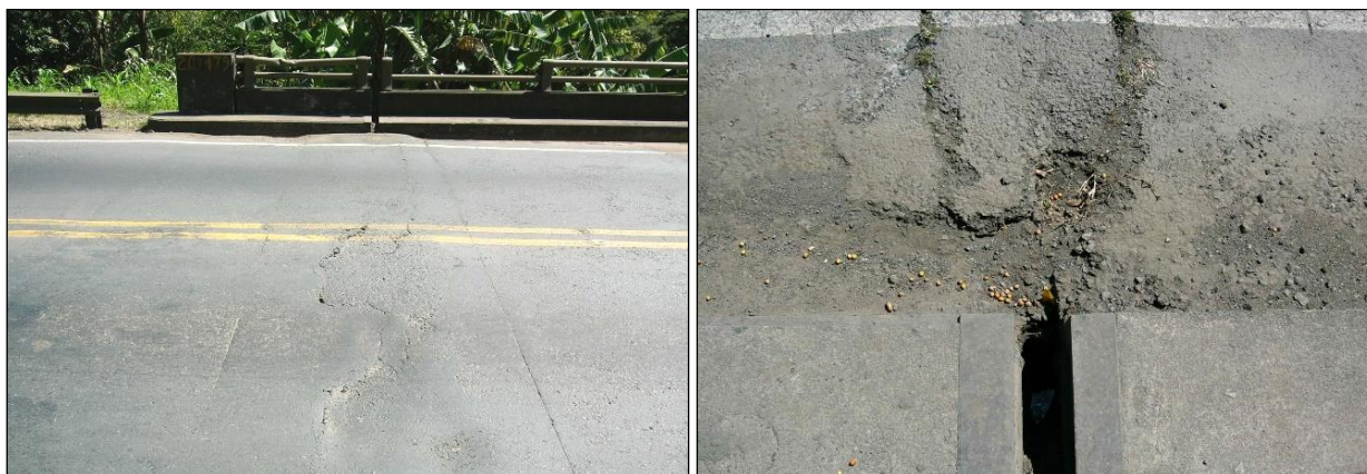
Figura 5.3. Fotografías del año 2006 de la junta de expansión n.º 2 del puente Rafael Iglesias con sobrecapas de mezcla asfáltica (Fuente: Rodríguez-Roblero, 2007).
