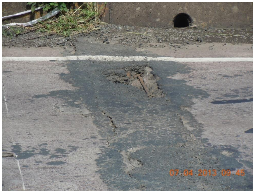
Figura 5.2. Fotografía del año 2013 de la junta de expansión n.º 1 del puente Rafael Iglesias con sobrecapas de mezcla asfáltica, desprendimientos de concreto y acero de refuerzo expuesto en los bordes de la losa adyacente a la junta (inspección de julio de 2013).
