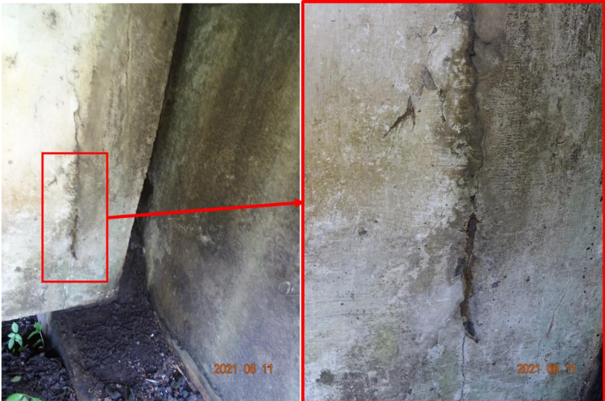
Figura 5.10. Agrietamiento en una dirección en el extremo de la viga T externa, al costado aguas abajo del tramo n.º 1 (inspección de junio de 2021).
