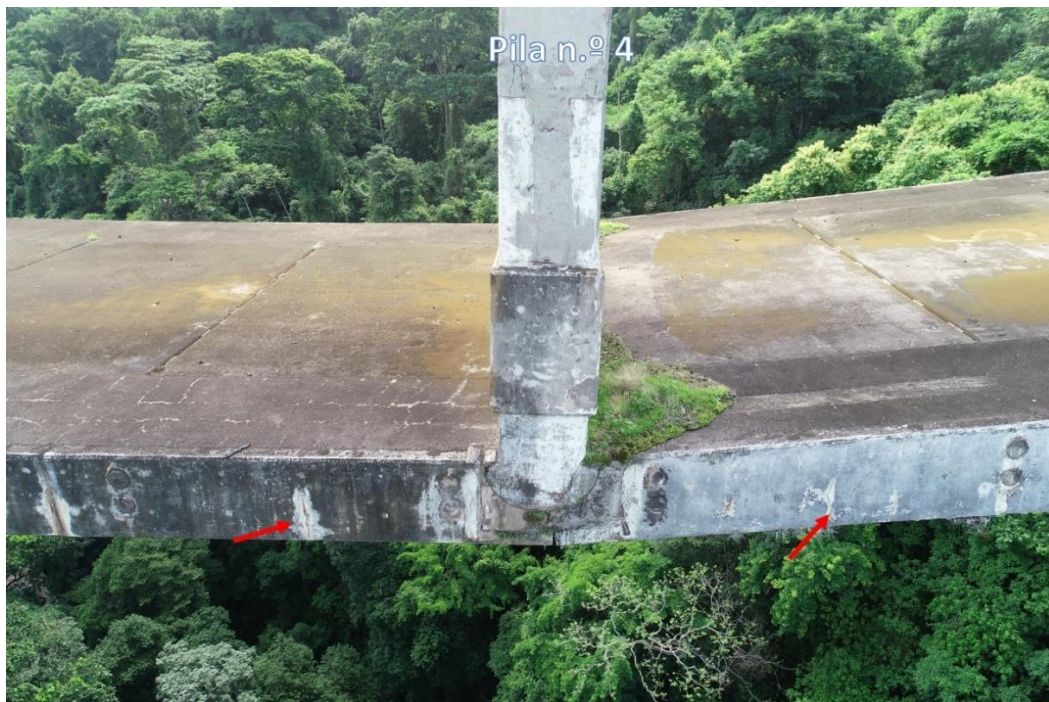
Figura 5.16. Agrietamiento en la banda tensada del tramo n.º 4 y n.º 5.
