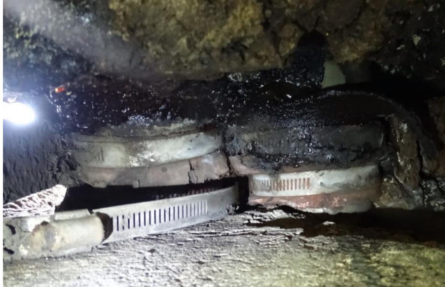
Figura 5.6. Cables A03 y A04, que atraviesan la junta de expansión n.º 1 y donde se observó grasa que se ha salido del ducto, con polvo y basura. No fue posible evaluar los cables debido al recubrimiento de hule.
