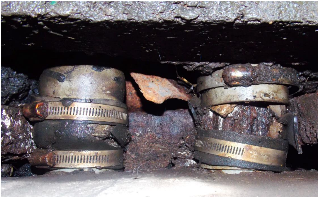
Figura 5.7. Cables que atraviesan la junta de expansión n.º 2 y donde se observó corrosión en el cable C04. No fue posible evaluar el cable C03 debido a la cubierta de hule.
