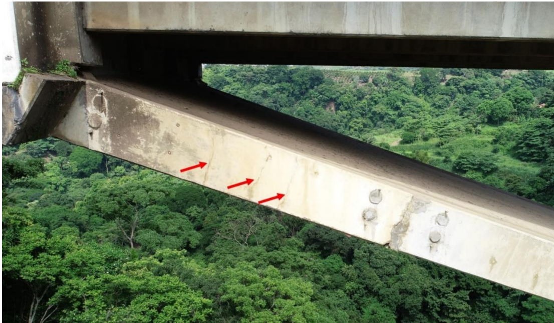
Figura 5.14. Agrietamiento en la banda tensada del tramo n.º 3.
