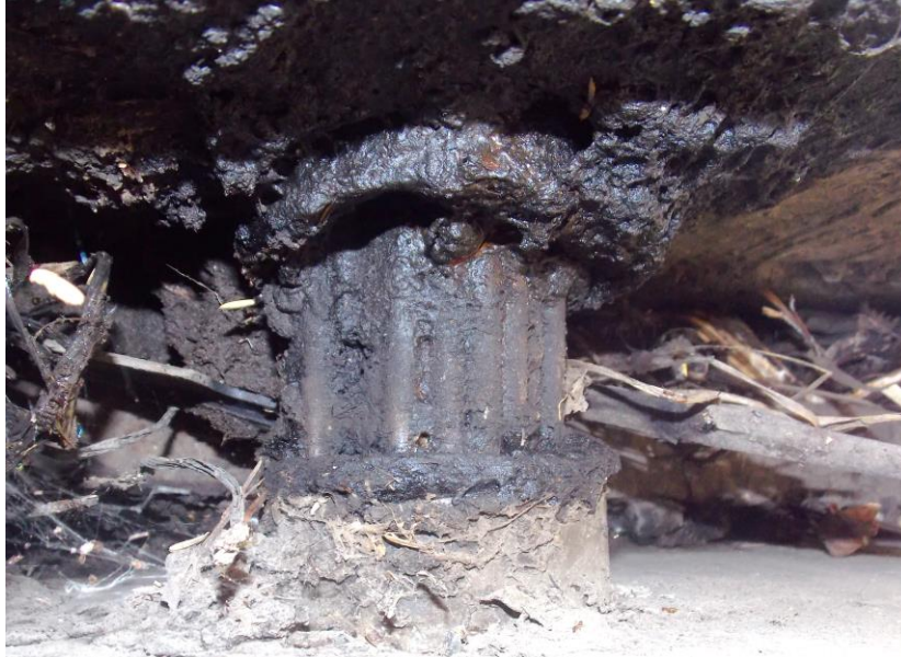
Figura 5.8. Cable C01 que atraviesa la junta de expansión n.º 2, donde se observó oxidación y grasa que se ha salido del ducto, en la cual se acumula polvo y basura.
