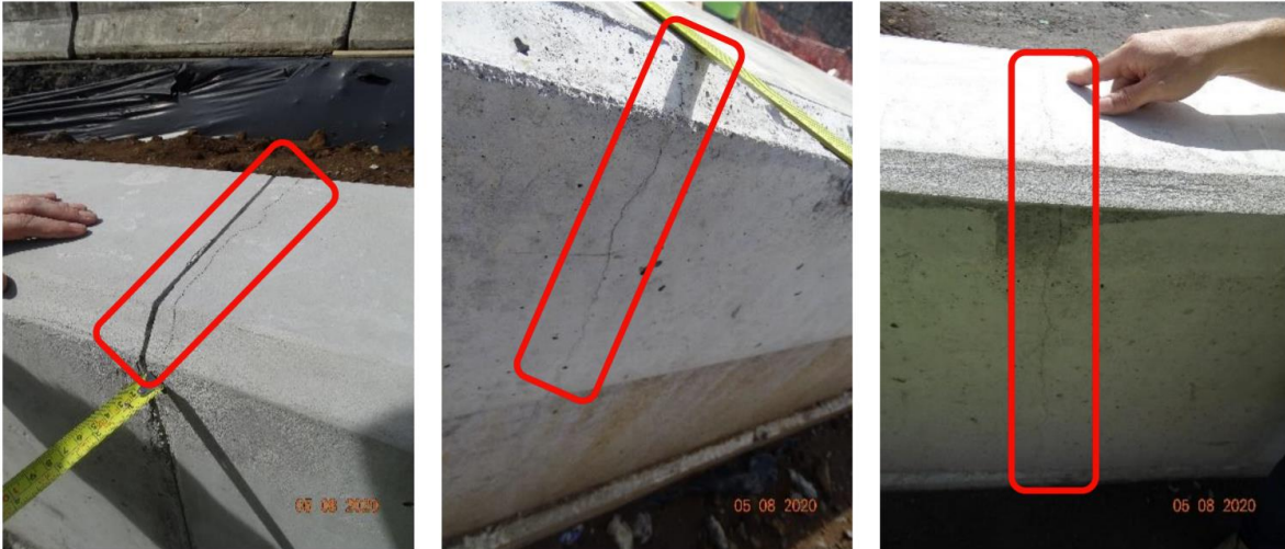
Figura 12. Desfase entre grieta y el corte con sierra, así como agrietamientos en las barreras tipo New Jersey, frentes 1 y 3. Fecha: 5 de agosto de 2020.
