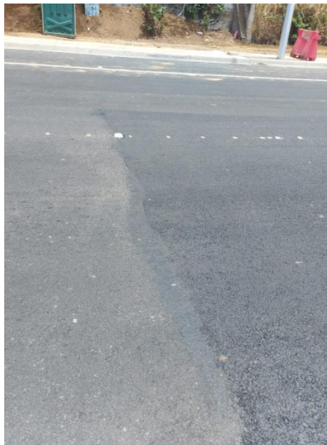
Figura 32. Junta transversal carril externo sentido San Pedro-Calle Blancos, Estacionamiento 1+000. Fecha 22 de marzo de 2021
