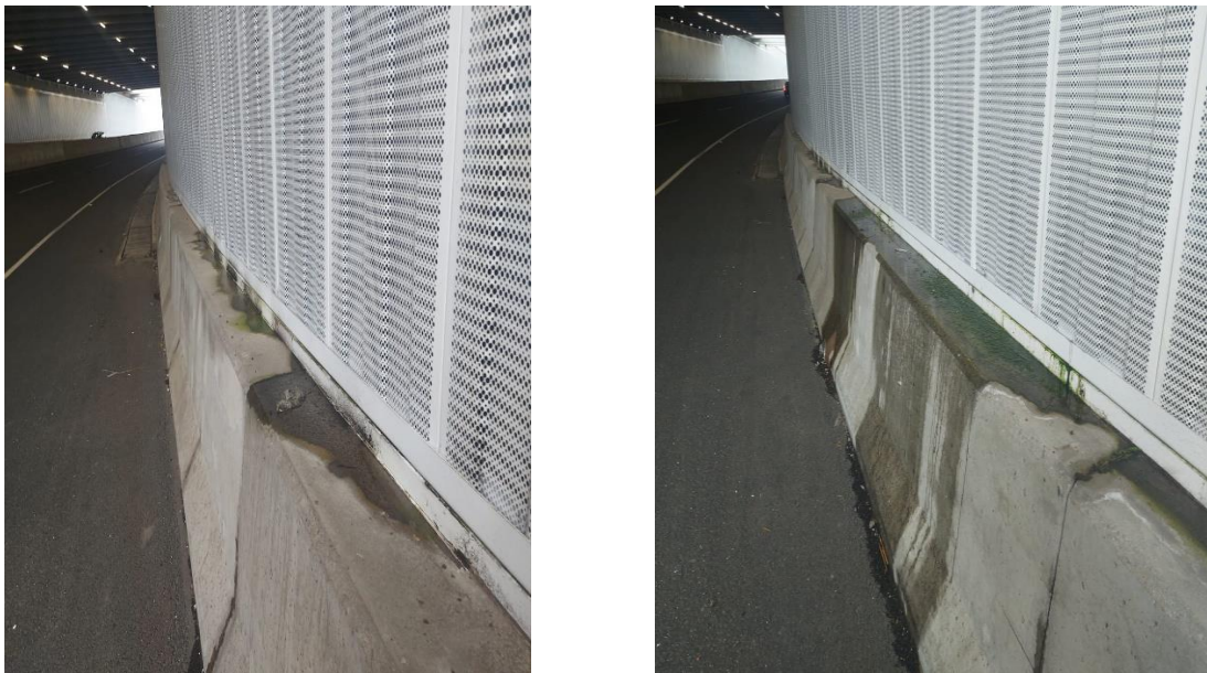
Figura A2. Condición de drenajes visita monitoreo al proyecto. Fecha 09 de julio de 2021.
