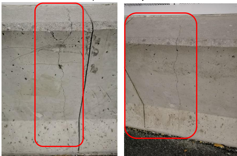
Figura 16. Grietas identificadas en barreta tipo New Jersey. Fecha: 16 marzo 2021.
