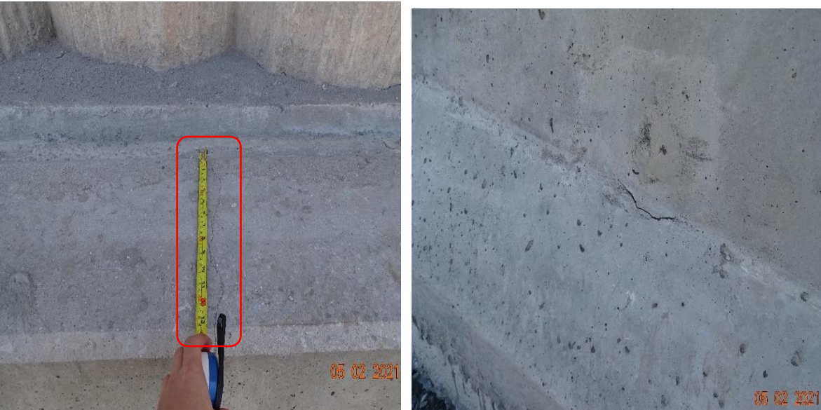
Figura 15. Grietas identificadas en barrera tipo New Jersey en la sección horizontal superior y en el cambio de sección vertical. Fecha: 5 febrero 2021.
