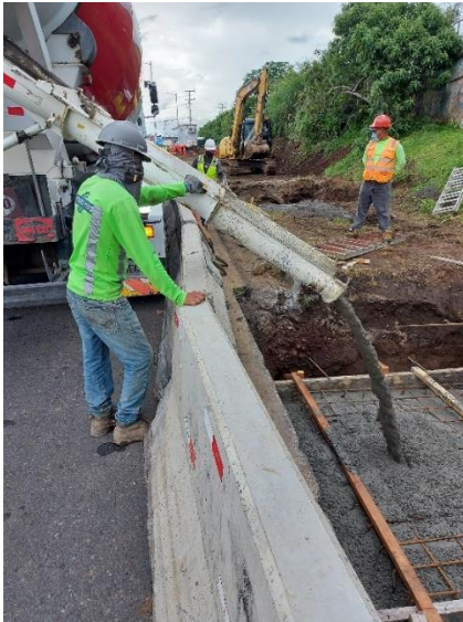
Figura 9. Colocación de concreto en placa de fundación puente peatonal, resistencia de 300 kg/cm 2 . Fecha: 15 de octubre de 2020. Fuente: LanammeUCR.
