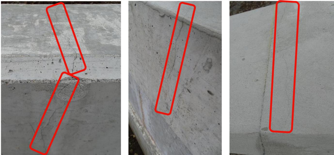
Figura 13. Agrietamientos en las barreras tipo New Jersey del frente 1 y reflejo de la fisura a través del resane realizado en la misma, donde se aprecia la línea marcada para el corte con sierra y el desfase con el reflejo de la grieta. Fecha: 26 de agosto de 2020.
