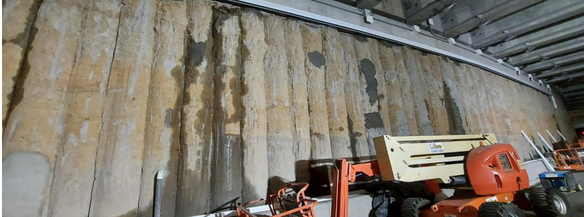
Figura 22. Filtraciones de agua pantalla de pilotes, sector norte muro en el sentido San Pedro - Calle Blancos. Fecha: 01 de marzo de 2021
