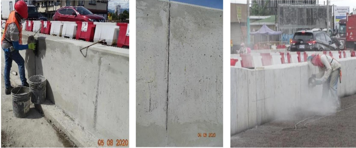
Figura 14. Resane incompleto y ranurado con sierra, en edades avanzadas del concreto, en barreras New Jersey, frentes 1 y 4. Fechas: 5 y 26 de agosto de 2020, respectivamente.
