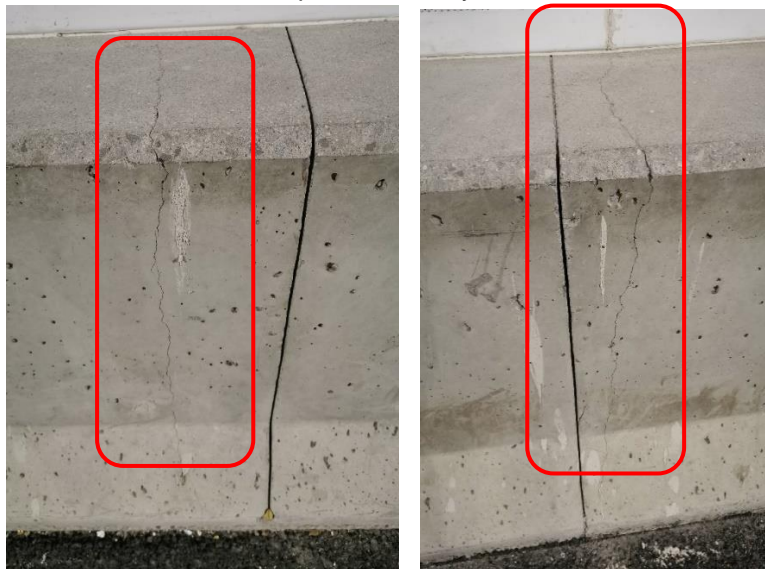
Figura 17. Grietas identificadas en barreta tipo New Jersey. Fecha: 16 marzo 2021.
