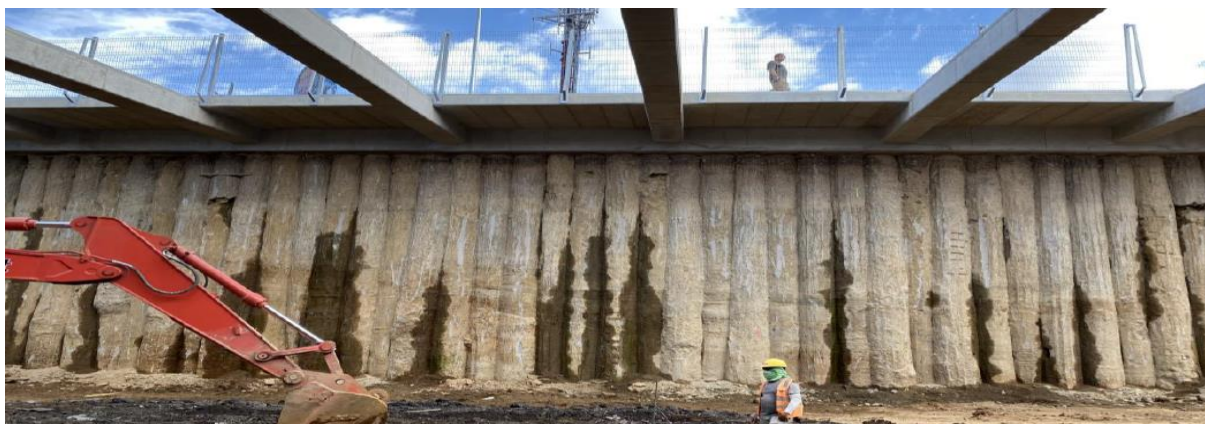
Figura 20. Filtraciones de agua pantalla de pilotes, sector sur muro en el sentido San Pedro - Calle Blancos. Fecha: 08 de enero de 2021
