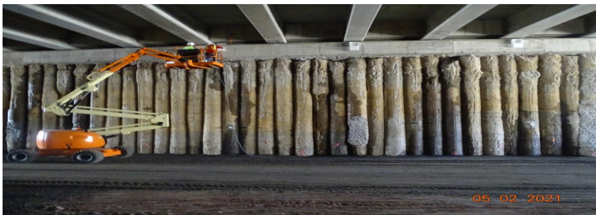
Figura 21. Filtraciones de agua pantalla de pilotes, sector norte muro en el sentido San Pedro - Calle Blancos. Fecha: 05 de febrero de 2021
