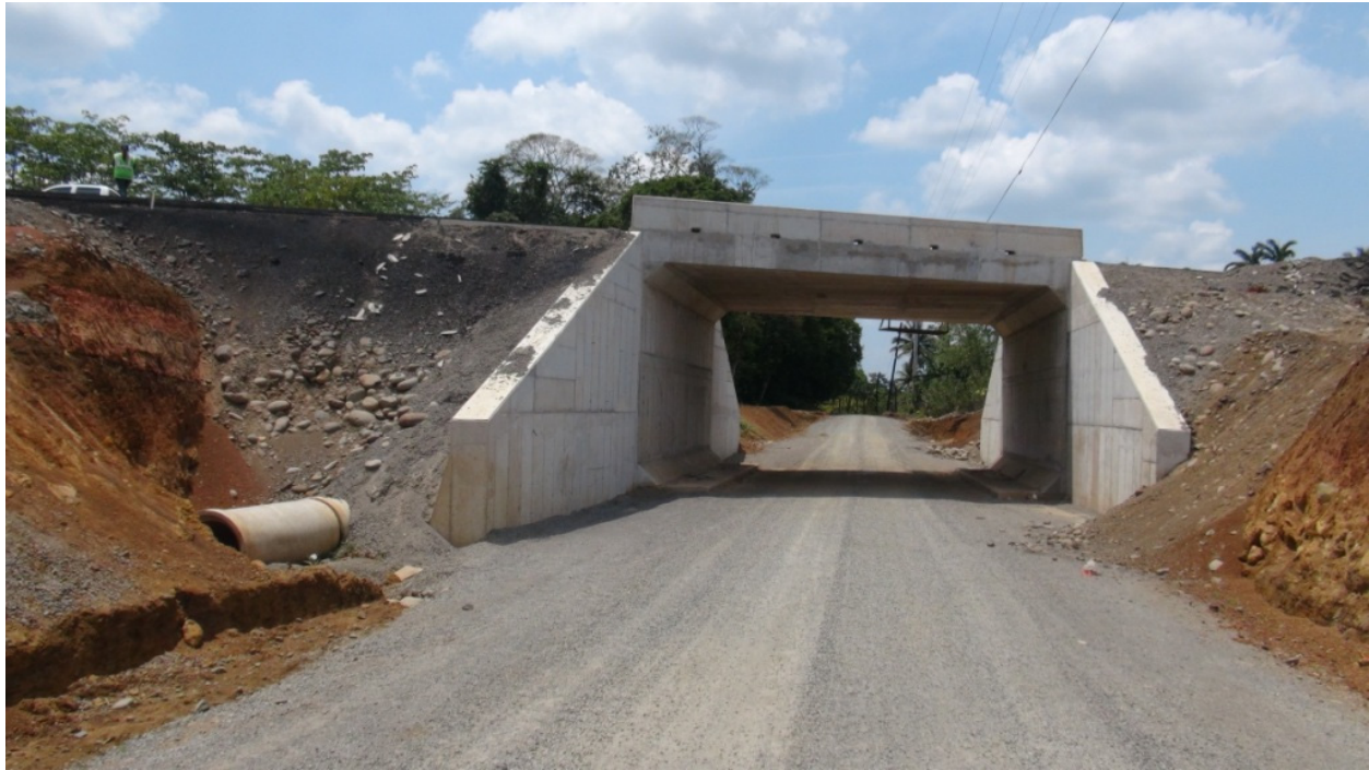
Figura 13: Paso a desnivel 4+150: Vista lateral donde se observa que el puente presenta un gran avance en su construcción. Solo falta la conformación de terraplenes en ambos accesos.
