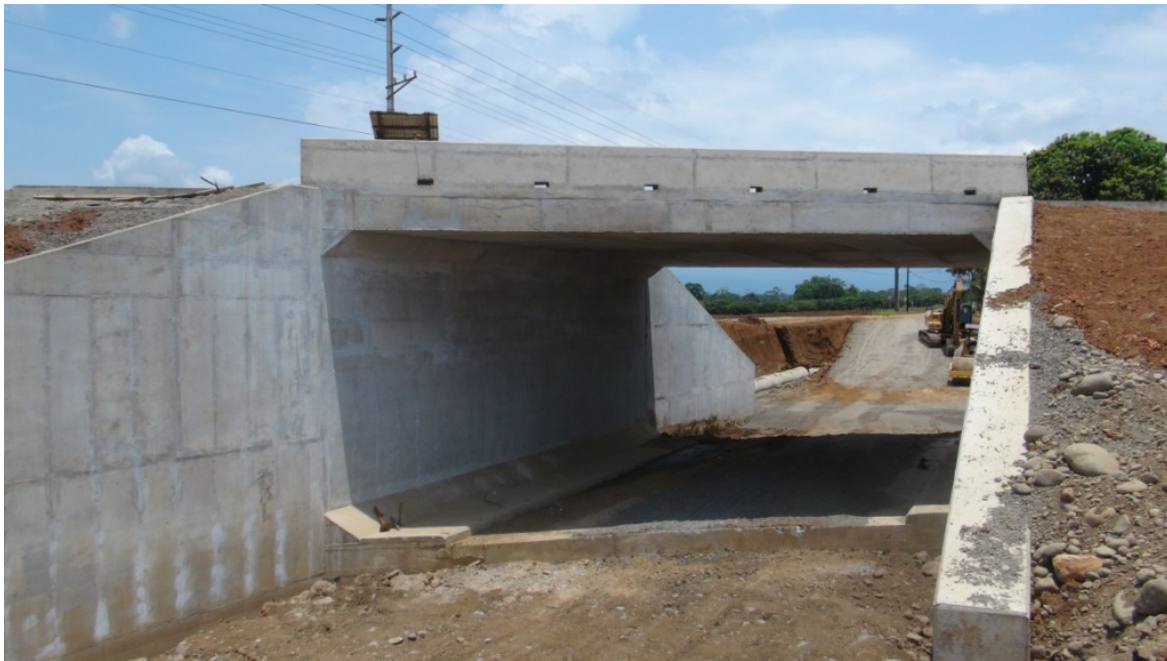
Figura 9: Paso a desnivel 3+176: Se muestra el sistema de drenaje para el manejo del agua de lluvia sobre la calzada del puente y el avance general en la construcción del mismo.
