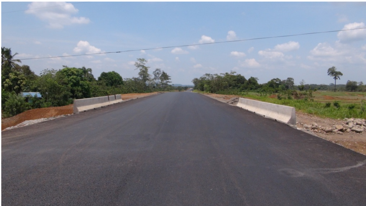
Figura 14: Paso a desnivel 4+150: Vista a lo largo de la línea de centro donde se observa la colocación de la carpeta asfáltica.
