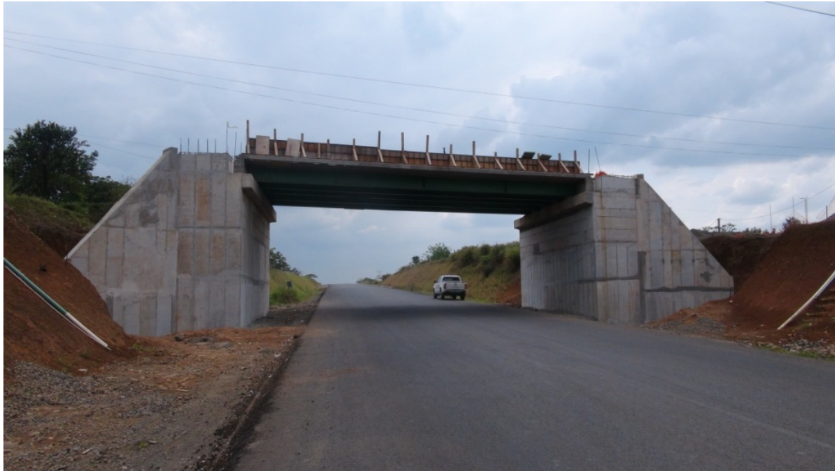
Figura 22: Paso a desnivel 14+747: Vista lateral del puente mostrando el avance de la construcción.
