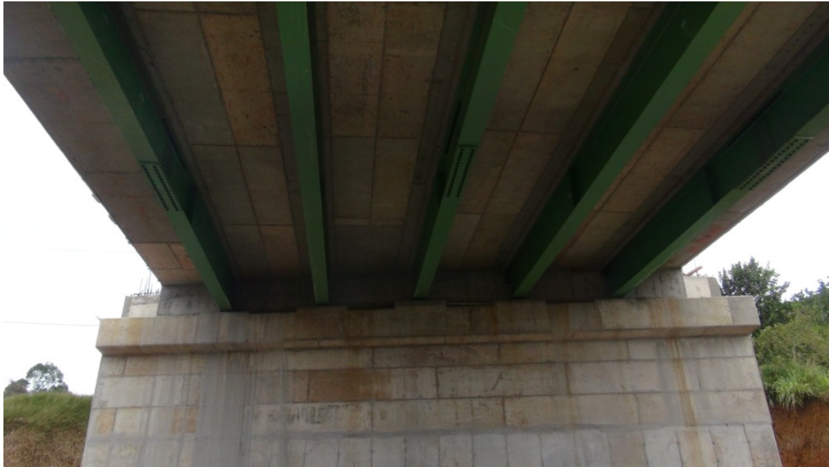
Figura 24: Paso a desnivel 14+747: Vista inferior del puente mostrando las vigas de acero y superficie inferior de la losa.
