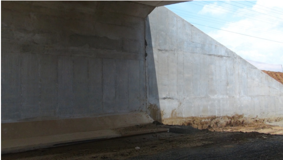
Figura 11: Paso a desnivel 3+176: Se observo grieta vertical entre el muro del bastión y el muro de retención.
