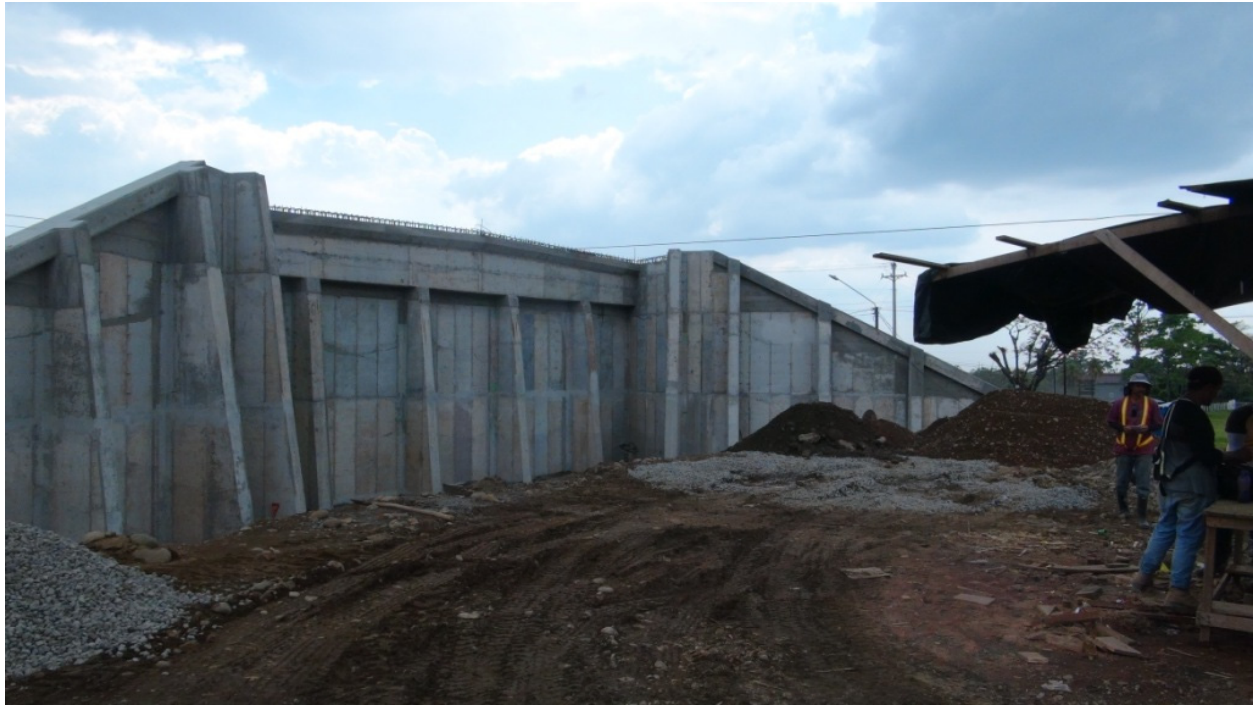
Figura 30: Paso a desnivel 27+013: La construcción del bastión -Oeste y sus respectivos muros de contención están completa.
