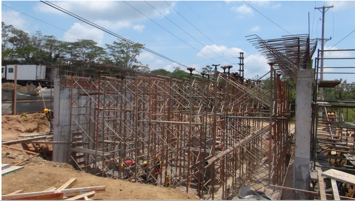
Figura 4: Paso a desnivel 1+551: Vista lateral donde se observan los preparativos para el colado de la losa de rodamiento.
