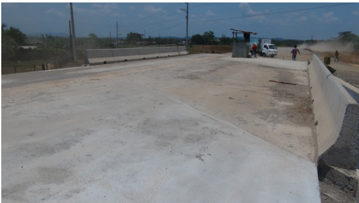
Figura 10: Paso a desnivel 3+176: Vista a lo largo de la línea de centro donde se observa la falta de la carpeta asfáltica y los guardavías.
