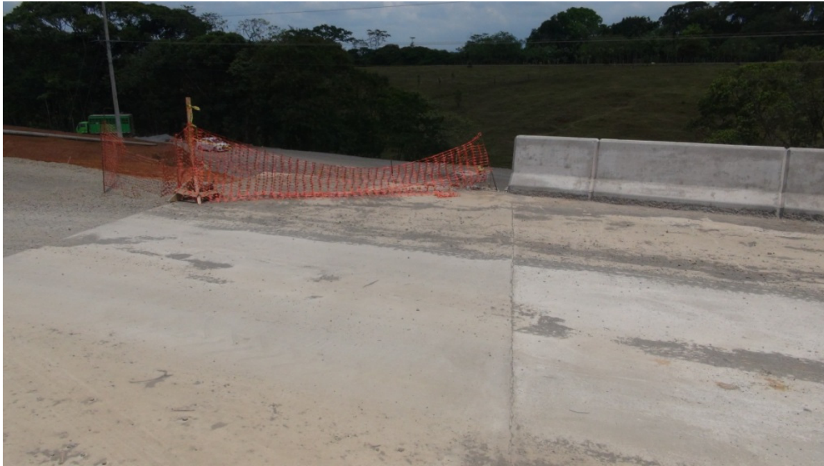
Figura 18: Paso a desnivel 6+200: Vista sobre el puente donde se muestra la losa de aproximación construida y cortes realizados a la barrera vehicular.
