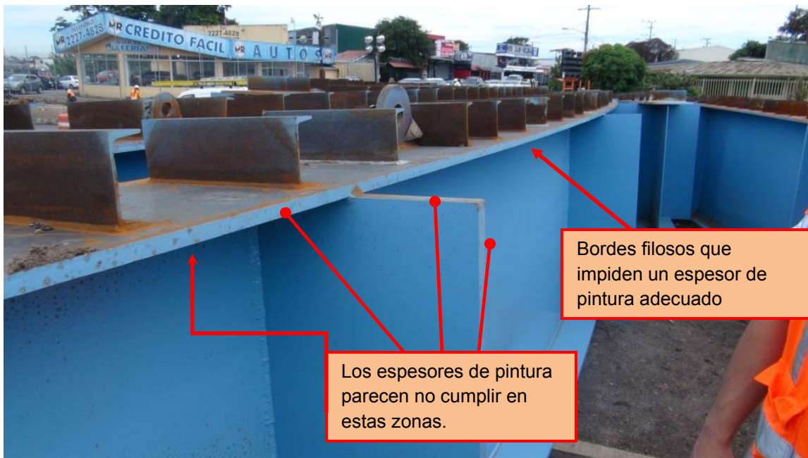
Figura 5. Se detectaron bordes filosos y superficies con aparentemente una falta de espesor de pintura. Puente-Este y Puente-Oeste.
