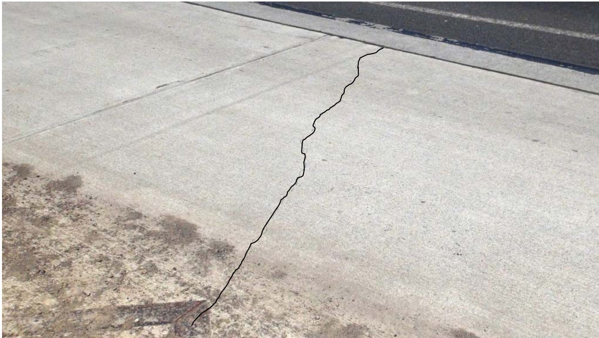
Figura 7. Fisuras en la losa de aproximación Norte del puente-Oeste.
