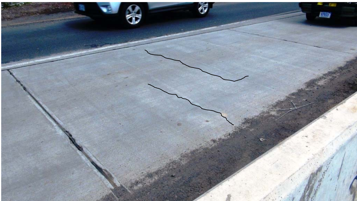
Figura 8. Fisuras en la losa de aproximación y juntas de construcción con sello de neopreno del puente-Oeste
